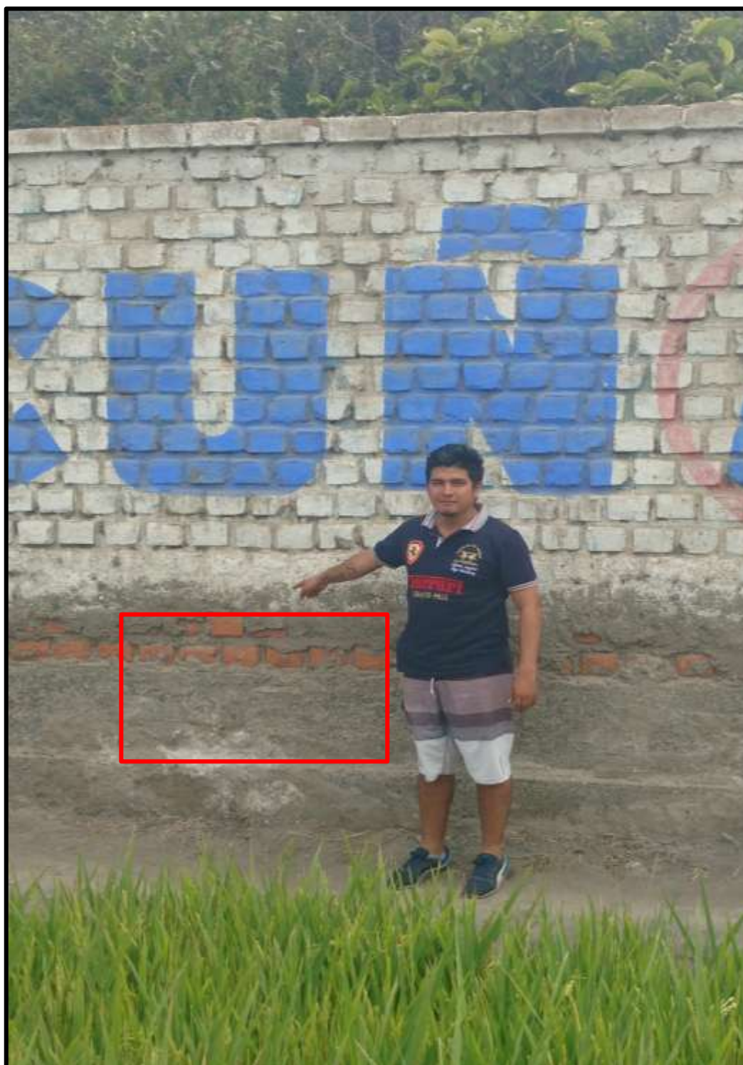
Fotografía 6: Muro de albañilería afectado por erosión en la Unidad Muestral 8.
