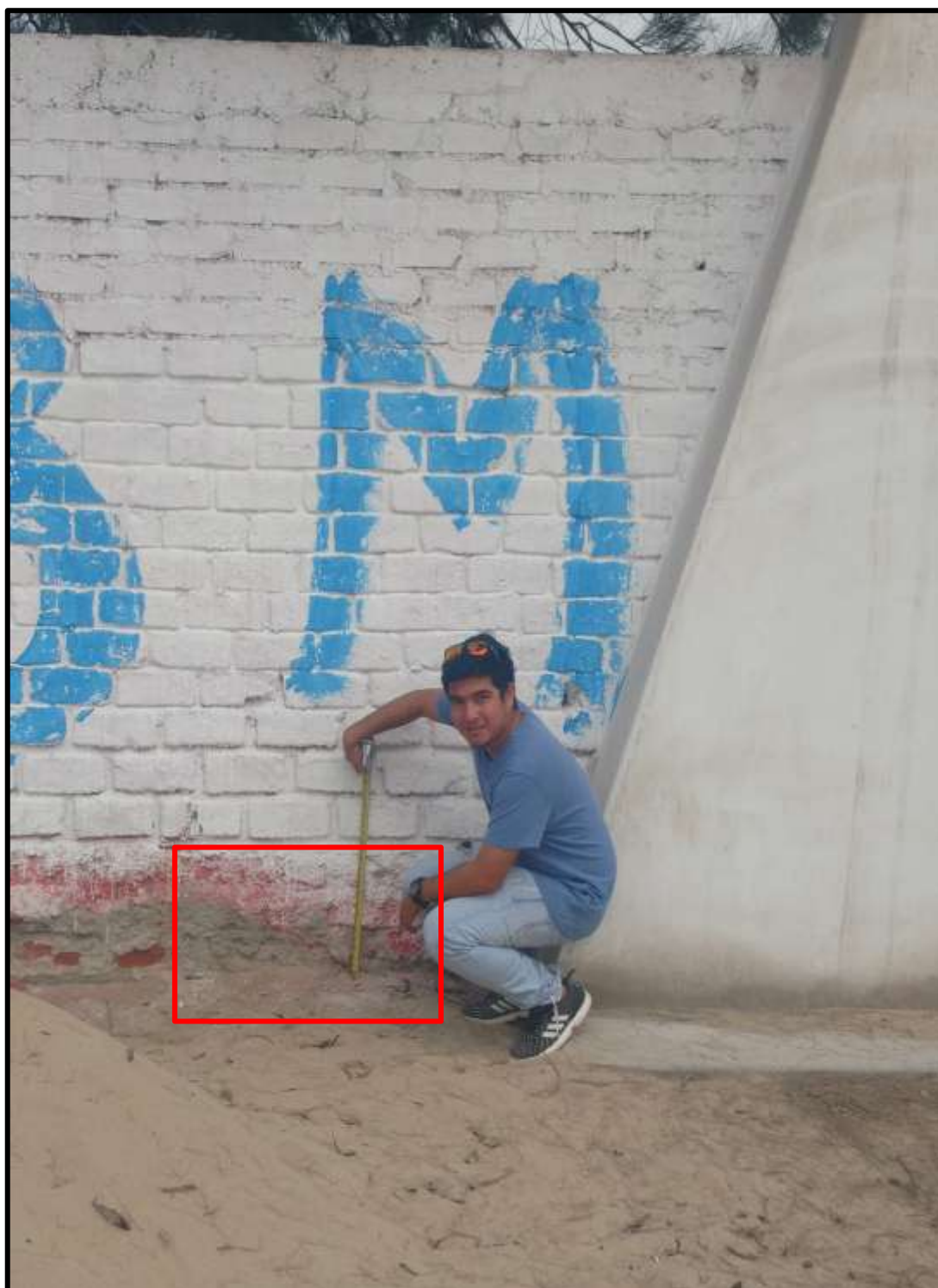
Fotografía 4: Muro de albañilería afectado por eflorescencia en la Unidad Muestral 5
