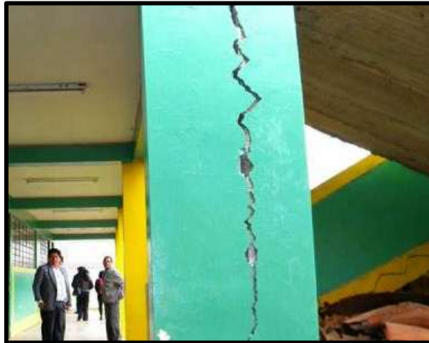
Imagen N°20: Grietas columna de concreto. Fuente: Elaboración Propia(2017)
