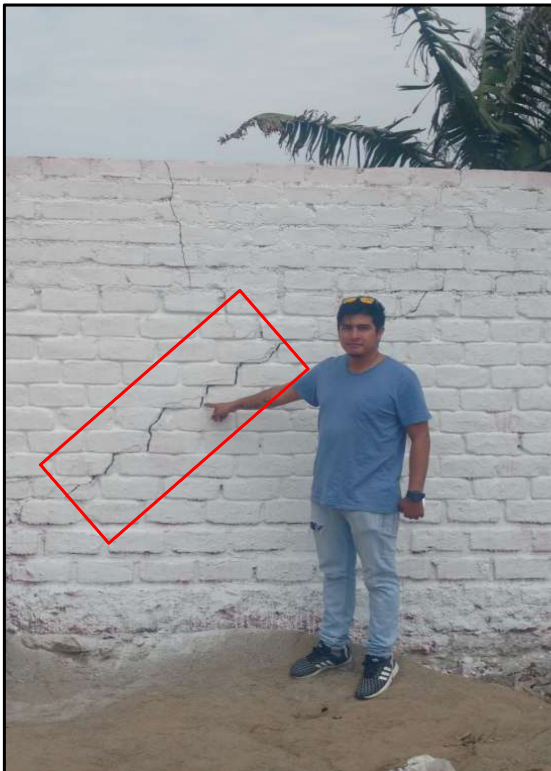
Fotografía 5: Muro de albañilería afectado por grietas en la Unidad Muestral 4.
