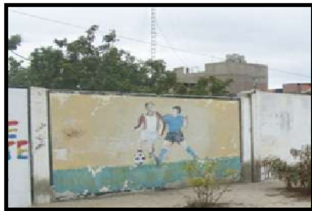
Imagen N°01: Corrosión en Acabados. Fuente: Elaboración Propia(2017)
