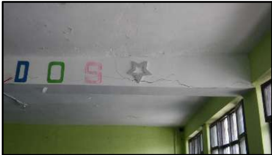
Imagen N°18: Fisuras en elementos de concreto.
