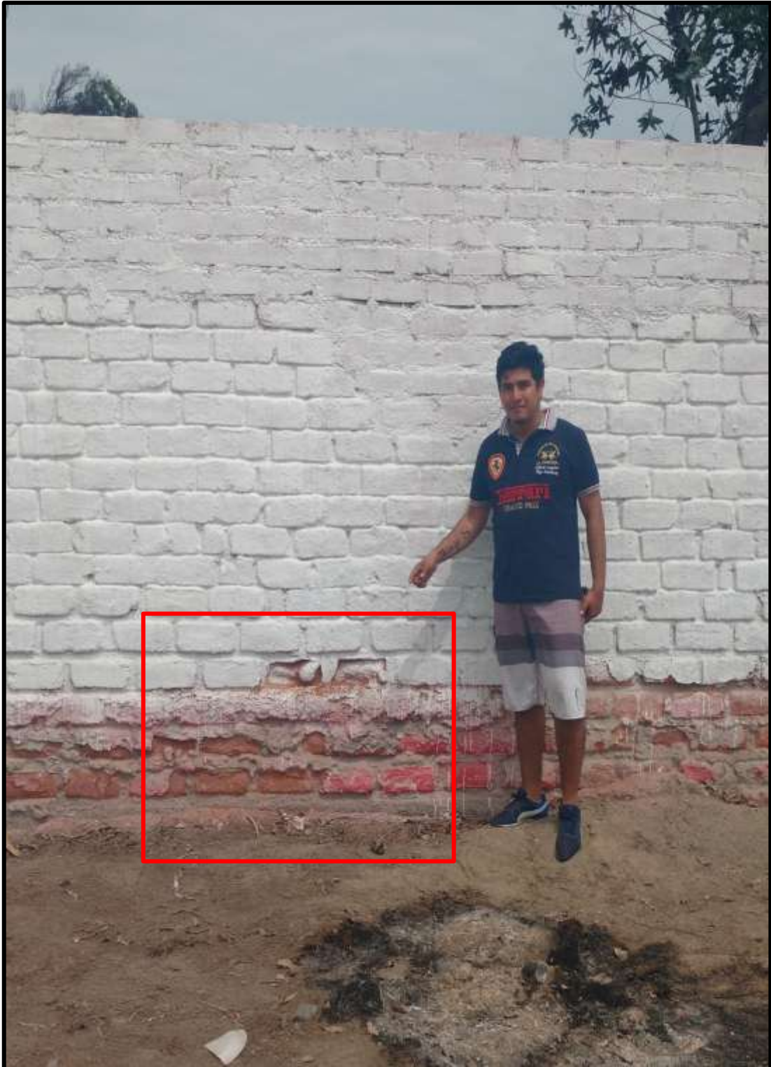
Fotografía 3: Muro de albañilería afectado por erosión en la Unidad Muestral 6.
