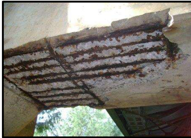
Imagen N°22: Corrosión del acero de refuerzo. Fuente: Elaboración Propia(2017)
