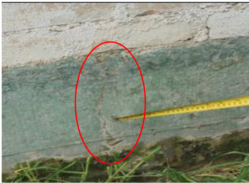
Fotografía 07: Patología Grieta en el sobrecimiento de la unidad de muestra N° 09.
