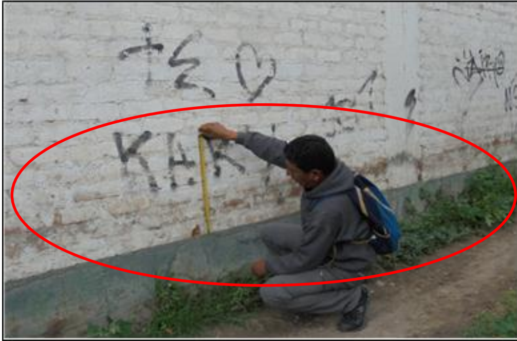
Fotografía 03: Patologías Erosión en la parte inferior de la unidad de muestra N° 02.
