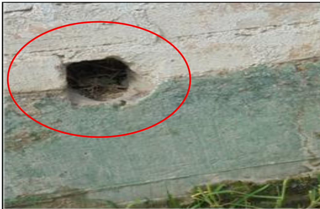
Fotografía 05: Patología Picadura en el muro de ladrillo de la unidad de muestra N°09.
