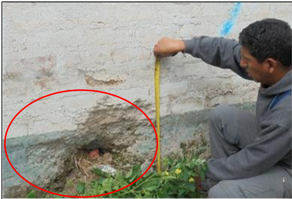
Fotografía 04: Patología picadura en el sobrecimiento de la unidad de muestra N°04.
