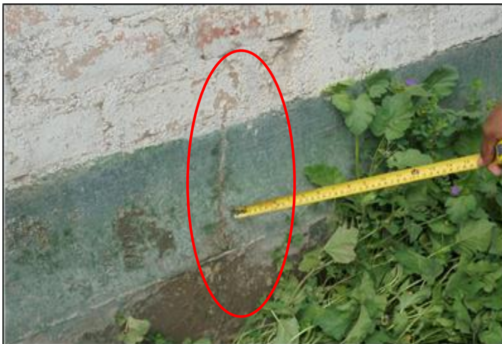
Fotografía 06: Patología Grieta en sobre cimienta en la unidad de muestra N°08.
