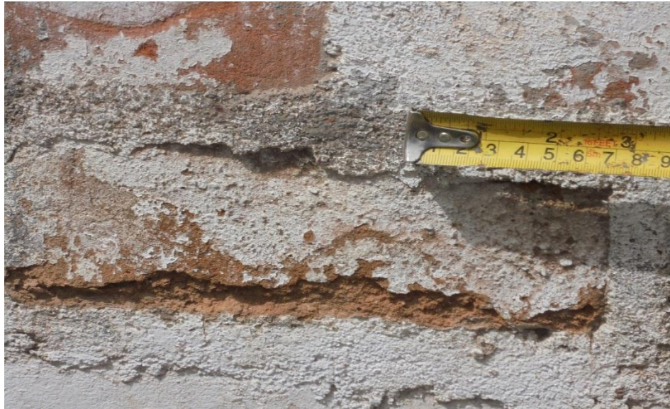
Figura 13. Erosión en los muros de albañilería
