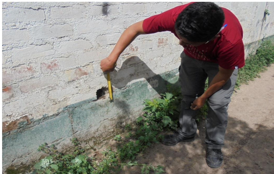
Figura 15. Picadura en muro Fuente: Elaboración propia
