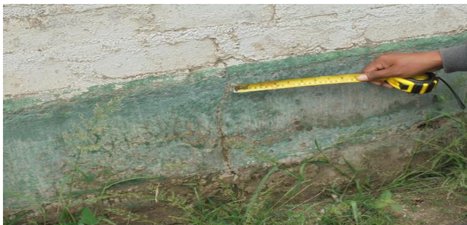
Figura 14. Grieta en muros Fuente: Elaboración propia
