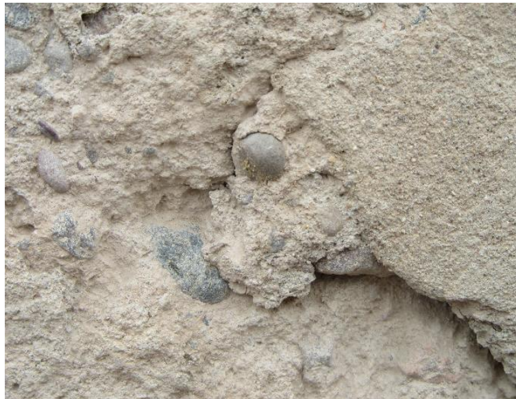
Figura 10: Desprendimiento en columna.
