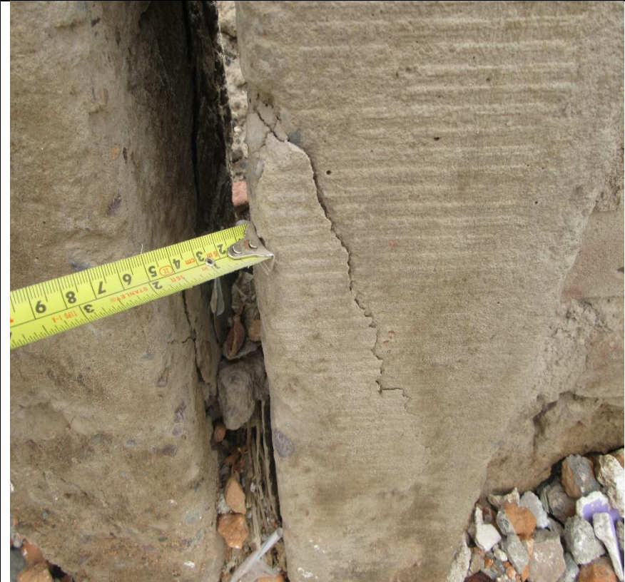
Fotografía 08: Desprendimiento en columna del cerco perimétrico del depósito de vehículos de la universidad Nacional de San Cristóbal de Huamanga. En la unidad de muestra 11.
