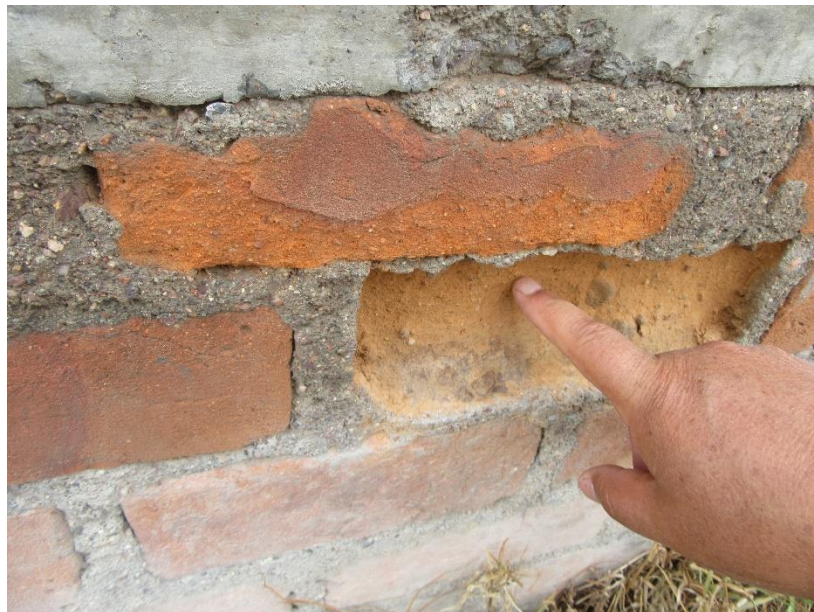
Figura 06: Erosión en muro
