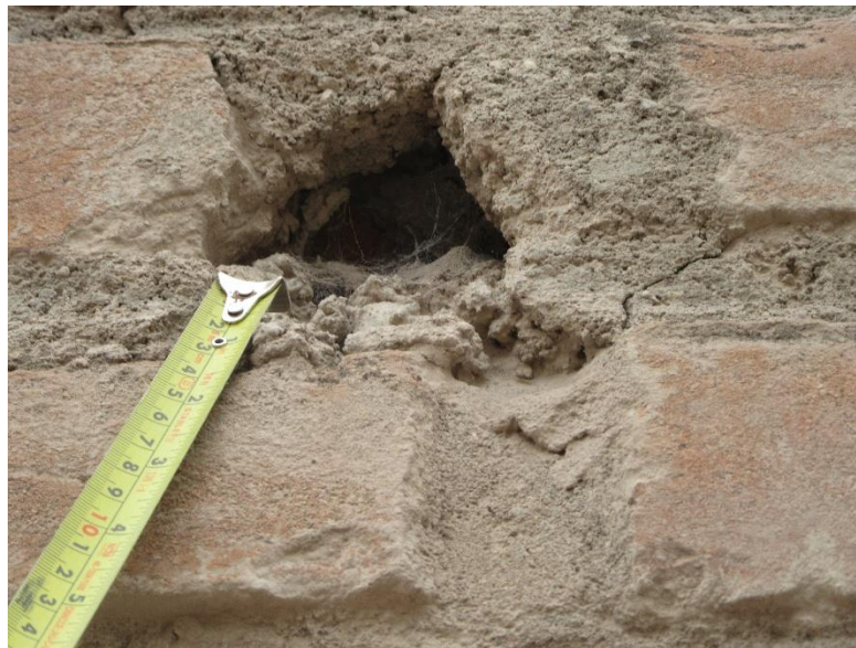
Figura 08: Picadura en los muros.
