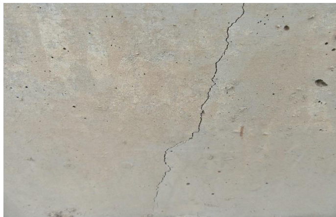
Figura 07. Fisuras en columna
