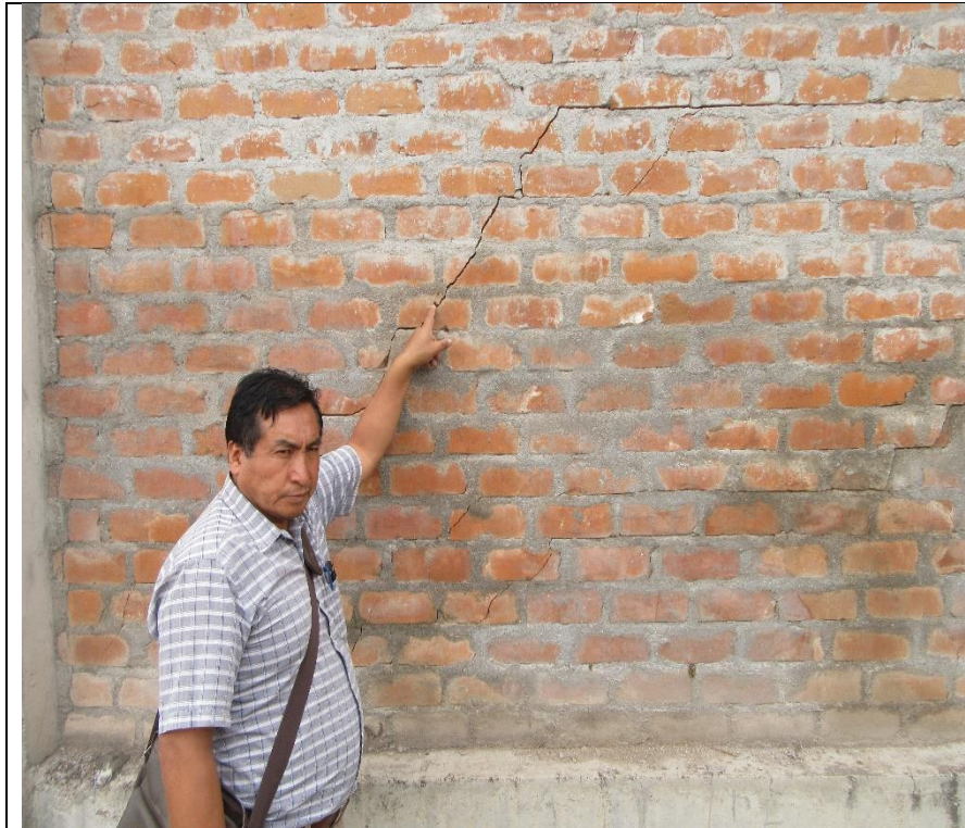
Fotografía 05: Grieta en muro del cerco perimétrico del depósito de vehículos de la universidad Nacional de San Cristóbal de Huamanga. En la unidad de muestra 03.
