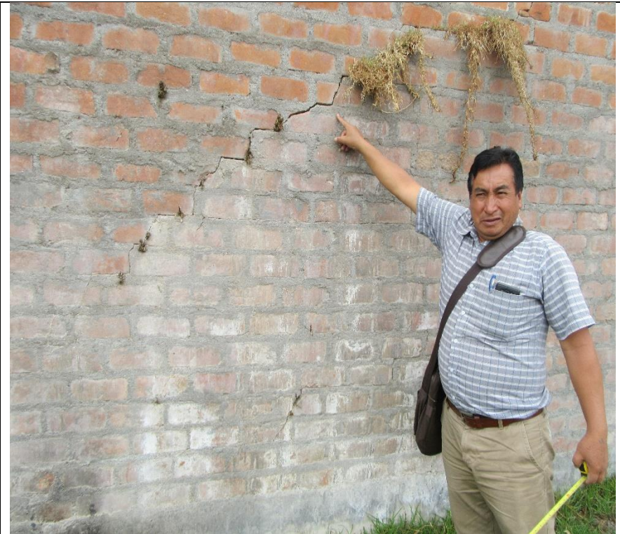
Fotografía 06: Grieta en muro del cerco perimétrico del depósito de vehículos de la universidad Nacional de San Cristóbal de Huamanga. En la unidad de muestra 03.
