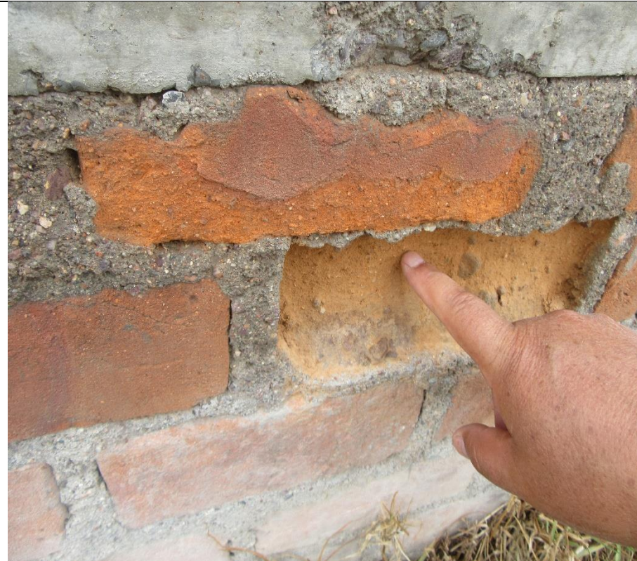
Fotografía 03: Erosión en muro del cerco perimétrico del depósito de vehículos de la universidad Nacional de San Cristóbal de Huamanga. En la unidad de muestra 02.
