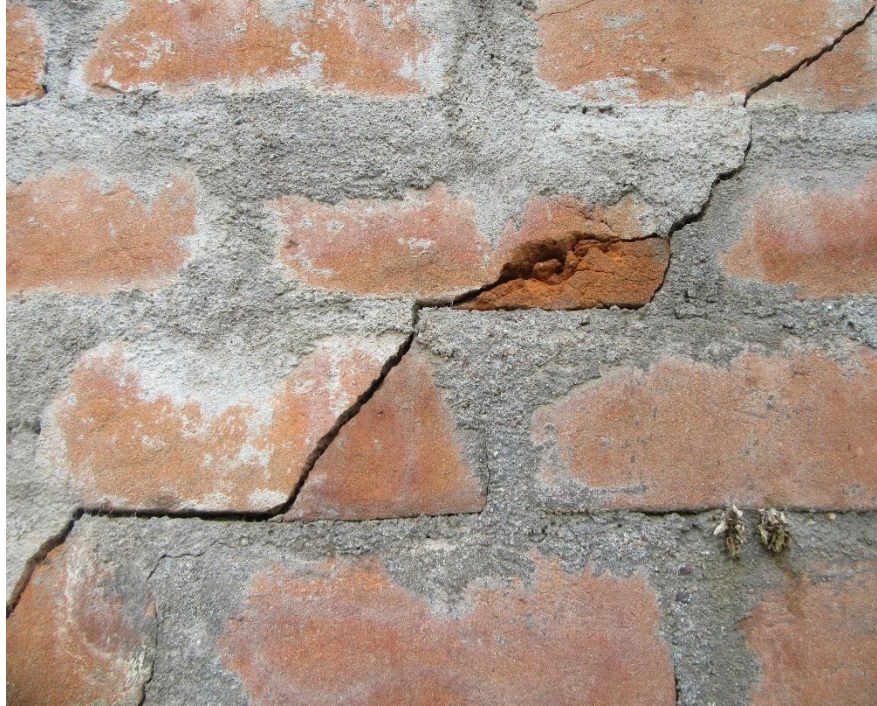
Figura 05. Grieta en muros
