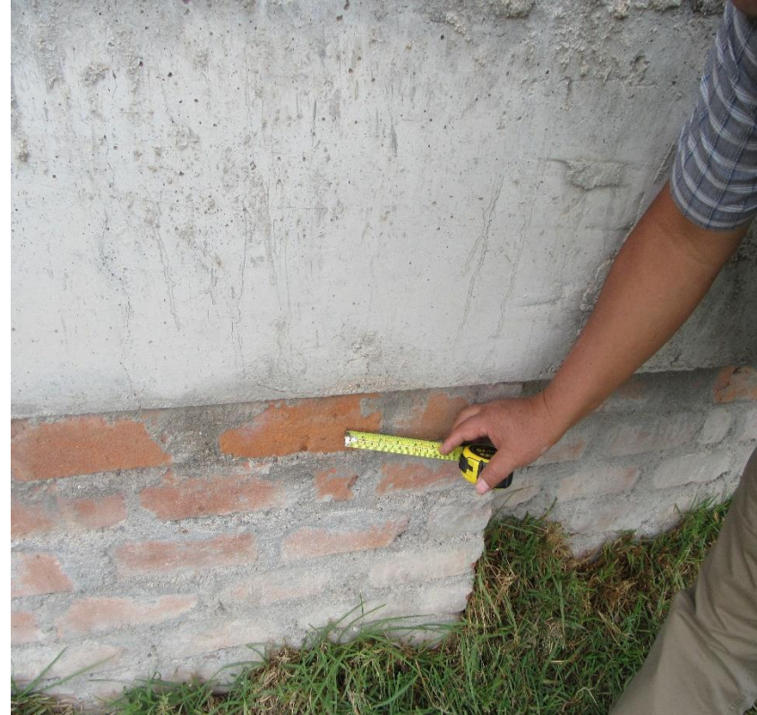
Fotografía 02: Erosión en muro del cerco perimétrico del depósito de vehículos de la universidad Nacional de San Cristóbal de Huamanga. En la unidad de muestra 01
