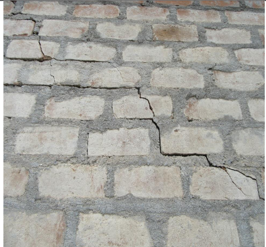
Fotografía 04: Grieta en muro del cerco perimétrico del depósito de vehículos de la universidad Nacional de San Cristóbal de Huamanga. En la unidad de muestra 02.
