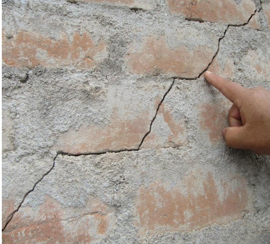
Fotografía 01: Grieta en muro del cerco perimétrico del depósito de vehículos de la universidad Nacional de San Cristóbal de Huamanga. En la unidad de muestra 01
