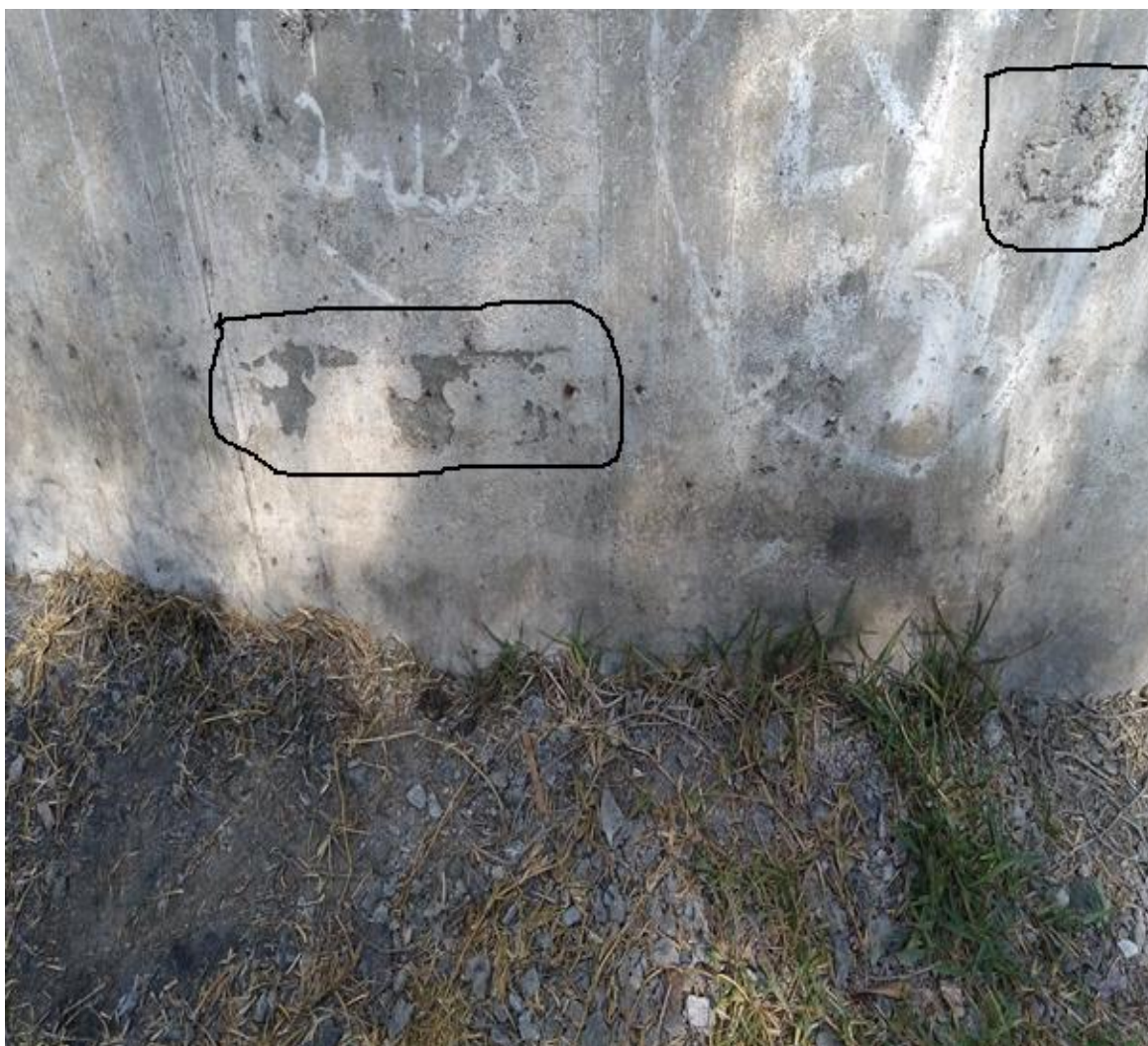
Fotografía 11: elemento de concreto armado afectada por la disgregación en Unidad Muestral 9.
