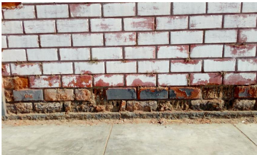
Figura 14. Muro de albañilería afectada por erosión en la parte inferior producto de un suelo salitroso y húmedo.
