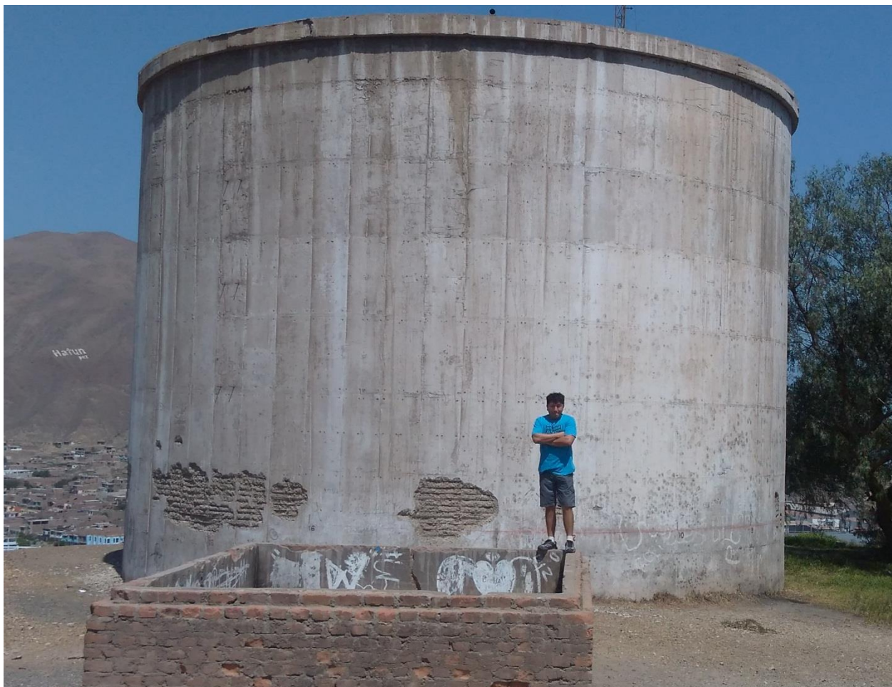
Fotografía 3: Vista lateral izquierda del reservorio apoyado R1, del distrito de Coishco, provincia de Santa, departamento de Ancash.
