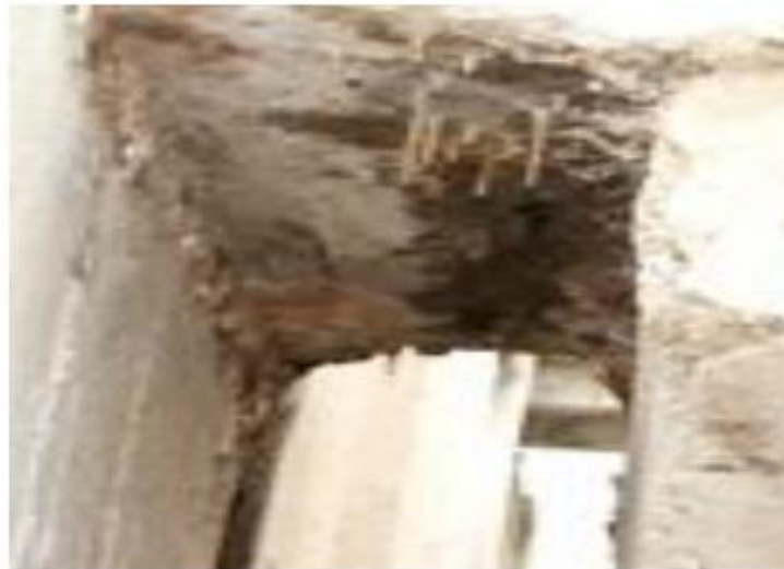
Figura 12. Eflorescencia del hormigón armado. Nota. Fuente: Crespo, D. (2014).
