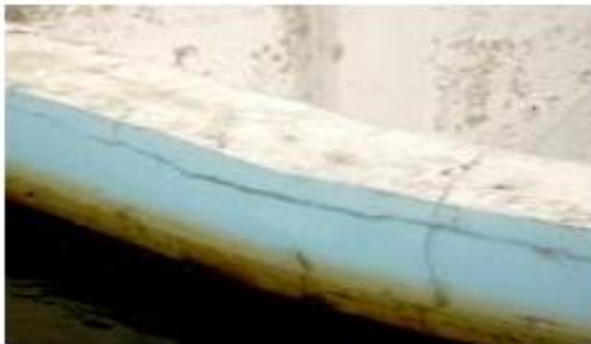
Figura 10. Grieta en elemento de concreto armado.
