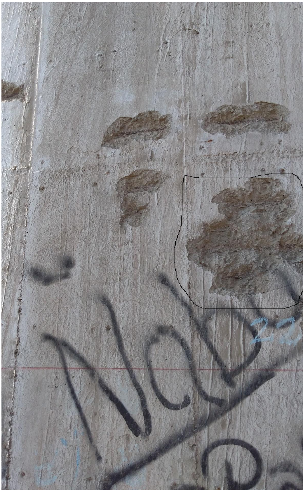
Fotografía 9: elemento de concreto armado afectada por la erosión en Unidad Muestral 11
