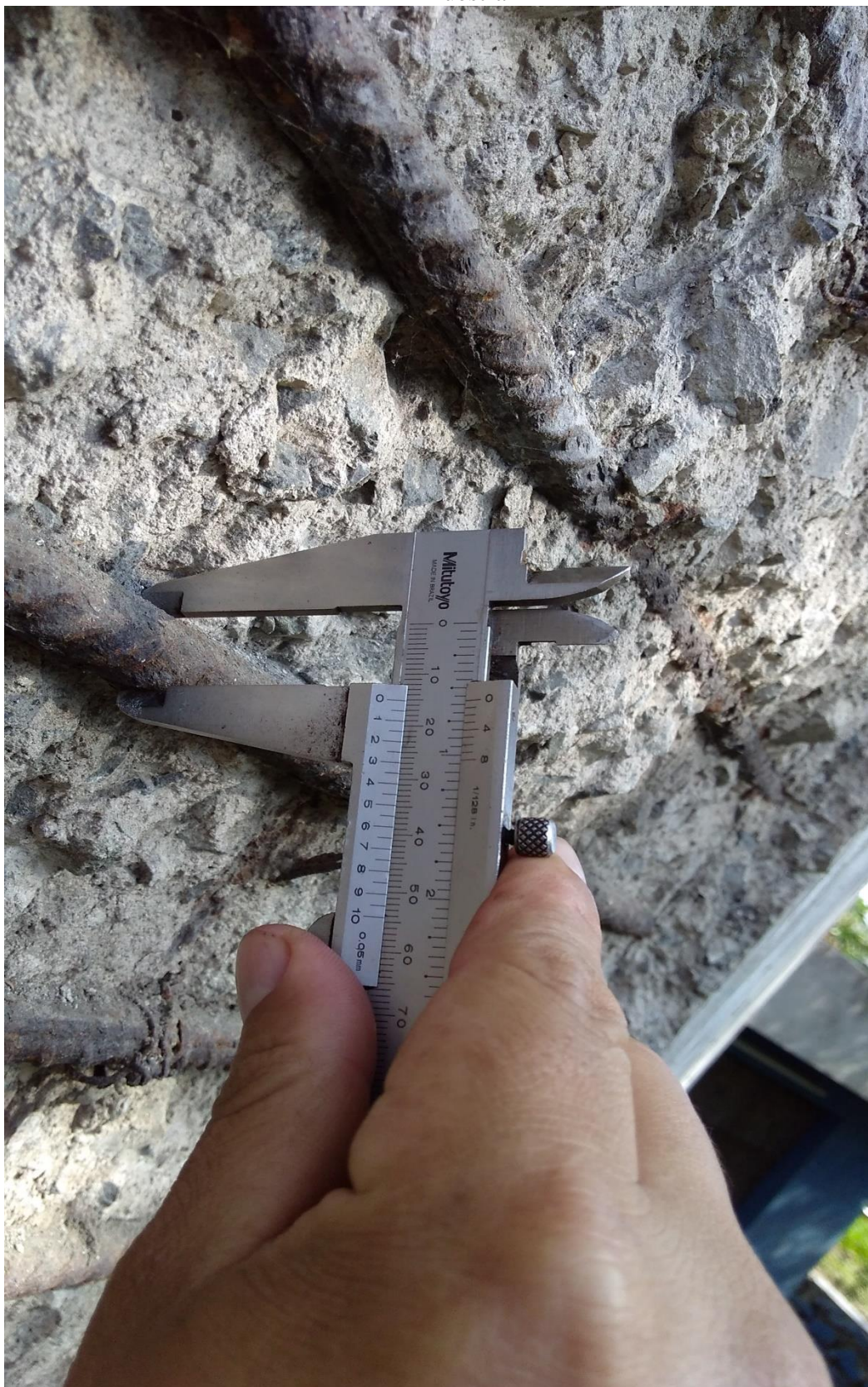
Fotografía 15: elemento de concreto armado afectada por corrosión en Unidad Muestral 4
