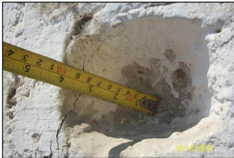
Figura 11. Erosión de la unidad de albañilería.
