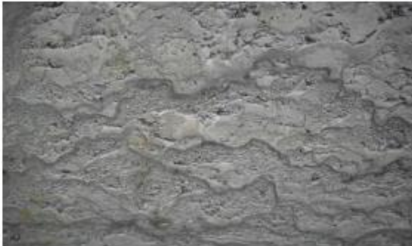
Figura 15. Disgregación de hormigón armado Nota. Fuente: Crespo, D. (2014).
