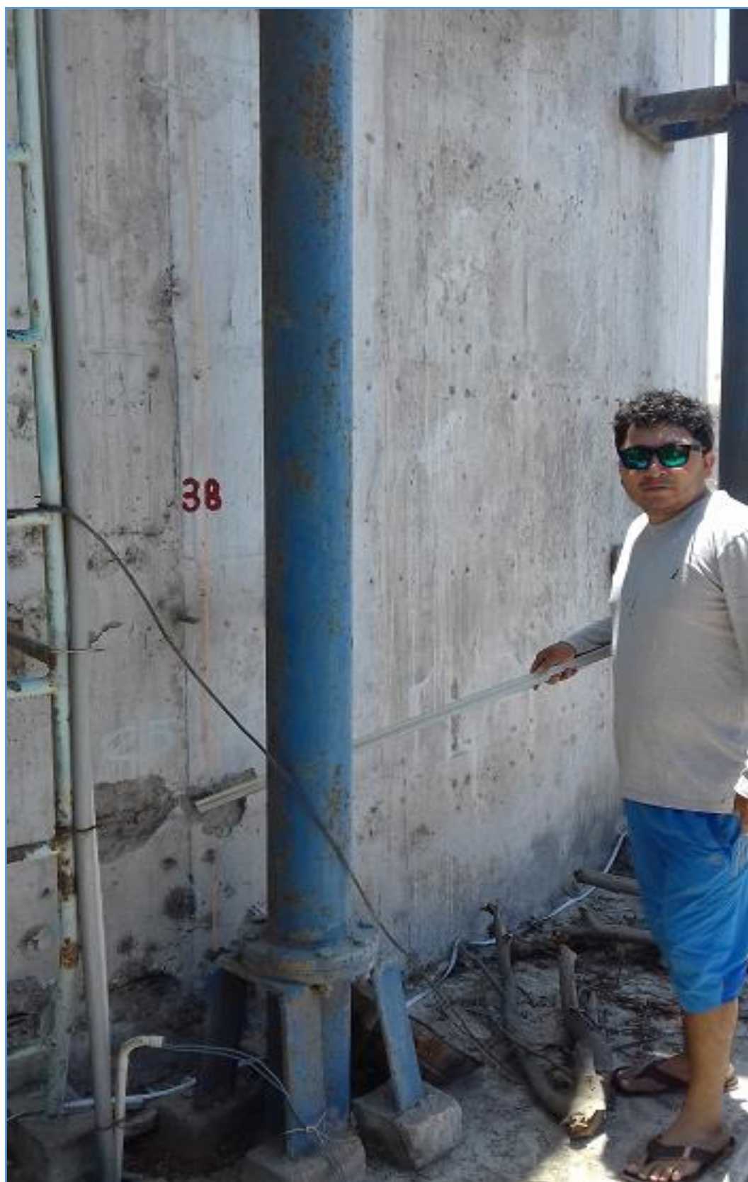
Fotografía 8: elemento de concreto armado afectada por la erosión en Unidad Muestral 20
