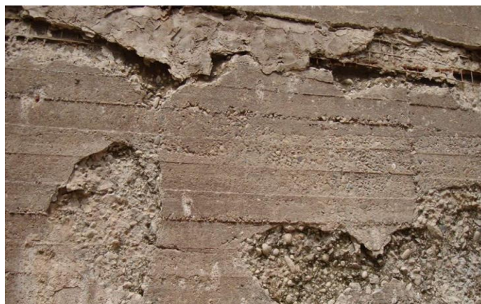
Figura 9. Erosión del concreto en un muro de contención, causada por agentes atmosféricos (agua de lluvia, viento)
