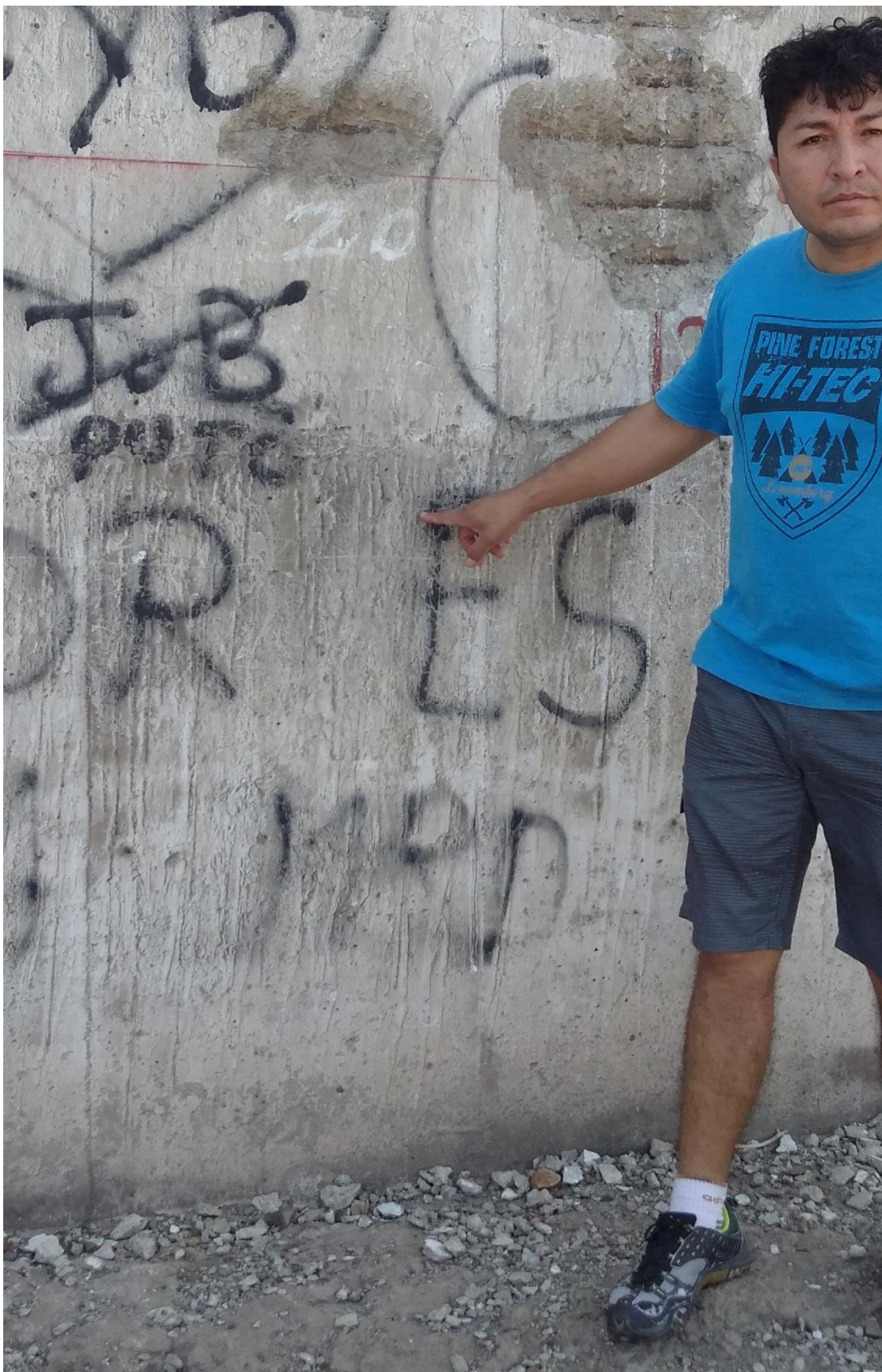
Fotografía 10: elemento de concreto armado afectada por la disgregación en Unidad Muestral 16.
