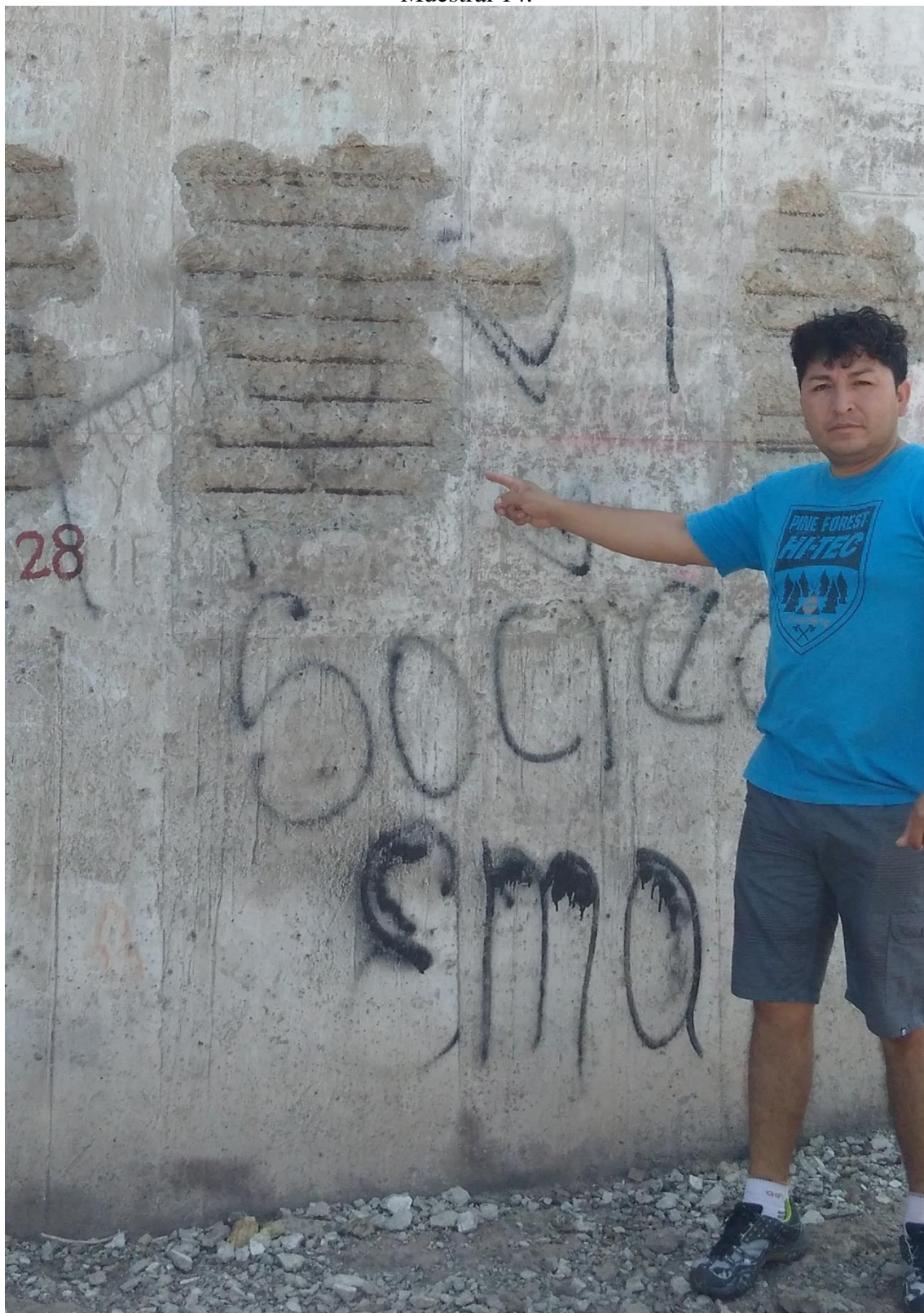
Fotografía 14: elemento de concreto armado afectada por corrosión en Unidad Muestral 14.
