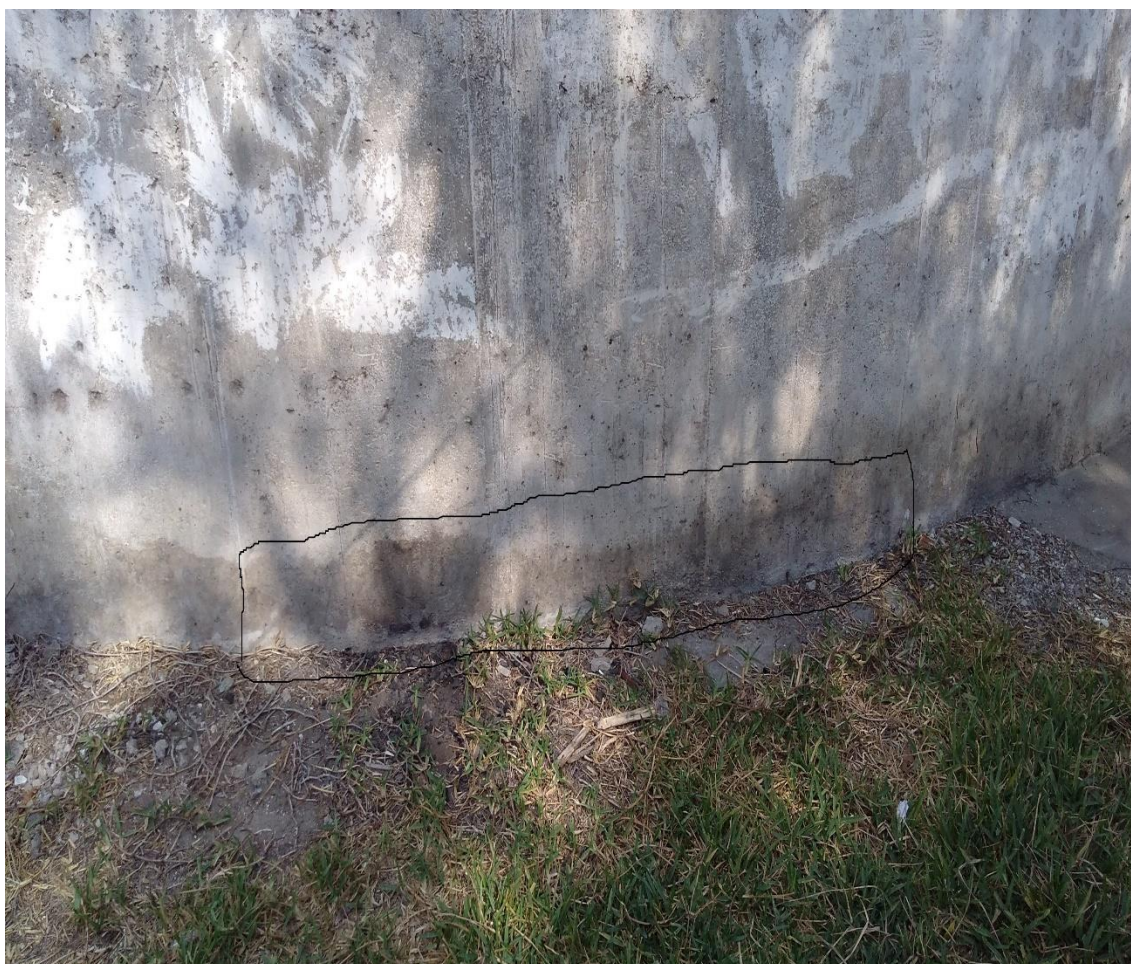
Fotografía 13: elemento de concreto armado afectada por eflorescencia en Unidad Muestral 7
