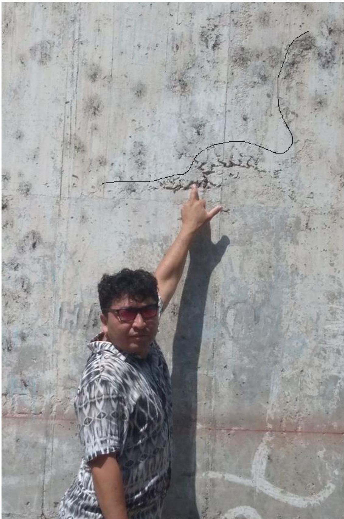
Fotografía 6: elemento de concreto armado afectado por grieta vertical en Unidad Muestral 18.
