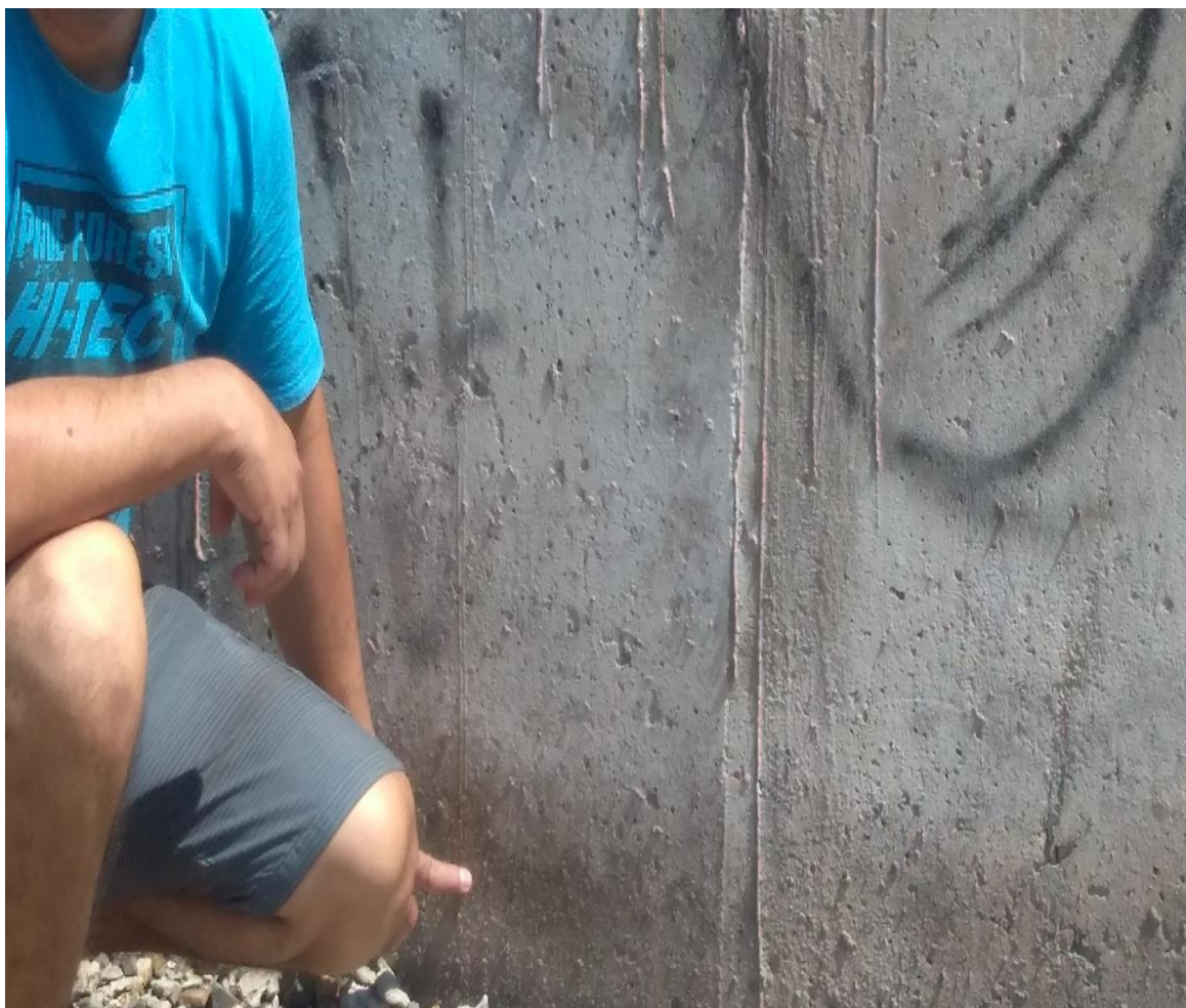
Fotografía 12: elemento de concreto armado afectada por eflorescencia en Unidad Muestral 6.
