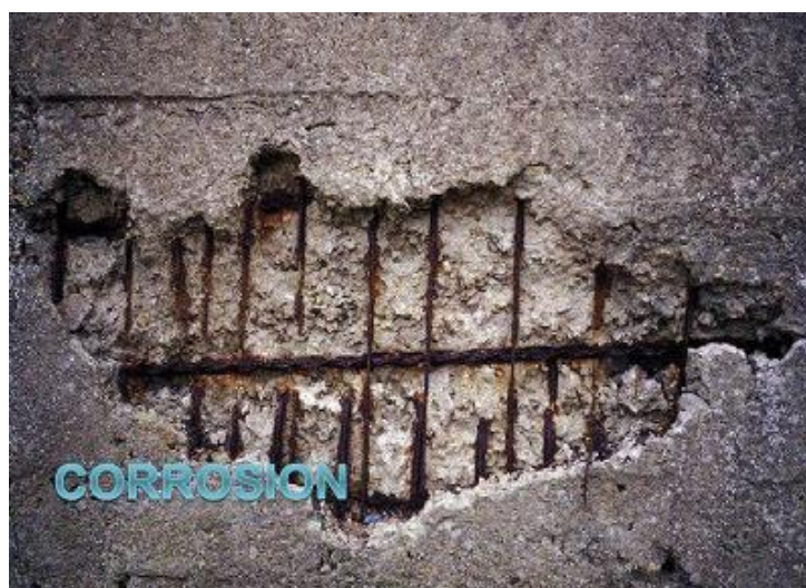
Figura 13. Corrosión. Superficie de hormigón armado. Nota. Fuente: Aquije, F. (2013).
