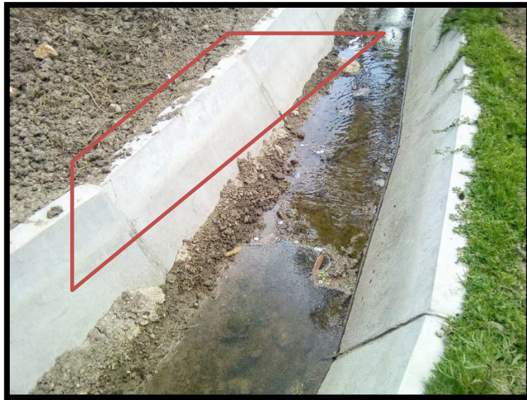
Imagen n° 05: Identificación del hundimiento en el canal.
