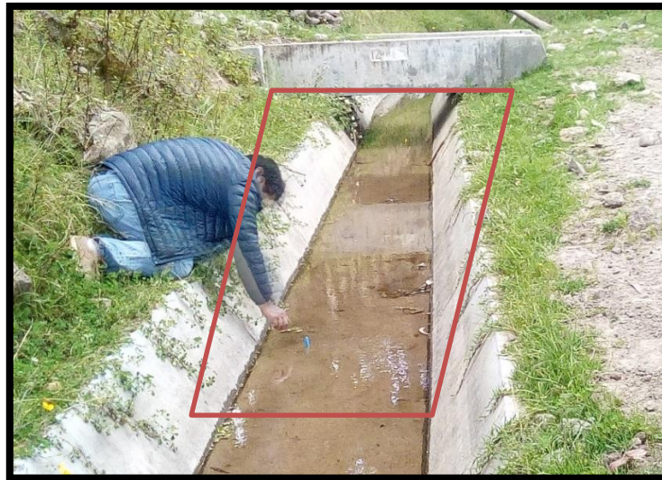
Imagen n° 04: Identificación de la sedimentación en el canal.
