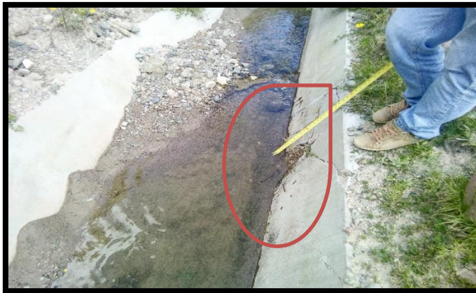
Imagen n° 01: Identificación de grieta en el canal.
