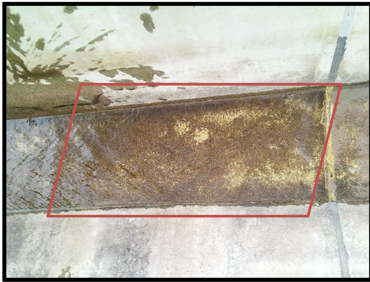
Imagen n° 06: Identificación de la erosión en el canal.
