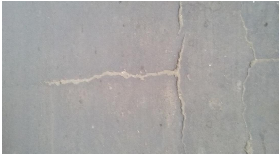
Fisura por sobre carga vehicular fisura transversal y longitudinal frente al Hotel Costa del Sol.
