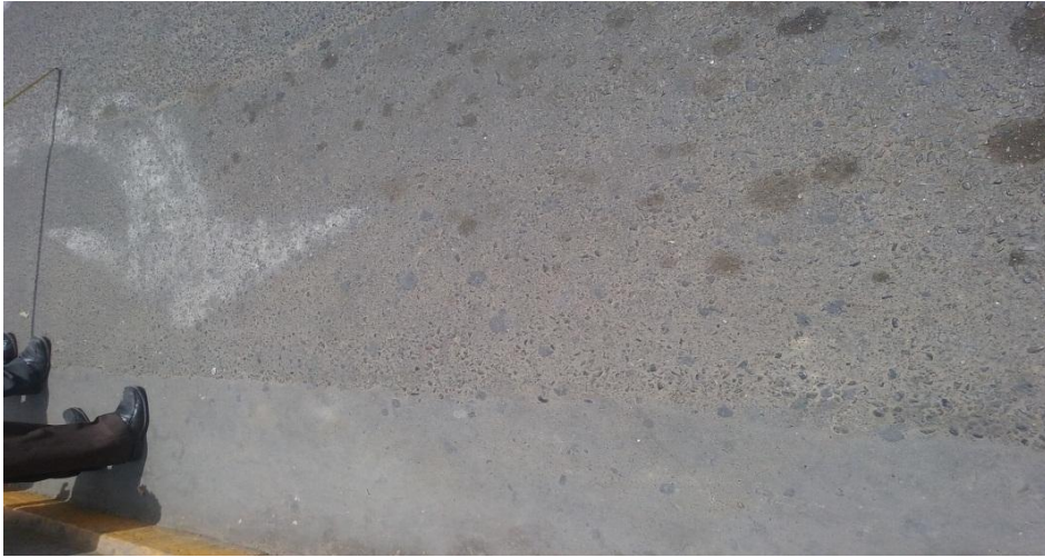
Parche y Hundimiento de buzón.
