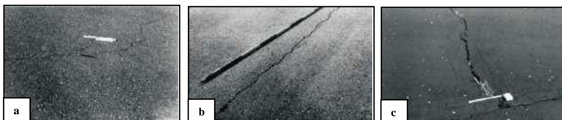
Gráfico 38. Fisuras longitudinales y transversales.
