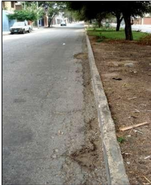
Gráfico 12. Fisuras de borde.
