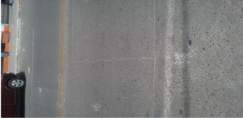
Fisura longitudinal y transversal separadas por 1 a 1.50 cm frente botica felicidad
