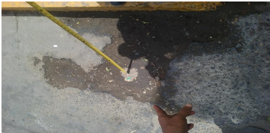
Erosión y desgaste del pavimento
