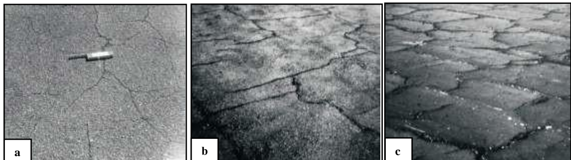
Gráfico 31. Fisuras en bloque de niveles de severidad bajo (a), medio (b) y alto (c).
