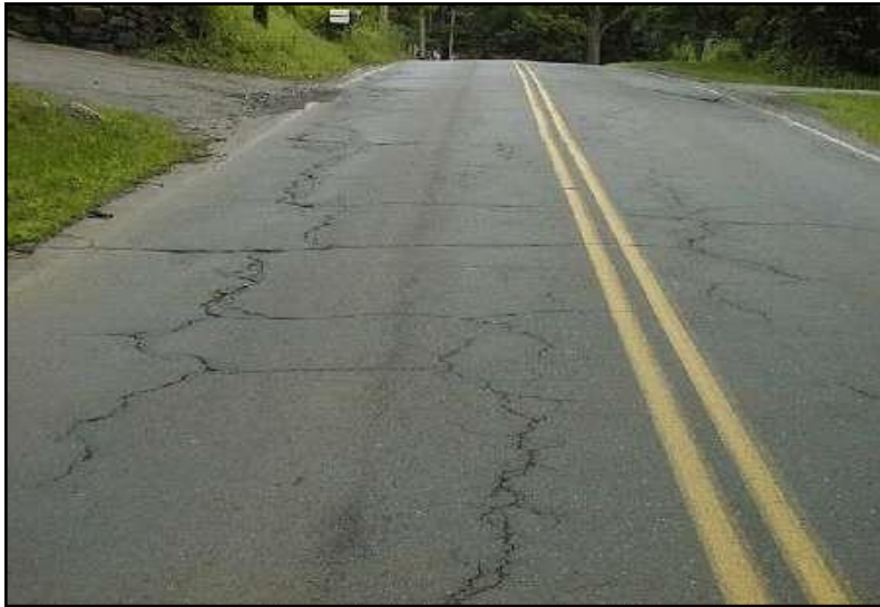
Gráfico 8. Fisuras en bloque.
