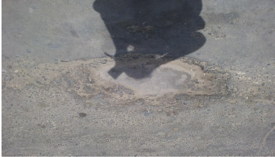
Fig.09 Deterioro de pavimento flexible por exceso de agua y humedad
