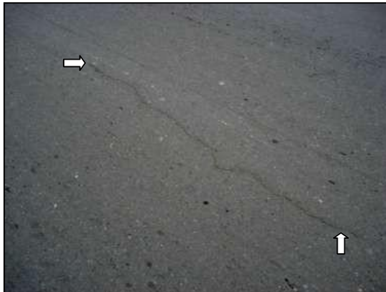
Gráfico 15. Fisuras longitudinales y transversales
