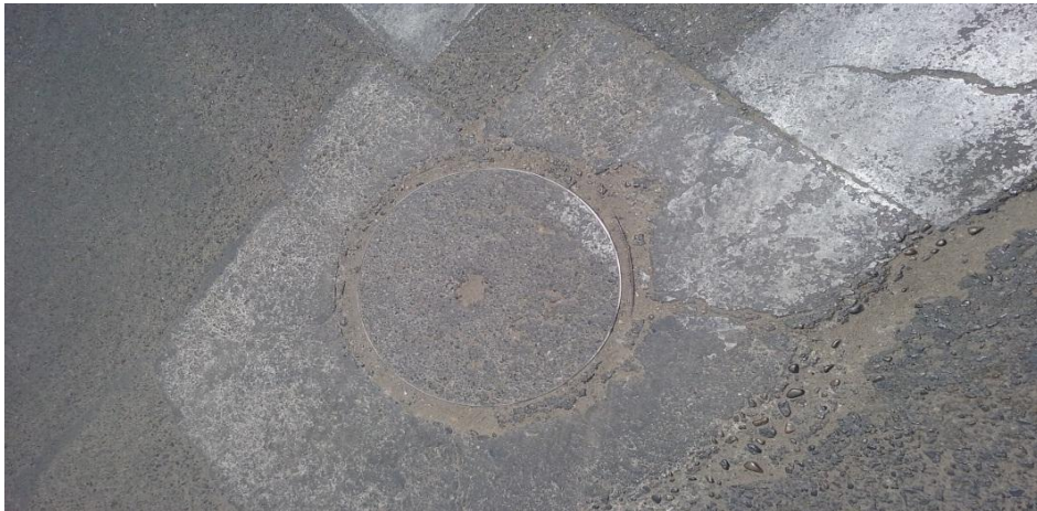
Parche y Hundimiento de buzón.
