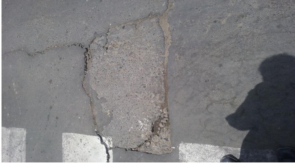
Fisura por sobre carga vehicular fisura transversal y longitudinal frente al Hotel Costa del Sol.
