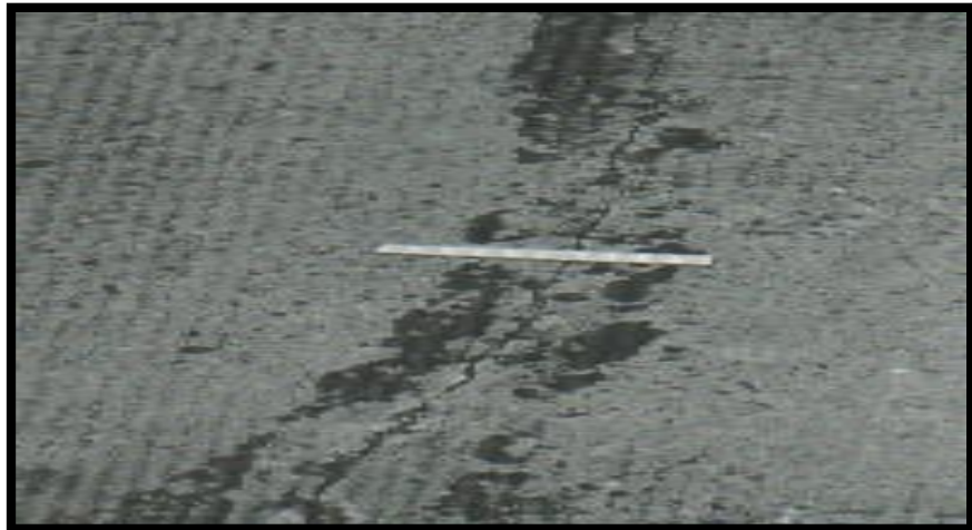
Figura 30. Grietas lineales de baja severidad.
