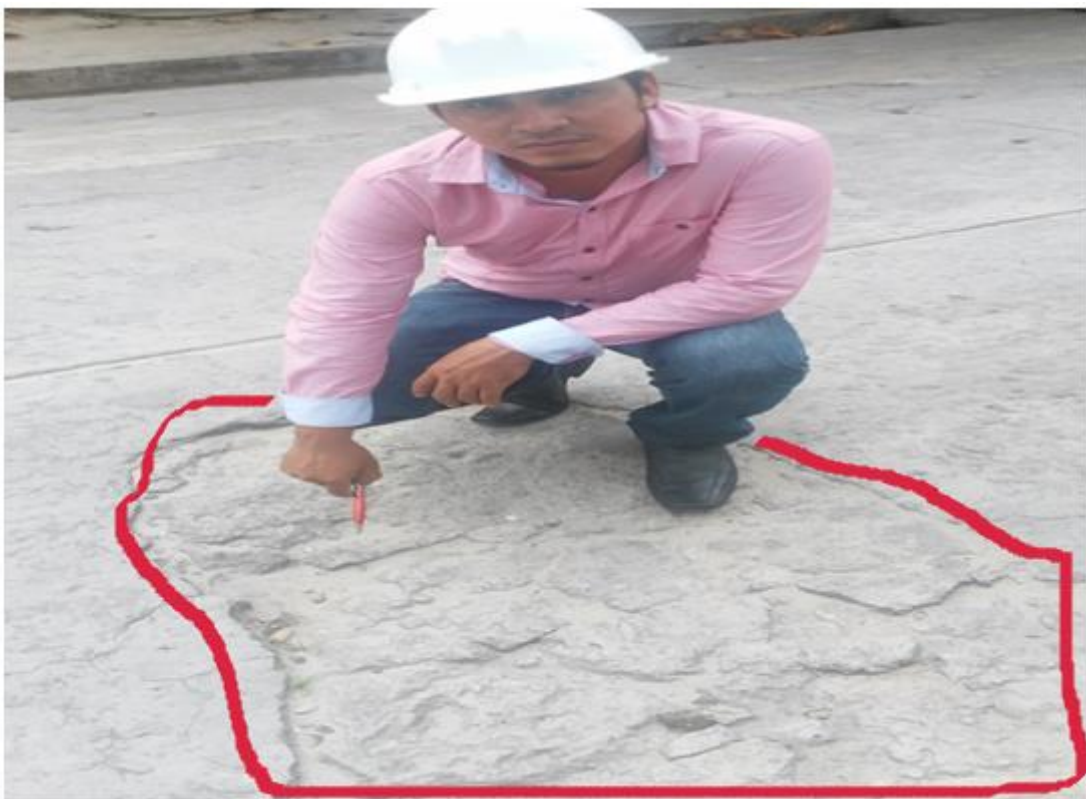
Figura 186. Calle, Piura cuadra 6, se observa Desconchamiento de severidad media.
