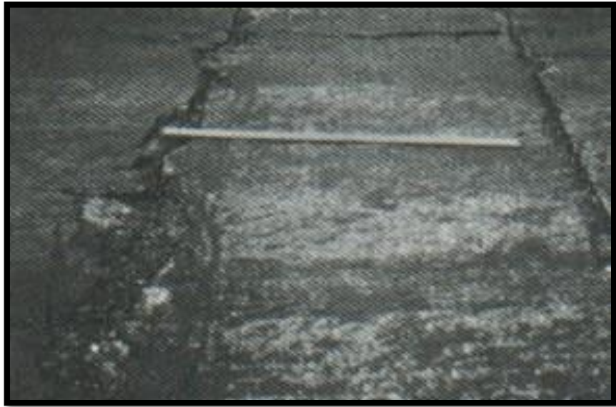
Figura 35. Parche grande y acometida de servicios públicos de alta severidad.
