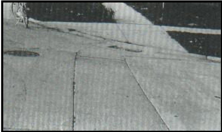
Figura 33. Parche grande y acometida de servicios públicos de baja severidad.
