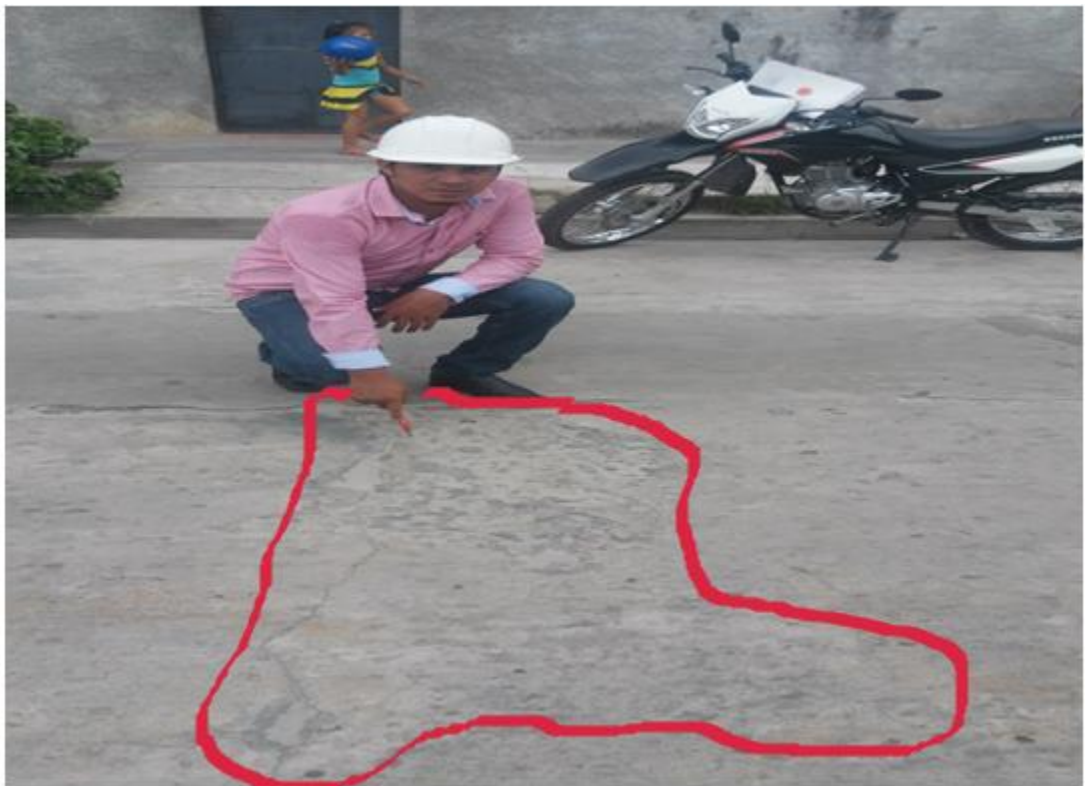
Figura 174. Calle, Piura cuadra 3, se observa Desconchamiento de baja severidad.
