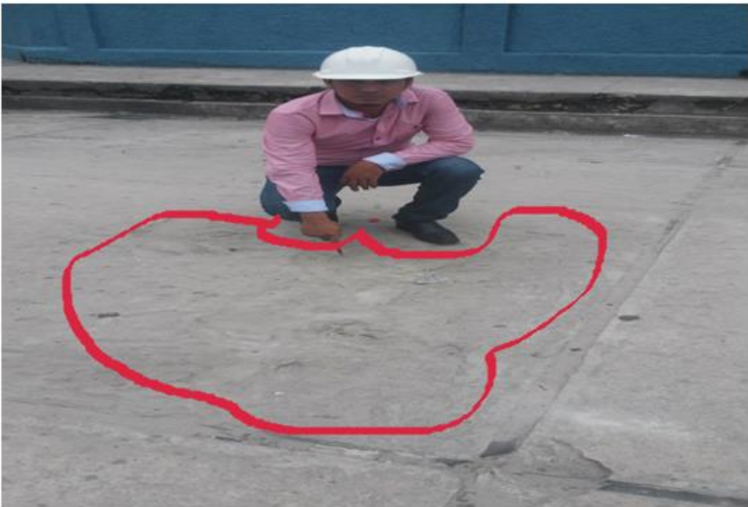
Figura 159. Calle, Piura cuadra 1, se observa Desconchamiento de severidad baja.
