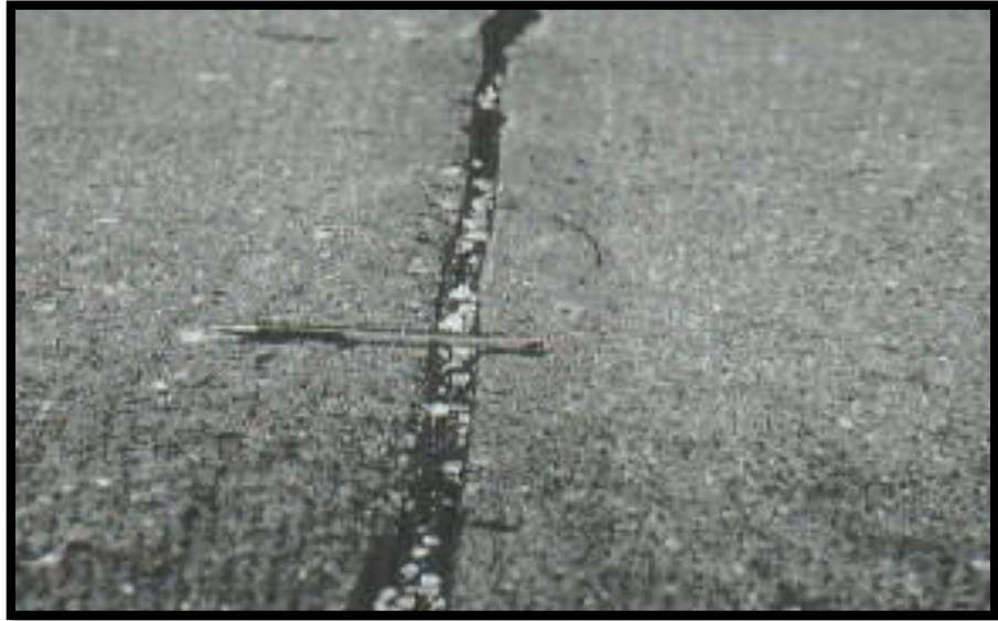
Figura 26. Daño del sello de la junta de alta severidad.
