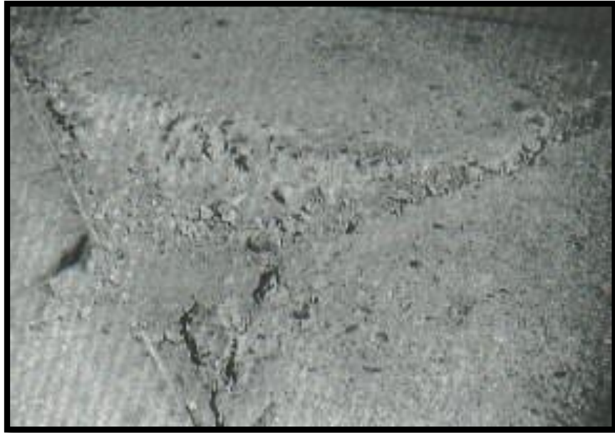
Figura 55. Descascaramiento de esquina de alta severidad.
