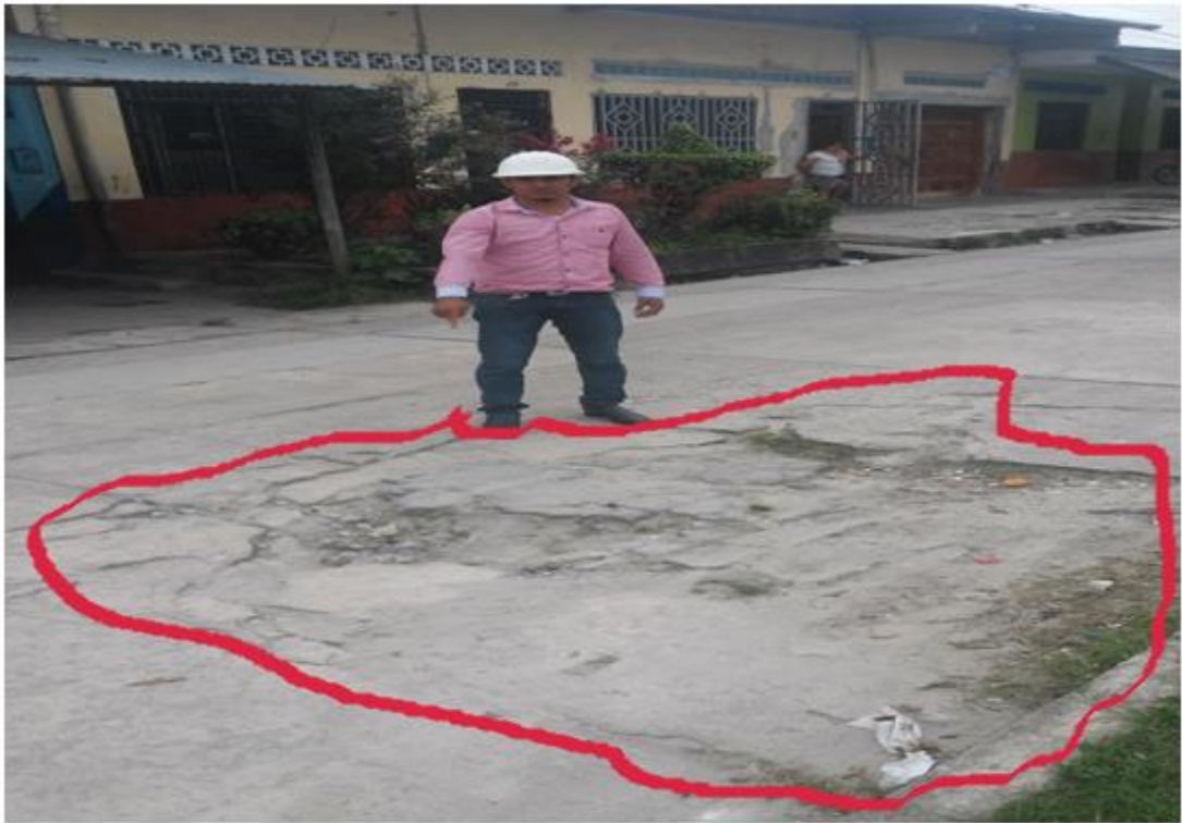
Figura 160. Calle, Piura cuadra 1, se observa Punzonamiento de alta severidad.
