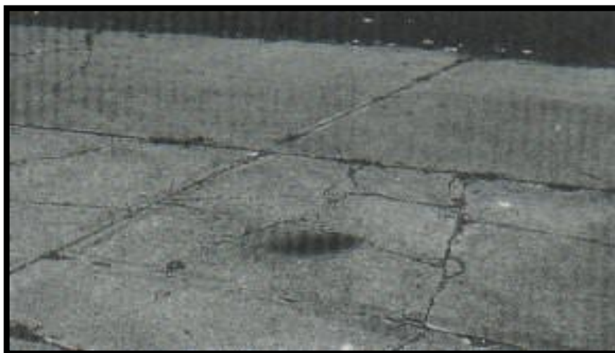
Figura 17. Losa dividida de alta severidad.
