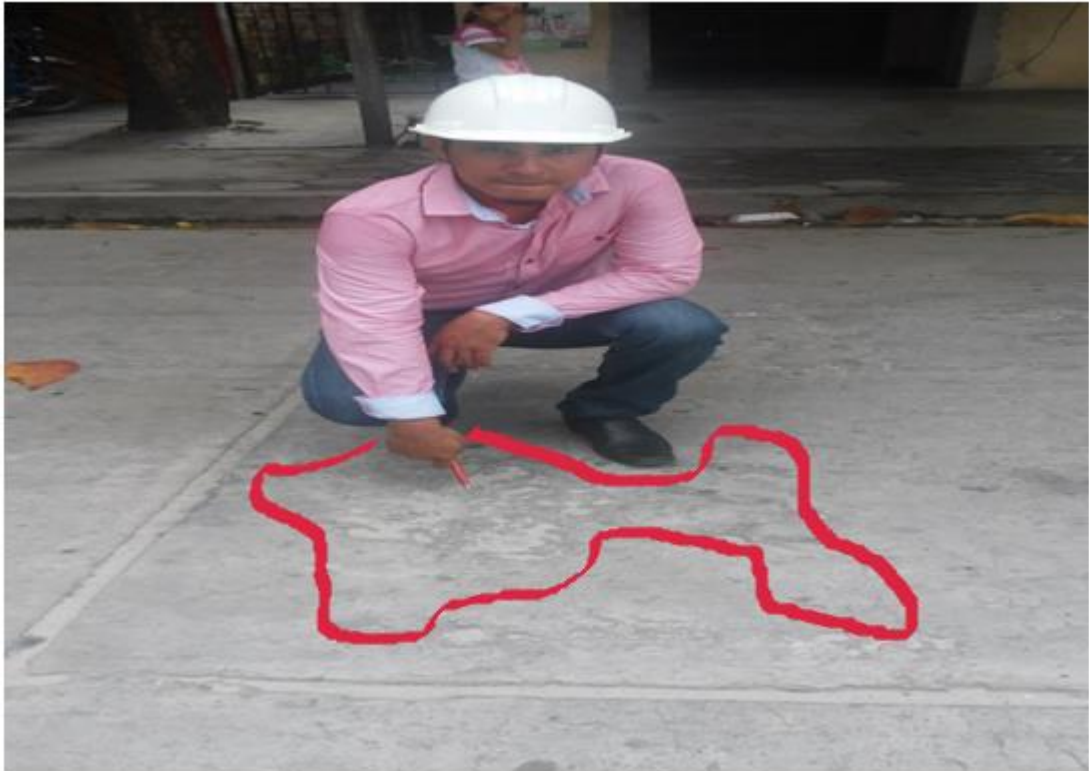
Figura 183. Calle, Piura cuadra 5, se observa Desconchamiento de baja severidad.
