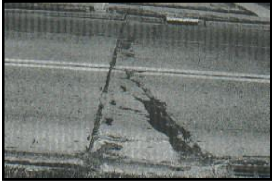
Figura 44. Punzonamiento de severidad media.
