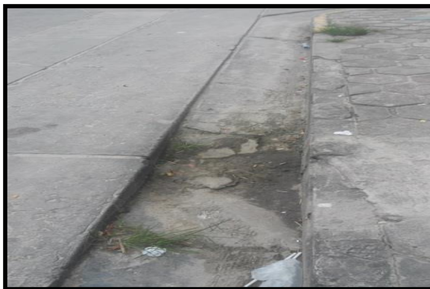
Figura 11. Blowup – Buckling de alta severidad.
