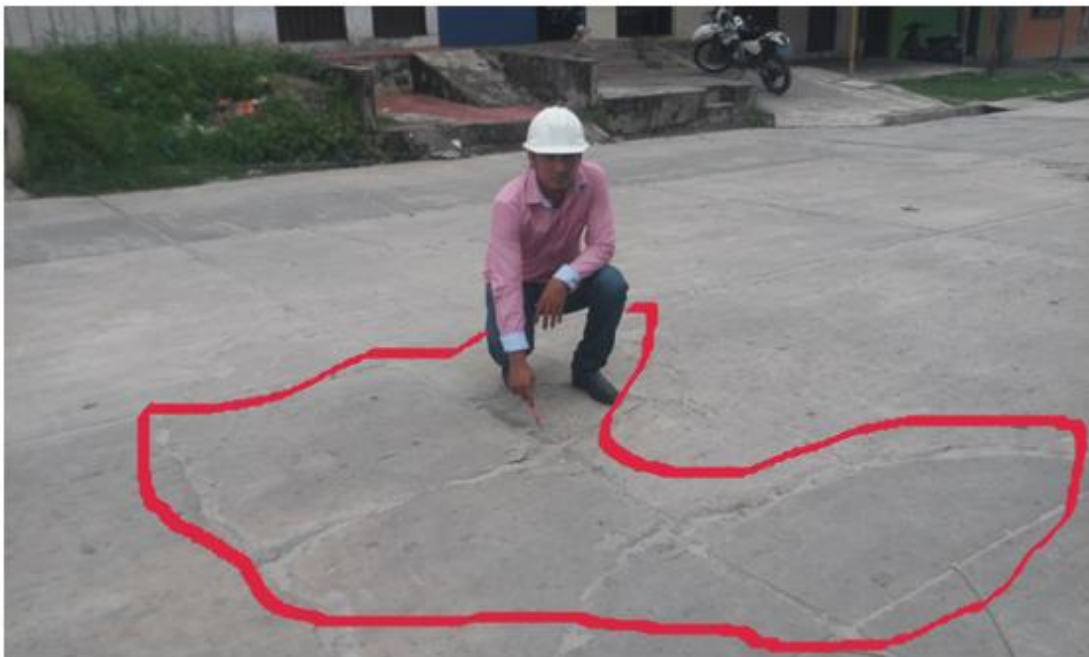
Figura 165. Calle, Piura cuadra 2, se observa Grieta de esquina de severidad media.
