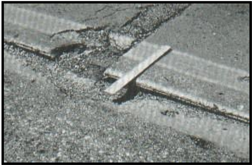
Figura 27. Desnivel carril / berma de baja severidad.
