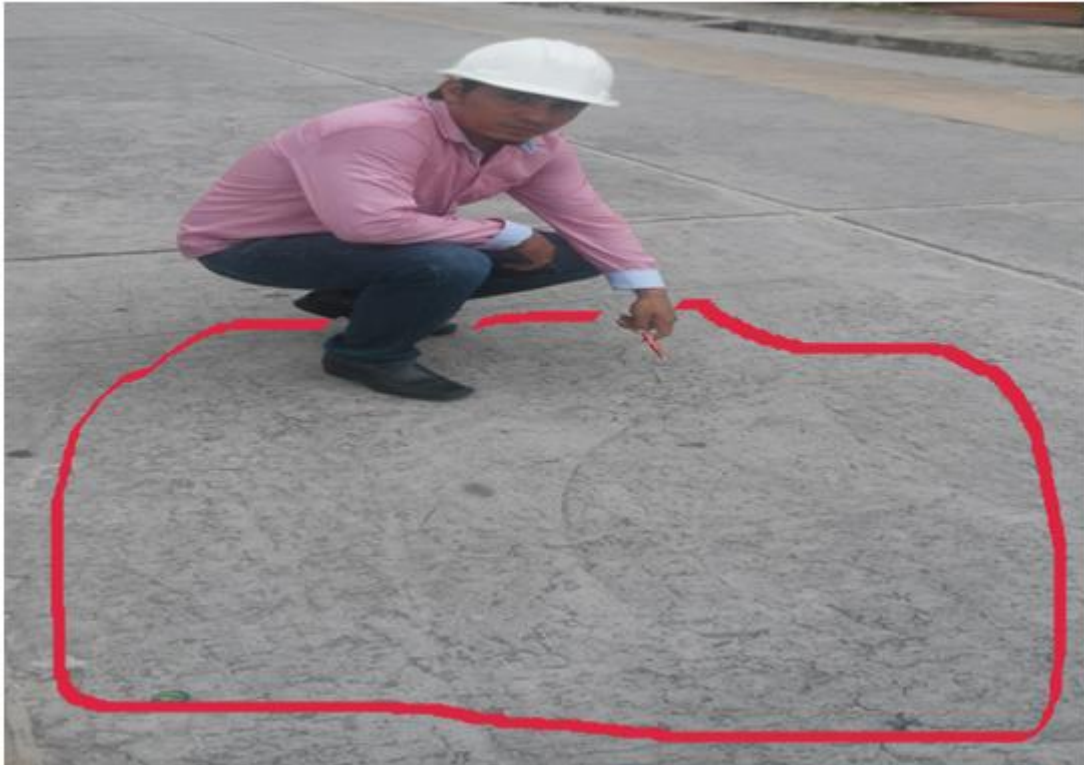
Figura 187. Calle, Piura cuadra 6, se observa Desconchamiento de baja severidad.
