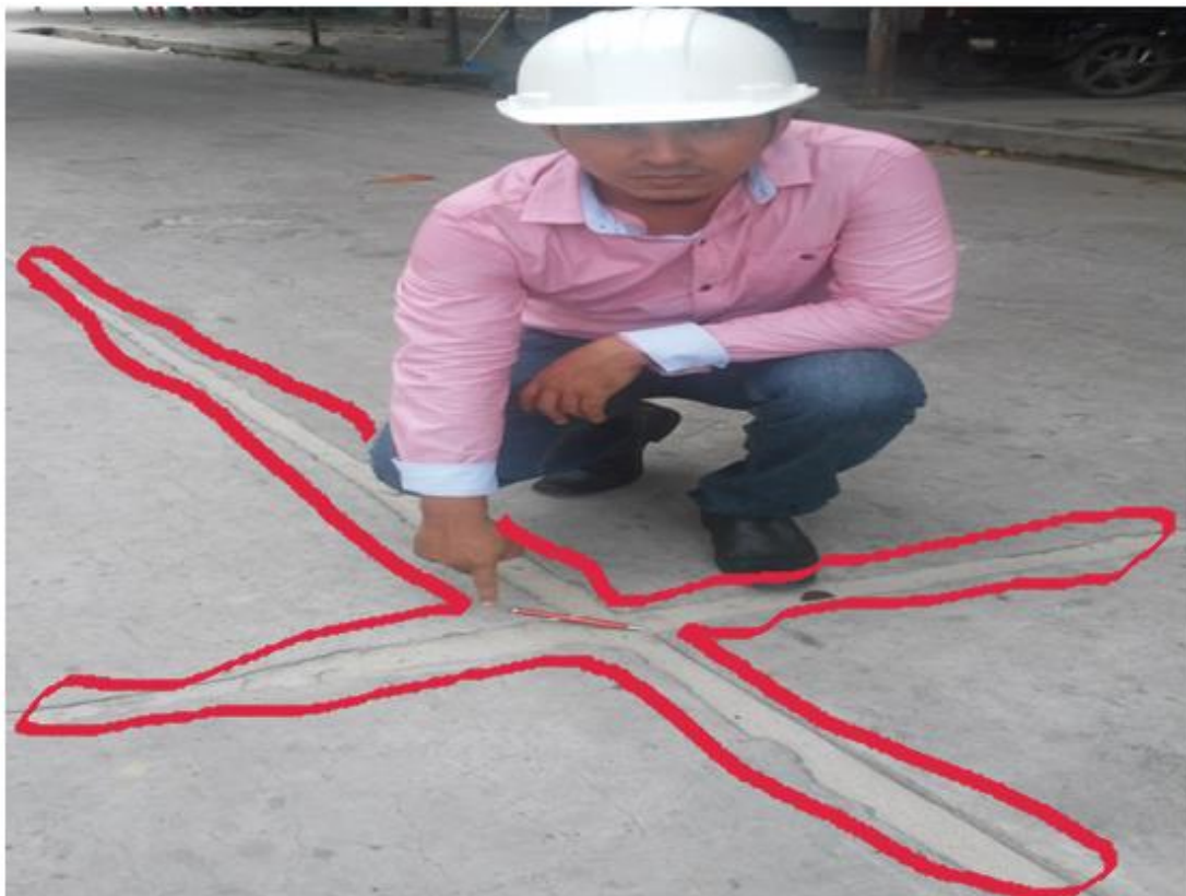
Figura 182. Calle, Piura cuadra 5, se observa Descascaramiento de junta de severidad media.
