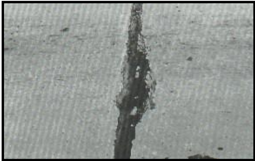
Figura 25. Daño del sello de la junta de severidad media.
