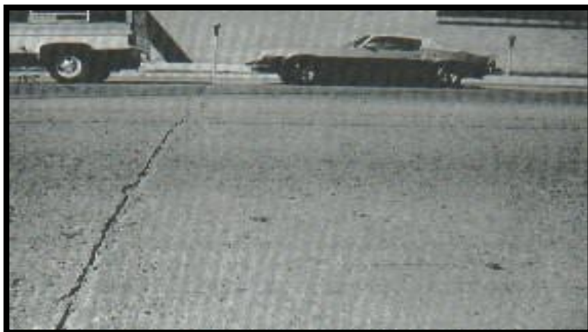
Figura 56. Descascaramiento de junta de baja severidad.
