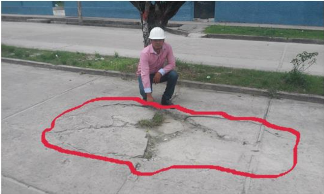
Figura 158. Calle, Piura cuadra 1, se observa Desconchamiento de severidad alta.
