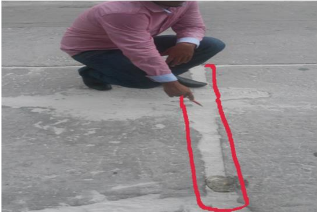
Figura 177. Calle, Piura cuadra 4, se observa Descascaramiento de junta de baja severidad.
