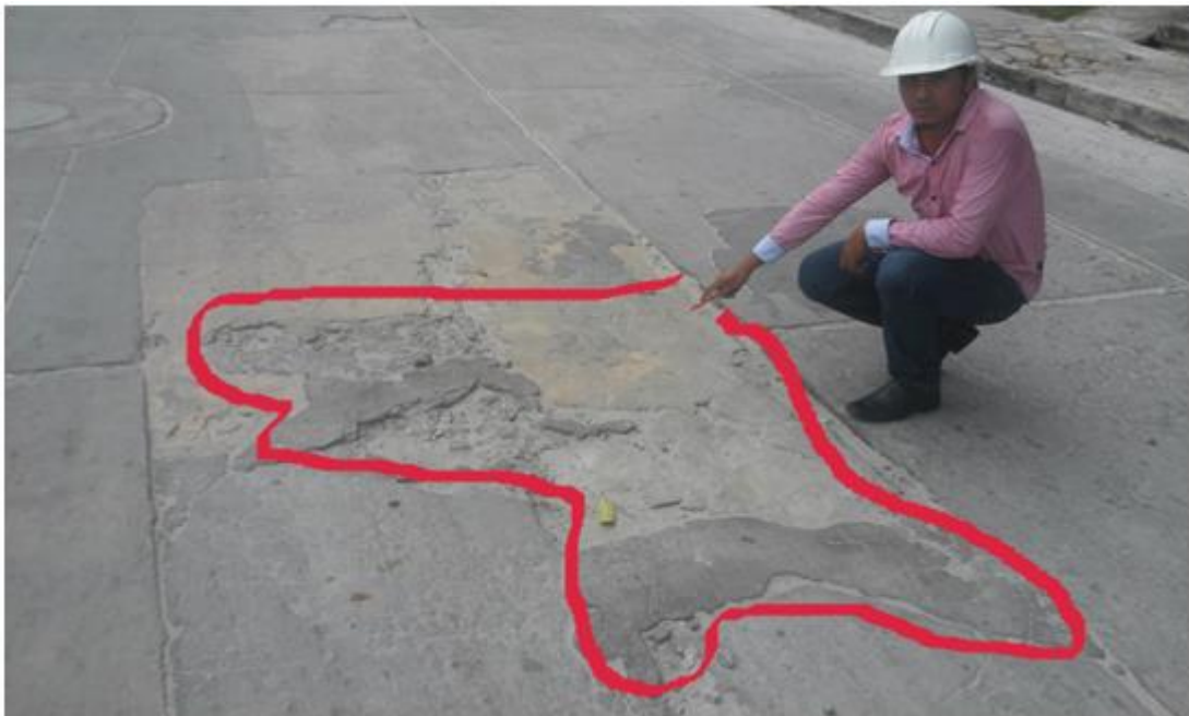
Figura 180. Calle, Piura cuadra 4, se observa Desconchamiento de baja severidad.
