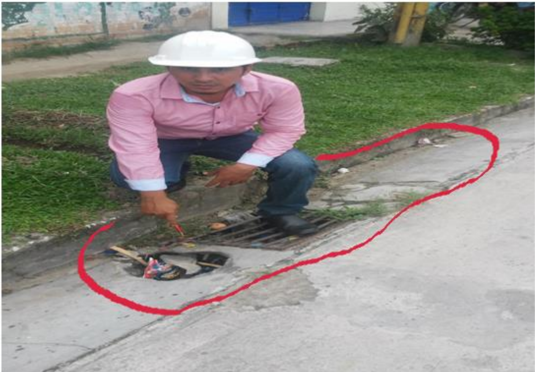
Figura 170. Calle, Piura cuadra 3, se observa BlowUp / Buckling de severidad media.
