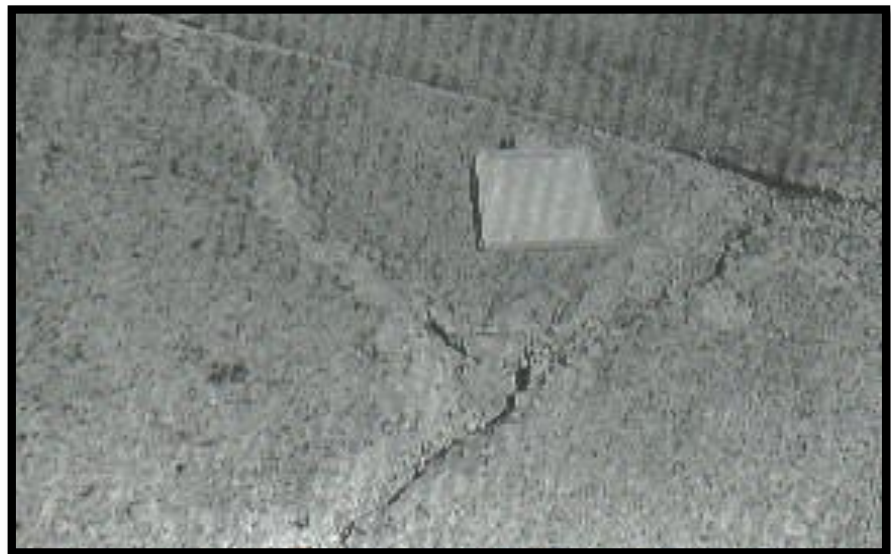
Figura 14. Grieta de esquina de alta severidad.
