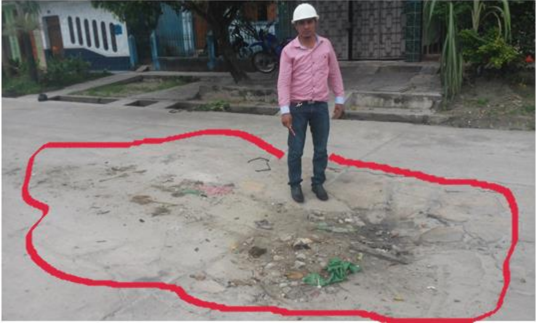
Figura 166. Calle, Piura cuadra 2, se observa Punzonamiento de alta severidad.
