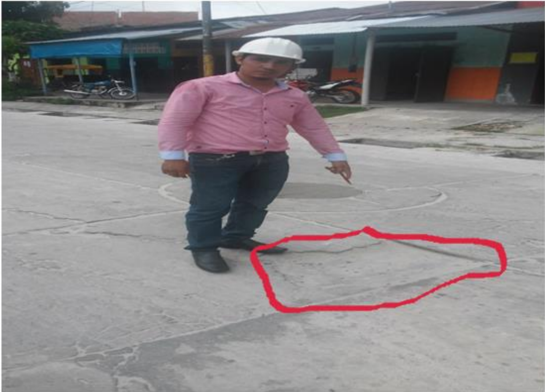
Figura 179. Calle, Piura cuadra 4, se observa Grieta de esquina de alta severidad.
