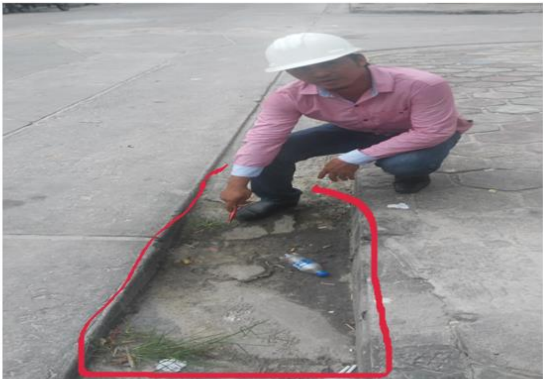
Figura 176. Calle, Piura cuadra 4, se observa BlowUp / Buckling de severidad media.
