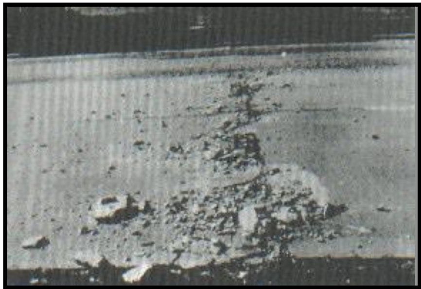
Figura 10. Blowup – Buckling de severidad media.
