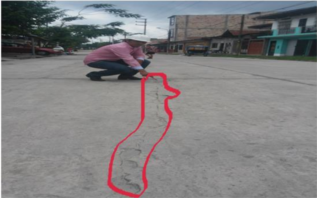
Figura 171. Calle, Piura cuadra 3, se observa Grieta lineal de severidad media.
