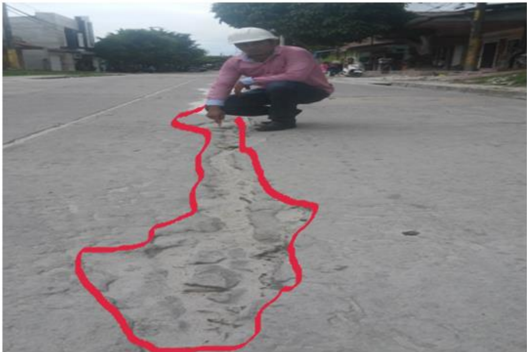
Figura 178. Calle, Piura cuadra 4, se observa Grieta lineal de alta severidad.
