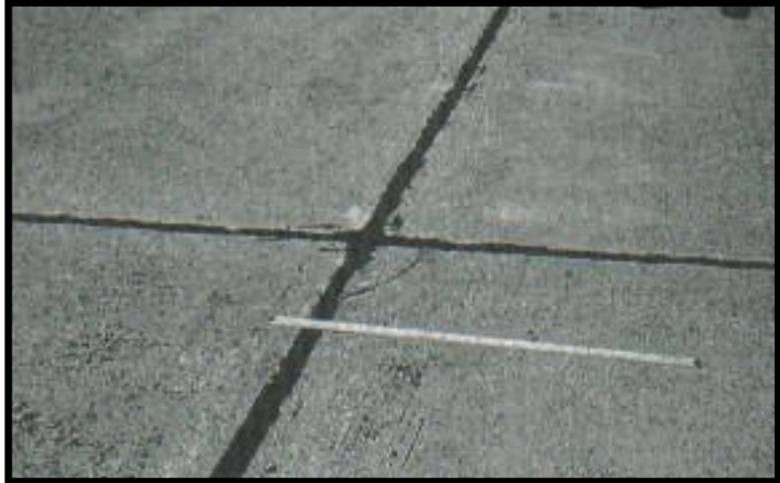
Figura 53. Descascaramiento de esquina de baja severidad.
