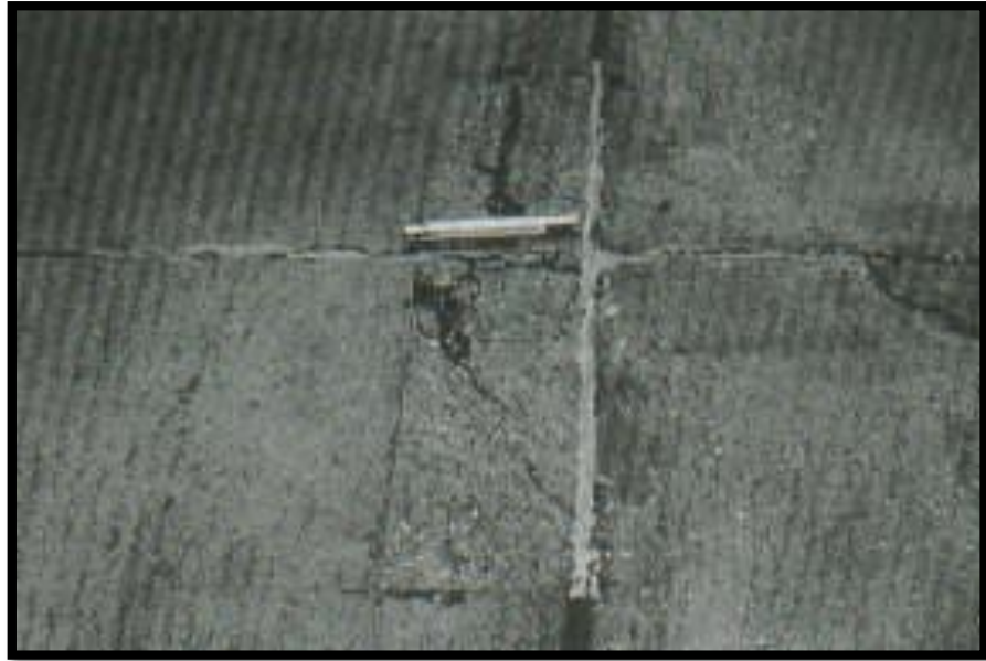
Figura 38. Parche pequeño de alta severidad.
