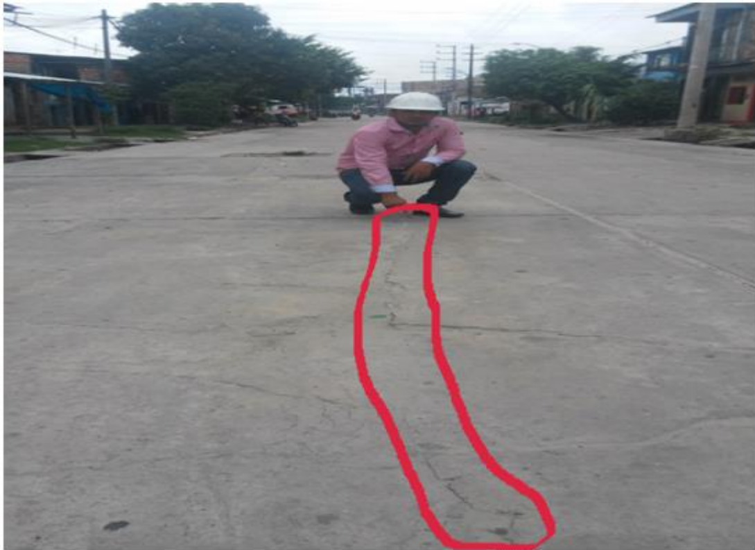
Figura 164. Calle, Piura cuadra 2, se observa Grieta lineal de severidad media.
