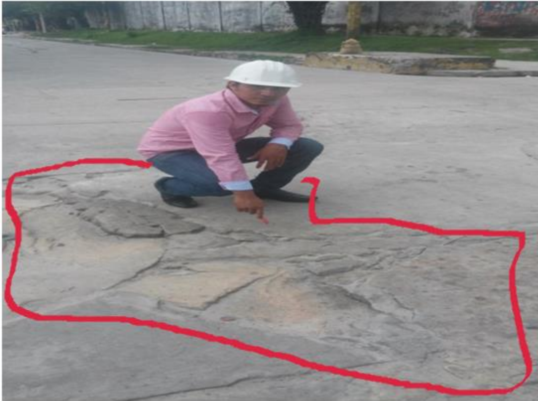
Figura 173. Calle, Piura cuadra 3, se observa Desconchamiento de severidad alta.
