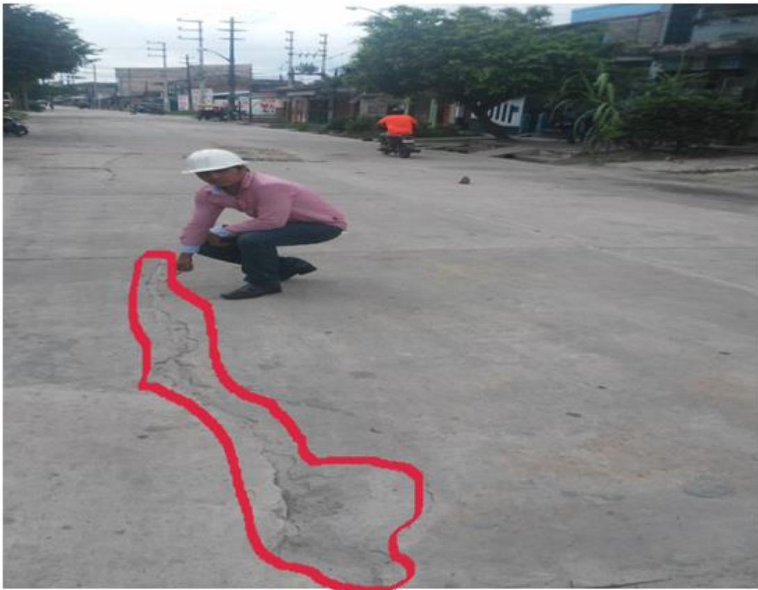
Figura 163. Calle, Piura cuadra 2, se observa Grieta lineal de severidad alta.
