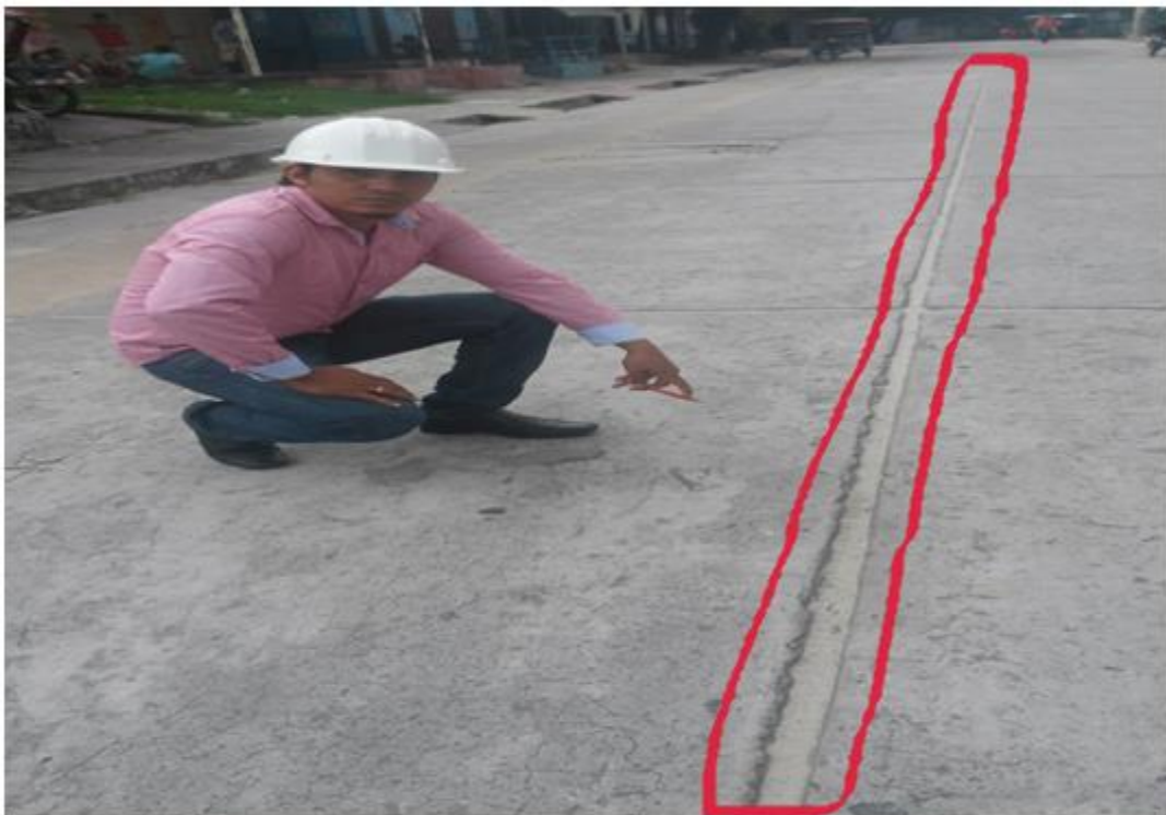
Figura 190. Calle, Piura cuadra 6, se observa Descascaramiento de junta de baja severidad
