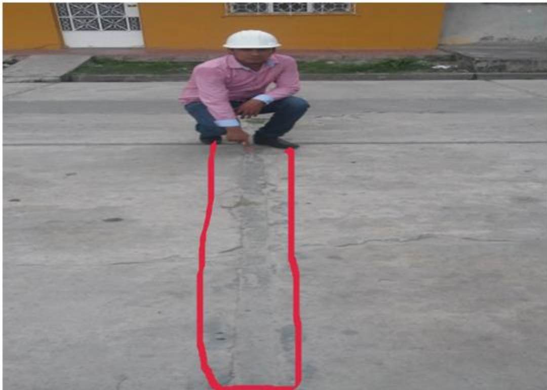
Figura 172. Calle, Piura cuadra 3, se observa Desacascamiento de junta de severidad media.
