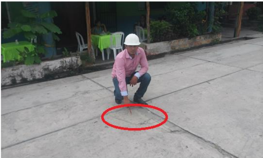
Figura 157. Calle Piura cuadra 1, se observa grieta de esquina de severidad media.
