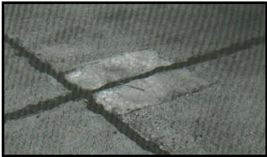
Figura 36. Parche pequeño de baja severidad.
