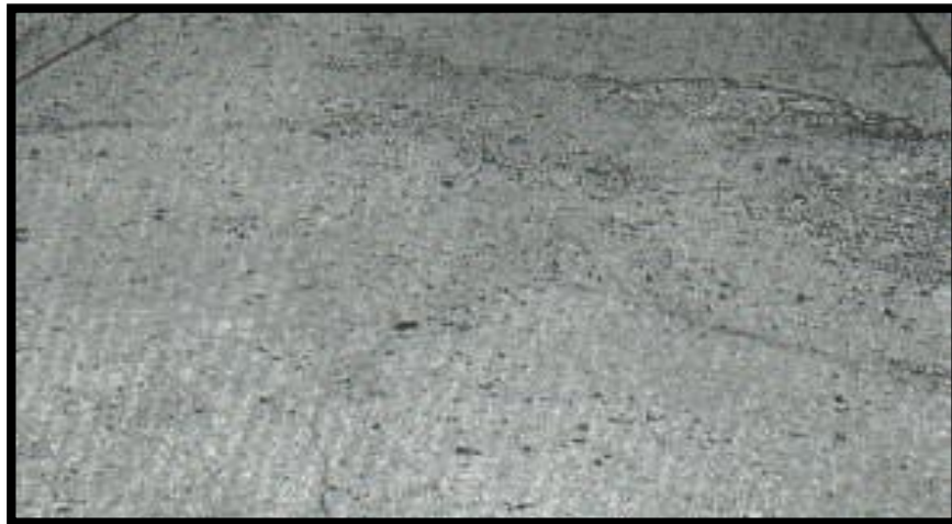
Figura 20. Grieta de durabilidad “D” de alta severidad.
