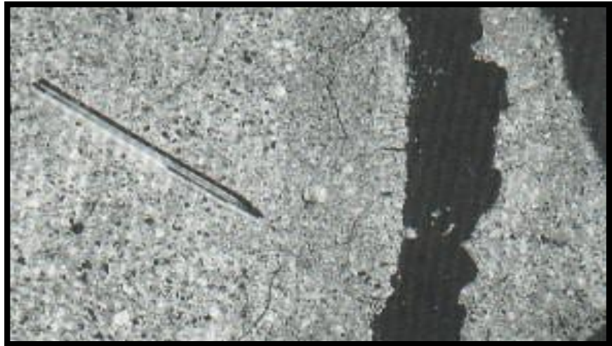
Figura 18. Grieta de durabilidad “D” de baja severidad.
