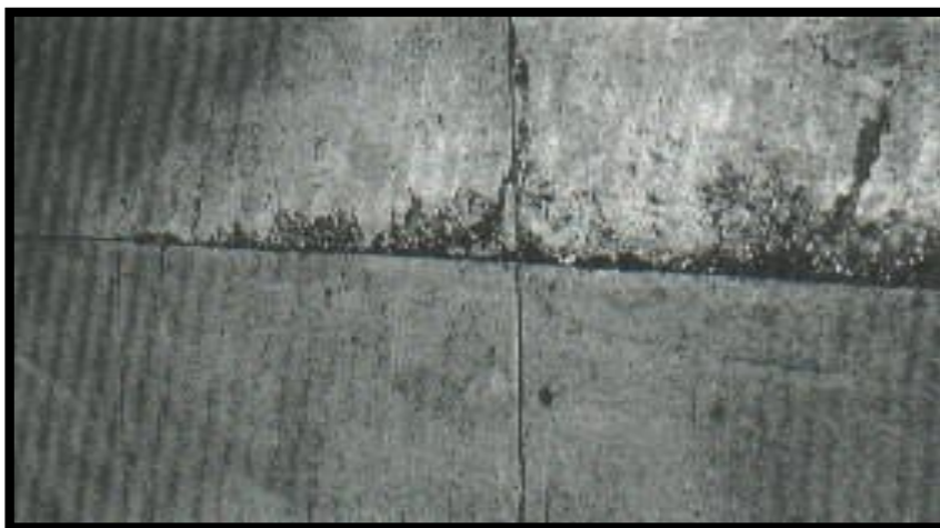
Figura 57. Descascaramiento de junta de severidad media.
