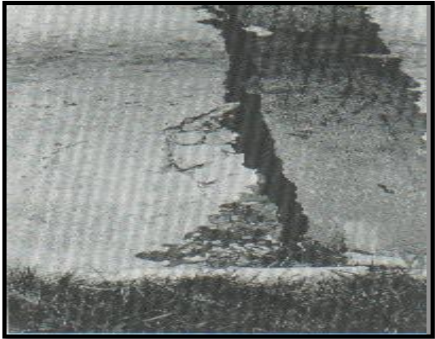
Figura 9. Blowup – Buckling de baja severidad.
