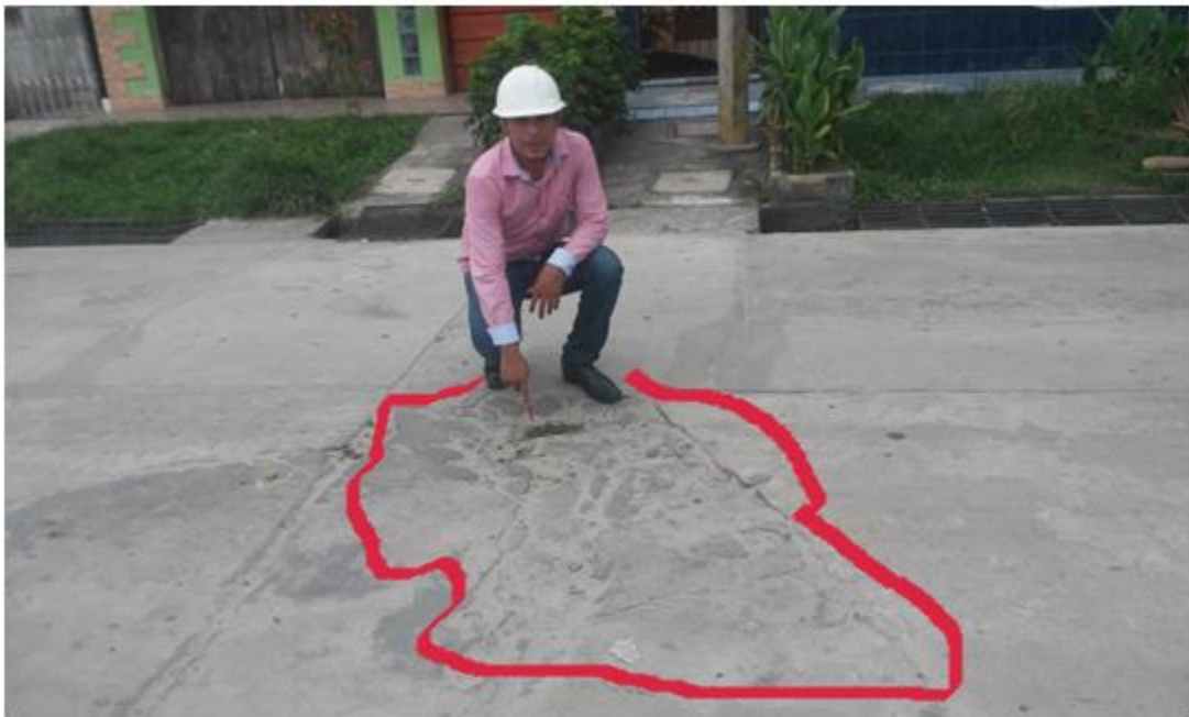
Figura 167. Calle, Piura cuadra 2, se observa Desconchamiento de severidad baja.
