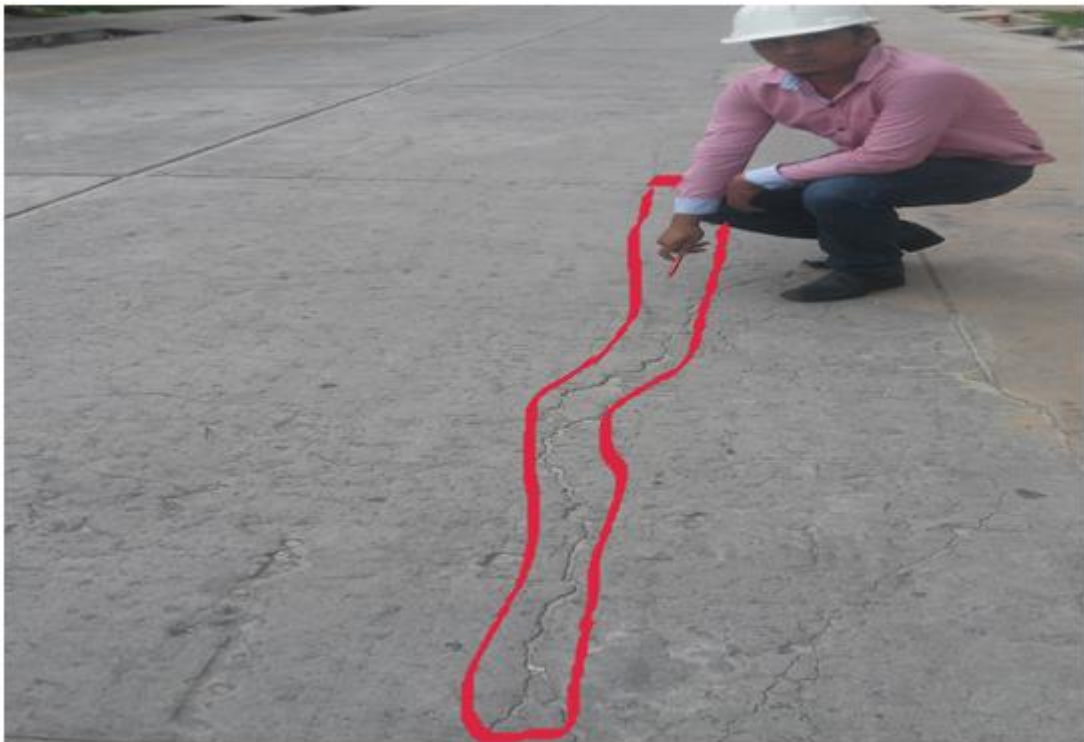
Figura 189. Calle, Piura cuadra 6, se observa Grieta lineal de baja severidad.
