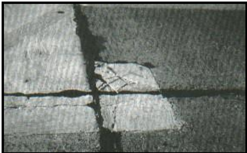
Figura 37. Parche pequeño de severidad media.
