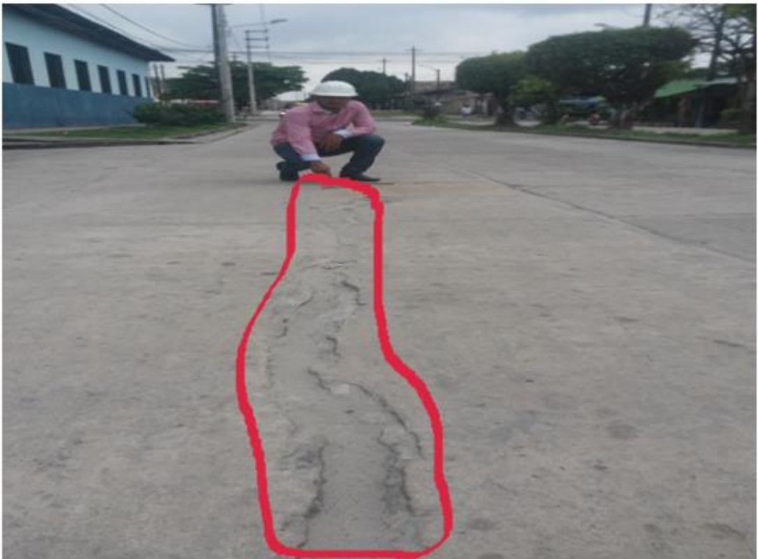
Figura 161. Calle, Piura cuadra 1, se observa Grieta lineal de alta severidad.
