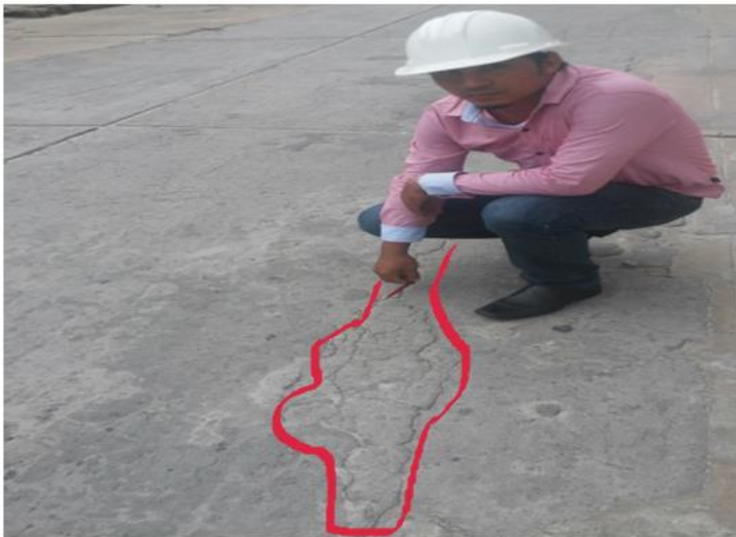
Figura 188. Calle, Piura cuadra 6, se observa Grieta lineal de severidad media.
