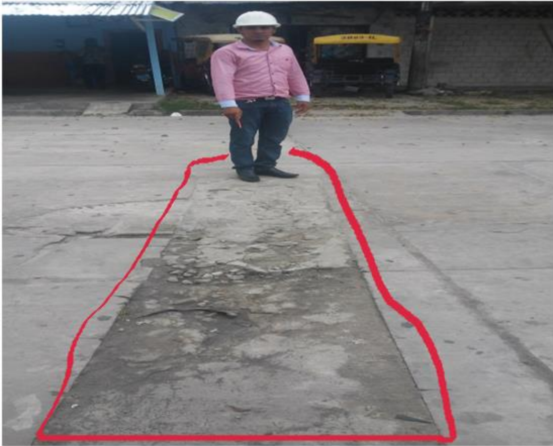
Figura 168. Calle, Piura cuadra 2, se observa Parcheo grande de severidad baja.
