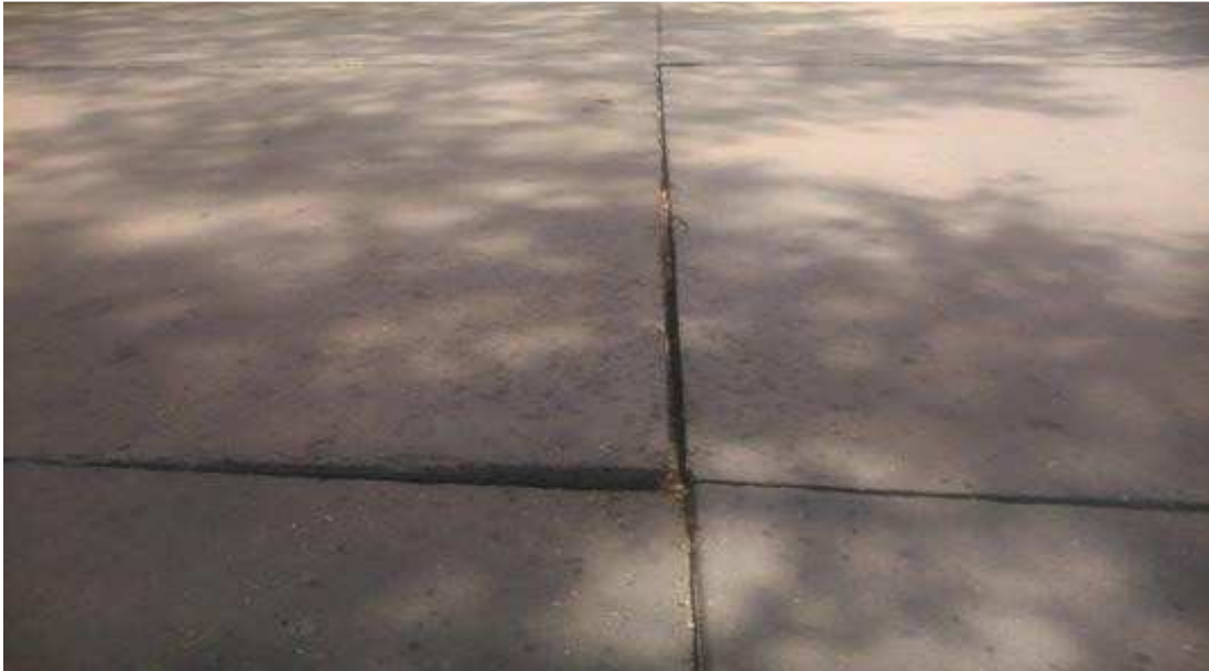
Gráfico 45: Desnivel en losa
