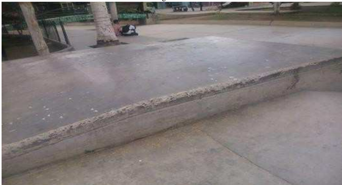
Gráfico 43: Desgaste en Borde de Losa
