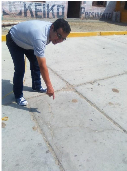
GRÁFICO N° 19: Grietas en esquina
