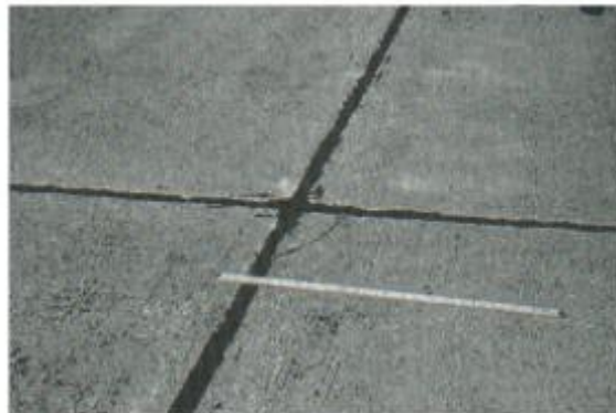
GRÁFICO N° 08: Descascamiento de esquina de baja severidad.
