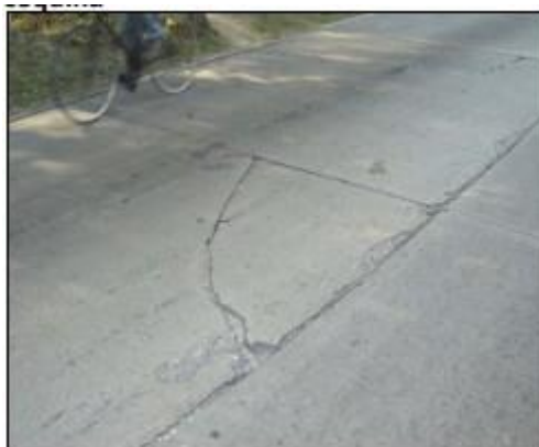
GRÁFICO N° 07: Vista típica de una grieta de esquina Fuente: “MANUAL PARA LA INSPECCIÓN VISUAL DE PAVIMENTOS RÍGIDOS”, Autor: Universidad nacional de Colombia - Instituto Nacional de Vías - INVIAS, Pág. 06.
