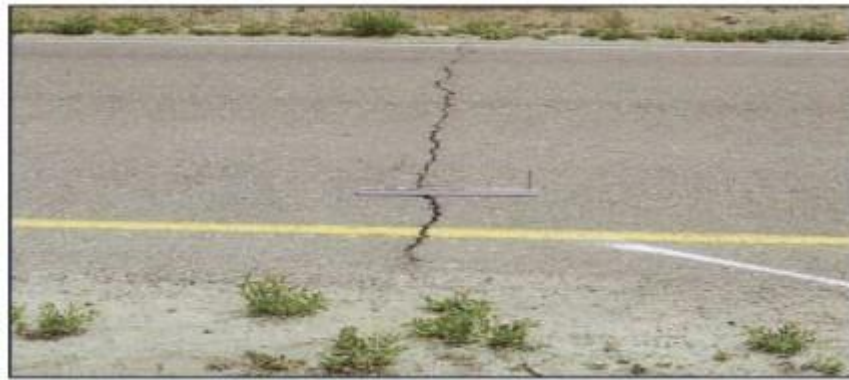
GRÁFICO N° 05: Fisura Transversal, atraviesa toda la sección de la carretera
