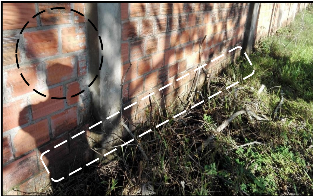
Figura 79: Presencia de eflorescencia en muros y humedad en viga.
