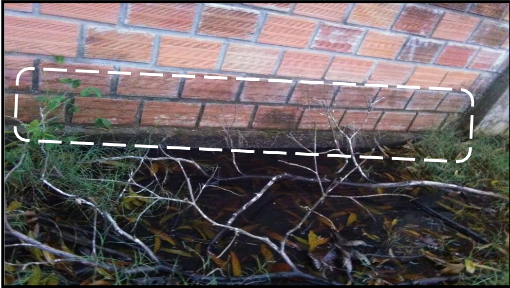
Figura 88: Se aprecia una filtración o humedad de severidad severa.
