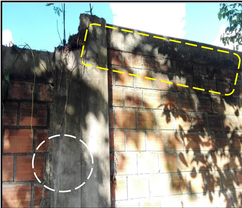
Figura 97: Presencia de fisuras longitudinales y eflorescencia.
