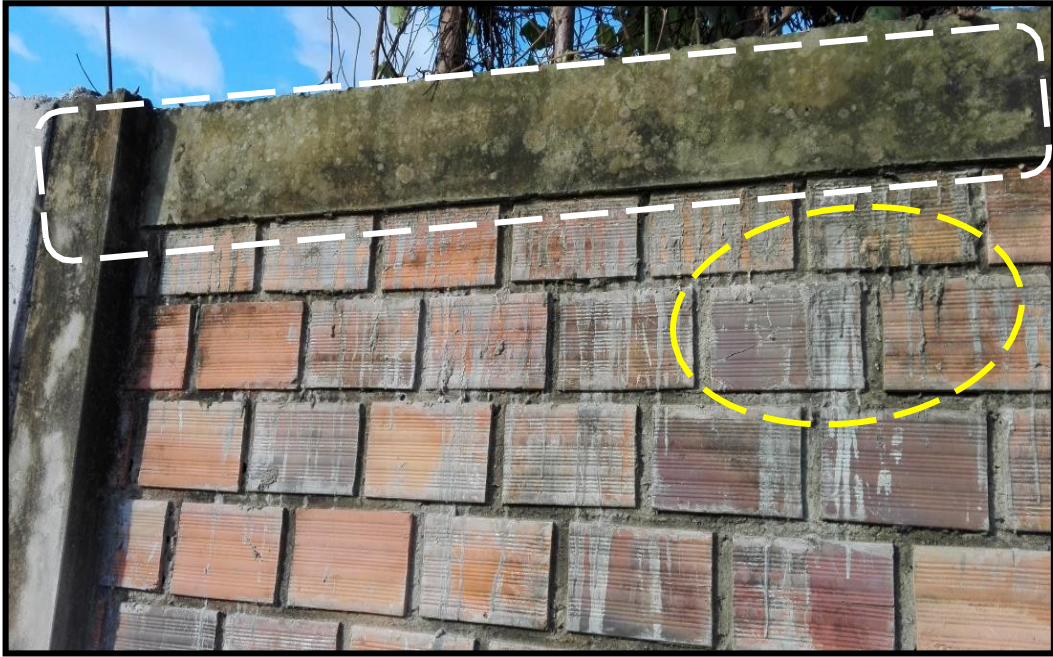
Figura 102: Eflorescencia y cráteres en muro y viga de amarre.
