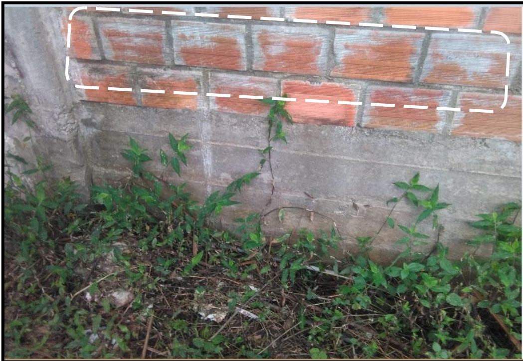
Figura 93: Apreciación de eflorescencia de severidad moderada.
