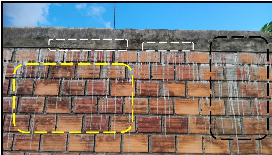
Figura 73: Presencia de fisuras diagonales en vigas y eflorescencia en muro.
