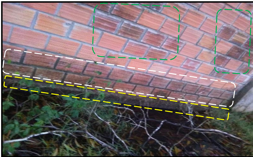
Figura 71: Se aprecia la eflorescencia y la humedad en muro y viga.
