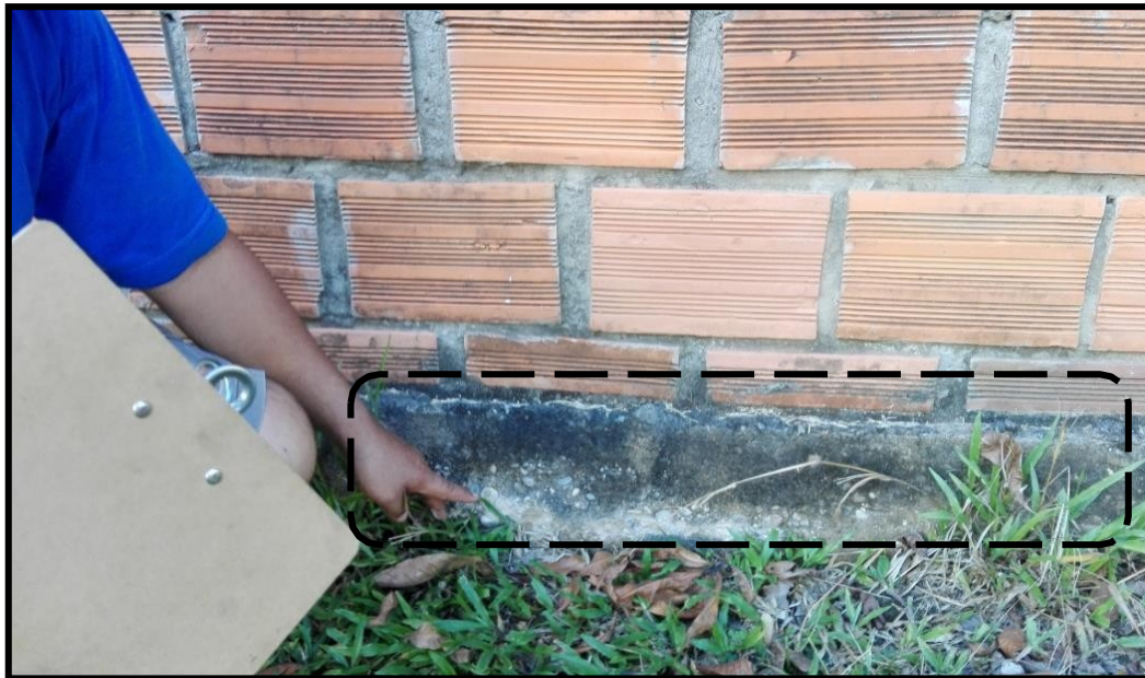
Figura 81: Identificando una desintegración de la viga.
