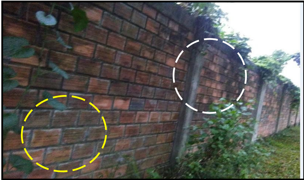
Figura 84: Presencia de eflorescencia en toda la estructura confinada.
