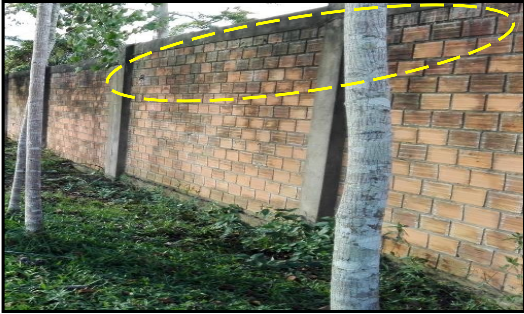
Figura 80: Se observa la presencia de eflorescencia de severidad moderada.
