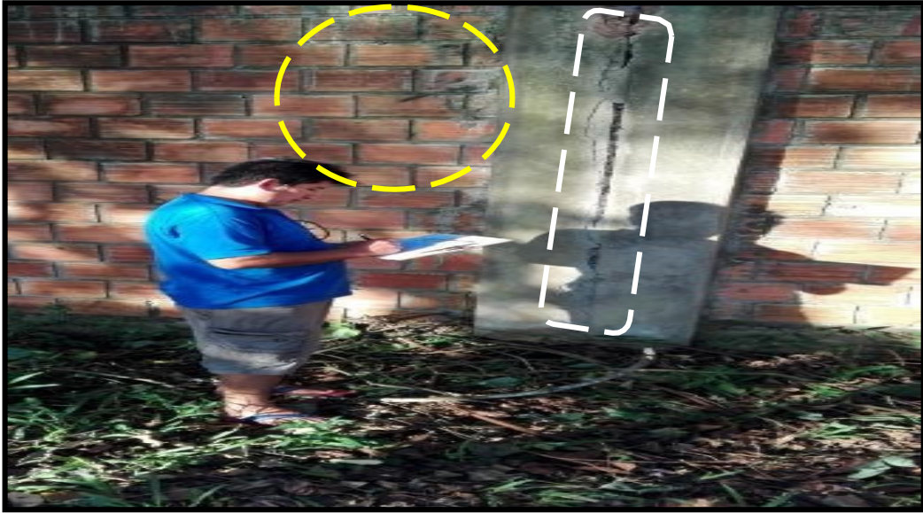
Figura 98: Se observa un agrietamiento vertical en la columna y eflorescencia.
