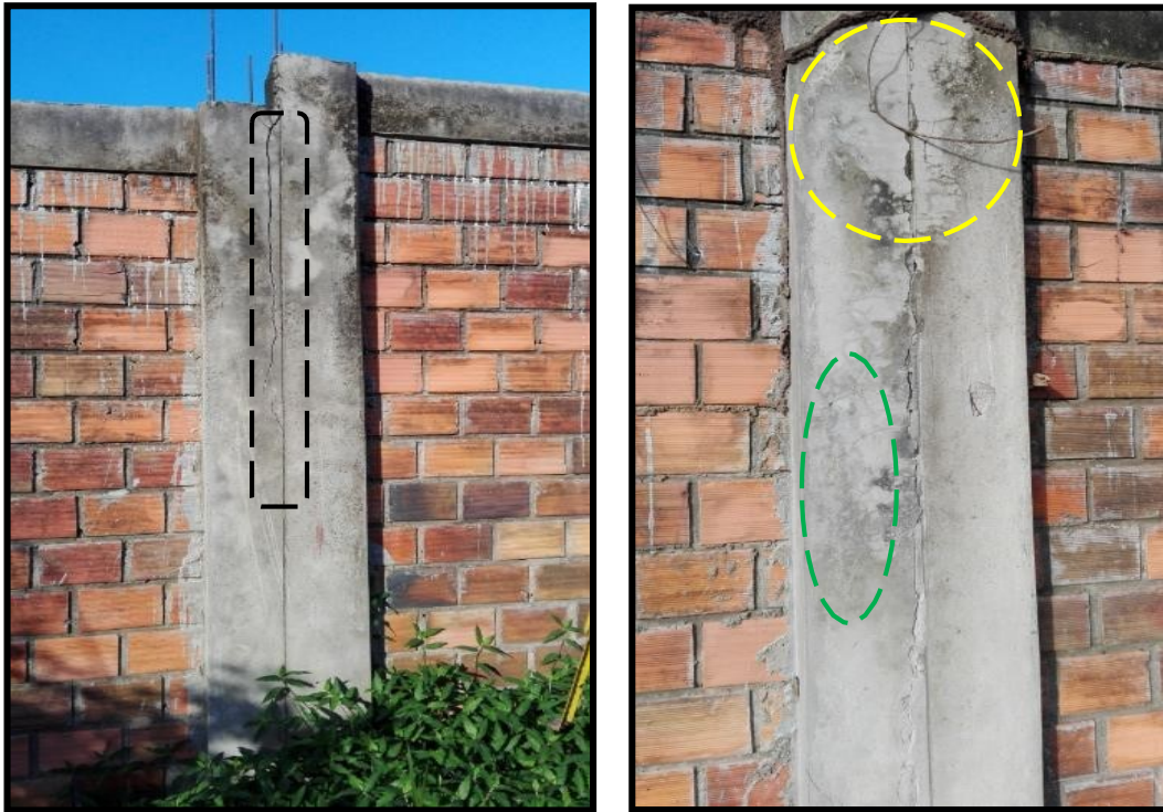
Figura 72: Se observa un agrietamiento vertical y fisuras diagonales en columnas.
