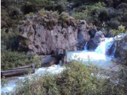
Captación del canal Uta
