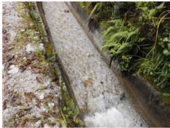
Canal con patología de hundimiento
