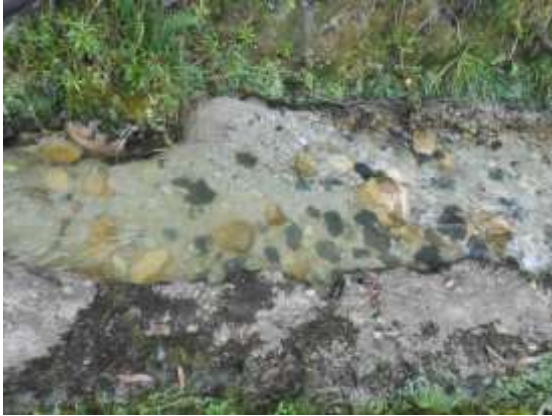
Patología encontrada hundimiento
