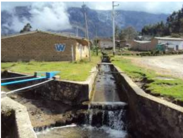
Mostrando una patología severa (Hundimiento)
