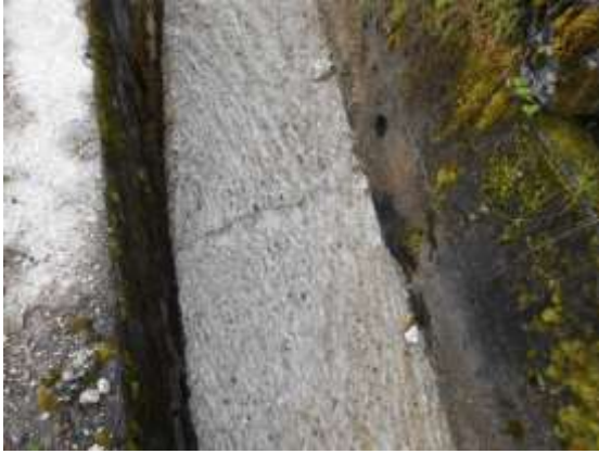
Patología encontrada grieta
