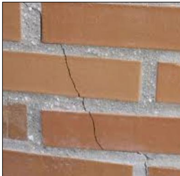
Figura 21. Fisura en revestimiento del muro Nota. Fuente: (Monjo J. 1997) 20
