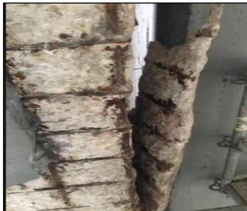
Figura 24. Corrosión Nota. Fuente: (Casas O. 2001) 22
