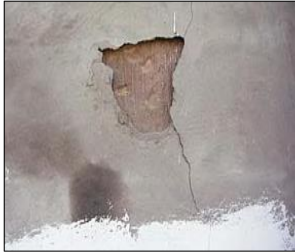
Figura 23. Desprendimiento del mortero Nota. Fuente: (Rodríguez E. 2006) 21
