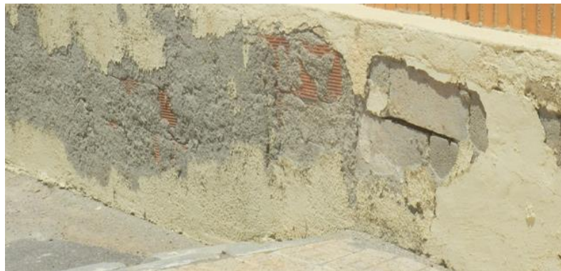
Figura 20. Erosión en muro de albañilería Nota. Fuente: (Monjo J. 1997) 19
