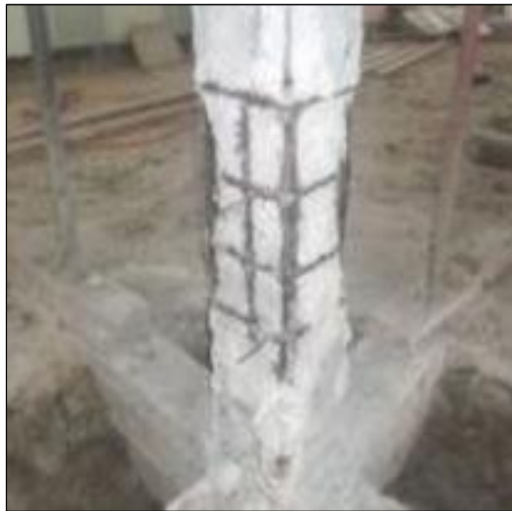
Figura 19. Corrosión en columna Nota. Fuente: (Zurita W. 2015) 17
