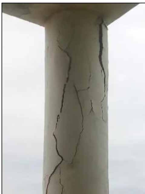
Figura 22. Grieta en columna de mortero Nota. Fuente: (Rodríguez E. 2006) 21
