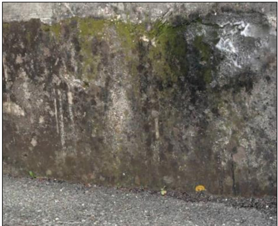
Figura 21. Moho en columna
