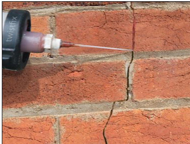
Figura 17. Fisura en muro de albañilería Nota. Fuente: (Enciclopedia Broto. 2012) 26
