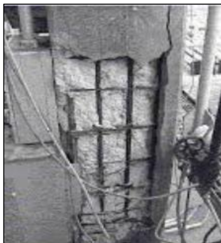
Figura 18. Corrosión en Columna Nota. Fuente: (Enciclopedia Broto. 2012) 26
