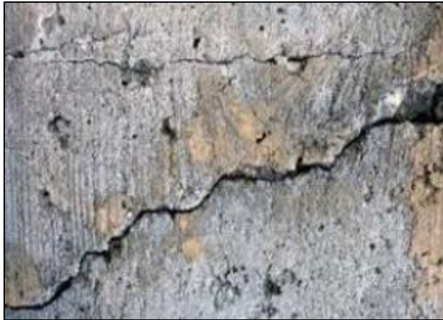
Figura 16. Grieta en concreto. Nota. Fuente: (Aguilar T. 2012) 25
