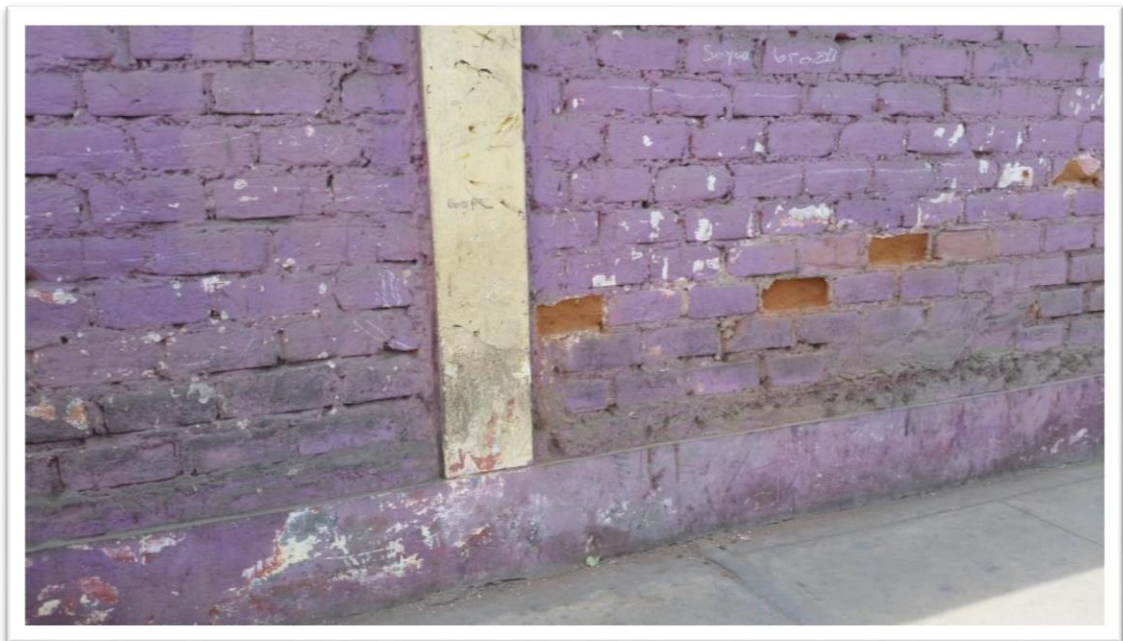
Fotografía 06: Se aprecia picadura en los ladrillos del cerco perimétrico de la institución educativa 2070 Nuestra Señora Del Carmen, en la unidad de muestra 08.
