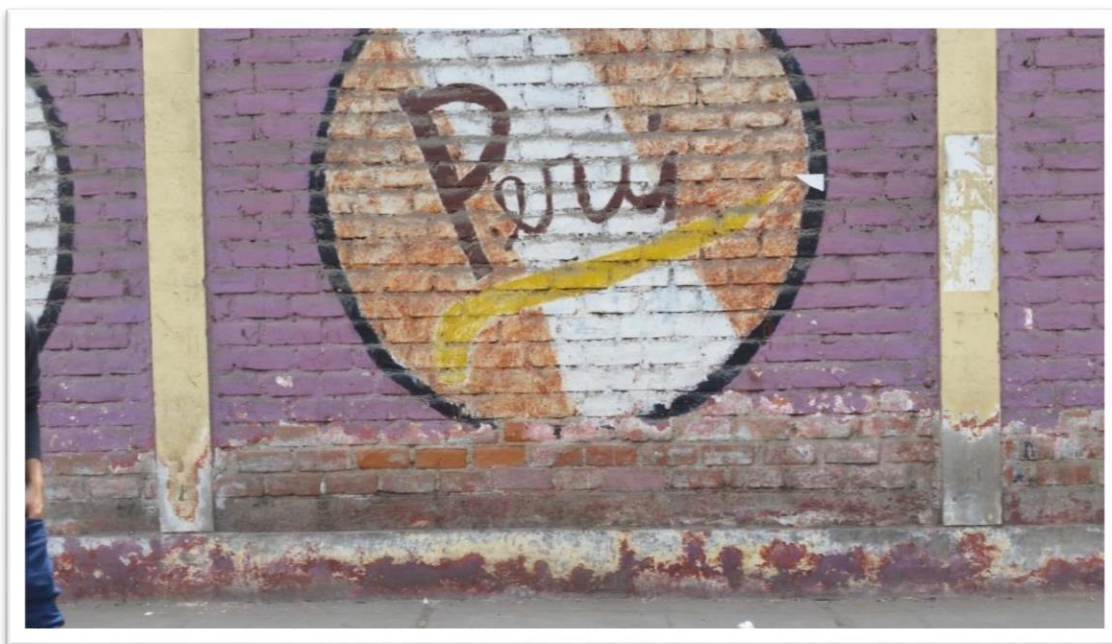
Fotografía 03: Se aprecia la erosión en el cerco perimétrico de la institución educativa 2070 Nuestra Señora Del Carmen, en la unidad de muestra 03.
