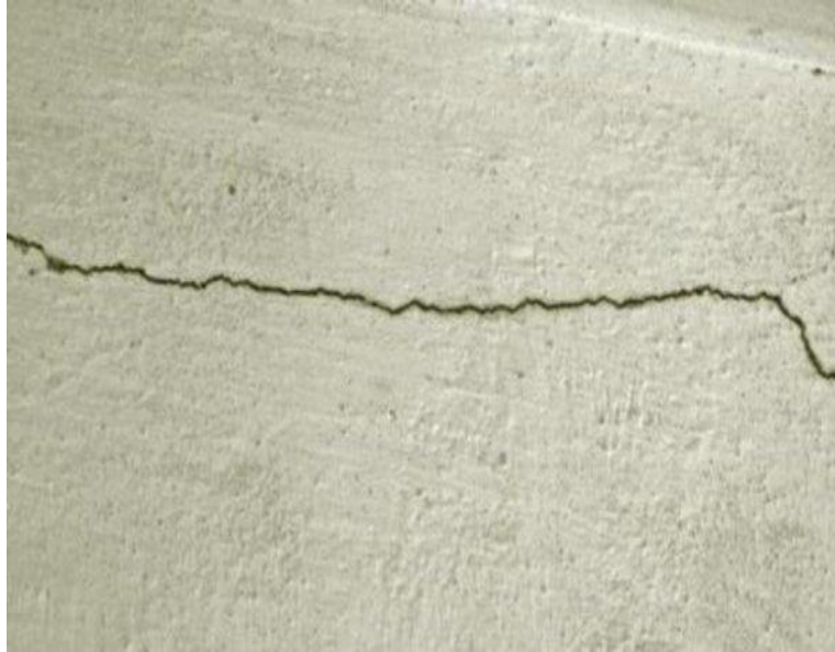
Imagen 06. Fisuras en columna
