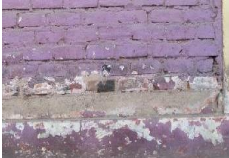
Figura 09: Eflorescencia en muro y sobrecimiento.
