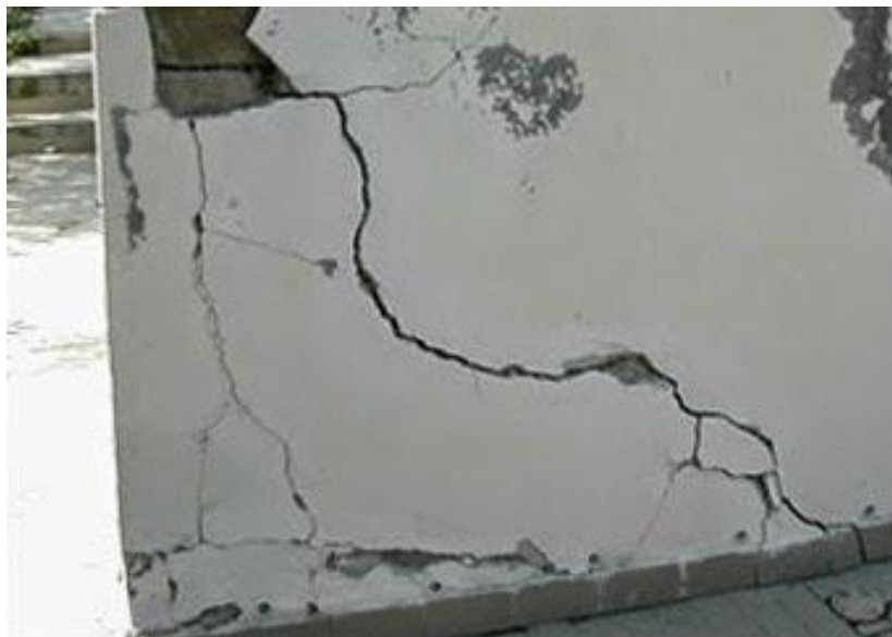
Figura 5. Grieta en muros
