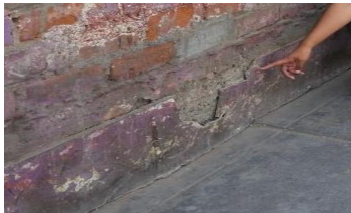
Figura 10: Desprendimiento en sobrecimiento.
