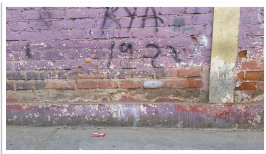
Fotografía 07: Se aprecia erosión en el cerco perimétrico de la institución educativa 2070 Nuestra Señora Del Carmen, en la unidad de muestra 13.
