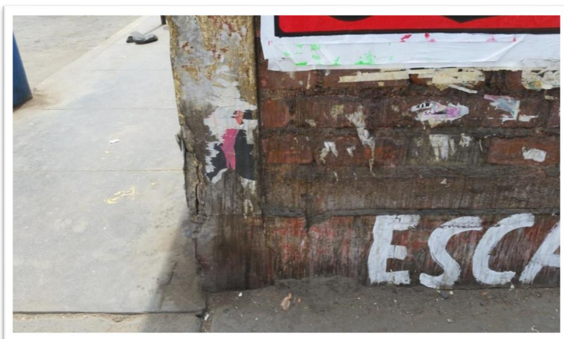
Fotografía 04: Se aprecia desprendimiento en el cerco perimétrico de la institución educativa 2070 Nuestra Señora Del Carmen, en la unidad de muestra 10.
