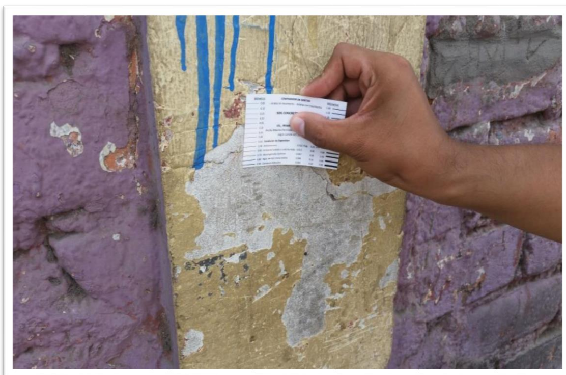
Fotografía 08: Se aprecia fisura en columna del cerco perimétrico de la institución educativa 2070 Nuestra Señora Del Carmen, en la unidad de muestra 14.
