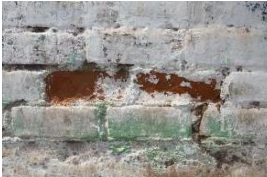
Figura 07: Disgregación en muro.
