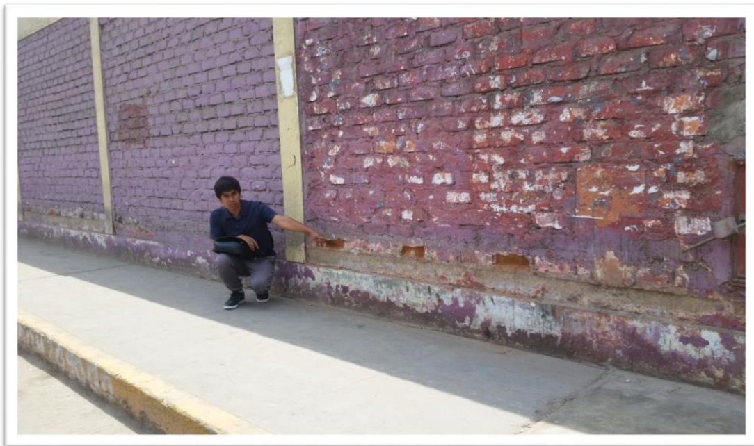
Fotografía 02: Se aprecia la eflorescencia en el cerco perimétrico de la institución educativa 2070 Nuestra Señora Del Carmen, en la unidad de muestra 01.
