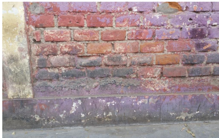
Imagen 08: Erosión en muro.
