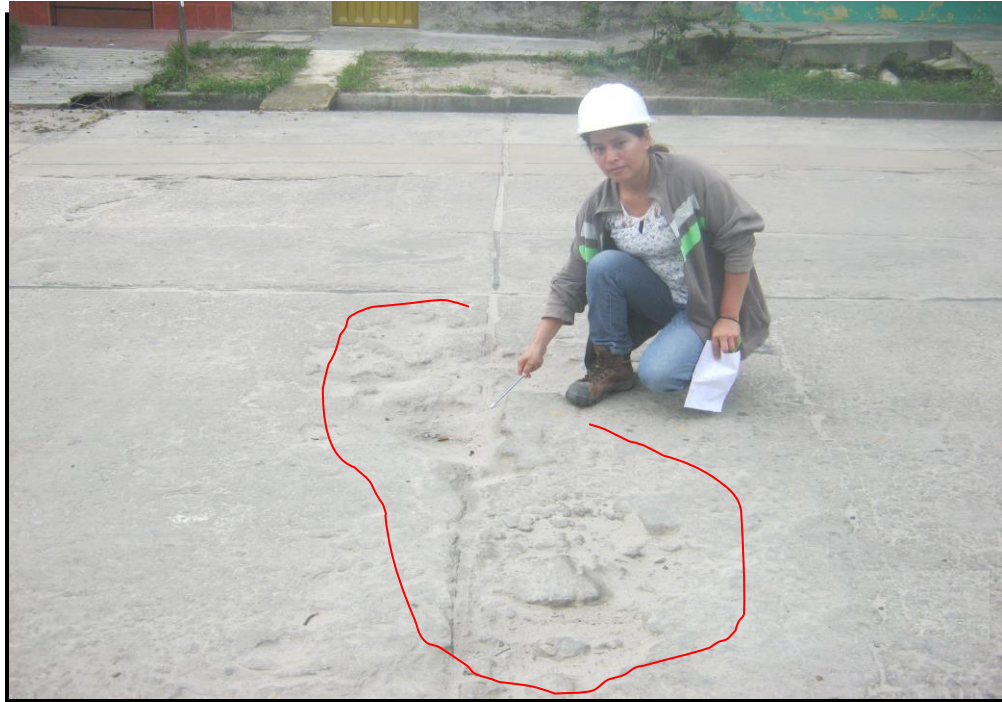
Figura 112: Foto desconchamiento de severidad alta
