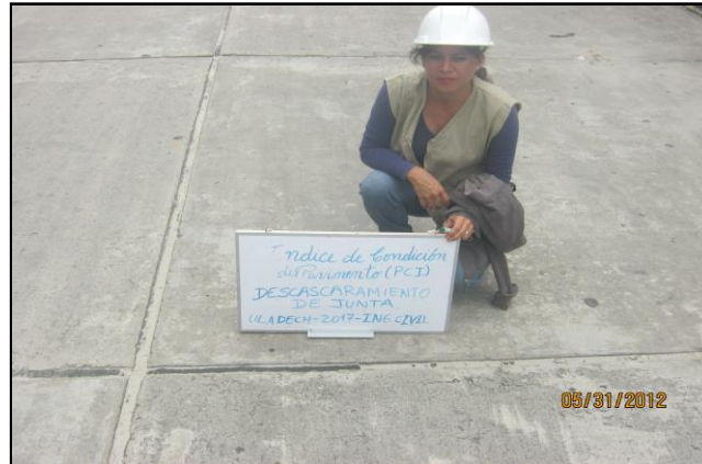
Figura 18: Descascaramiento de Junta
