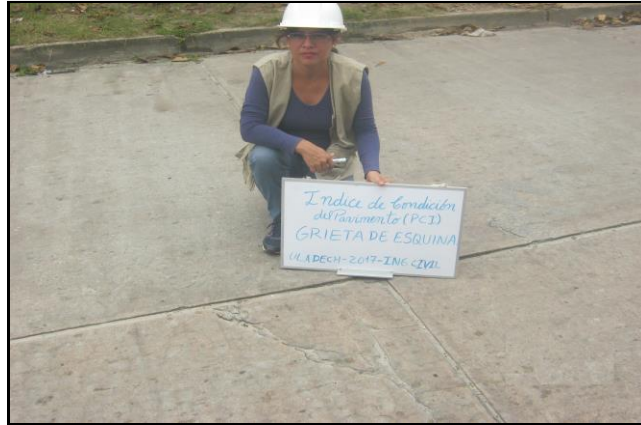
Figura 22: Grietas de Esquina
