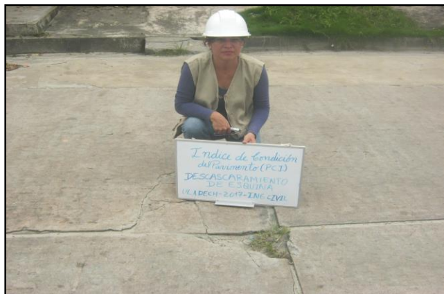
Figura 17: Descascaramiento de Esquina.
