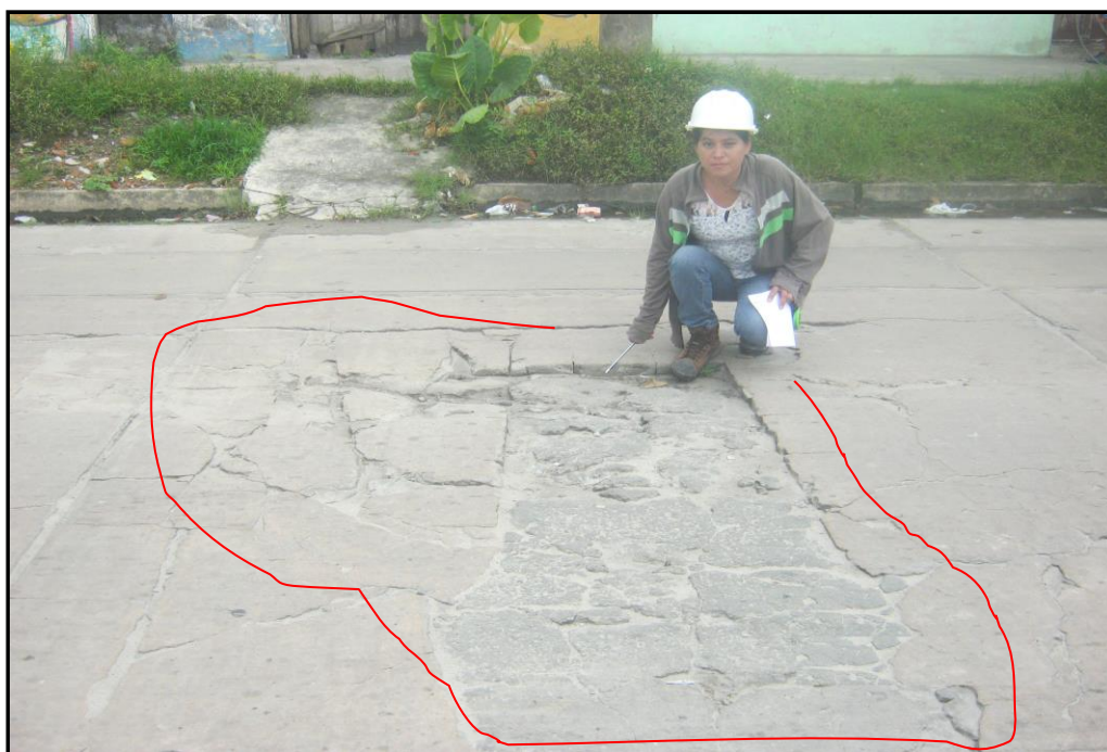
Figura 109: foto punzonamiento de severidad alta.
