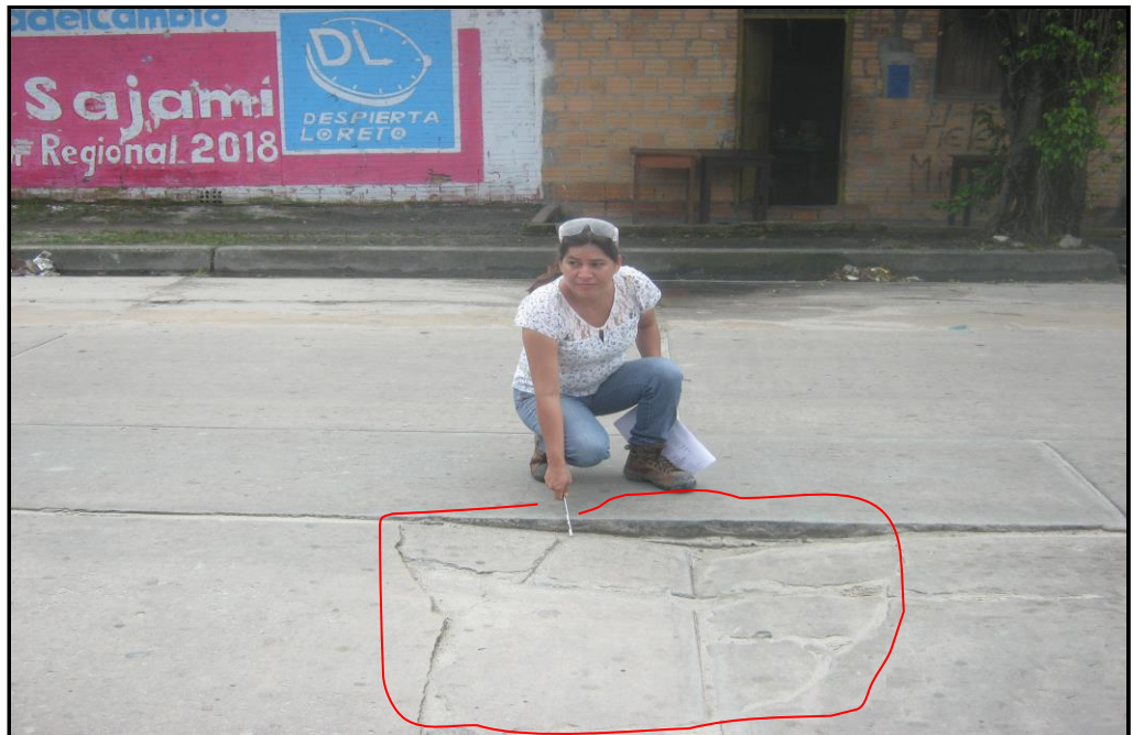
Figura 99: Se observa punzonamiento de severidad alta
