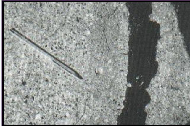
Figura 23: Grietas de Durabilidad “D”
