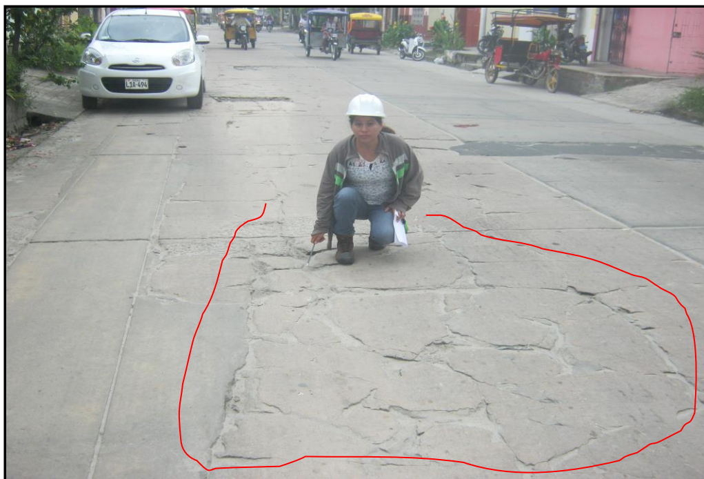
Figura 108: foto de desconchamiento de severidad alta.
