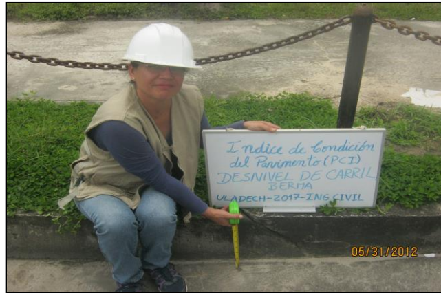
Figura 19: Desnivel de Carril / Berma
