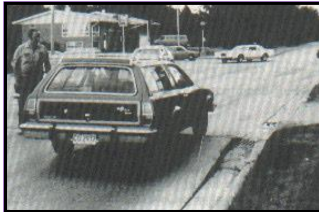
Figura 14: Falla por Blowups-Buckles
