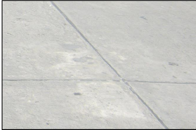
Figura 20: Daño del Sello de la Junta
