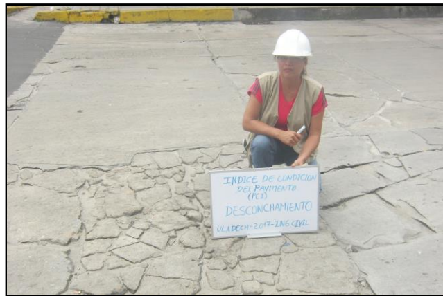
Figura 16: Desconchamiento/Mapa De Grieta/Craquelado.
