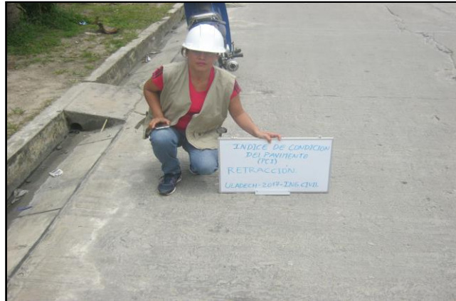
Figura 21: Grietas de Retracción.
