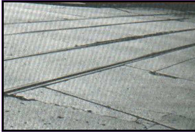
Figura 15: Falla por el Cruce de Vía Férrea.
