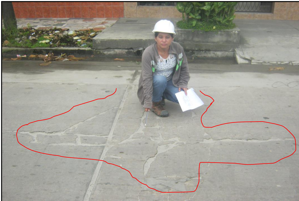
Figura 105: Foto punzonamiento de severidad media.
