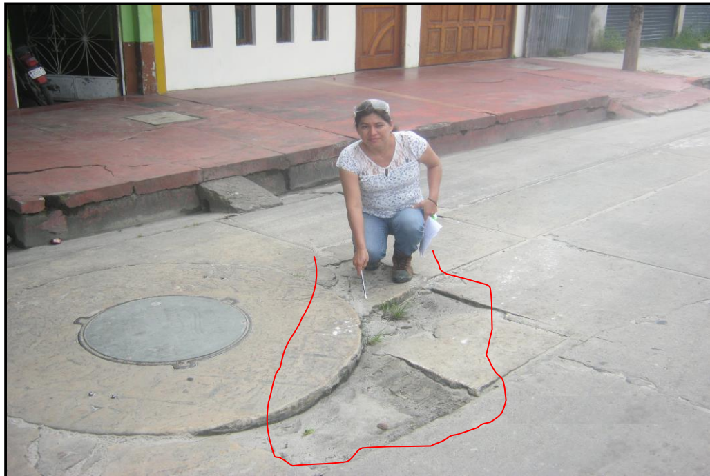
Figura 101: Se observa punzonamiento de severidad alta
