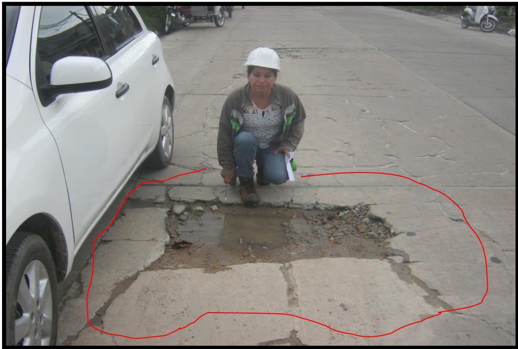
Figura 107: Foto punzonamiento de severidad alta.
