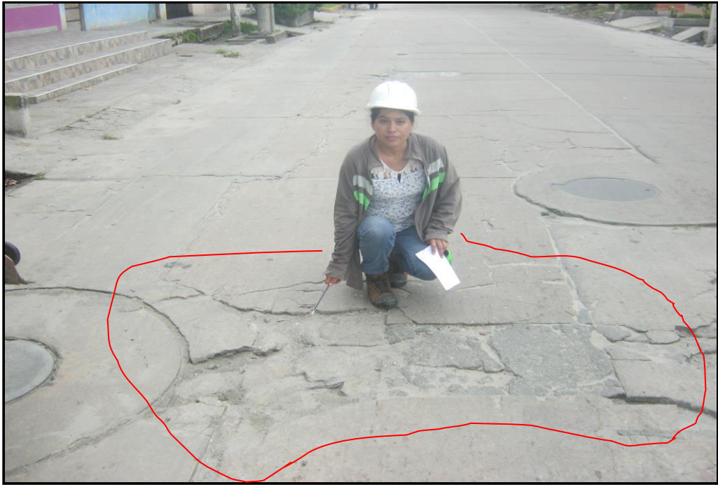
Figura 104: Foto punzonamiento de severidad alta
