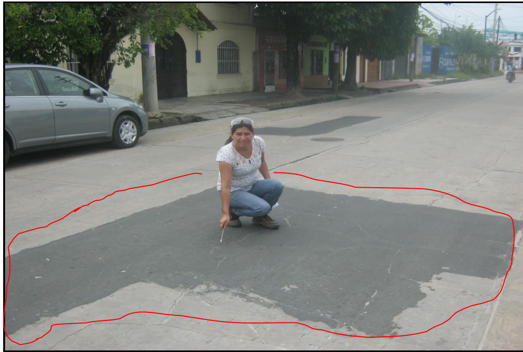
Figura 100: Se observa parcheo grande severidad media
