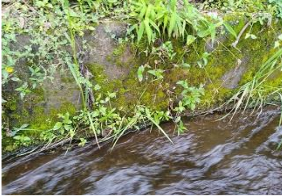
Fotografía 03: Se muestra la patología Biológica en la paredes laterales del canal de regadío santa Ana – Vegetación. Fuente: Elaboración Propia.
