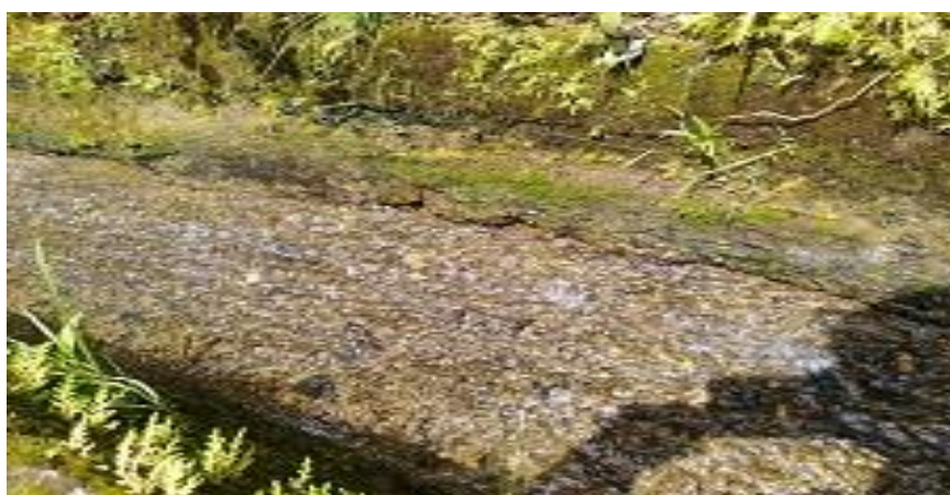
Gráfico N° 13: Erosión en la losa de fondo del canal de regadío.
