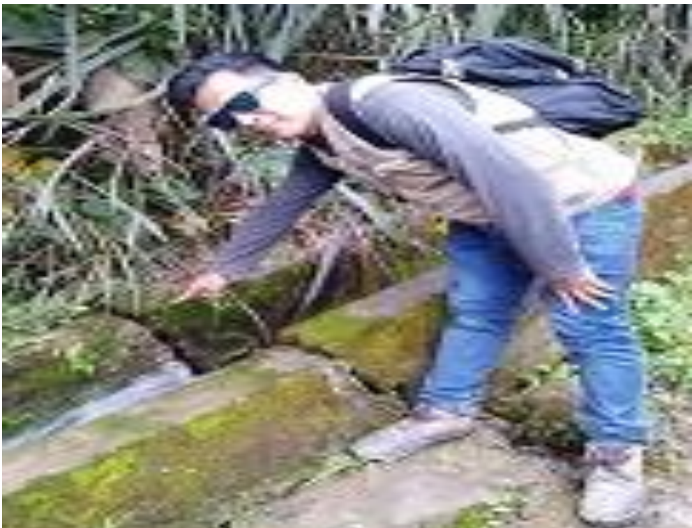
Fotografía 04: Se muestra la patología Mecánica en las paredes laterales y losas de fondo del canal de regadío santa Ana – Grieta. Fuente: Elaboración Propia.
