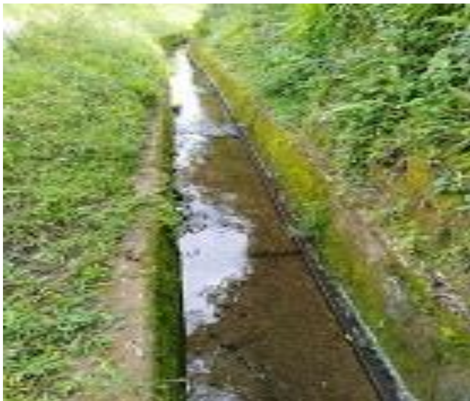
Fotografía 07: Se muestra la patología Física en la losa de fondo del canal de regadío Santa Ana – Sedimento. Fuente: Elaboración Propia.
