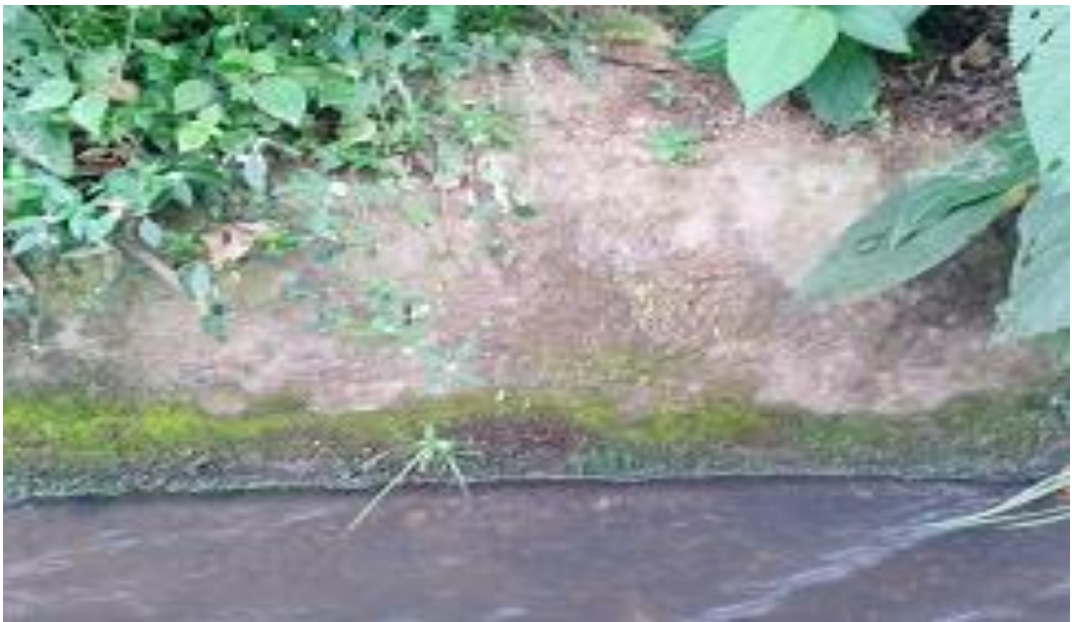
Fotografía 02: Se muestra la patología Biológica en las paredes laterales del canal de regadío Santa Ana – Hongos. Fuente: Elaboración Propia.
