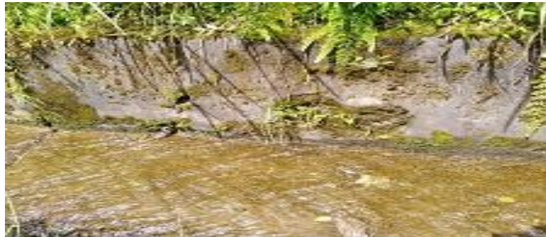
Gráfico N° 15: Descaramiento en la pared lateral del canal de regadío.
