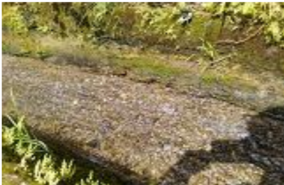
Fotografía 08: Se muestra la patología Mecánica en la losa de fondo del canal de regadío santa Ana – Erosión. Fuente: Elaboración Propia.
