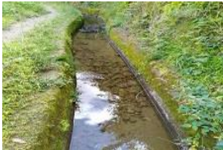
Gráfico N° 10: Sedimento en la losa de fondo del canal.
