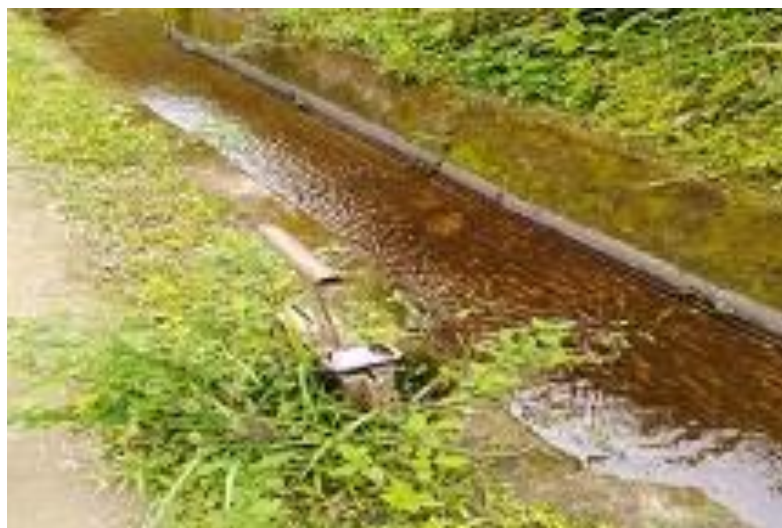
Gráfico N° 17: Eflorescencia en la pared lateral del canal de regadío.
