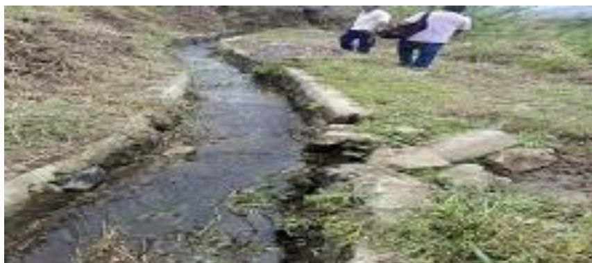
Gráfico N° 16: Rotura de la pared lateral del canal de regadío.
