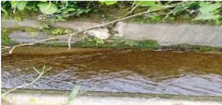
Gráfico N° 11: Grietas en la estructura del canal.
