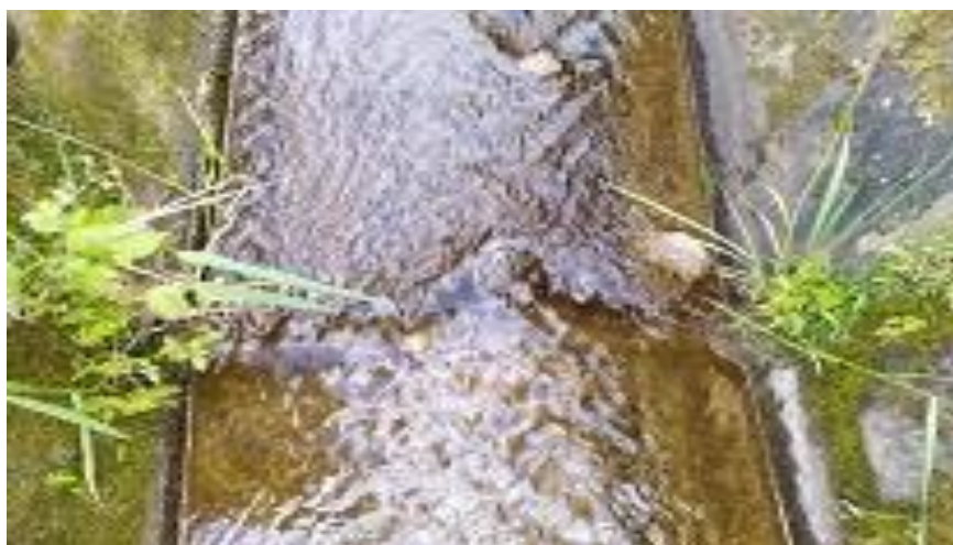
Gráfico N° 09: Vegetación en las paredes laterales del canal.
