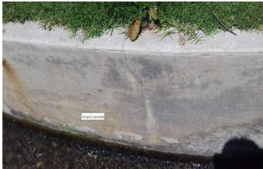
Figura 7: Fisuras en la estructura del canal.
