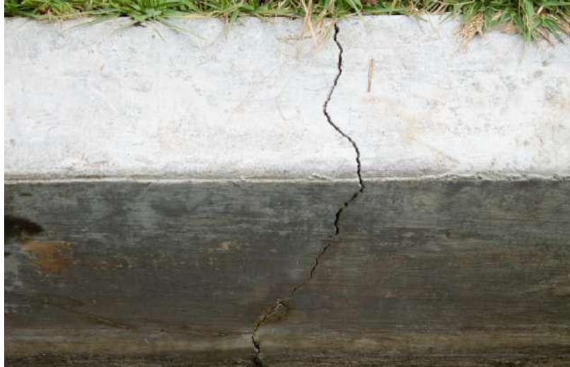
Figura 6: Grietas en la estructura del canal.
