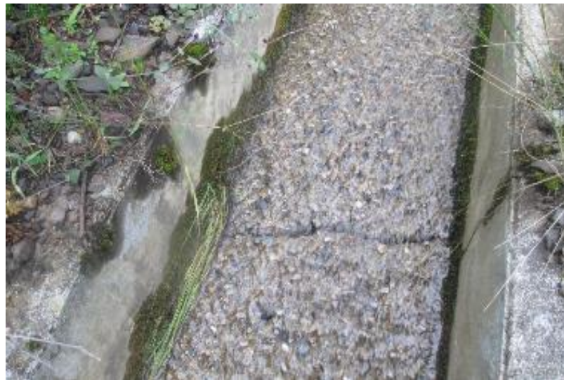
Figura 5: Erosión en el fondo del canal.
