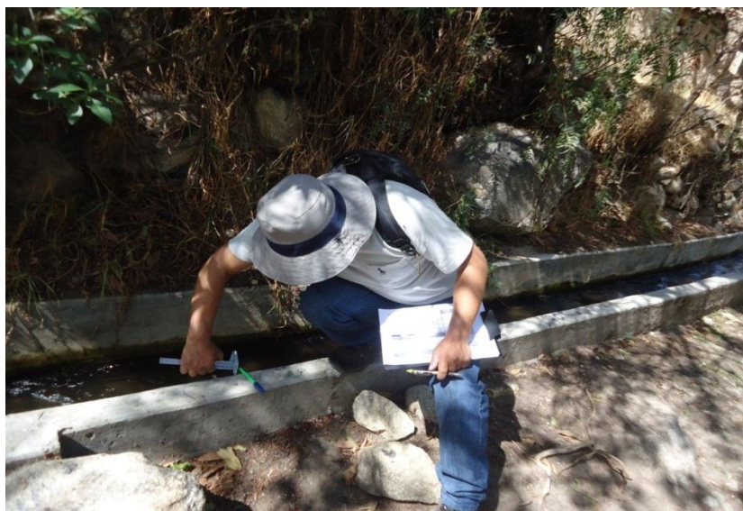
Fotografía 03: Tomando datos de la patología grieta en el canal.
