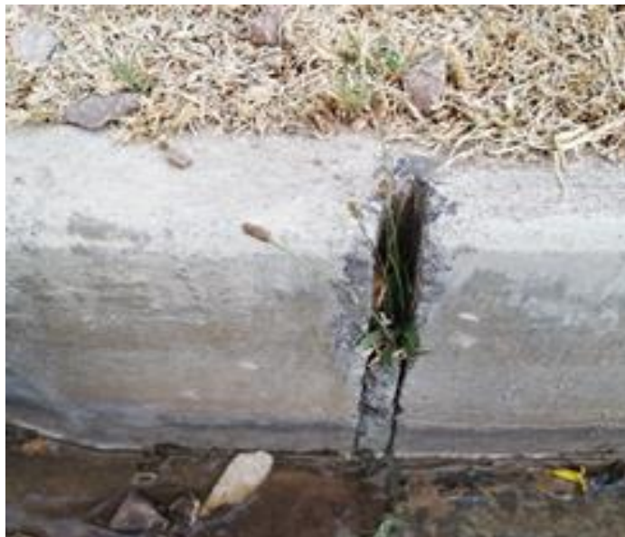
Figura 13: Crecimiento de vegetación en junta longitudinal.
