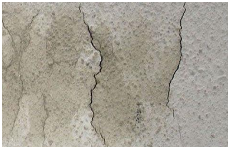
Figura 12: Fisuras como consecuencia de movimientos en el suelo de fundación.
