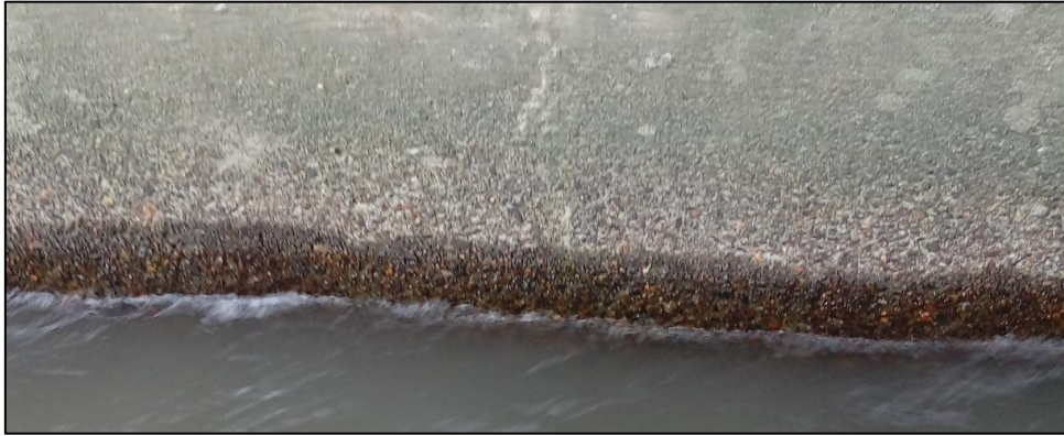
Figura 9. Daño por Erosión
