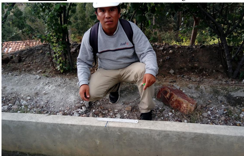
Foto N° 02: Obteniendo la abertura de la Patología Fractura
