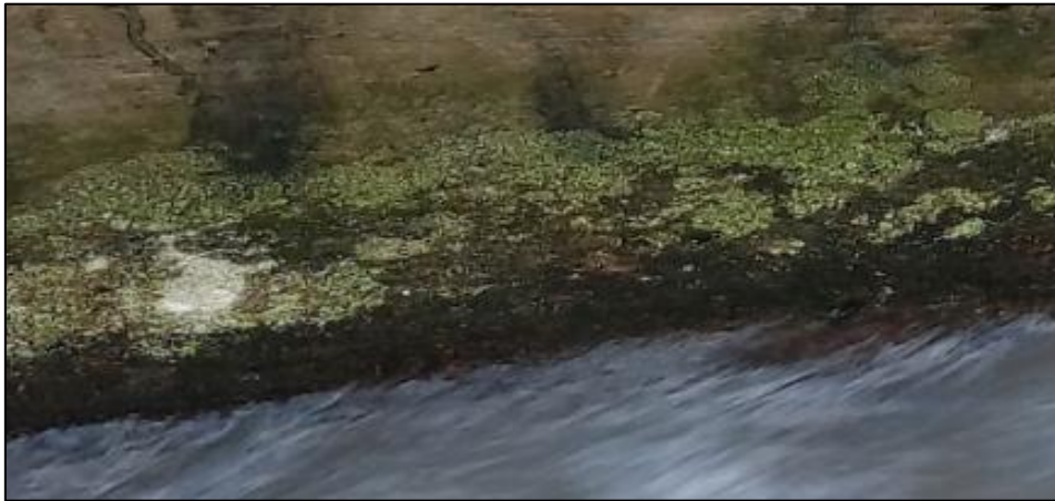
Figura 11. Daño por Musgo
