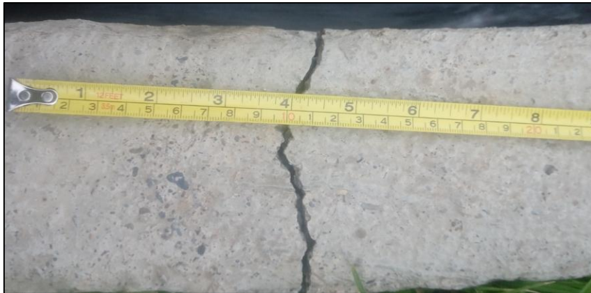
Figura 8. Grietas en canal de concreto
