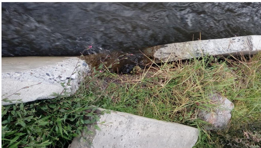
Figura 10. Daño por Impacto
