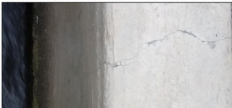
Figura 6. Fisuras en canal de concreto
