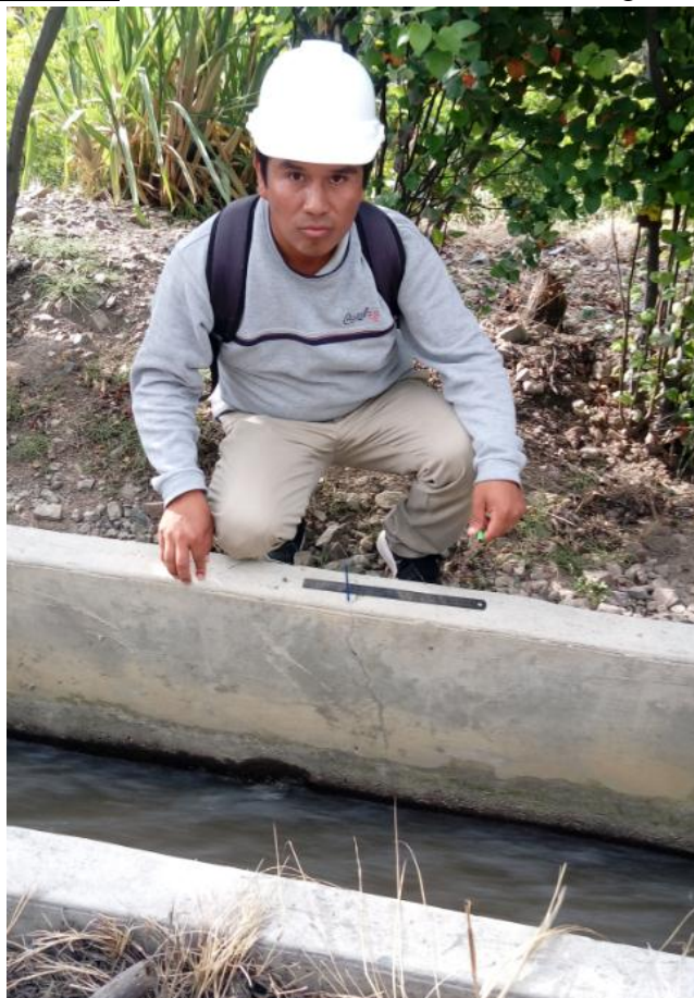
Foto N° 01: Obteniendo la abertura de la Patología Grieta
