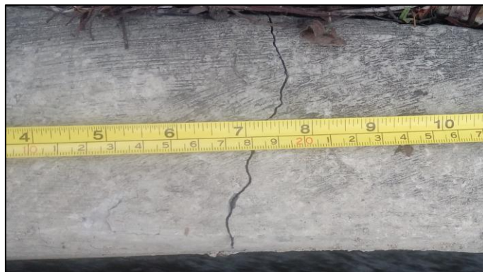
Figura 7. Fracturas en canal de concreto
