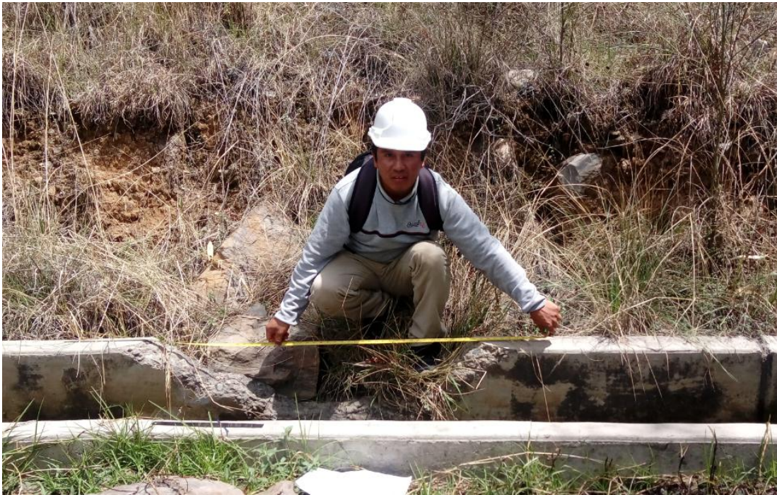
Foto N° 03: Obteniendo las dimensiones de la Patología Impacto
