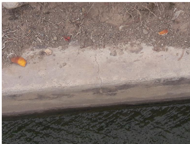
FOTOGRAFIA N° 03: Fotografía del Canal “Chullcu” al margen derecho se visualiza una grieta.
