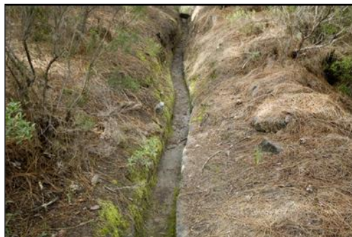
Figura 4: Canal de tercer orden.
