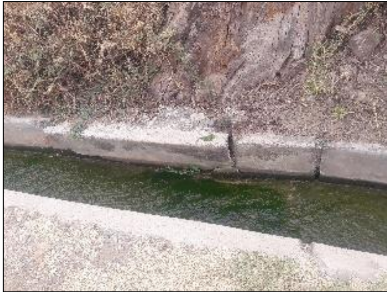
FOTOGRAFIA N° 06: Fotografía del Canal “Chullcu” presencia de grietas
