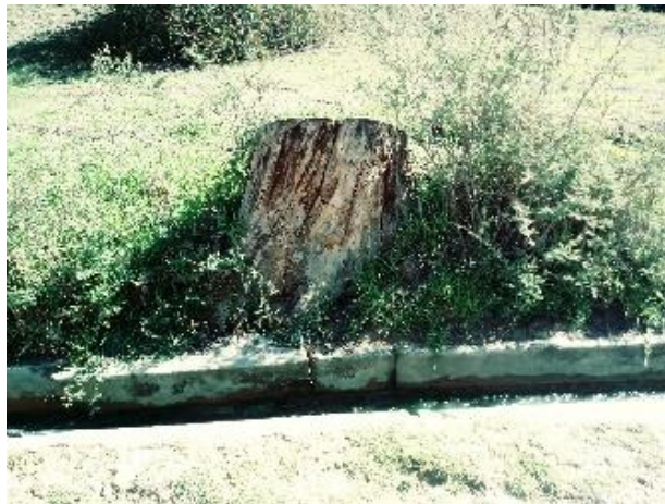
FOTOGRAFIA N° 05: Fotografía del Canal “Chullcu” presencia de grietas
