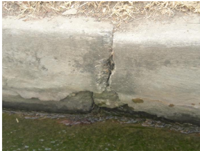
FOTOGRAFIA N° 02: Fotografía del Canal “Chullcu” al margen derecho se visualiza una grieta.
