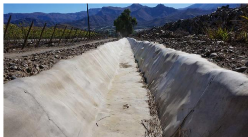
Figura 16: Degradación del revestimiento del concreto.
