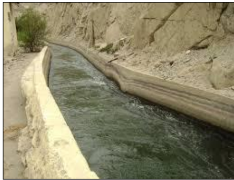
Figura 14: Grieta como consecuencia de movimiento en el suelo de fundación.
