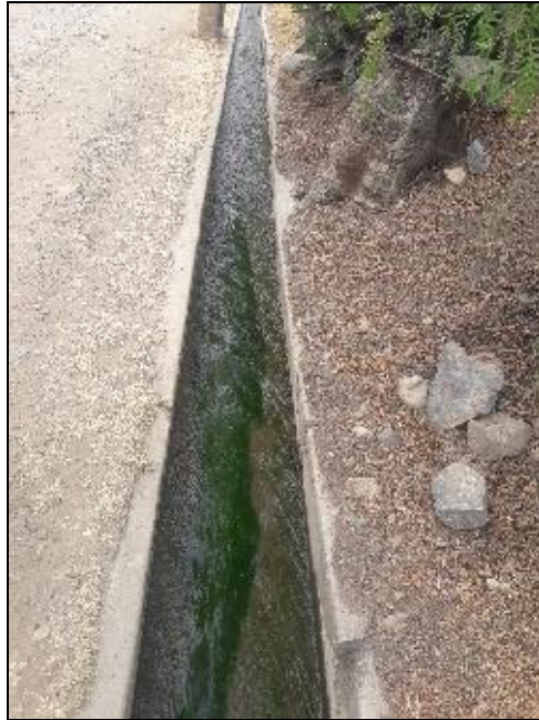
FOTOGRAFIA N° 08: Fotografía del Canal “Chullcu” presencia de algas
