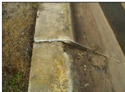
Figura 17: Desplazamiento de paneles en talud.
