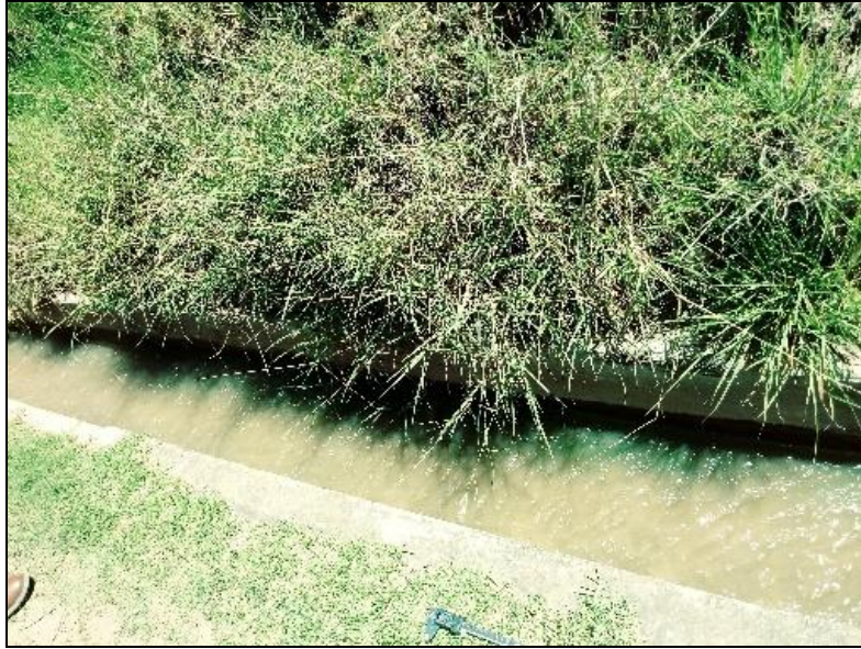
FOTOGRAFIA N° 10: Fotografía del Canal “Chullcu” presencia de vegetación
