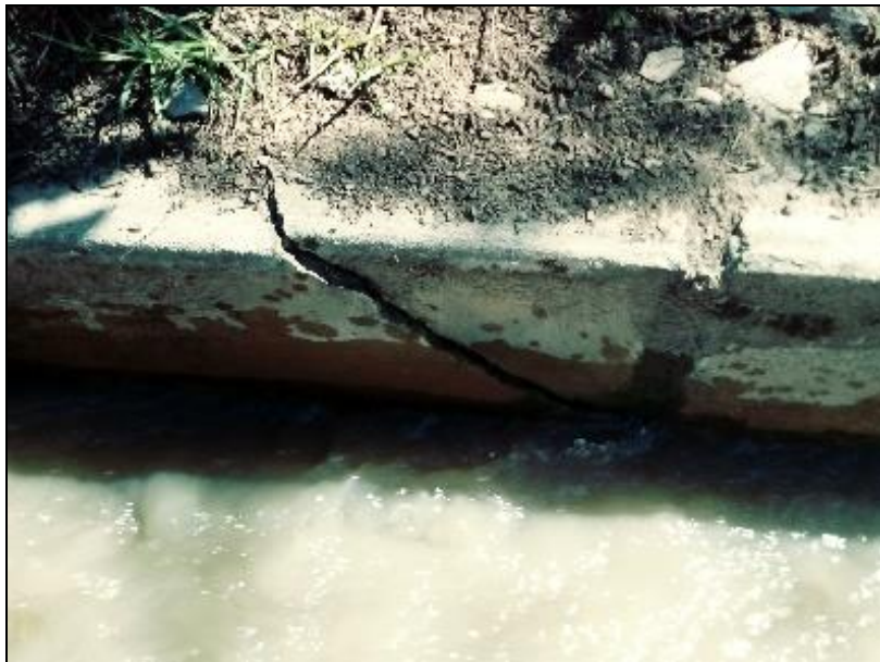
FOTOGRAFIA N° 07: Fotografía del Canal “Chullcu” presencia de grietas
