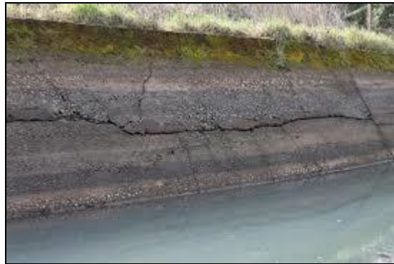
Figura 15: Fisuras en el revestimiento como consecuencia de la subpresión.
