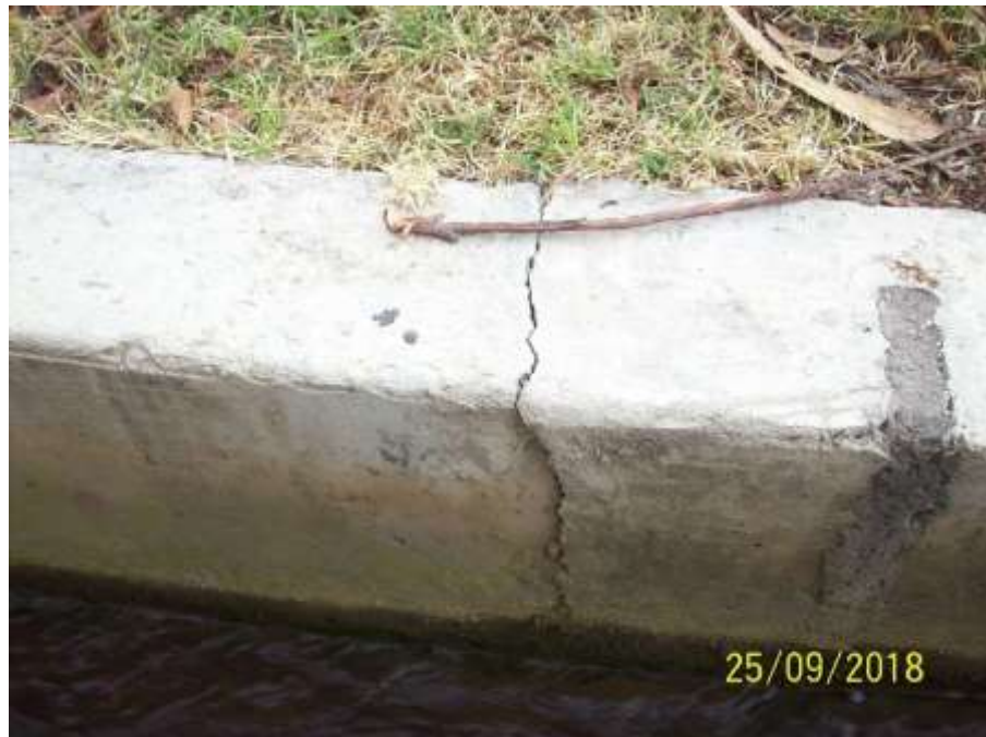
FOTO N° 03: Fotografía del Canal “Recuayhuanca - pachin” se visualiza el hinchamiento en margen izquierdo
