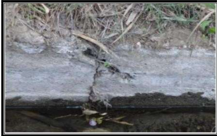
Figura 3. Ocurrencia de fisuras y/o grietas en la estructura
