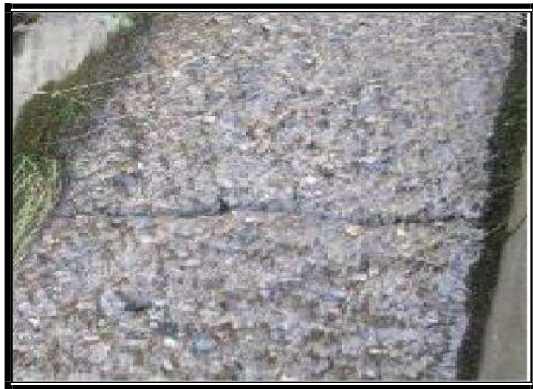
Figura 7. Daño por erosión.
