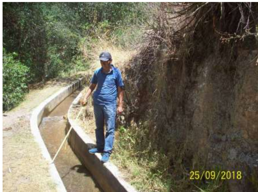
FOTO N° 04: Fotografía del Canal “Recuayhuanca - pachin” se visualiza la patología en el margen derecho
