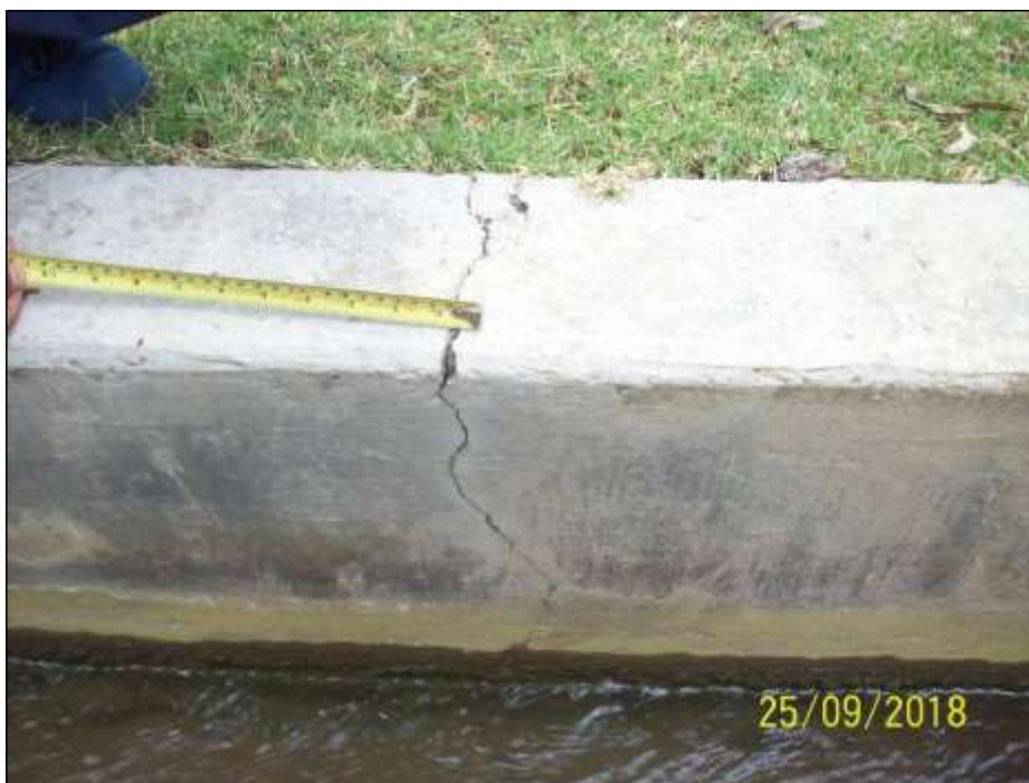
FOTO N° 01: Fotografía del Canal “Recuayhuanca - pachin” al margen izquierdo se visualiza la grietas.
