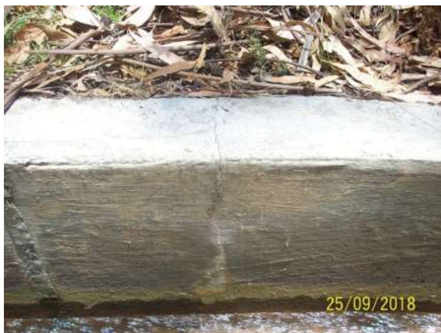
FOTO N° 02: Fotografía del Canal “Recuayhuanca - pachin” al margen derecho se visualiza la fisura.
