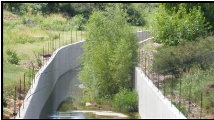
Figura 15: Daños por vegetación.
