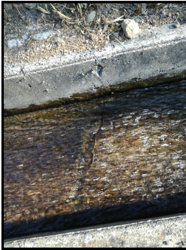
Vista de la patología (grieta) en el canal de riego de Cayac.
