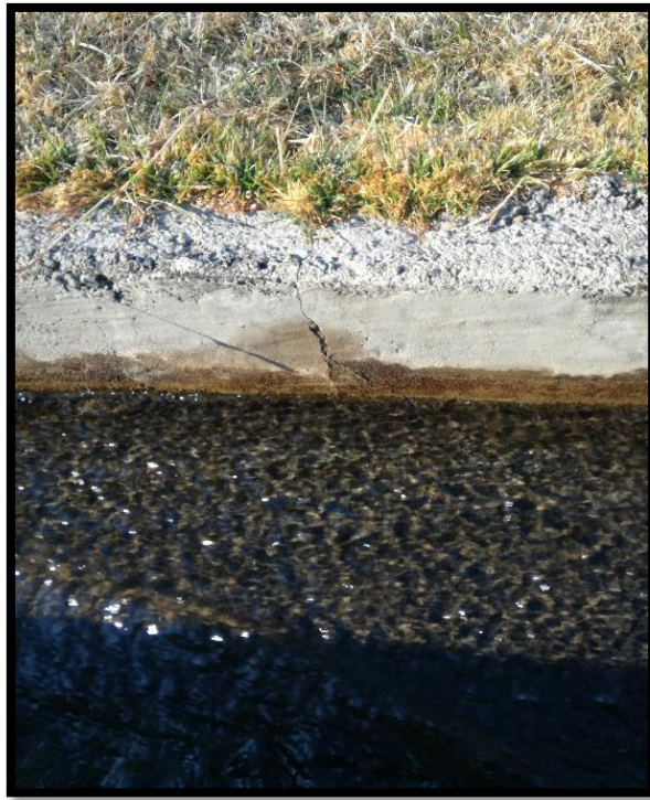
Vista de la patología (fisura) en el canal de riego de Cayac.
