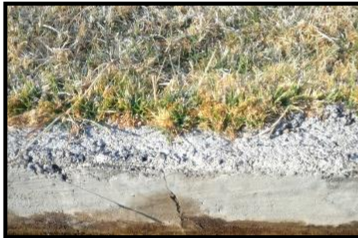
Figura 13: Fisura en concreto.
