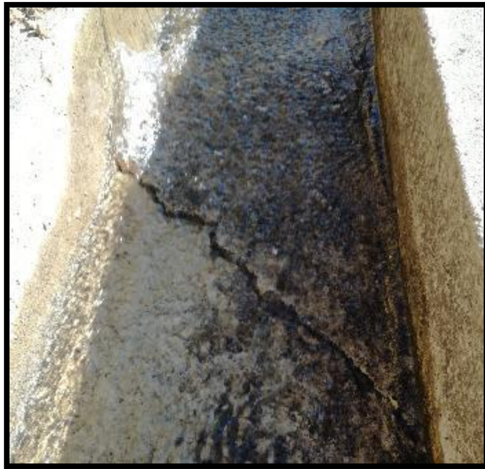
Figura 14: Grieta en el fondo del canal.
