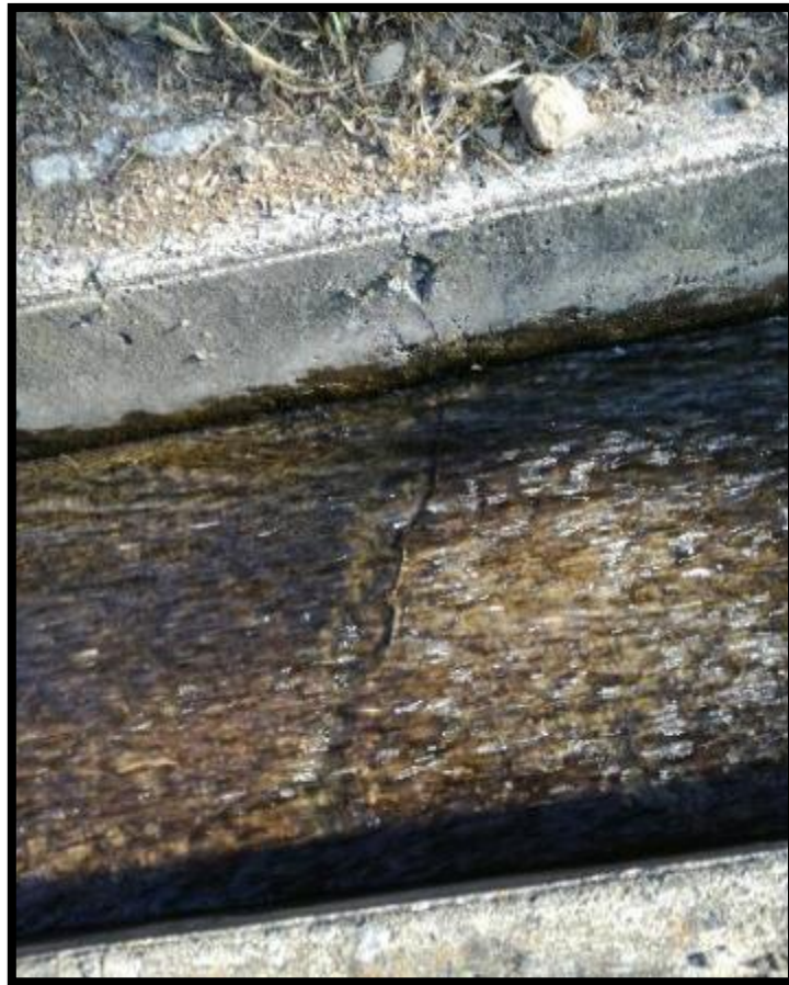
Figura 12: Erosión en el fondo del canal.
