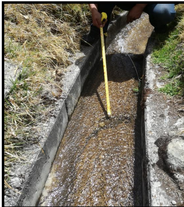
Vista de la patología (erosión) en el canal de riego de Cayac.
