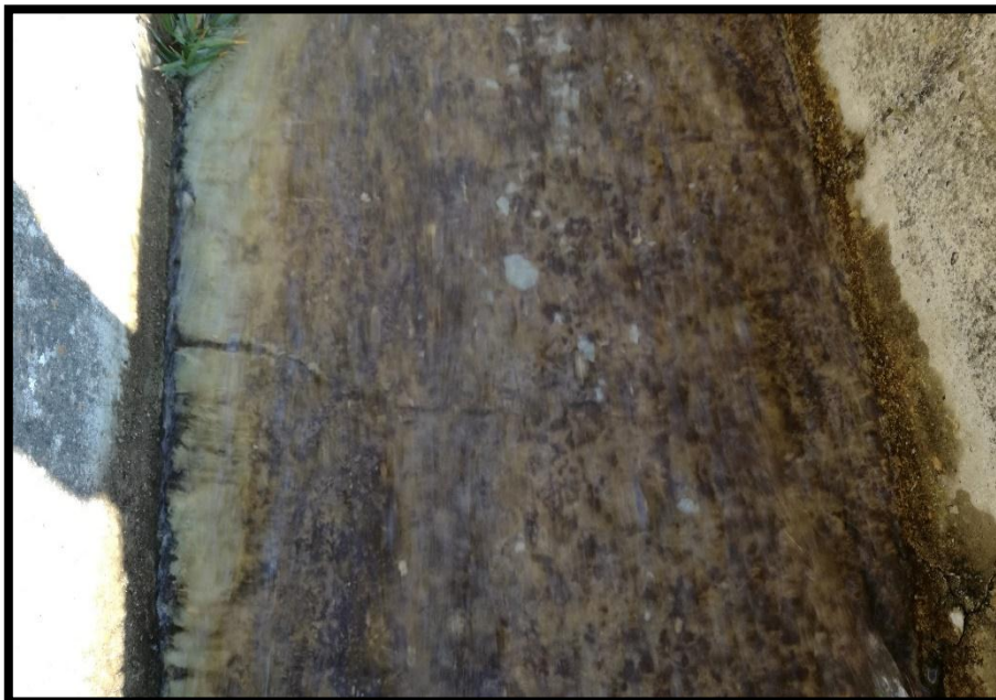
Vista de la patología (fisura) en el canal de riego de Cayac.
