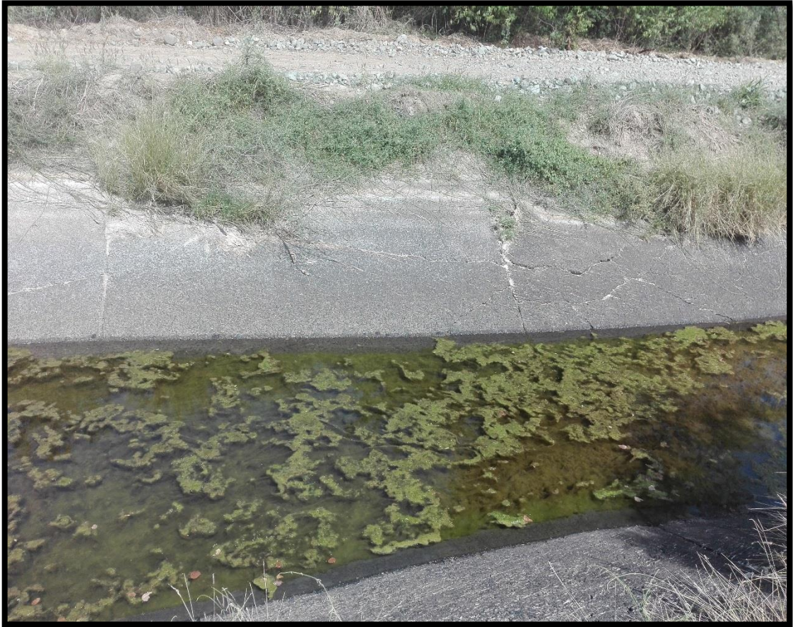
Grieta Lineal, Grieta de Esquina y Descascaramiento en las Juntas
