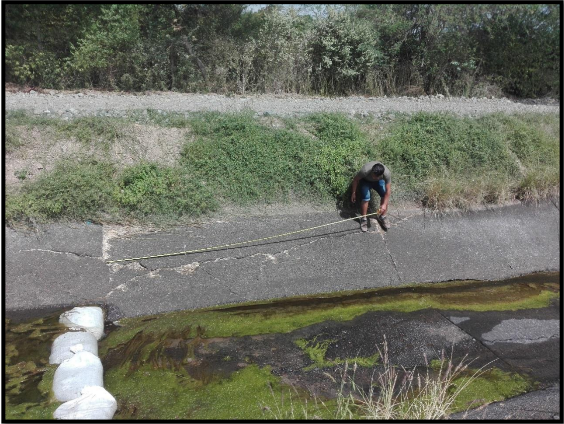
Evaluando el canal encontramos, Falla de Escala, Grieta Lineal
