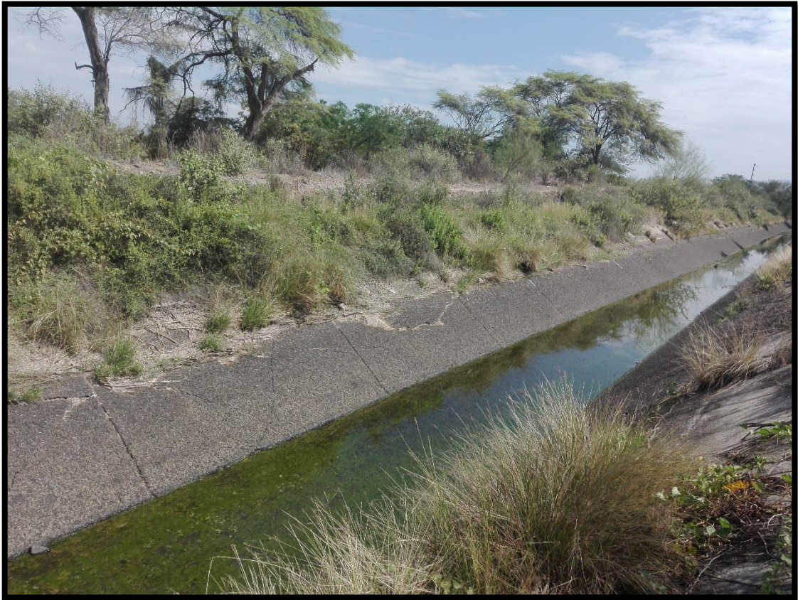
Se encontraron fallas de Grietas de Esquina, Desacascamientos en el canal
