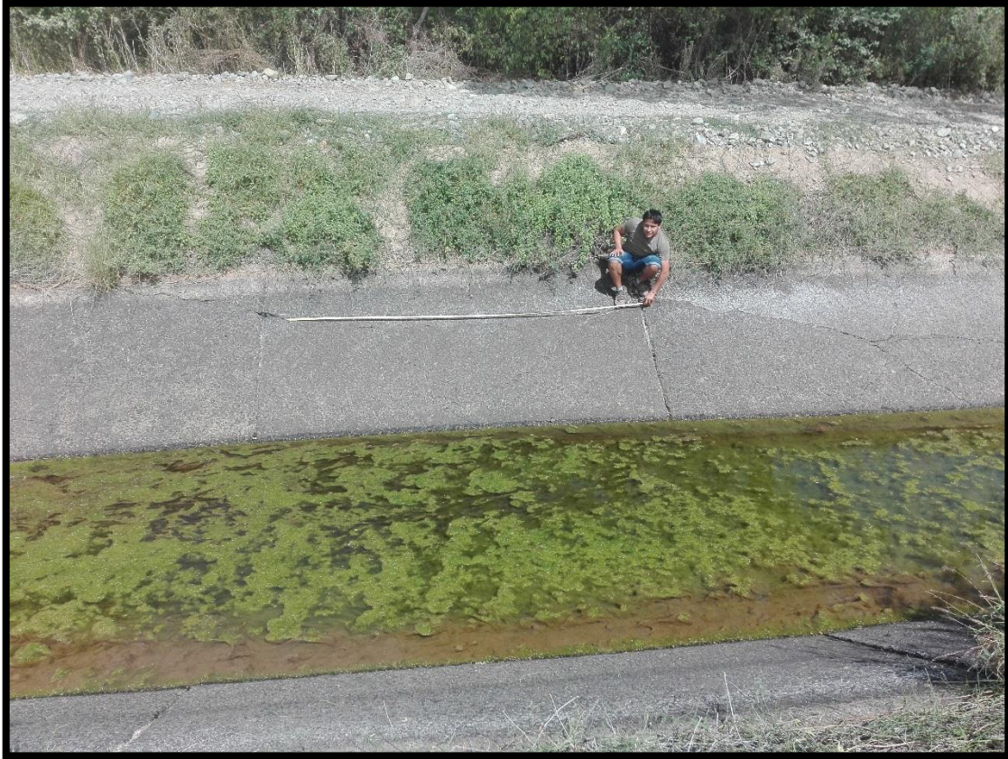
Evaluando los tipos de fallas se encontraron daños de Grieta Lineal, Escala
