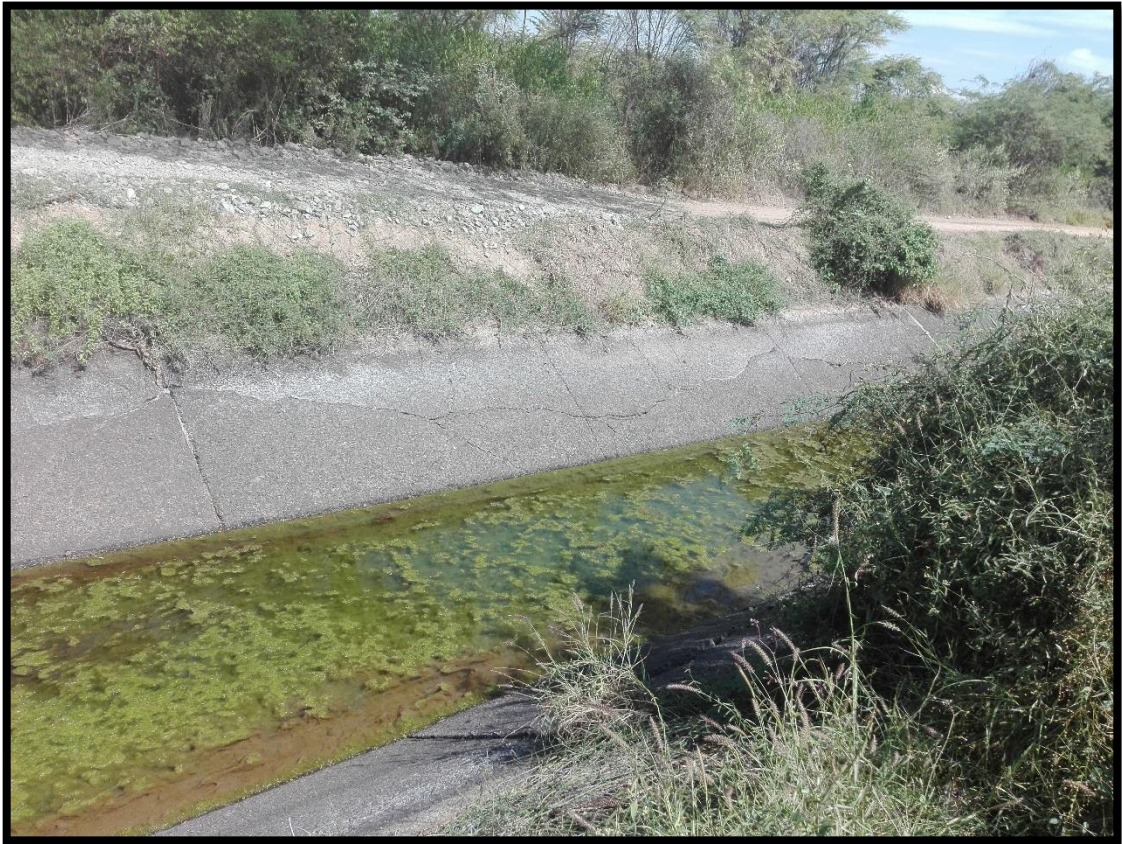
Se Observa en la superficie del canal presenta un daño de Grieta Lineal
