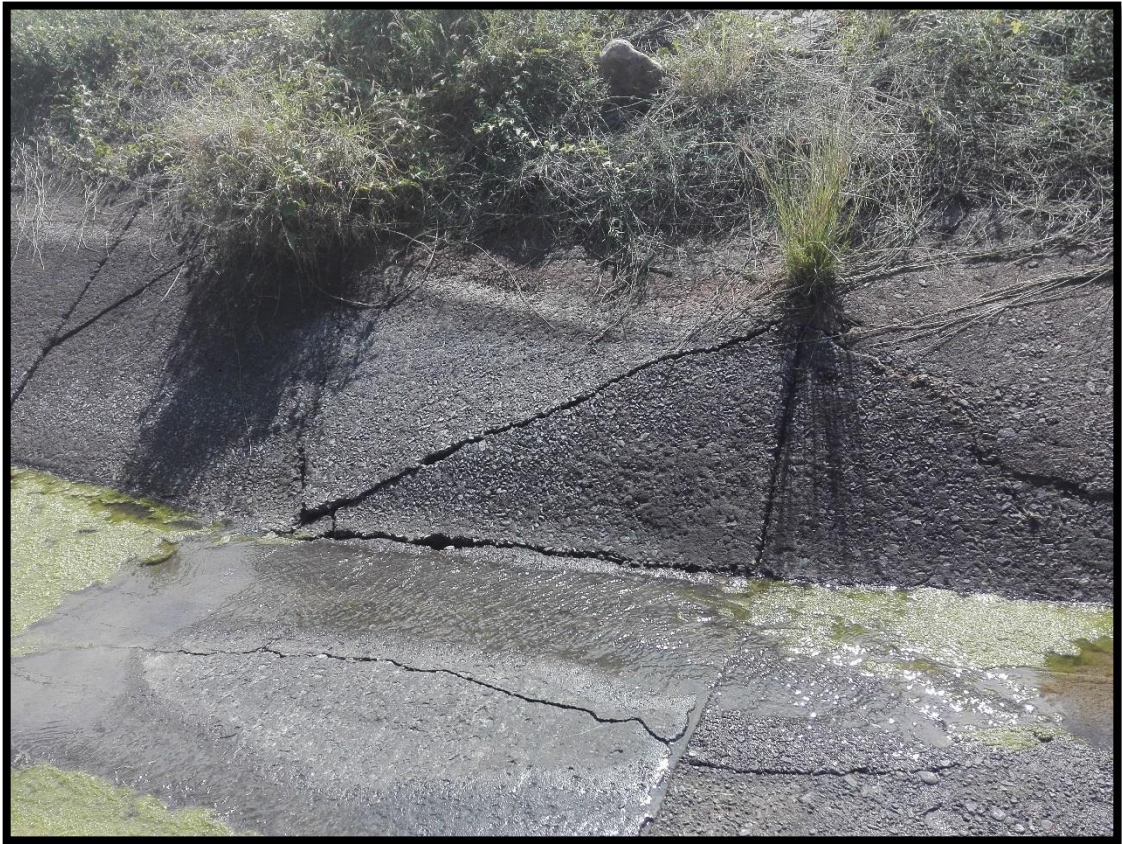
Se Observa que el canal presenta daños de Grietas, Lineales y de esquina Así como También Daños de Desconchamiento.
