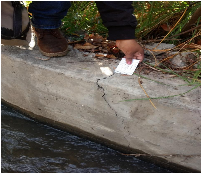
Imagen N° 8 midiendo el nivel de severidad de la grieta.
