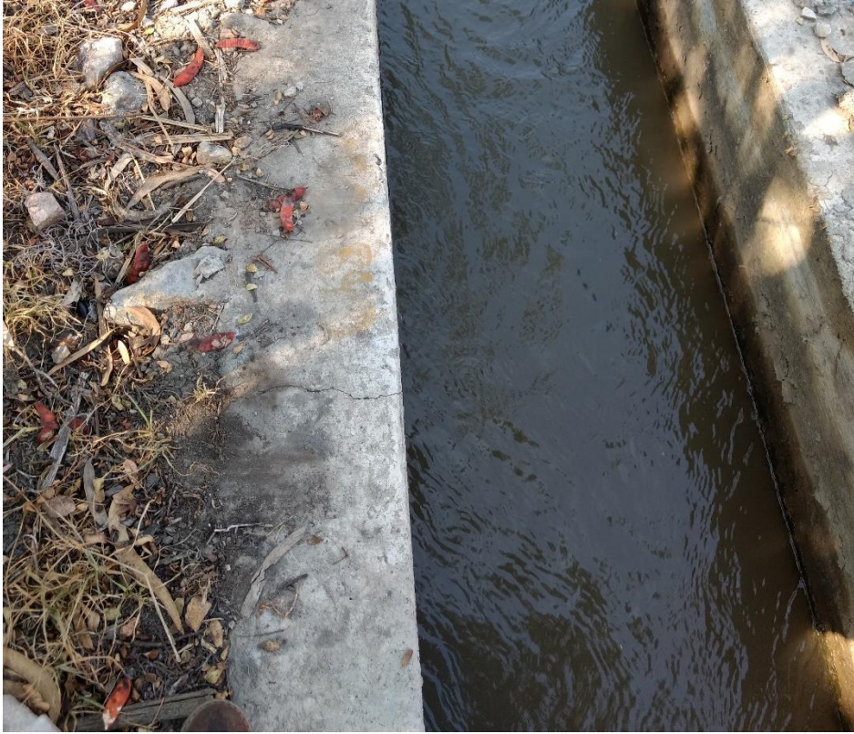
Imagen N° 9 Canal de riego Puchca se observa la presencia de fisura.
