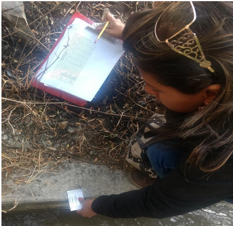
Imagen N° 10 Canal de riego Puchca mi persona realizando la medición de fisura.
