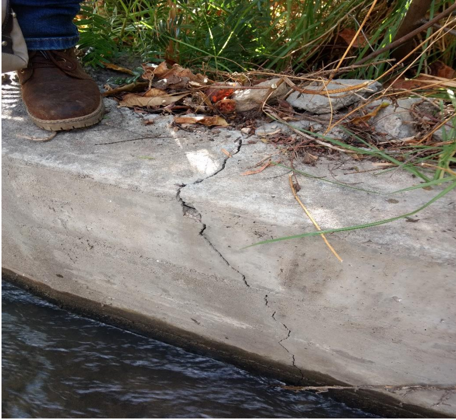
Imagen N° 7 Canal de riego Puchca. Se observa la presencia de grieta.
