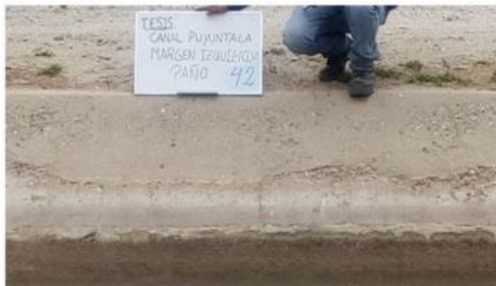
Gráfico 5: Erosión en losa lateral del canal de concreto.
