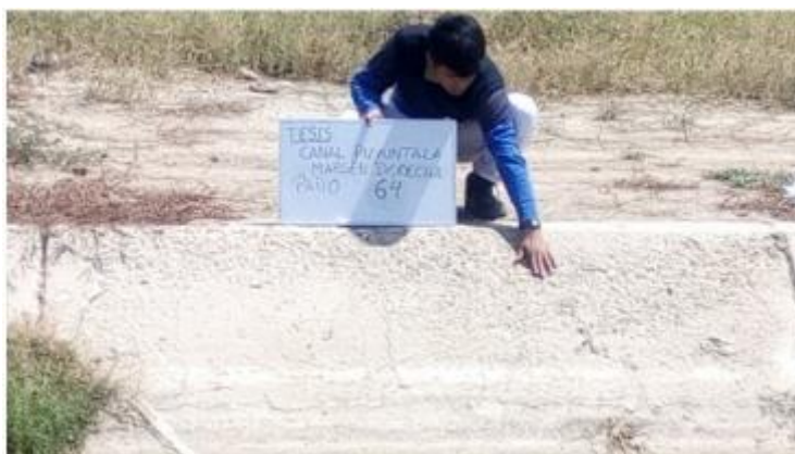
Gráfico 10: Descascaramiento del concreto.
