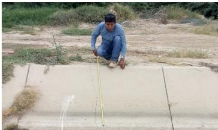
Gráfico 7: Grieta en estructura de concreto.
