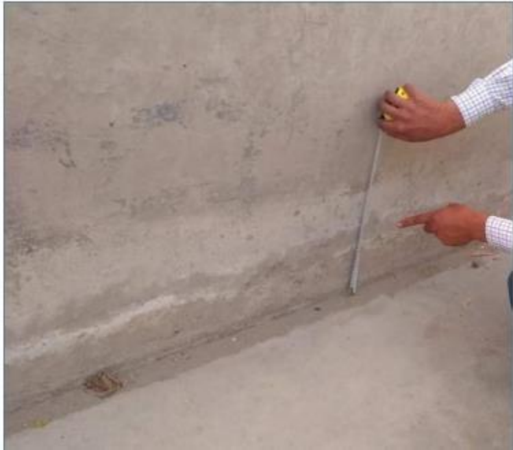
Gráfico 9: Eflorescencia en losa lateral de canal
