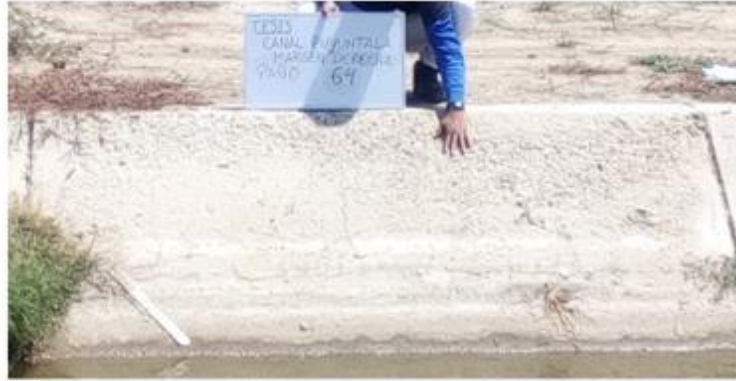
Gráfico 6: Desprendimiento en concreto.
