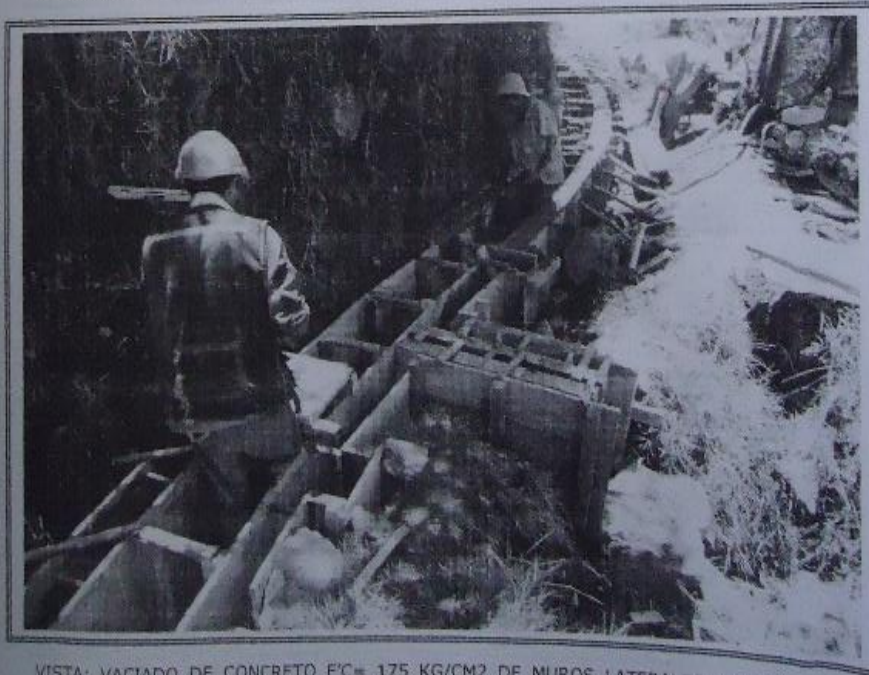
VISTA: VACIADO DE CONCRETO F'C= 175 KG/CM2 DE MUROS LATERALES DEL CANAL Y TAMBIEN DE LAS TOMAS LATERALES, SEGÚN PLANOS APROBADOS.
