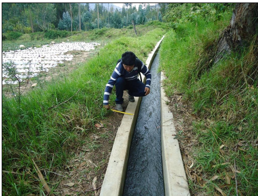
Foto N° 02: Fotografía del canal “Huanchacpampa” grieta identificada
