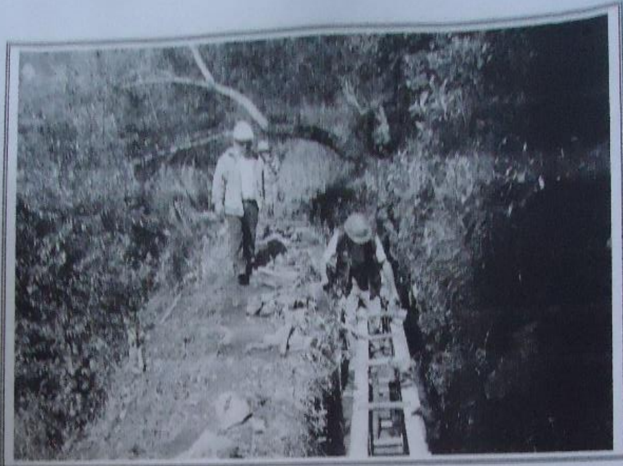
VISTA: ENCOFRADO DE MUROS LATERALES EN OTRO PUNTO DEL CANAL HUANCHACPAMPA, INSPECCIONA EL SUPERVISOR DE OBRA.
