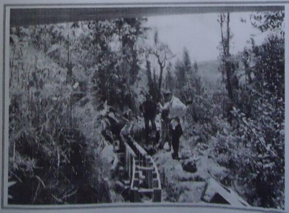
VISTA: CONTINUA EL ENCOFRADO DE MUROS LATERALES DEL CANAL HUANCHACPAMPA CON MEDIDAS INDICADOS EN LOS PLANOS.
