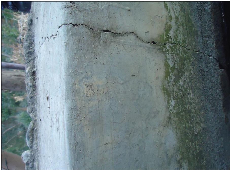
Foto N° 08: Fotografía del canal “Huanchacpampa” grieta identificada
