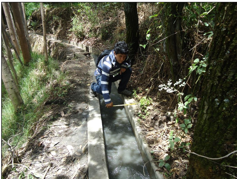
Foto N° 01: Fotografía del canal “Huanchacpampa” grieta identificada
