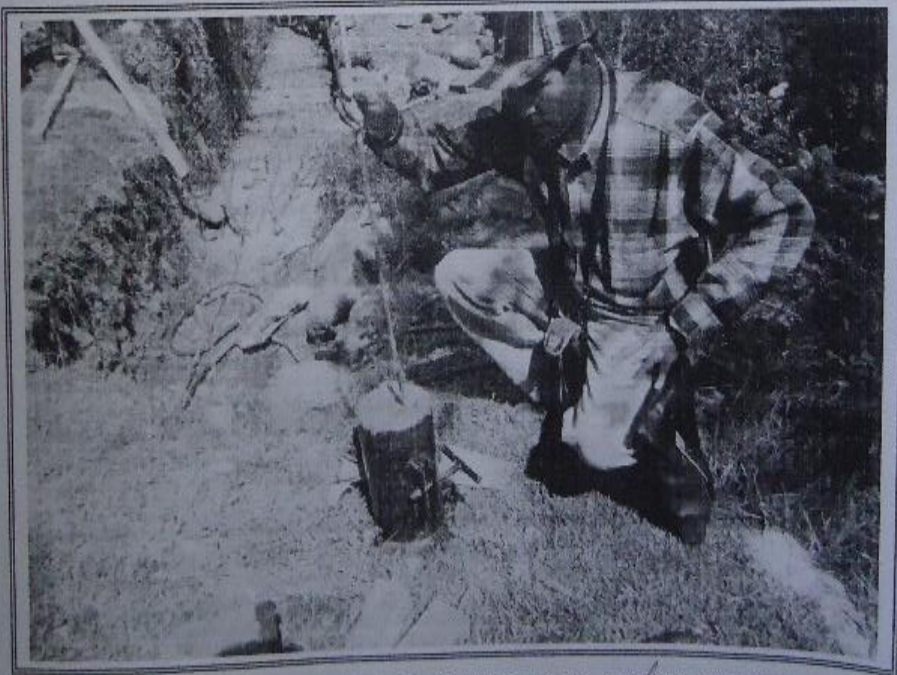
VISTA: SE TOMA MUESTRAS DE TESTIGOS EN PROBETAS DEL VACIADO DE CONCRETO DE MUROS Y PISOS DEL CANAL HUANCHACPAMPA.
