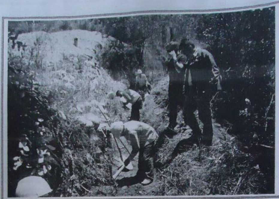
VISTA: EXCAVACION Y REFINE DE ZANJAS DEL CANAL HUANCHACAMPA CON PERSONAL OBRERO DE LA ZONA DE ACOPAMPA.
