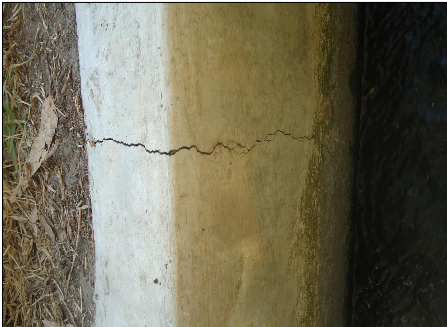
Foto N° 06: Fotografía del canal “Huanchacpampa” grieta identificada
