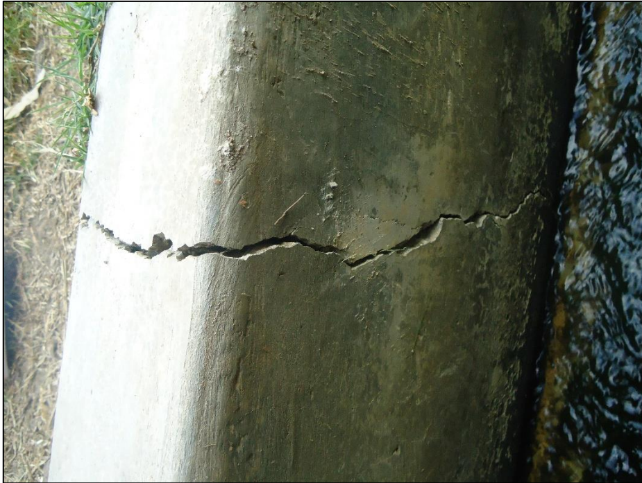
Foto N° 03: Fotografía del canal “Huanchacpampa” grieta identificada
