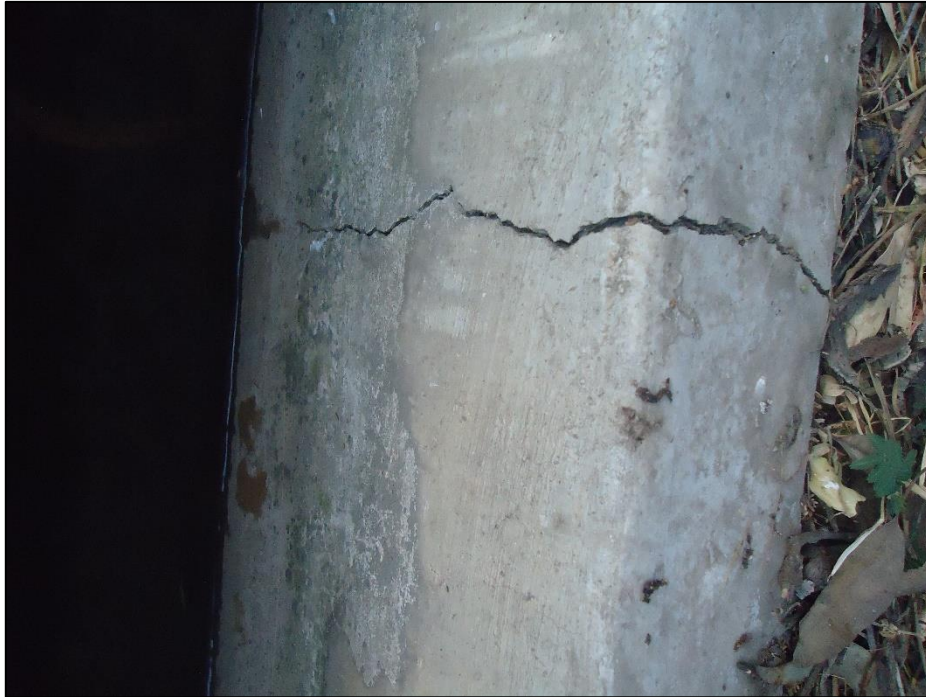
Foto N° 05: Fotografía del canal “Huanchacpampa” grieta identificada
