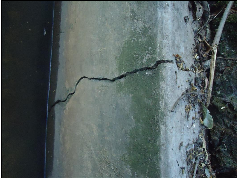
Foto N° 7: Fotografía del canal “Huanchacpampa” grieta identificada
