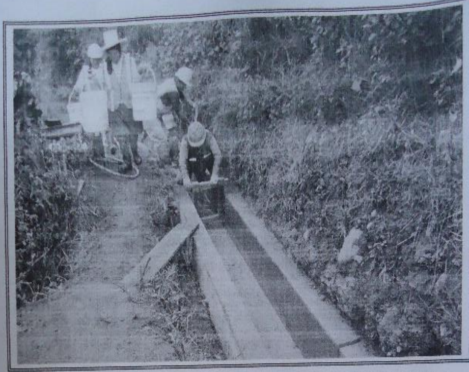
VISTA: VACIADO DE CONCRETO f'c=175 KG/CM 2 DE PISOS DEL CANAL HUANCHACPAMPA SEGÚN LAS MEDIDAS INDICADAS EN LOS PLANOS.
