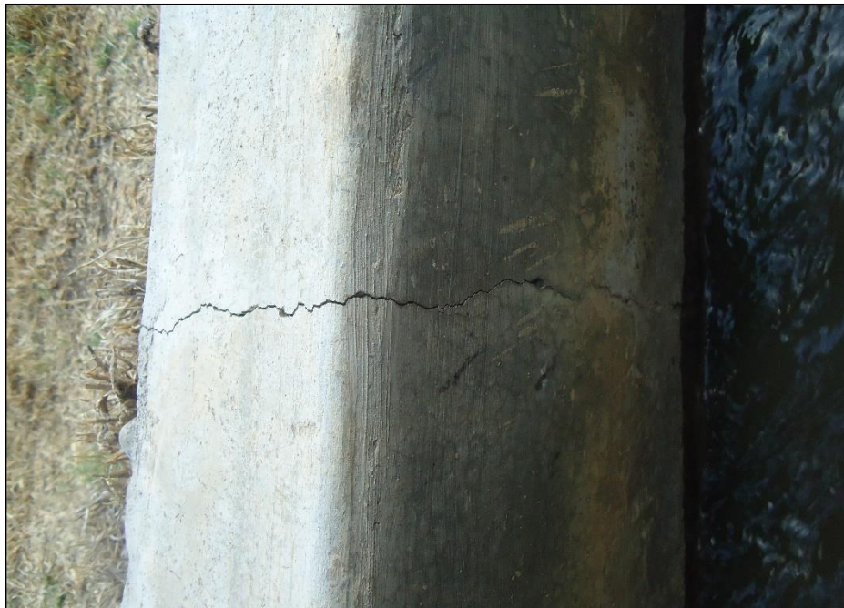
Foto N° 04: Fotografía del canal “Huanchacpampa” grieta identificada
