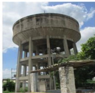
VISTA DEL RESERVOIRIO R1 GRAU
