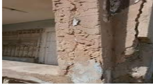
Gráfico N° 07: Desprendimiento del Concreto
