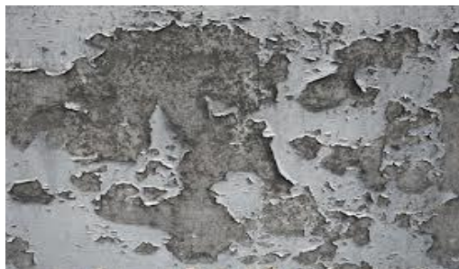
Gráfico N° 15: Desprendimiento de Concreto
