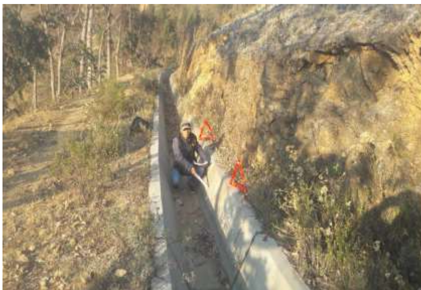
FOTO N° 03: Fotografía del Canal Irrigación Huecrococha al margen derecho se visualiza grietas.
