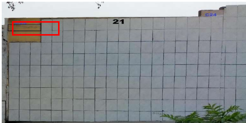
Figura 27. Aparición de fisuras en el muro de albañilería. Nota. Fuente: Elaboración propia. (2018).
