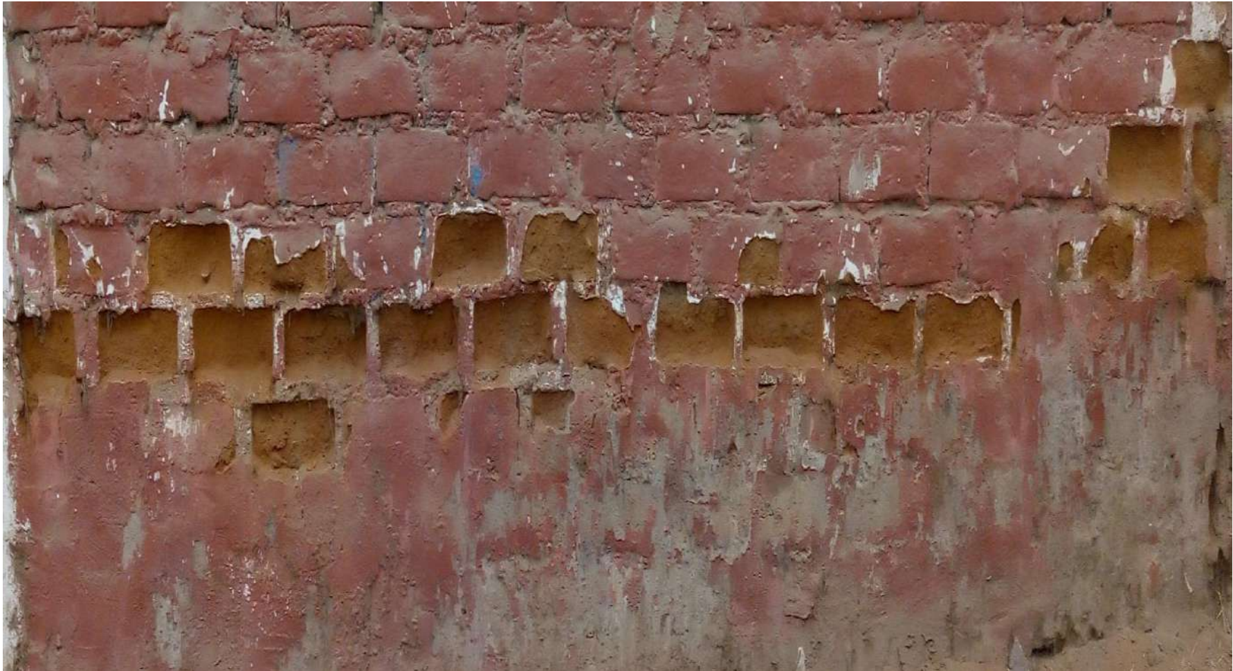
Fotografía 5: Albañilería afectada por erosión en la Unidad Muestral 05, paño 26.
