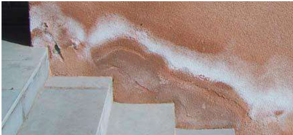
Figura 29. Estructura con presencia de eflorescencia en la parte inferior. Nota. Fuente: Elaboración propia. (2018).
