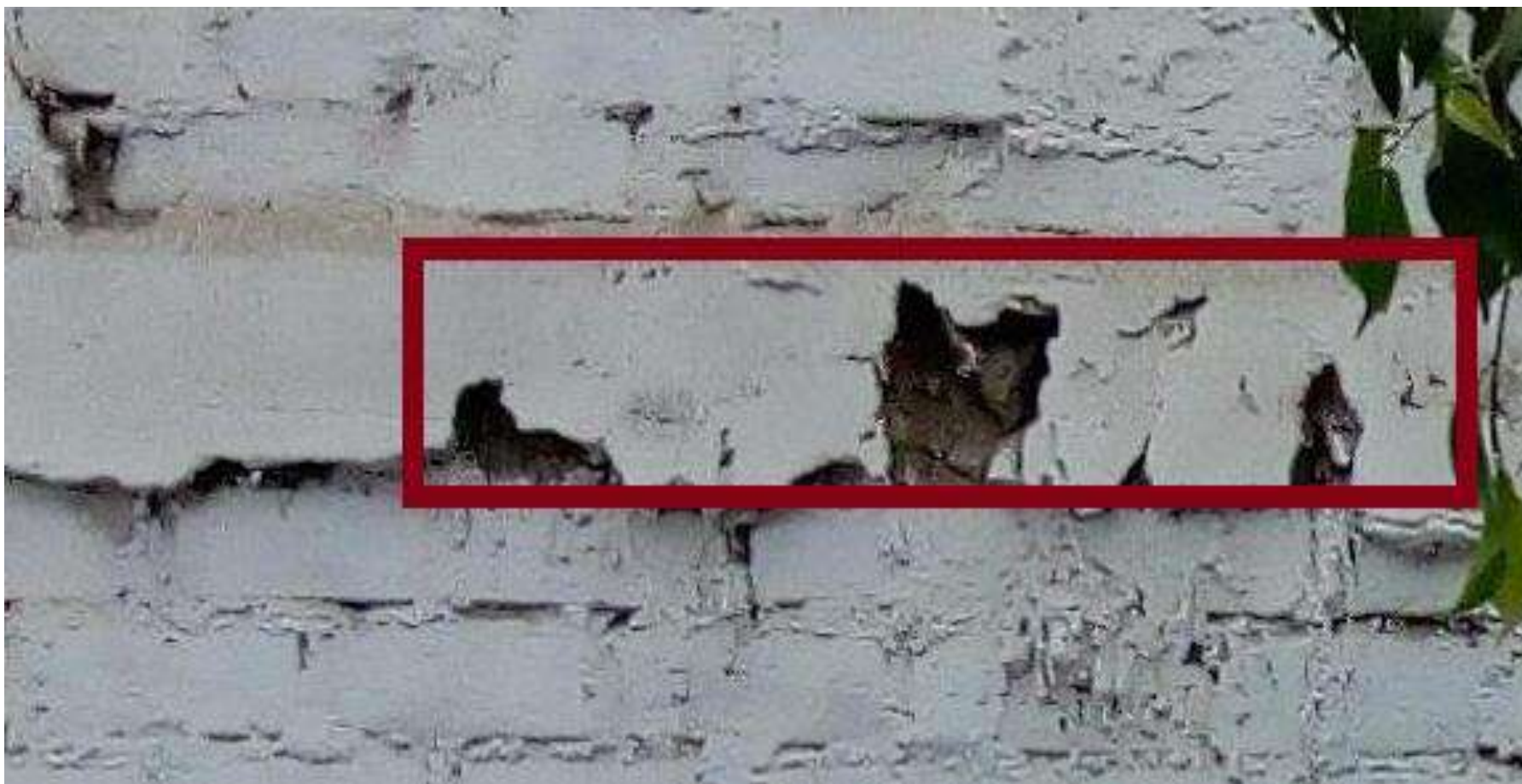
Fotografía 7: Viga afectada por desprendimiento en Unidad Muestral 05 paño 24.
