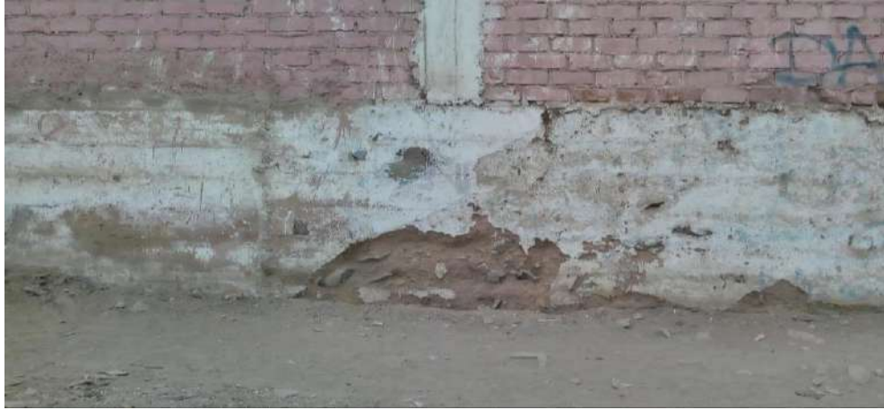
Figura 28. Desprendimiento en sobrecimiento del muro. Nota. Fuente: Elaboración propia. (2018).
