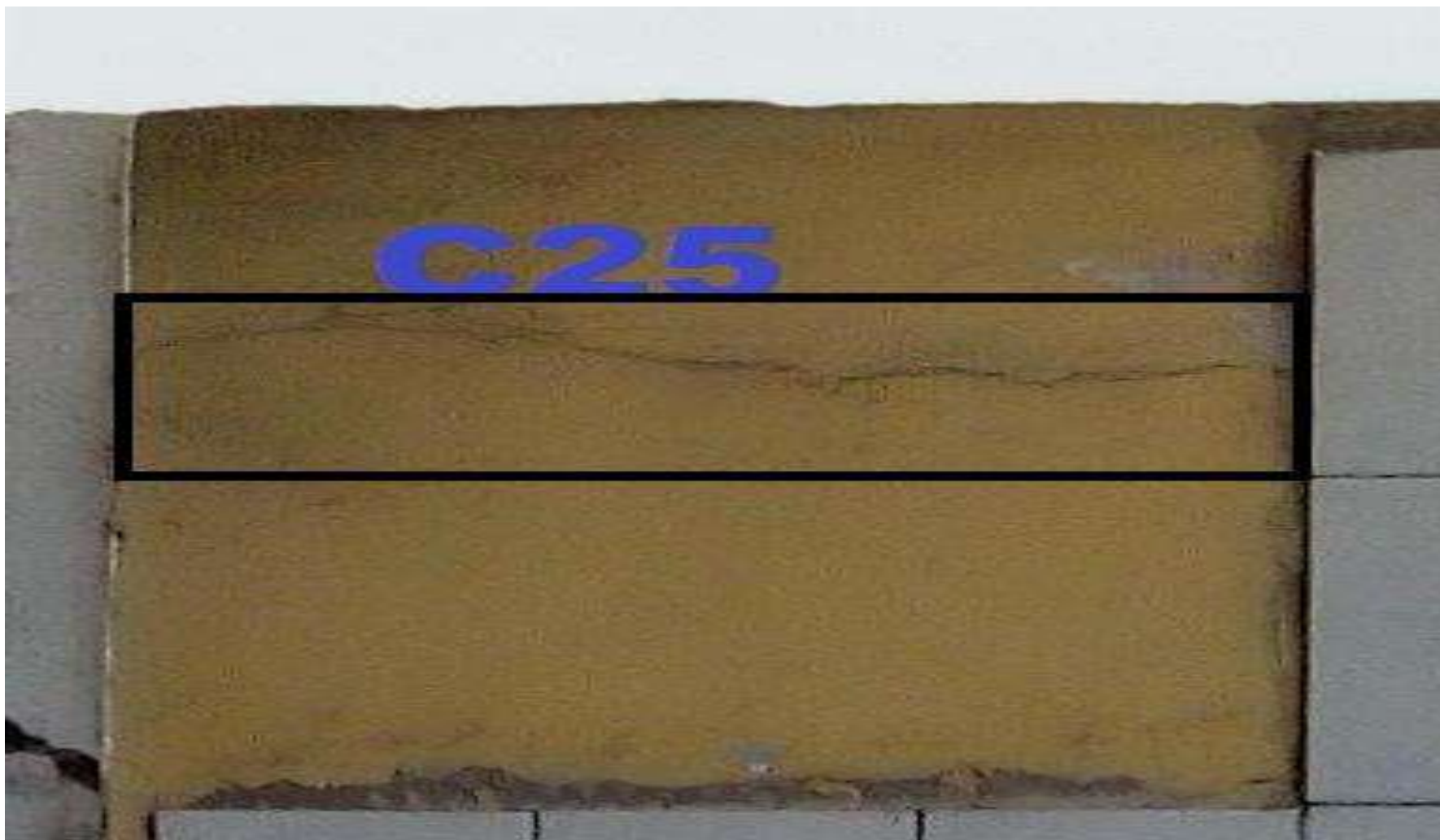
Fotografía 8: Columna C25, afectada por fisura en Unidad Muestral 04, paño 21.
