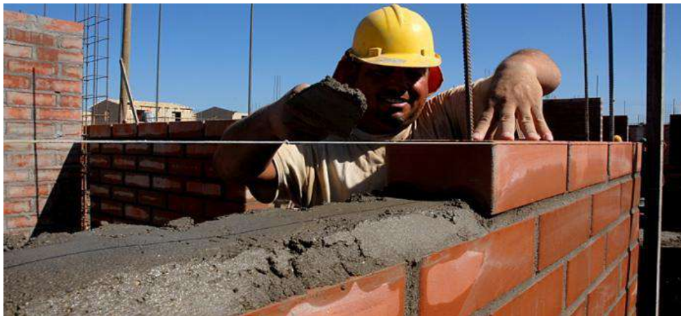
Figura 14. Albañil realizando la colocación del mortero para la colocación de la unidad de albañilería.
