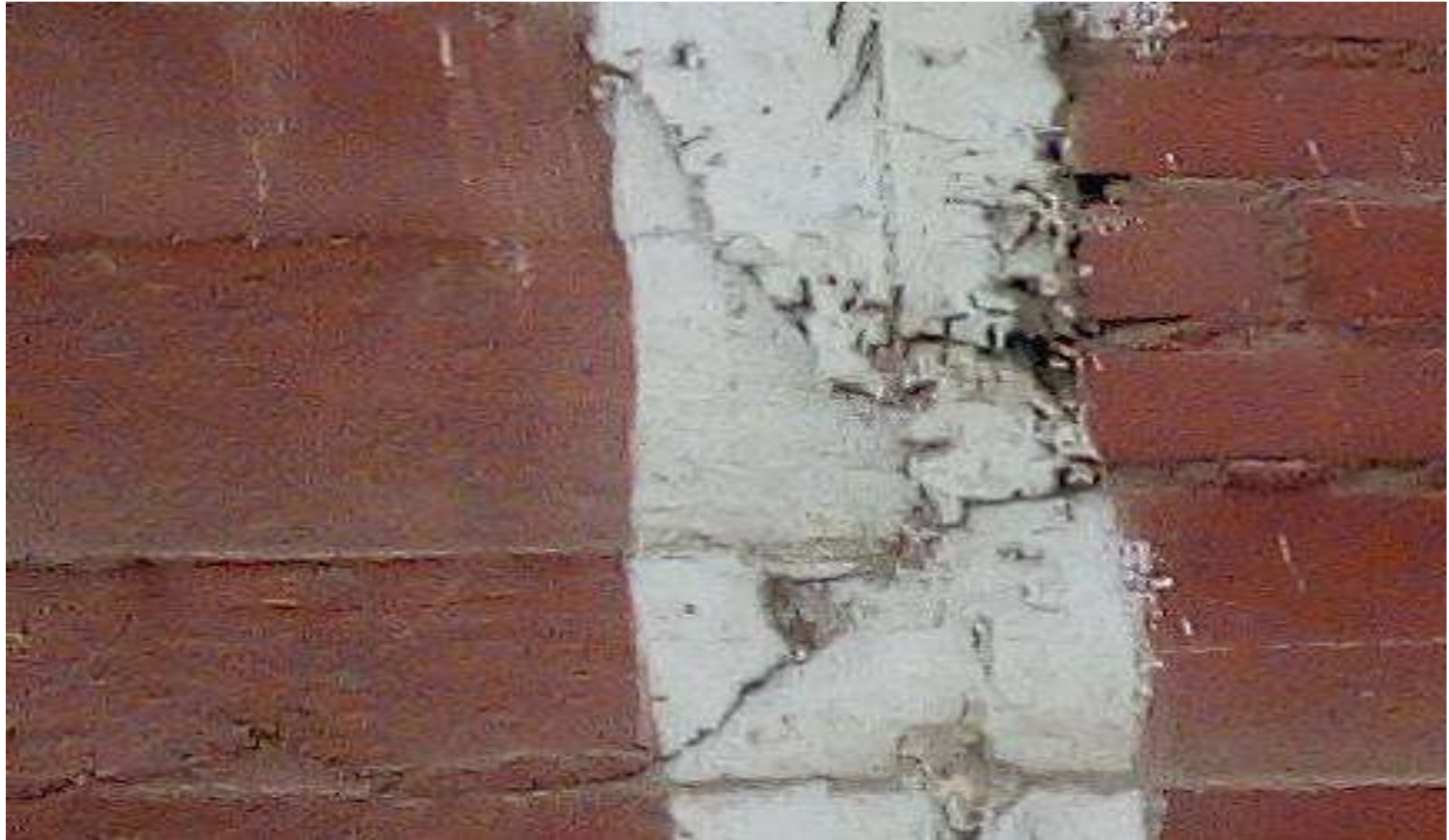
Fotografía 6: Columna C53, afectada por grieta en Unidad Muestral 06 paño 46.
