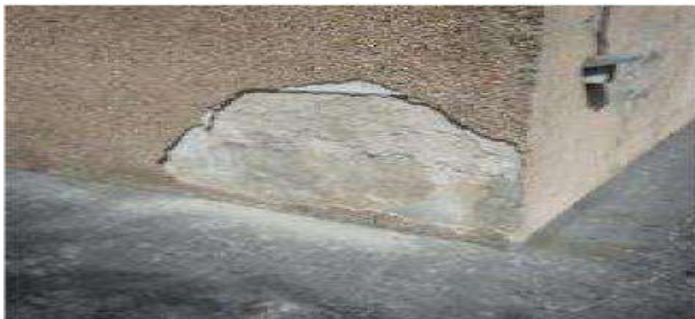
Figura 1. Detalle de fachada este. Piedra proyectada desprendida. Caso estudio 1.
