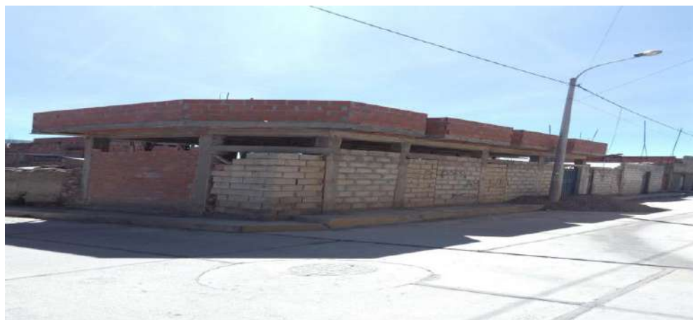
Figura 2. Construcción comercial – ubicación: Jr. Los geranios N°328 – Juliaca.- Afectación por errores en la Ejecución Dato. Fuente: Alexanders Barra M. (2016).
