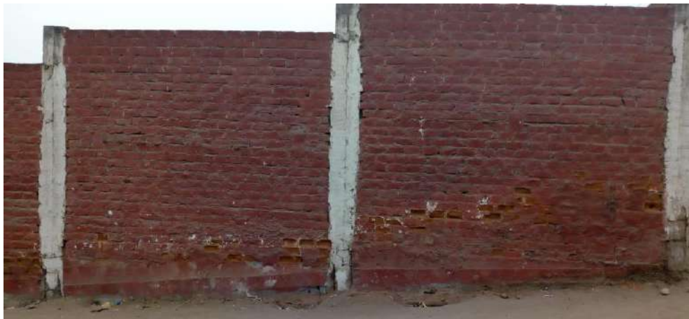
Figura 25. Muro de albañilería afectada por erosión física parcialmente en la parte inferior a consecuencia de los agentes atmosféricos. Nota. Fuente: Elaboración propia. (2018).
