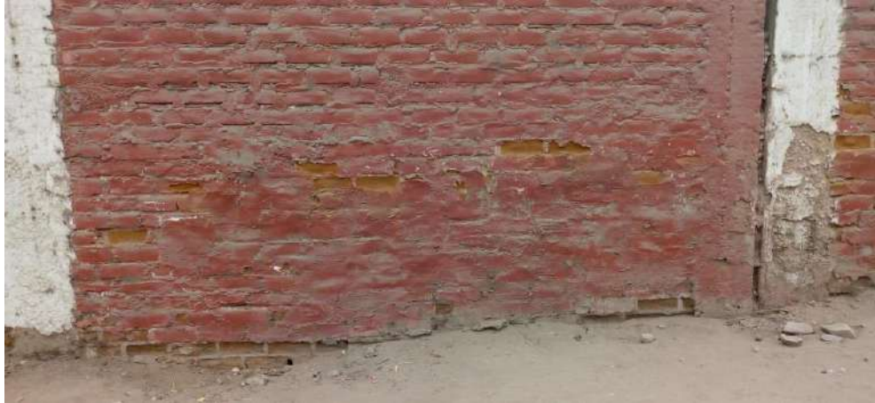
Figura 31. Muro de albañilería afectada por erosión química en la parte Inferior.
