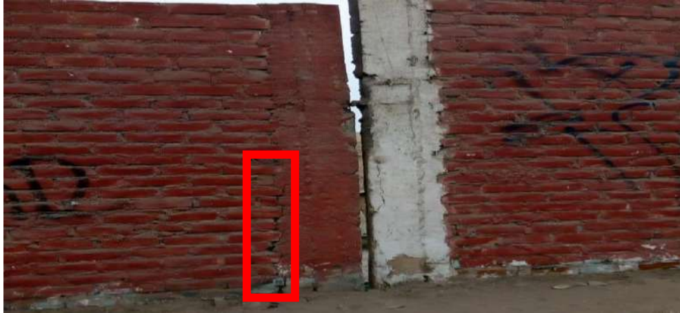
Figura 26. Grieta en muro de albañilería. Nota. Fuente: Elaboración propia. (2018).
