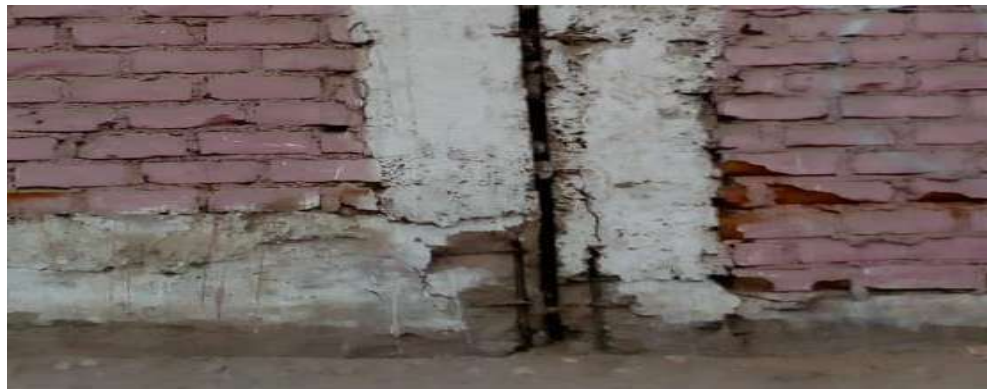
Figura 30. Acero de columna afectada por la corrosión. Nota. Fuente: Elaboración propia. (2018).
