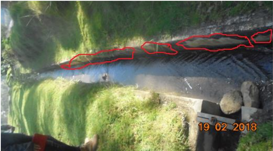
Fotografía 11: Eflorescencia en el margen derecha del canal.
