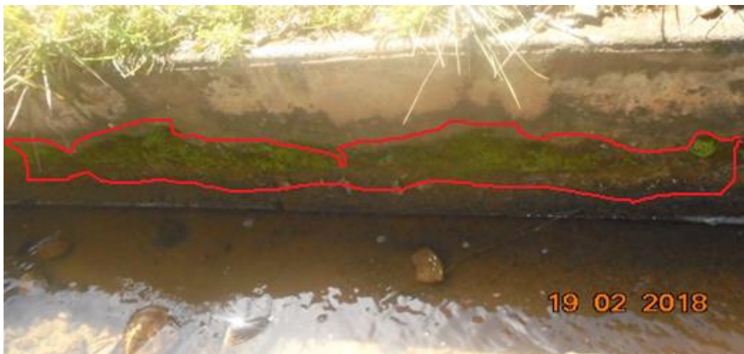
Fotografía 12: Moho en el margen Izquierda del canal.
