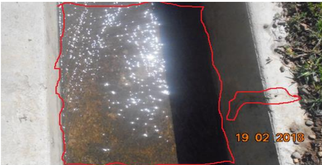
Fotografía 09: Erosión en el fondo del canal y fisura margen izquierda.
