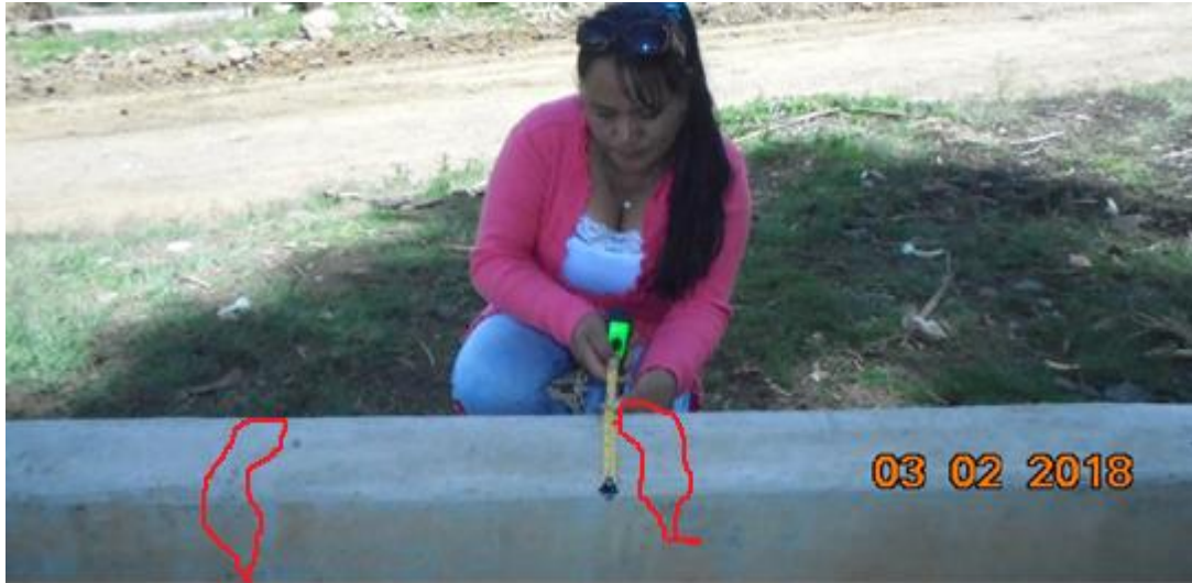
Fotografía 02: Fisura en margen derecha del canal
