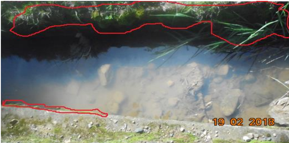
Fotografía 04: Moho en margen derecha e izquierda en el canal.
