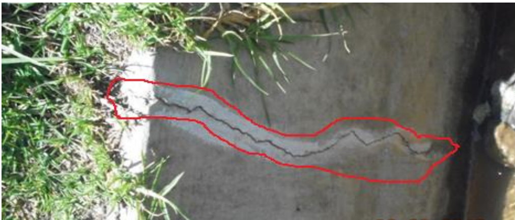
Fotografía 05: Grieta en margen izquierda del canal
