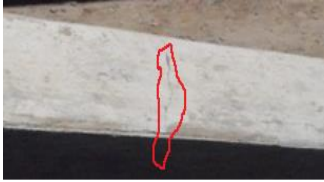
Figura 1. Signo de fisura severo.
