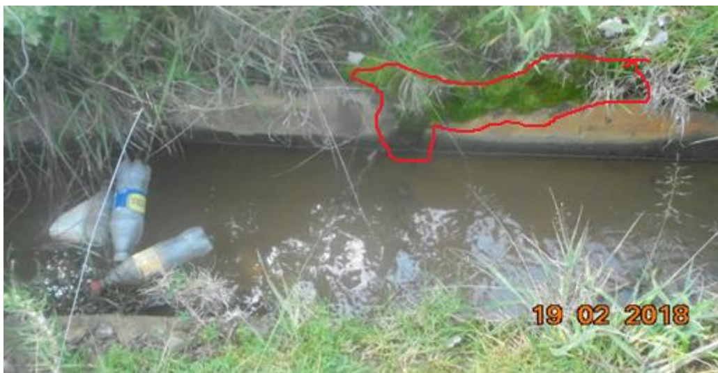
Fotografía 13: Moho en el margen derecha del canal.
