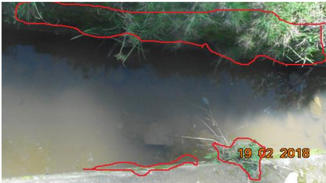
Fotografía 03: Moho en el margen Izquierda del canal riego
