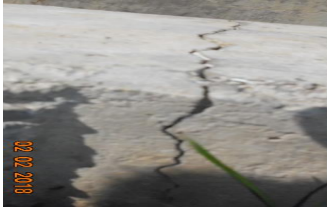
Figura 2. Signo de grieta severo.
