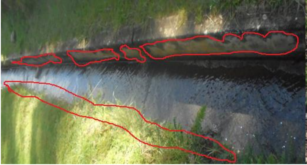
Fotografía 10: Eflorescencia en el margen izquierdo del canal.
