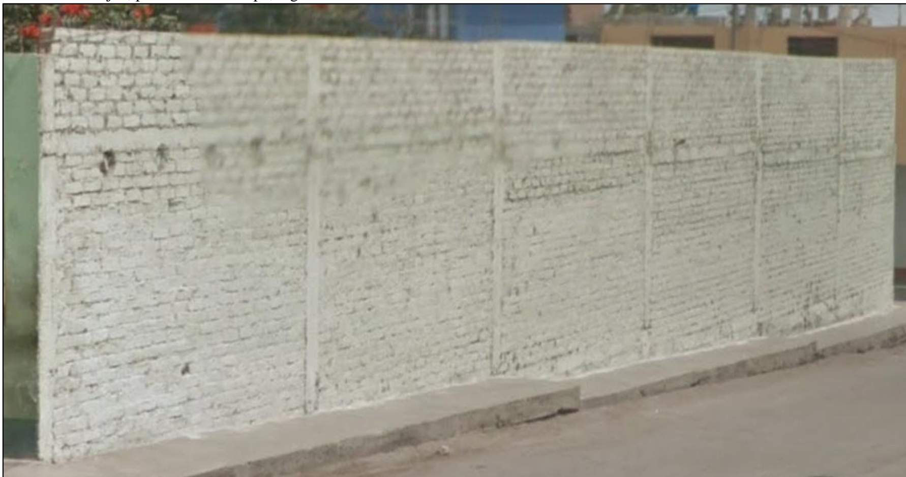
Fotografía 2: Tramo 3-4 del cerco perimétrico de la sede del Ministerio de Agricultura, ubicado en la auxiliar Panamericana Norte 142-209 en el distrito Paján, provincia de Ascope, región de La Libertad.
