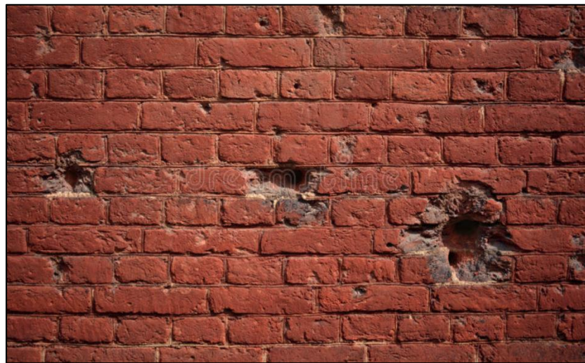
Figura 21. Muro con presencia de erosión mecánica debido al impacto de proyectiles.
