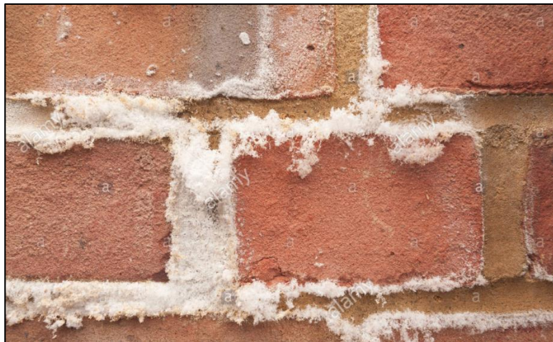
Figura 22. Muro con presencia de eflorescencia en las juntas de mortero.
