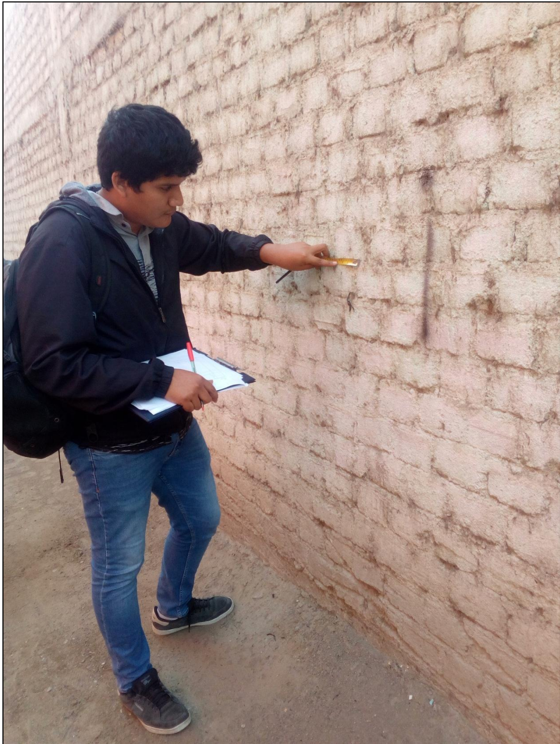
Fotografía 11: Presencia de grietas en la albañilería en la UM-7.
