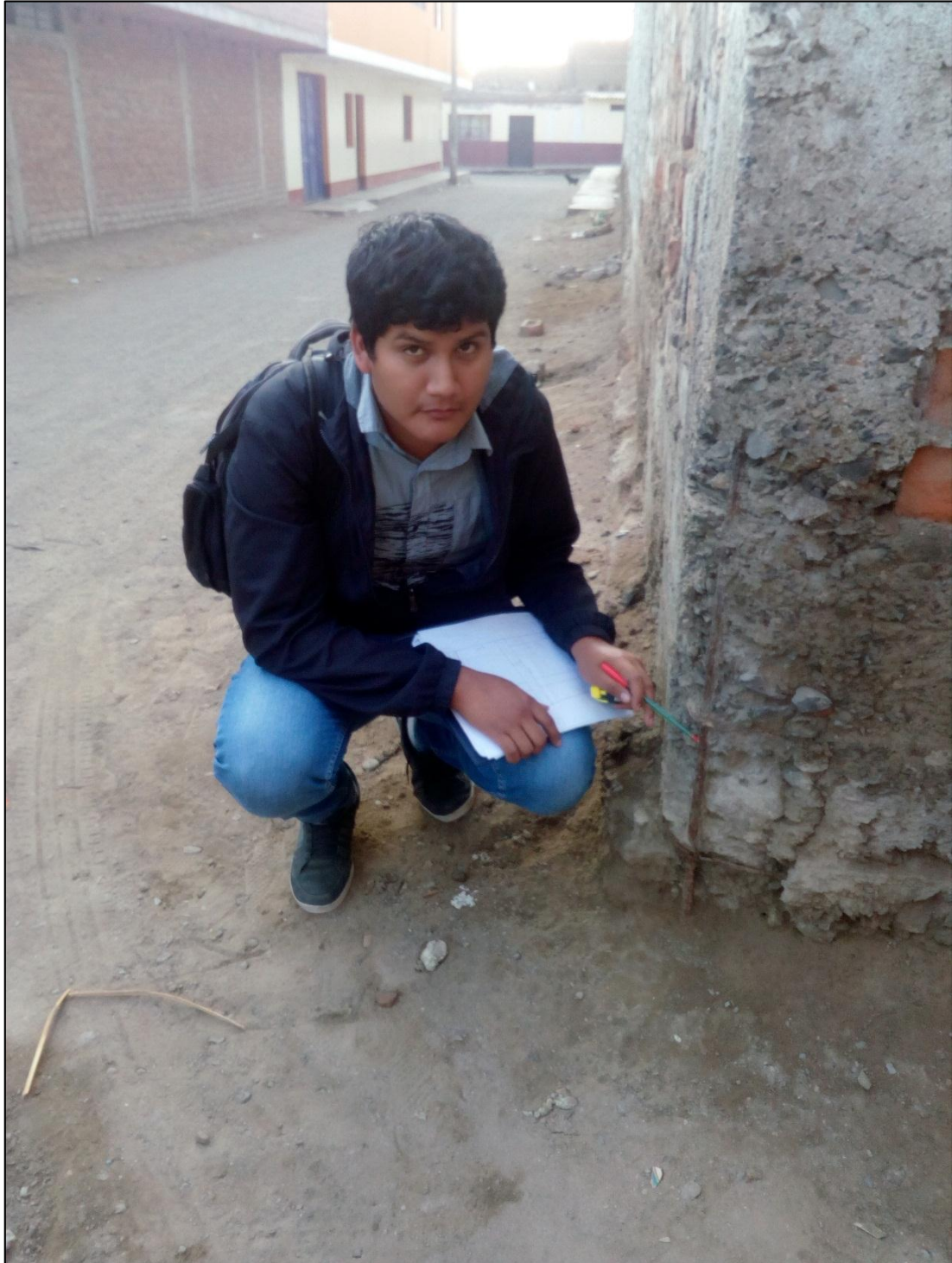
Fotografía 10: Presencia de corrosión en el acero estructural, en la zona inferior de la columna en la UM-12.
