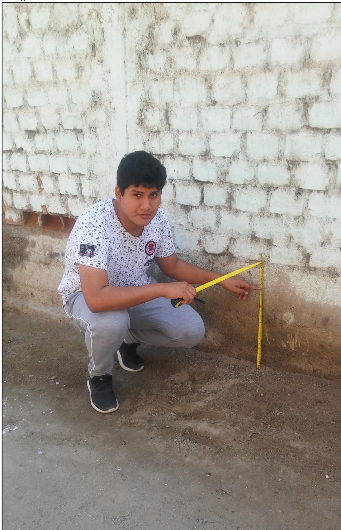
Fotografía 12: Presencia de eflorescencia en el sobrecimiento en la UM-12.
