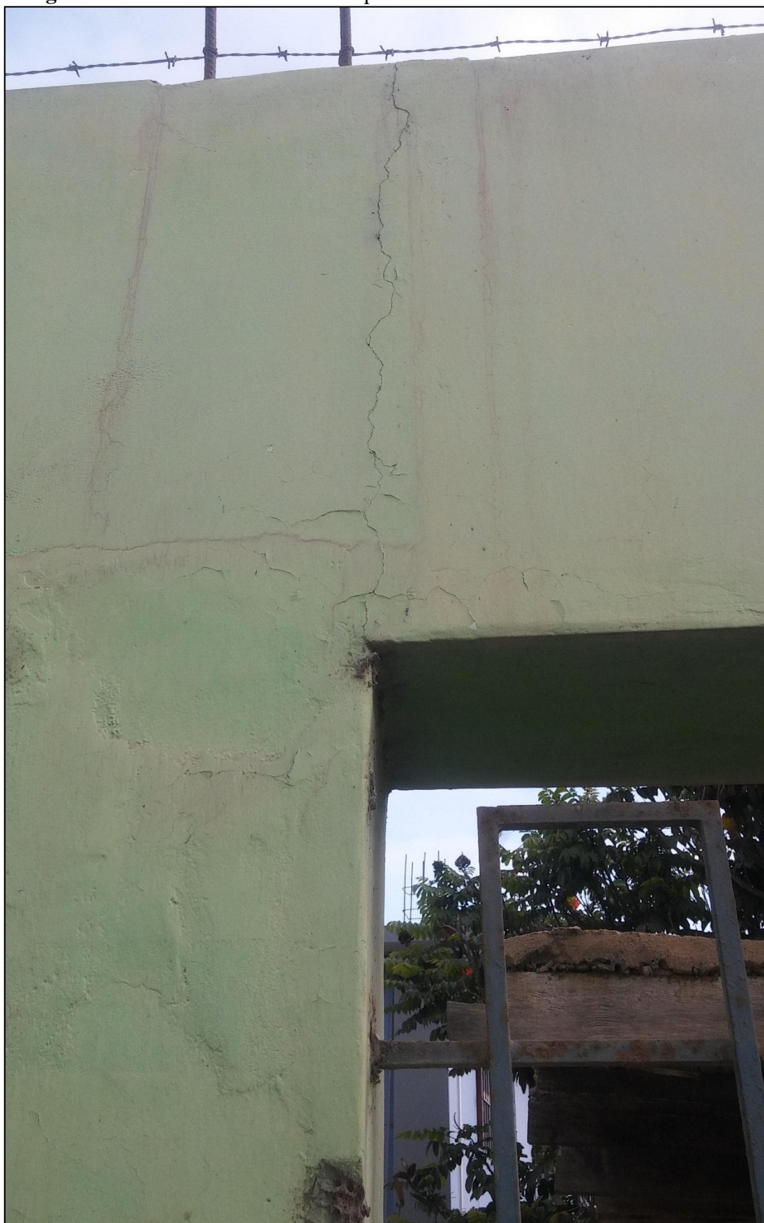
Fotografía 6: Presencia de fisuras en el pórtico de concreto armado en la UM-4.
