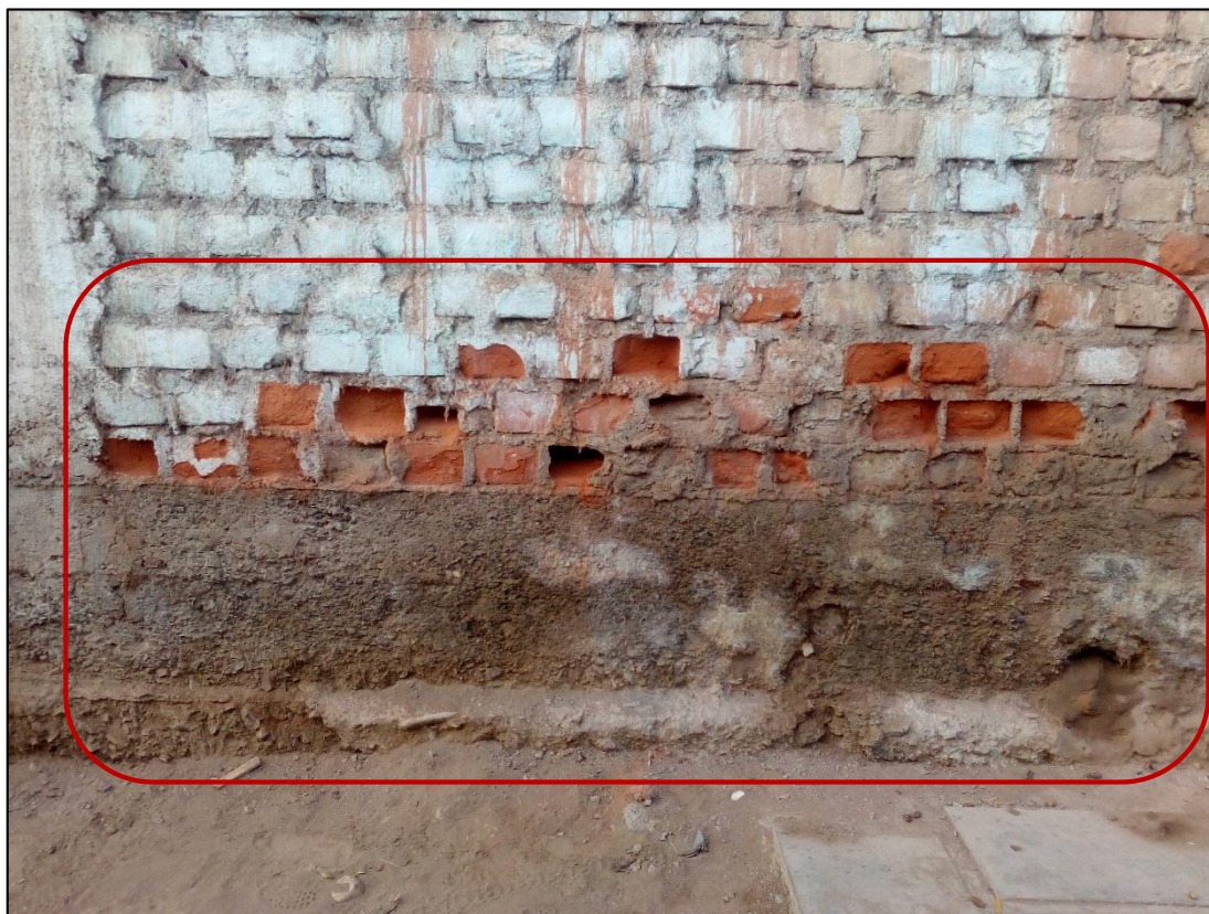
Fotografía 7: Albañilería y sobrecimiento afectados por erosión física química en la UM-11.
