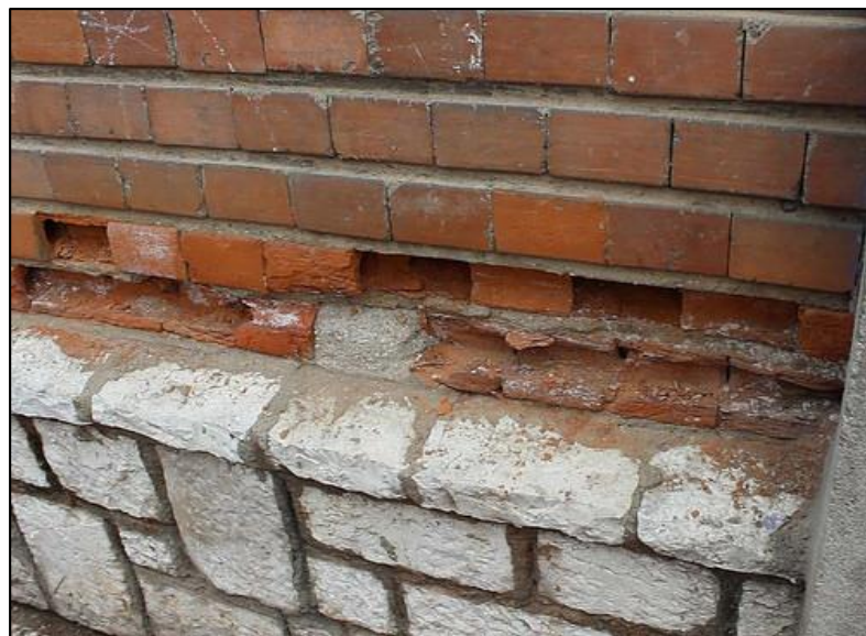
Figura 18. Muro de albañilería afectado con erosión física por agua.
