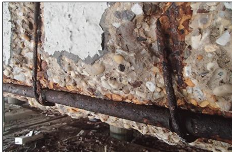
Figura 23. Columna deteriorada por la corrosión del acero.
