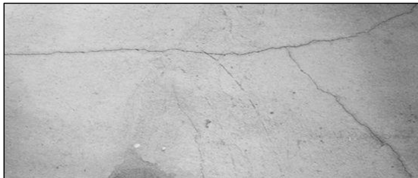
Figura 19. Fisuras por retracción hidráulica en el concreto.
