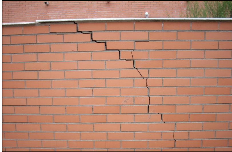
Figura 20. Grieta en muro divisorio de patio de parcela por deformación del apoyo de su cimiento.
