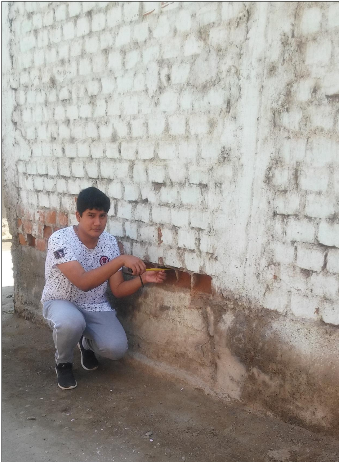
Fotografía 9: Albañilería afectada por erosión física química en la UM-12.
