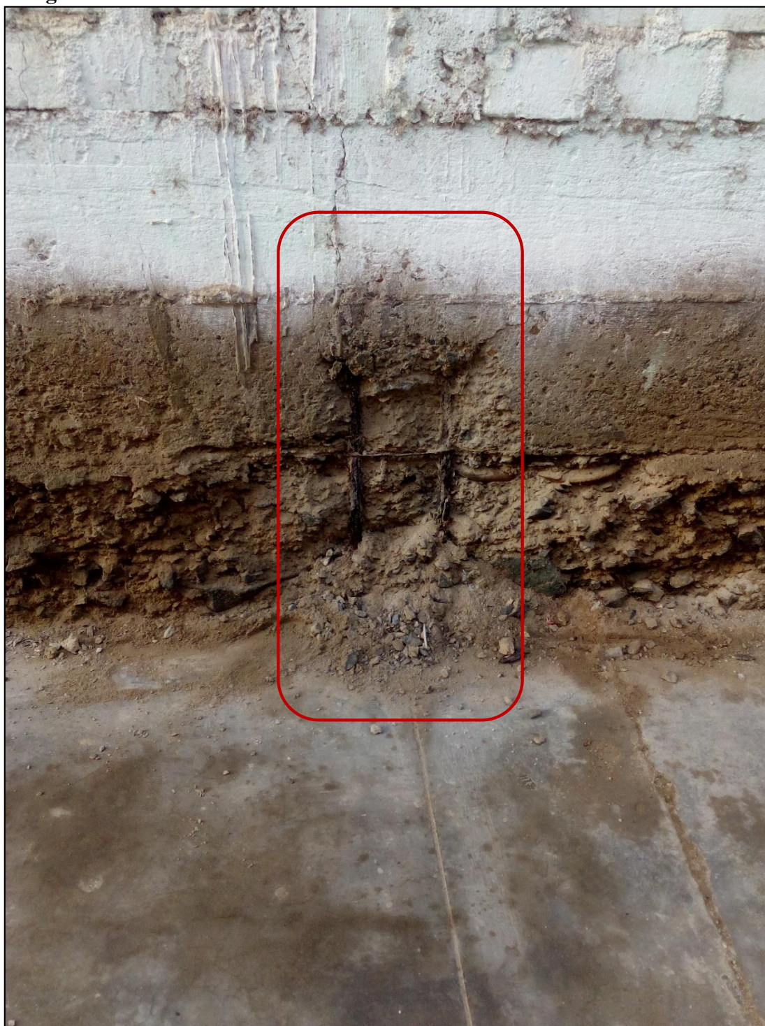
Fotografía 5: Corrosión en el acero estructural de la columna en la UM-9.
