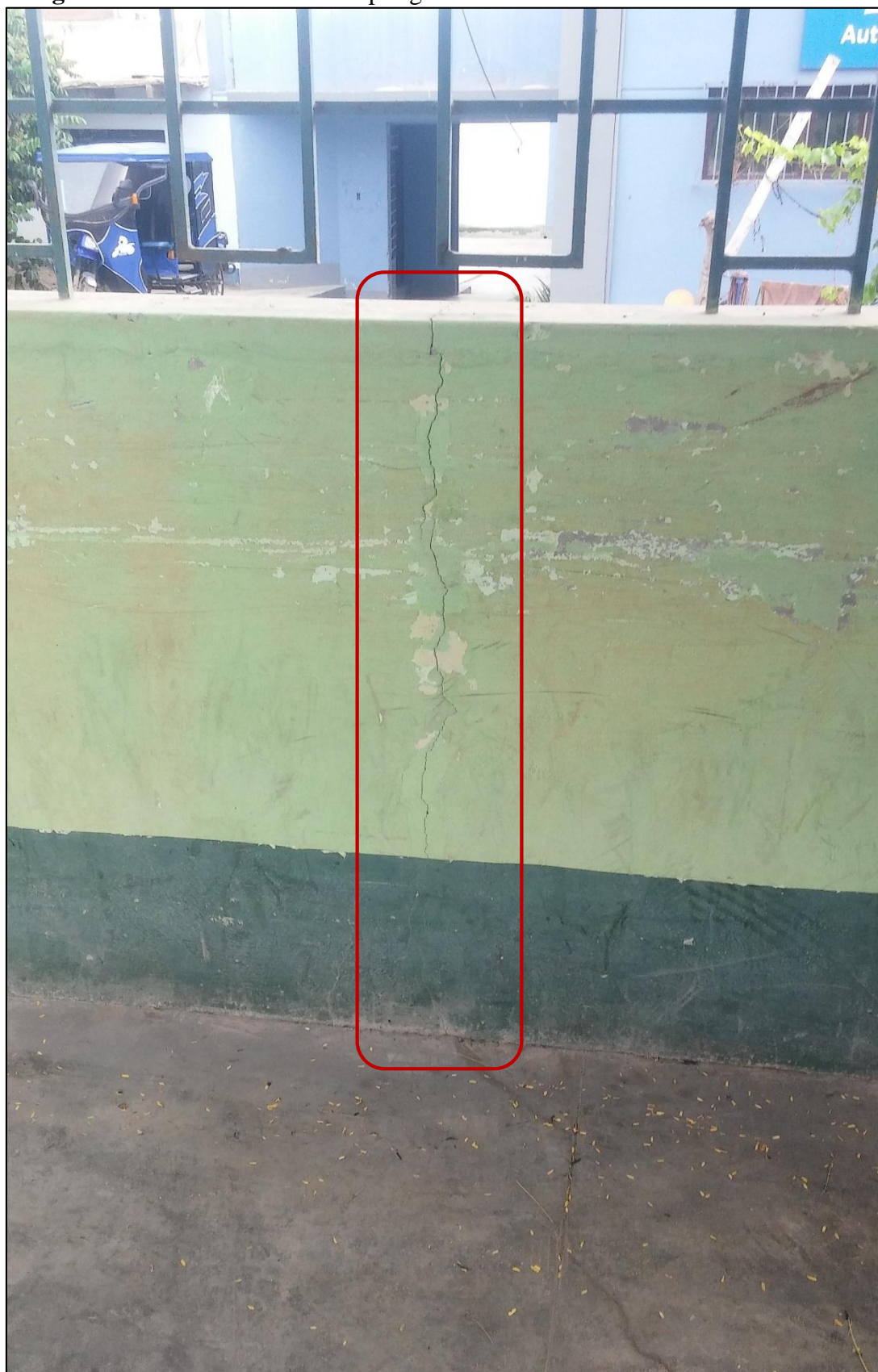
Fotografía 4: Albañilería afectada por grieta en la UM-3.
