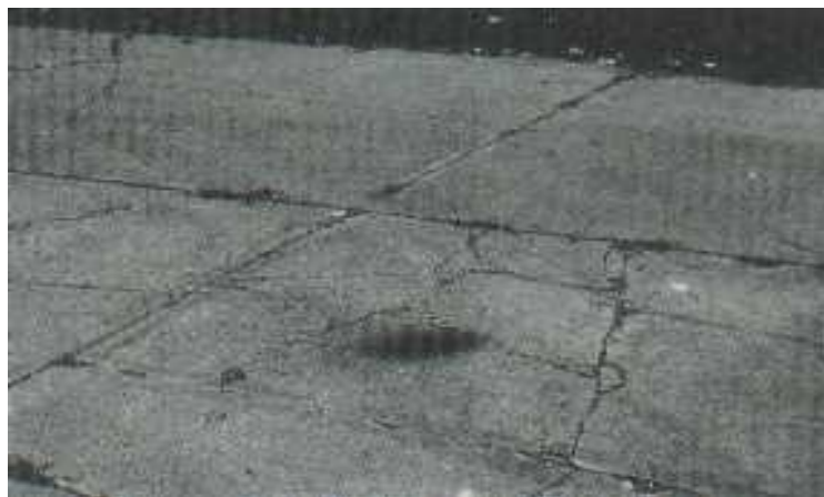
Figura 18: Losa dividida de alta severidad.
