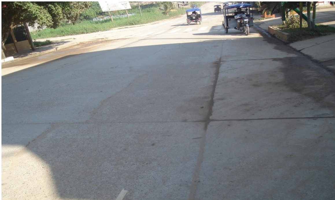
Figura N° 113: Vista de Patologías en la cuadra 04 del Jirón Cahuide
