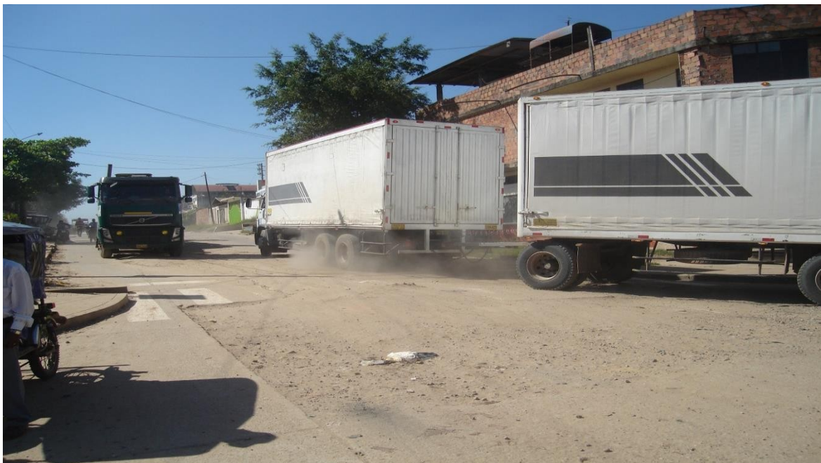
Figura N° 99: Vista de Patologías en la cuadra 01 del Jirón Cahuide
