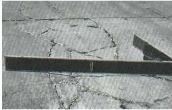
Figura 25: Punzonamiento de alta severidad.
