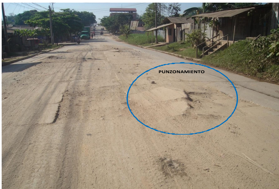
Figura N° 108: Vista de Patologías en la cuadra 03 del Jirón Cahuide
