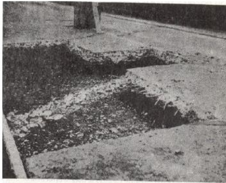
Figura 29: Parchero de concreto
