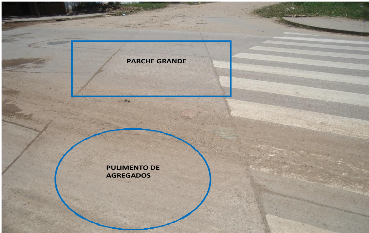
Figura N° 112: Vista de Patologías en la cuadra 04 del Jirón Cahuide
