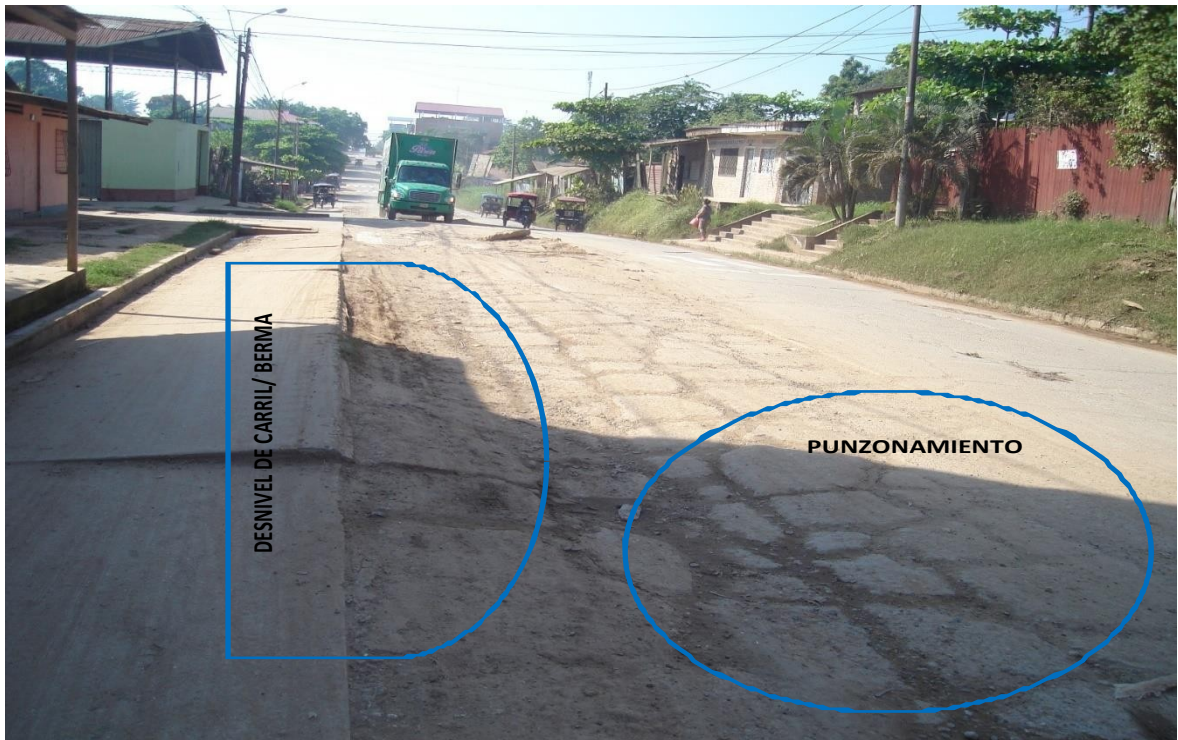
Figura N° 105: Vista de Patologías en la cuadra 02 del Jirón Cahuide
