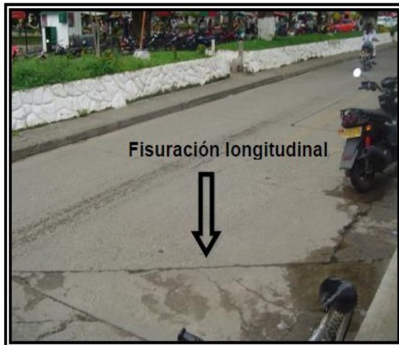
Figura 02. Fisuración y descascamiento por intervención de las empresas de servicio públicos.
