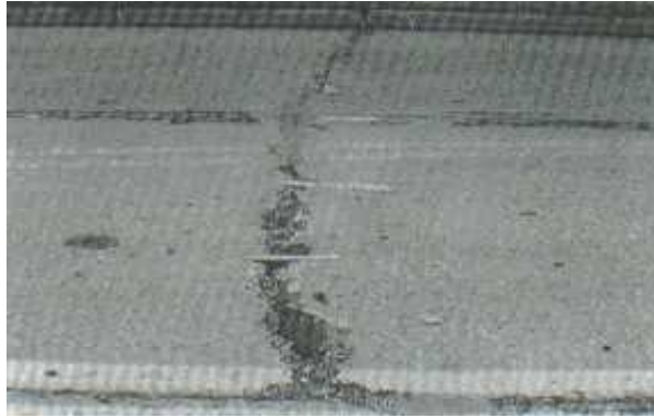
Figura 21: Grietas lineales de alta severidad en losa de concreto simple
