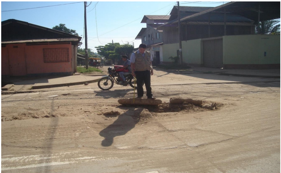
Figura N° 106: Vista de Patologías en la cuadra 02 del Jirón Cahuide
