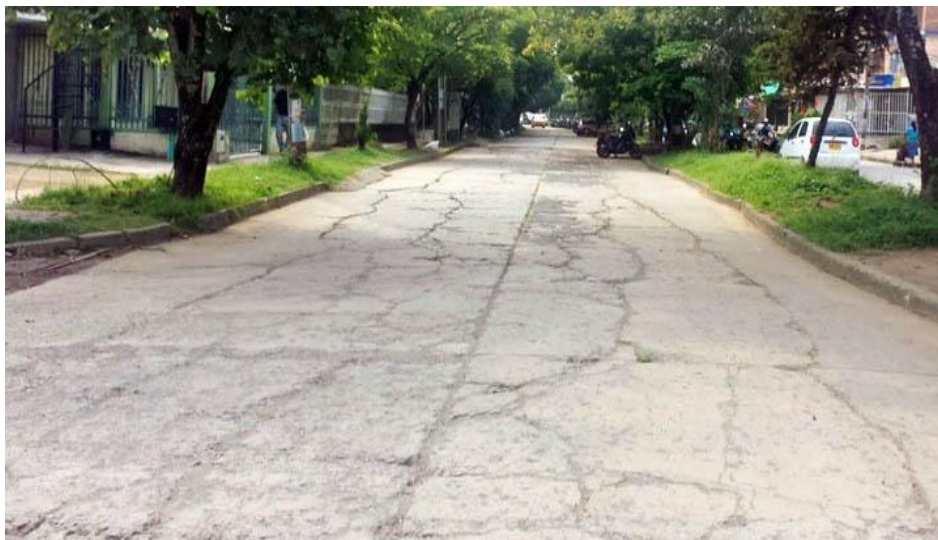
Figura 1 pavimento rígido deteriorado- Nicaragua
