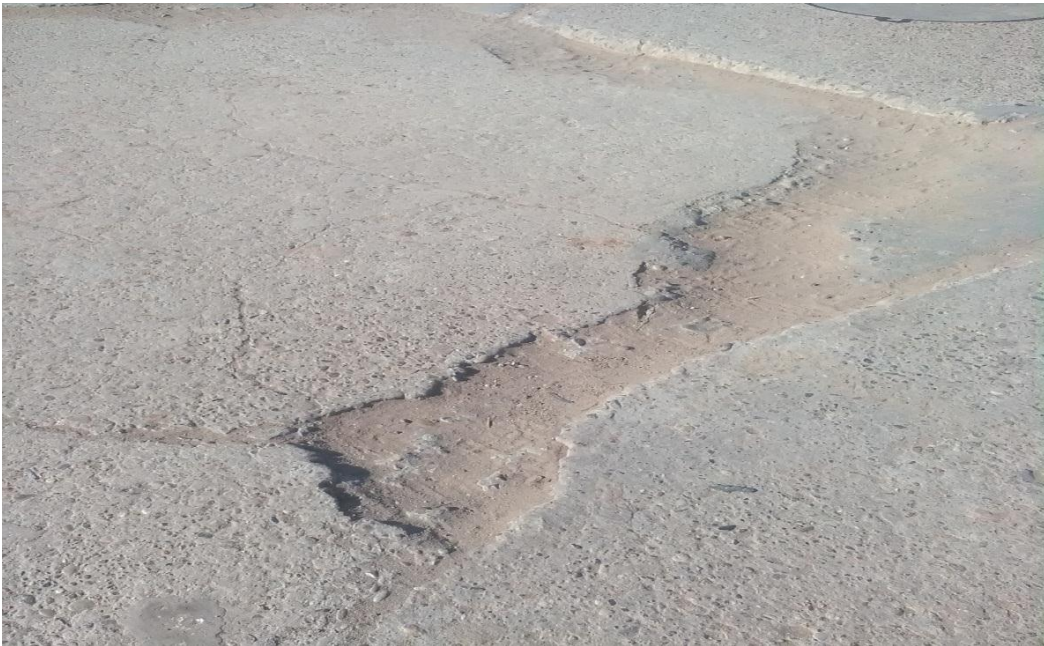
Grieta de esquina
