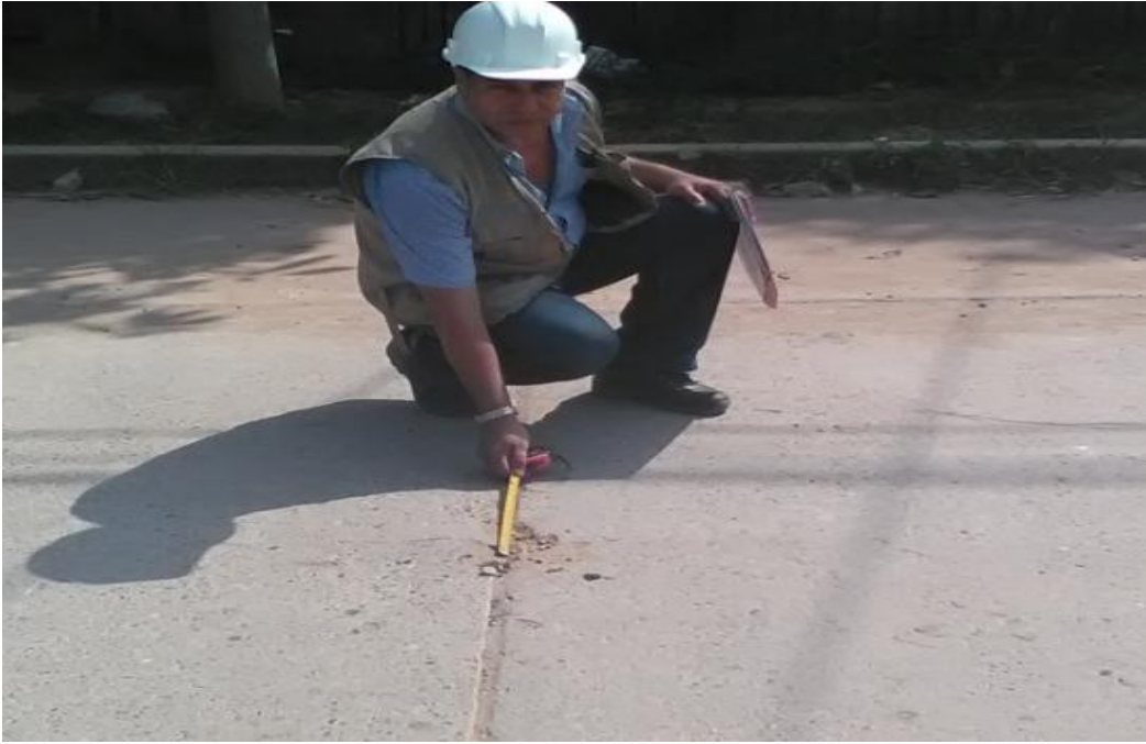
Daño de sello de junta
