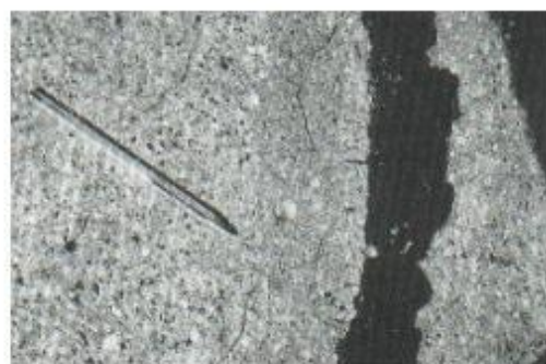
Grieta de durabilidad
