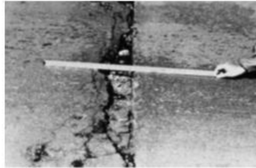
Daño del daño de junta
