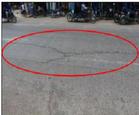
Figura 44. Patología de grieta lineal con nivel de severidad media; en la cuadra 4 del Jr. Ucayali, distrito de Callería.
