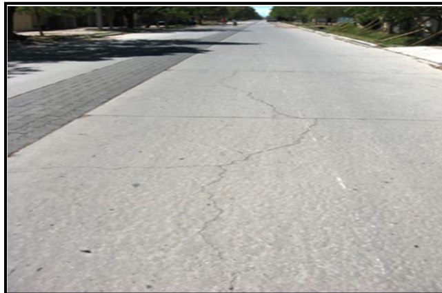
Figura N° 11. Gráfico de falla superficial de pavimento rígido
