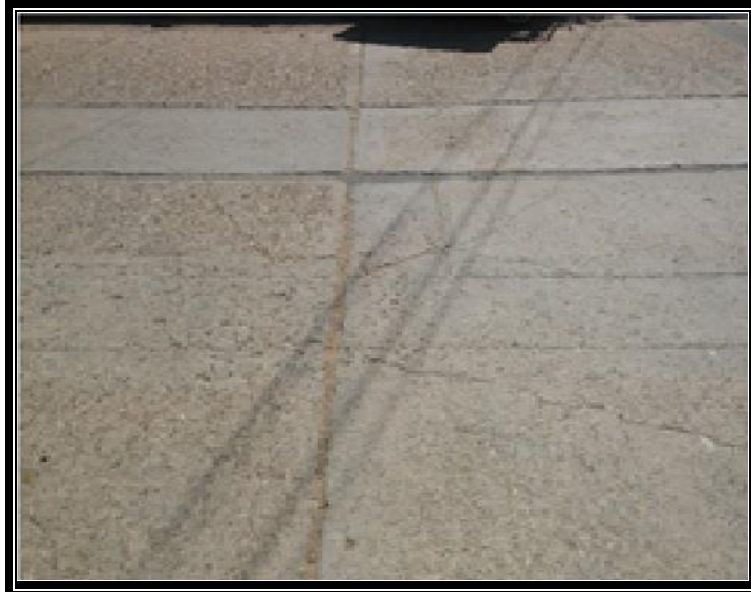
(pulimento de agregado, grieta de esquina,parche grandes) del jirón Atahualpa (2017)
