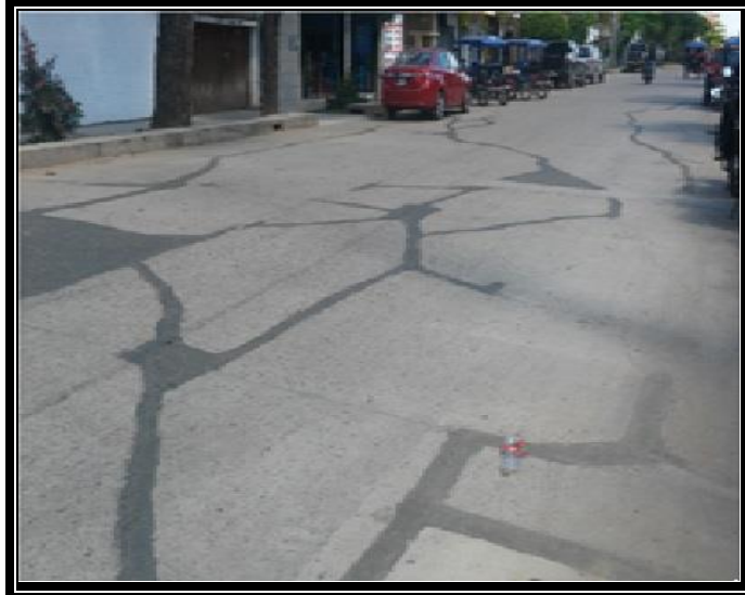
(Losas dividida , grietas lineales ,parches pequeños) del jirón Atahualpa (2017)
