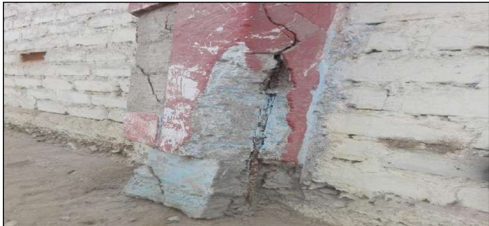
Figura 20. Grieta longitudinal en columna de concreto del cerco Perimétrico de la Institución Educativa Inicial 520.
