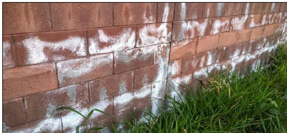
Figura 23. Estructura del cerco perimétrico con presencia de Eflorescencia en la parte inferior.
