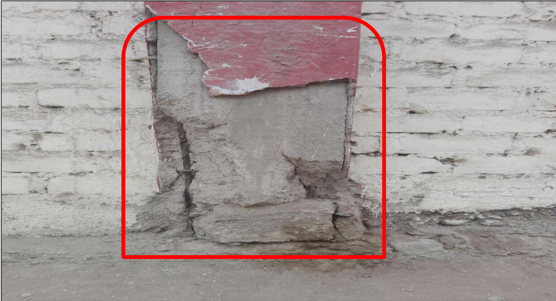
Fotografía 9: Columna afectada por desprendimiento en la unidad muestral 7.
