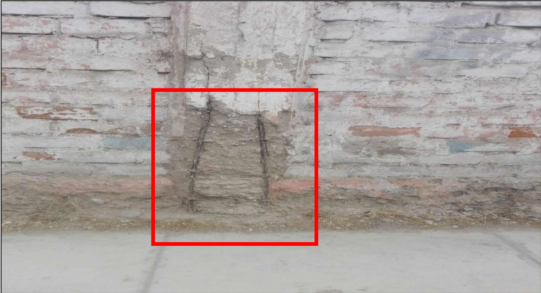
Fotografía 8: Acero de la columna afectada por corrosión en la unidad muestral 10.
