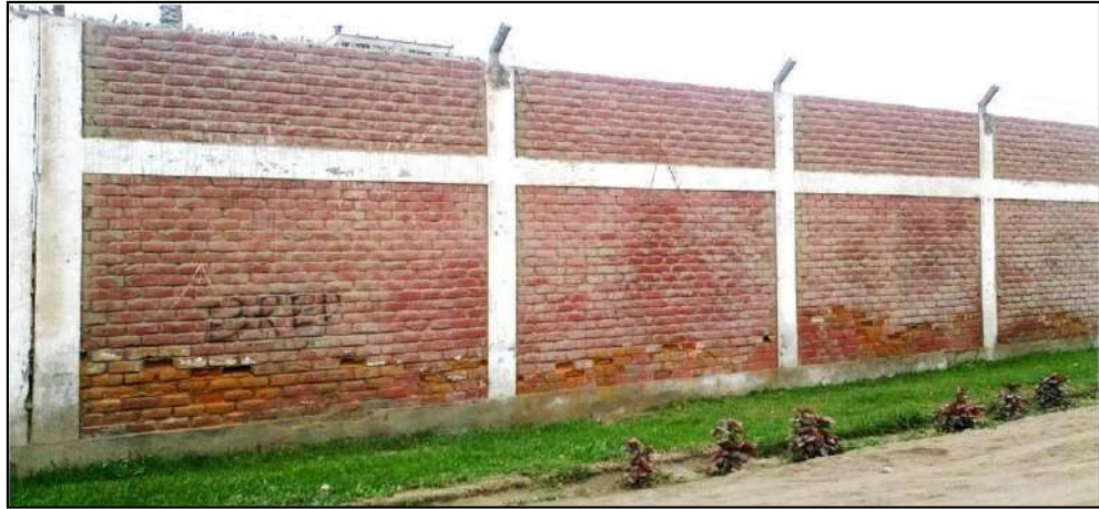
Figura 5. Patologías que afectan la estructura de albañilería confinada del cerco perimétrico del local de la industria papelera Quimpac del distrito de Paramonga, provincia de barranca, región lima.
