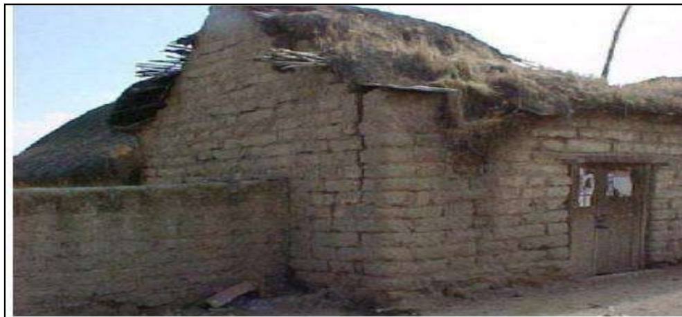
Figura 2. Agrietamiento en la parte superior de las esquinas de una construcción de adobe. Nota. Cabrera y Plaza. (2014).
