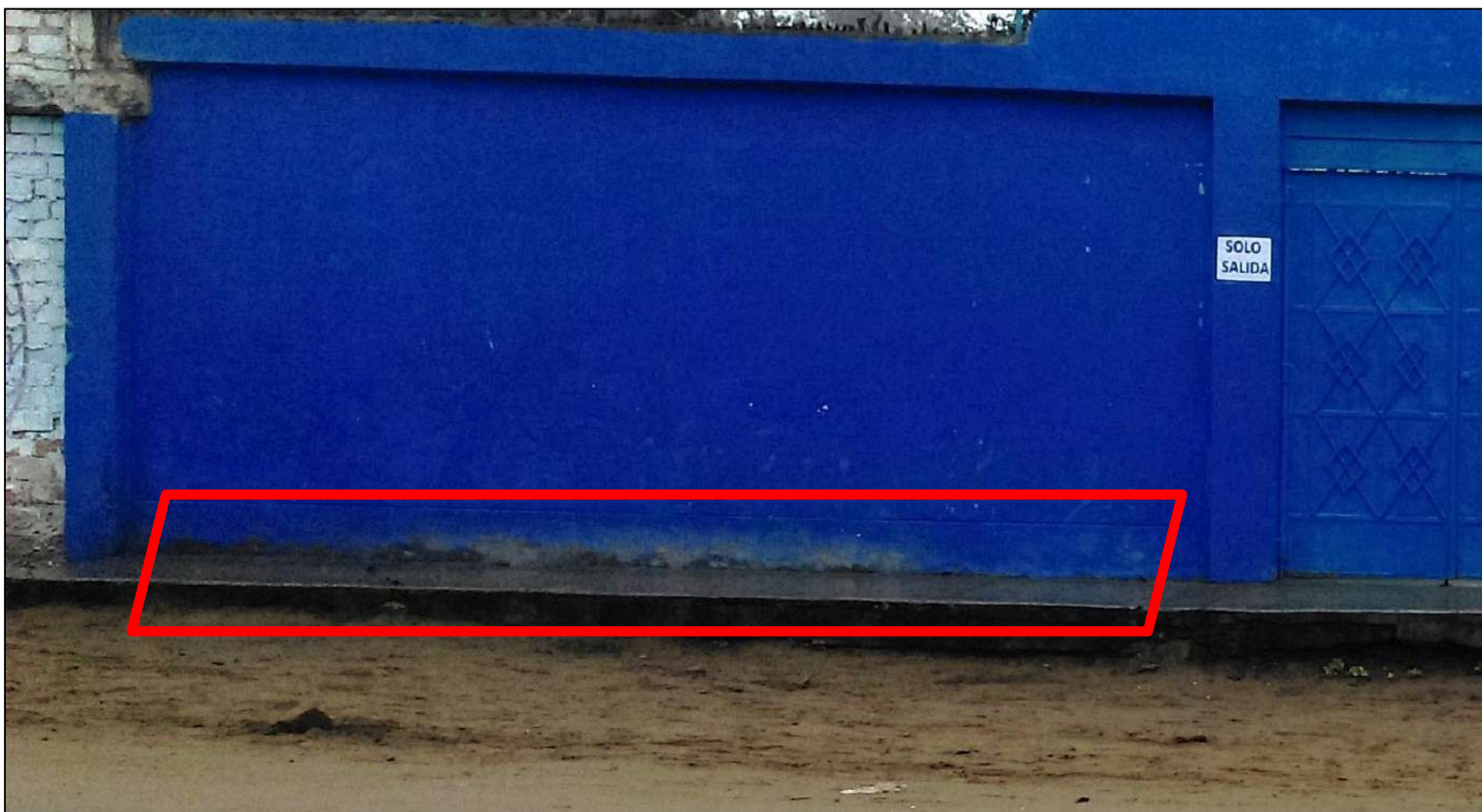
Fotografía 10: Albañilería afectada eflorescencia en la unidad muestral 9.
