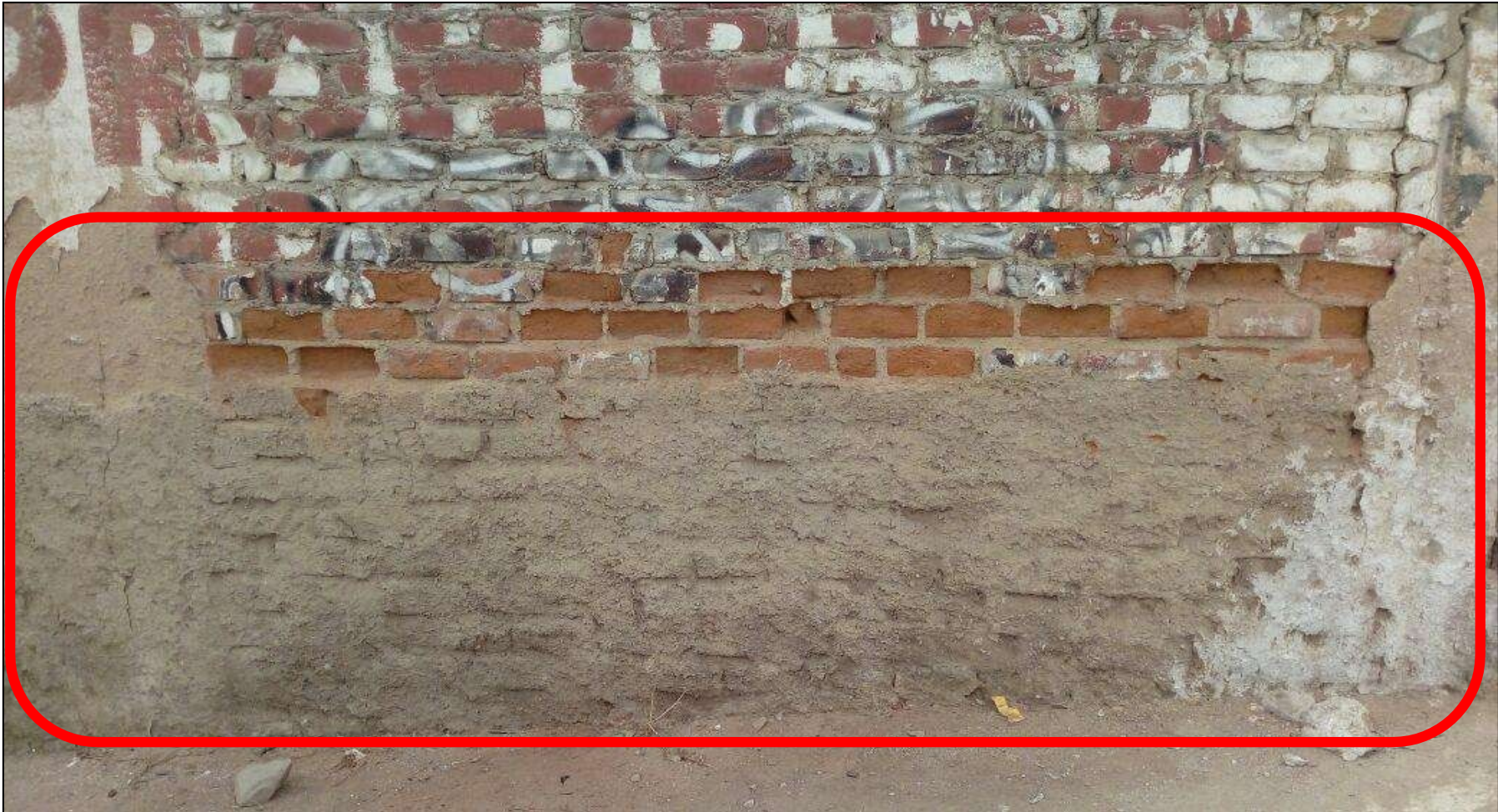
Fotografía 6: Albañilería y columna afectada por erosión física - química en la unidad muestral 14.
