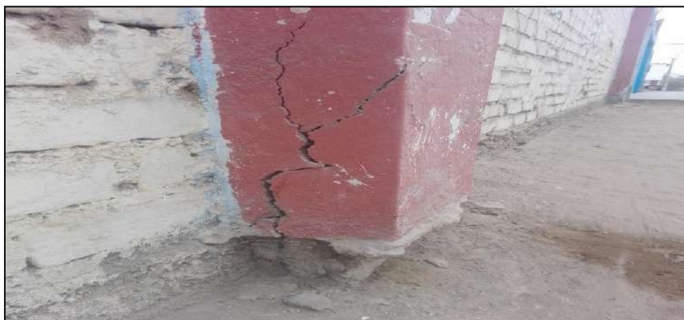
Figura 19. Vista de la formación de grieta longitudinal en columna de concreto del cerco perimétrico de la Institución Educativa Inicial 520. Nota. Fuente: Elaboración propia (2018).
