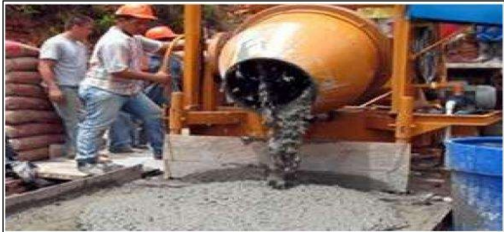
Figura 12. Imagen de Concreto Nota. Elaboración propia. (2018).
