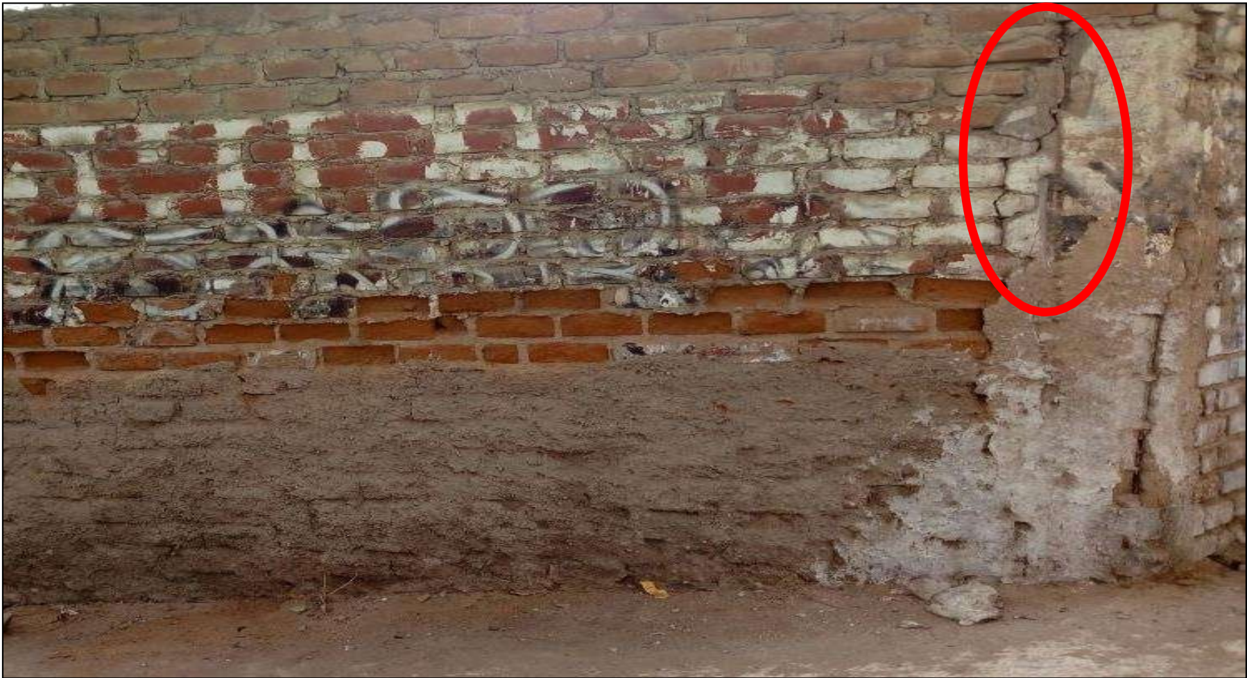
Fotografía 7: Albañilería afectada por grieta en la unidad muestral 14.
