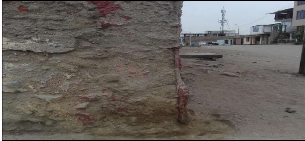
Figura 25. Muro de albañilería afectada por erosión química en la parte inferior producto de un suelo salitroso y húmedo en el cerco perimétrico de la Institución Educativa Inicial 520.
