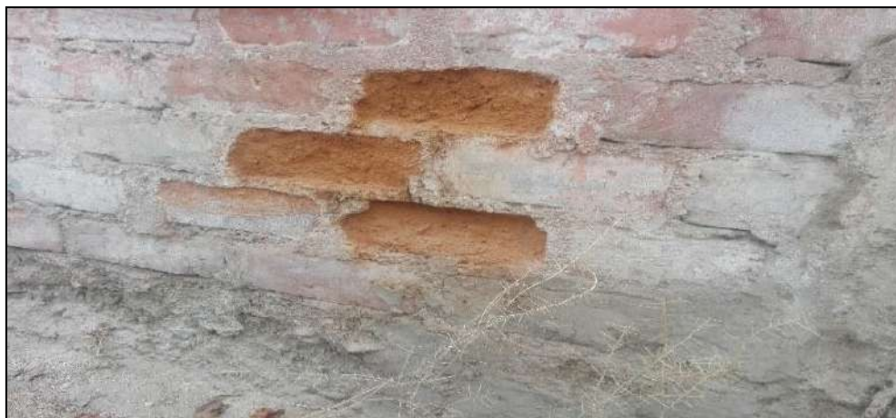
Figura 17: Muro con erosión del cerco perimétrico de la Institución Educativa Inicial 520.
