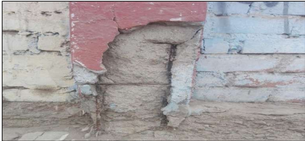
Figura 24. El acero de la columna del cerco perimétrico de la Institución Educativa Inicial 520, afectada por la corrosión provocada por el desprendimiento del concreto.
