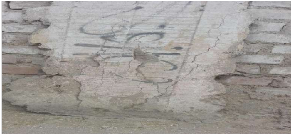
Figura 21. Aparición de fisuras en la columna del cerco perimétrico de la Institución Educativa Inicial 520, a consecuencia de acciones mecánicas. Nota. Fuente: Elaboración propia. (2018).
