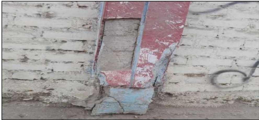
Figura 22. Desprendimiento del tarrajeo por mala adherencia en la Columna del cerco perimétrico de la Institución Educativa Inicial 520.
