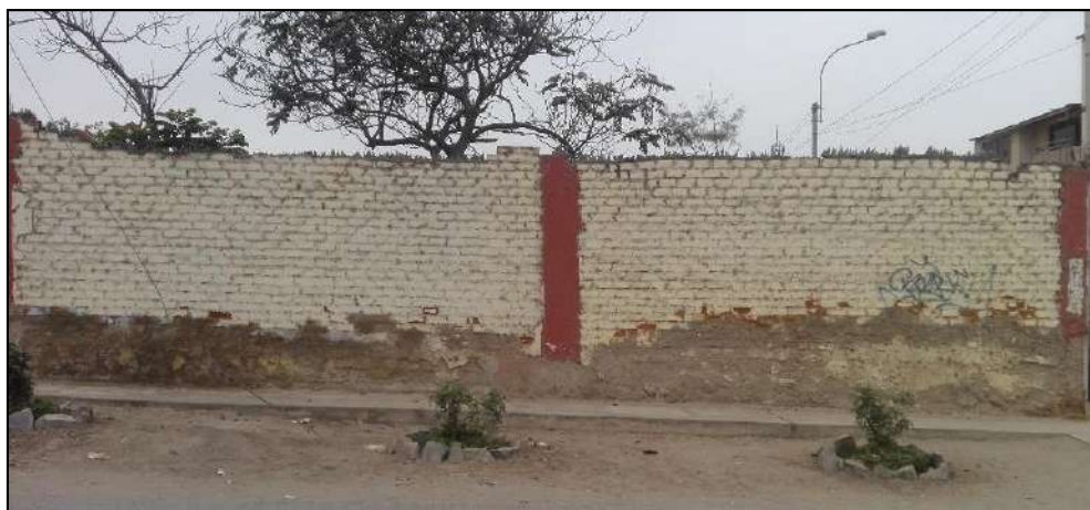
Figura 18. Erosión química en muro y sobrecimiento del cerco perimétrico de la Institución Educativa Inicial 520.
