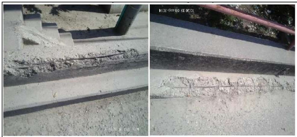
Figura 1. Patologías apreciadas en andenes y bordillos desportillados, acero Expuesto y corrosión del mismo.
