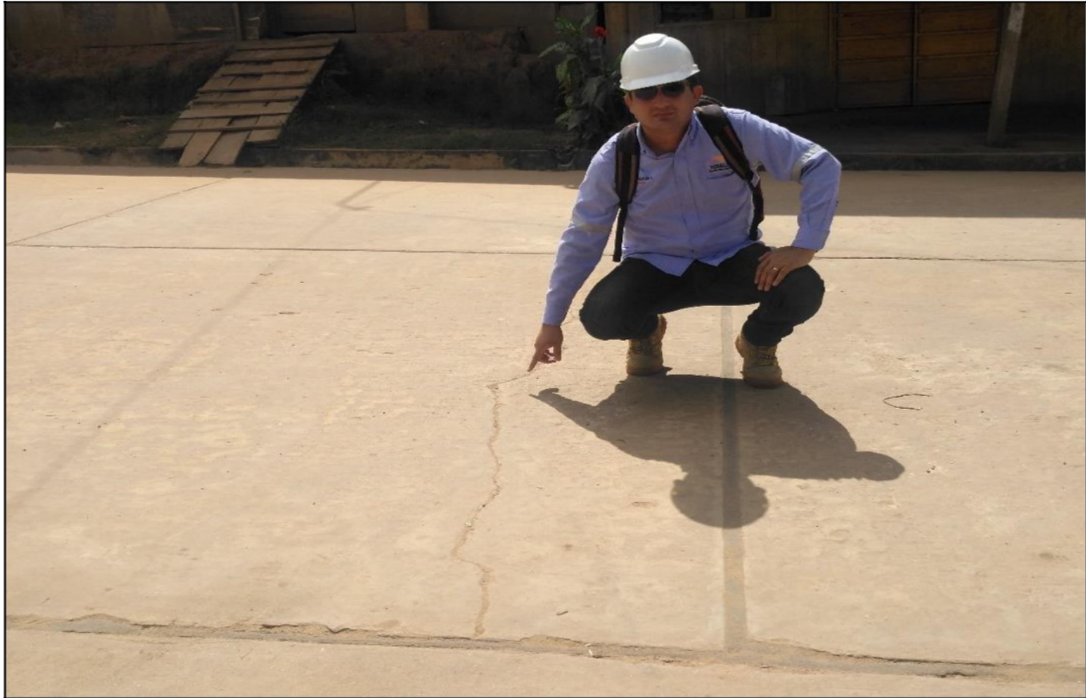
Figura 64: Vista panorámica de la patología Grieta Lineal severidad baja
