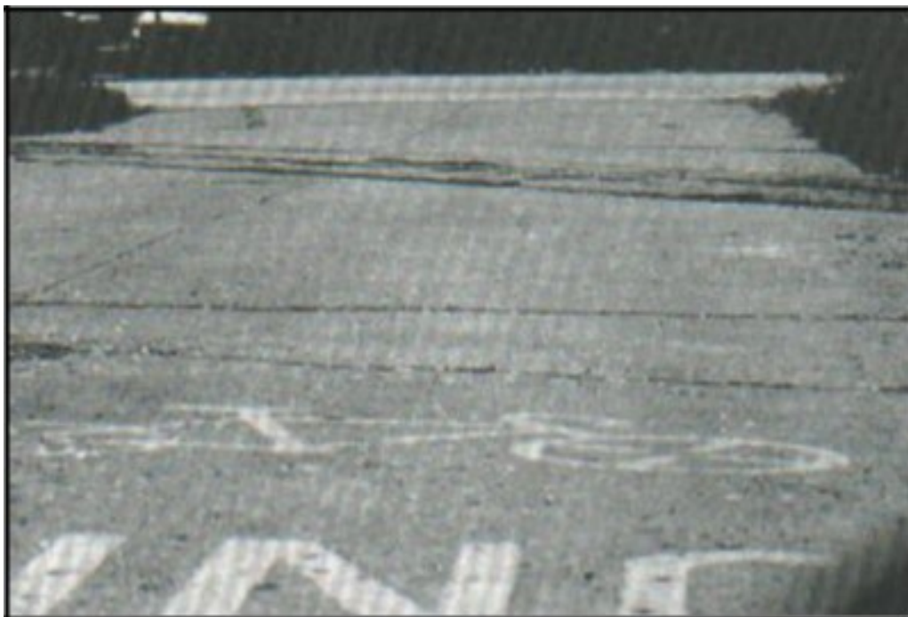
Figura 44: Cruce de vía férrea de severidad media
