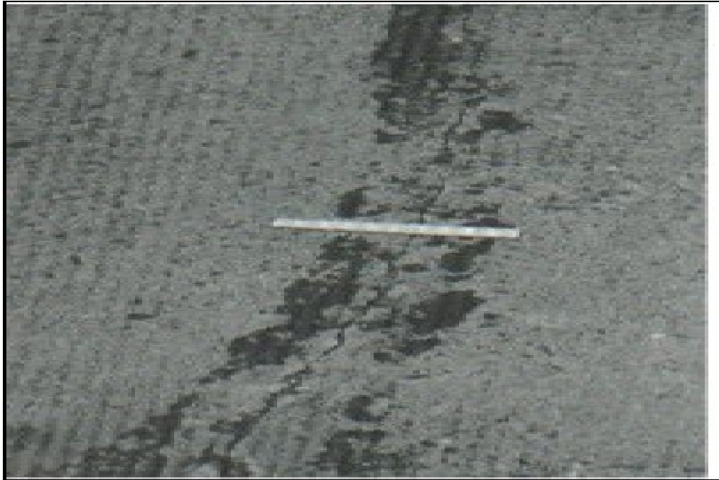
Figura 28: Grietas lineales de baja severidad en losa de concreto simple.
