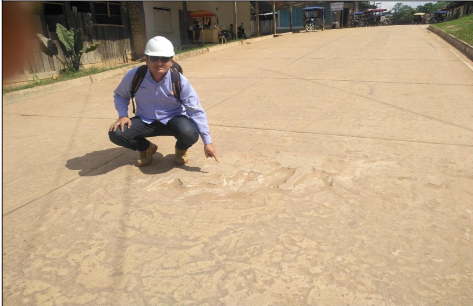
Figura 60: Vista panorámica de la patología Desconchamiento severidad alta
