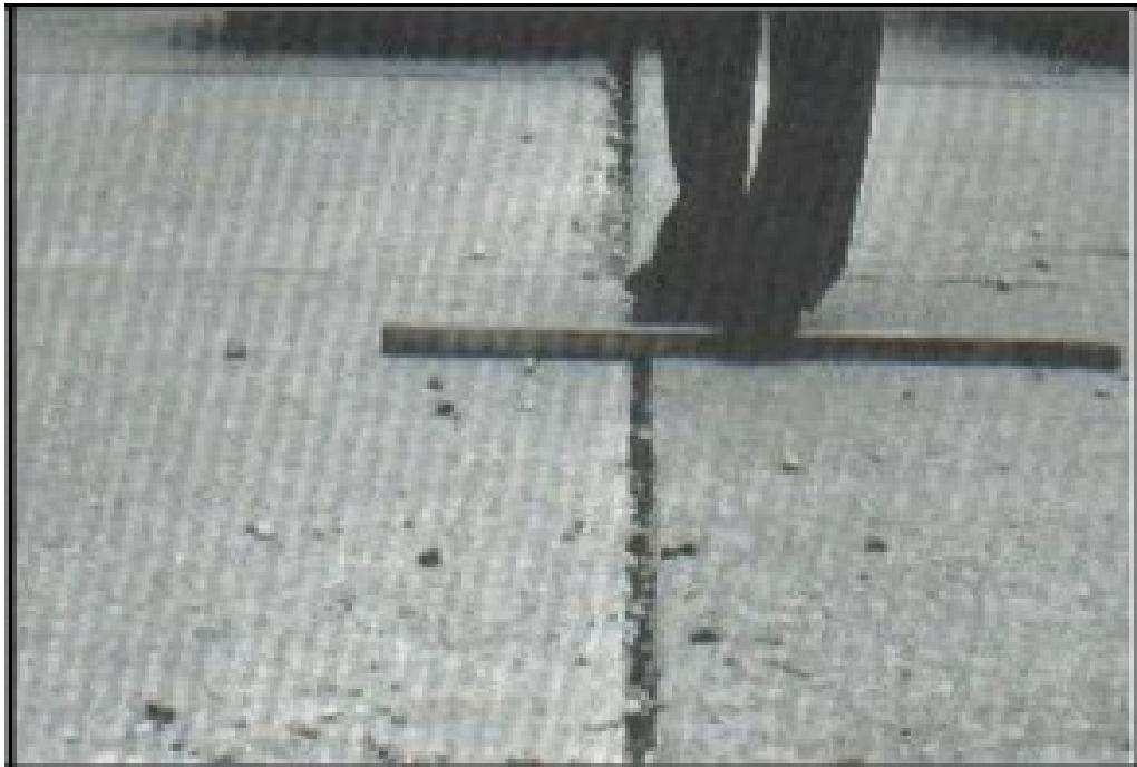
Figura 19: Escala de severidad baja.
