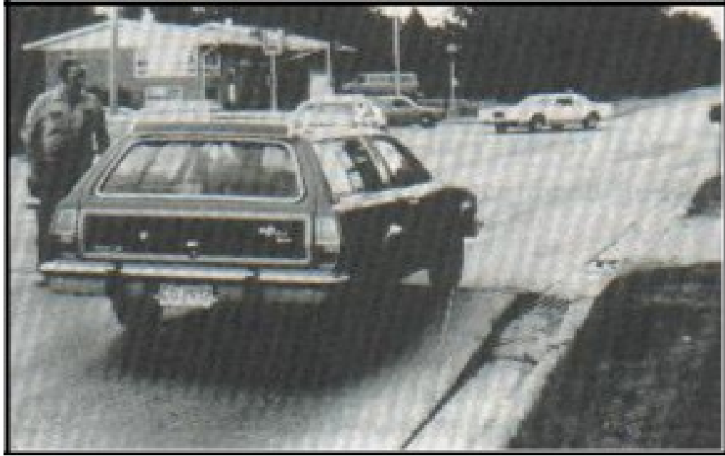
Figura 9: Blowup / Buckling de severidad alta
