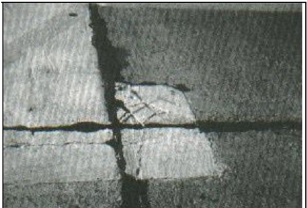
Figura 36: Parche pequeño de severidad alta.
