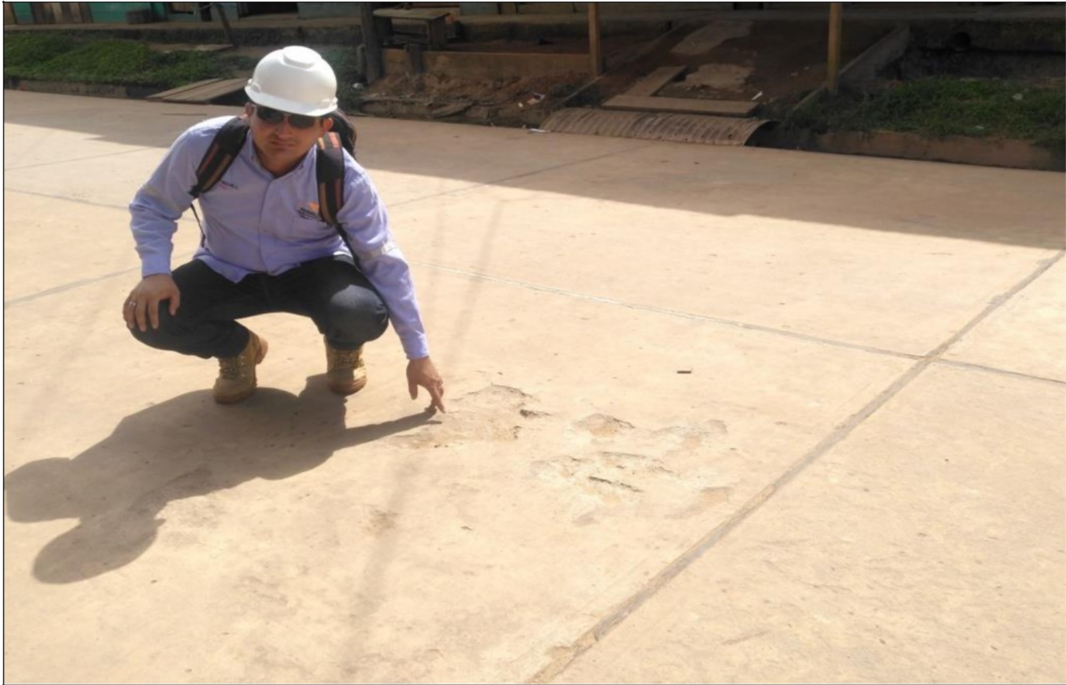
Figura 57: Vista panorámica de la patologías Desconchamiento severidad media
