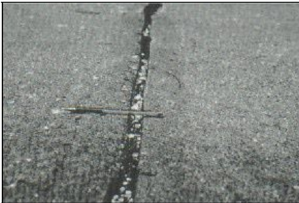
Figura 24: Daño del sello de junta de alta severidad.
