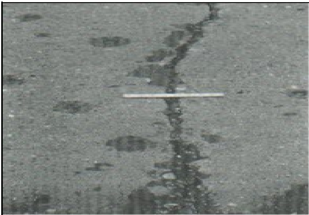
Figura 29: Grietas lineales de severidad media en losa de concreto reforzado.
