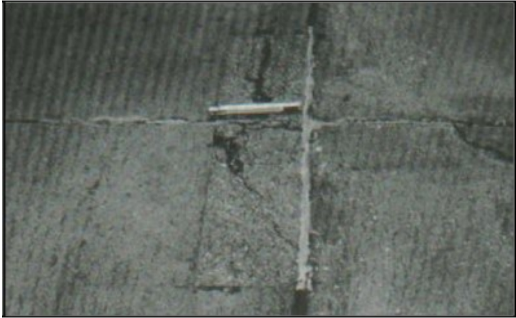
Figura 35: Parche pequeño de severidad media.
