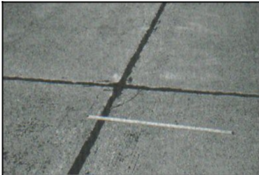
Figura 50: Descascaramiento de esquina de severidad baja
