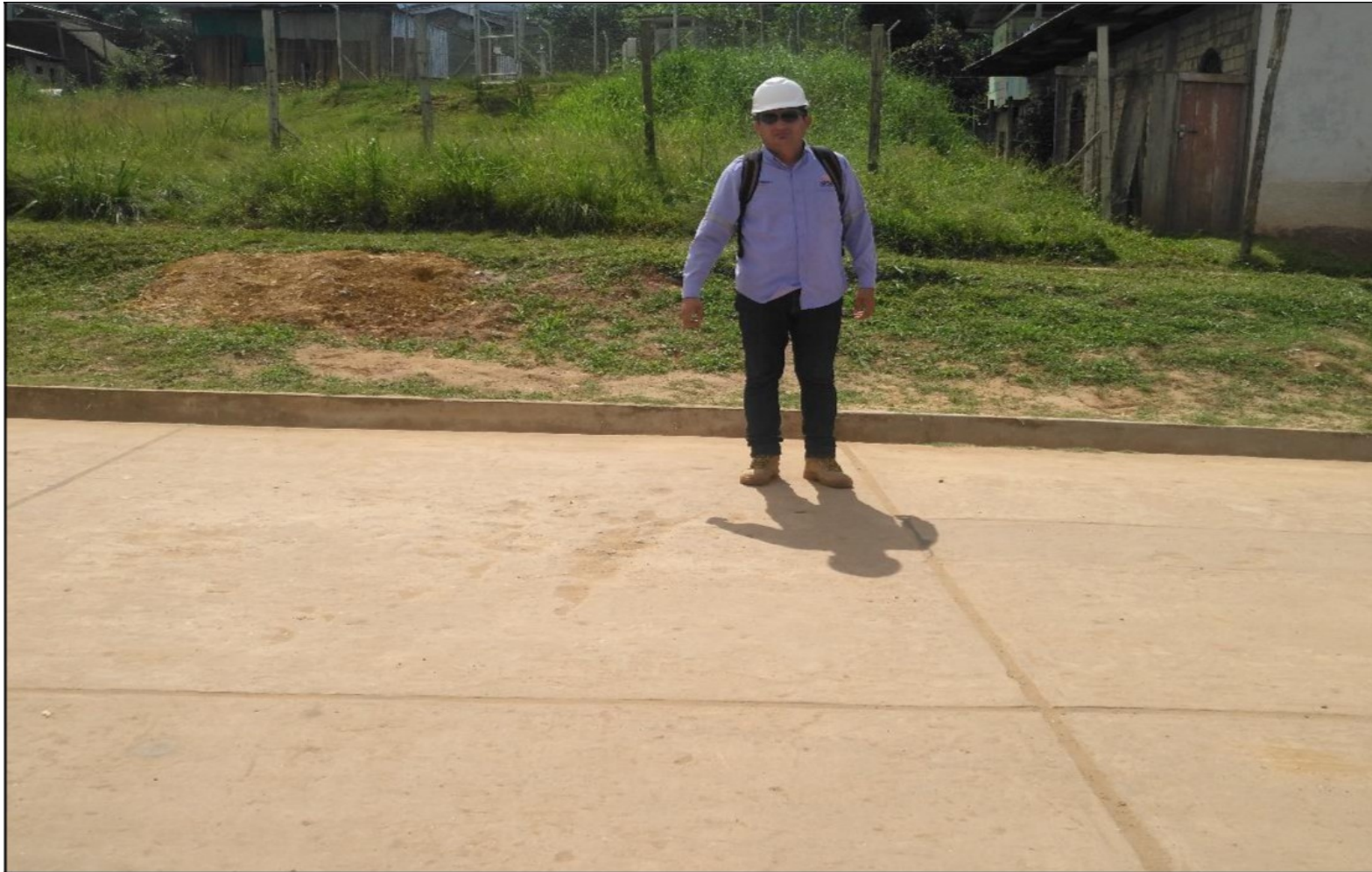
Figura 58: Vista panorámica de la patologías Desconchamiento severidad media
