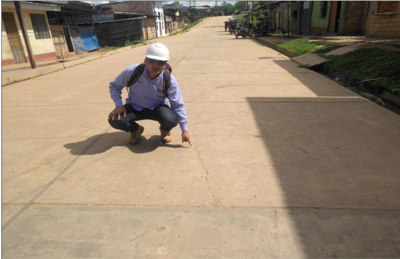
Figura 62: Vista panorámica de la patología Grieta Lineal severidad baja
