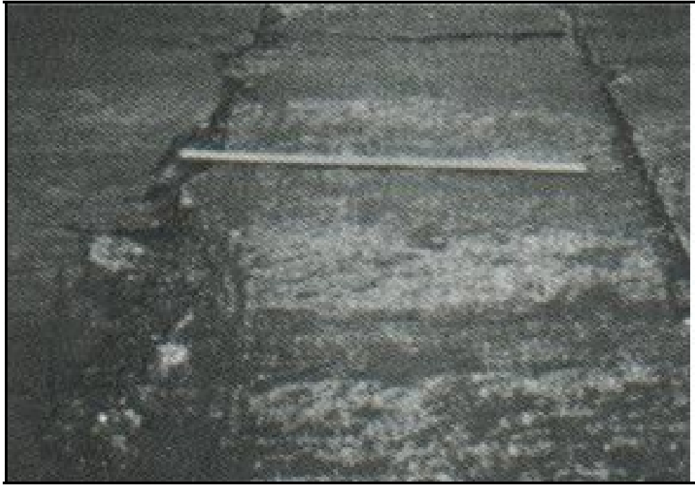
Figura 33: Parche grande y acometidas de servicios públicos de alta severidad.
