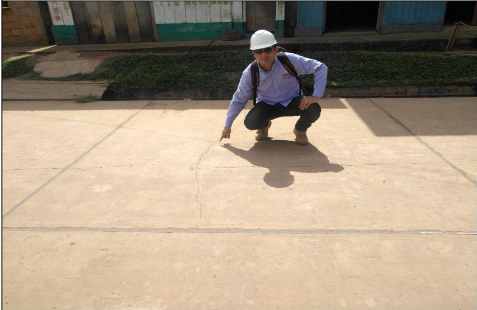
Figura 61: Vista panorámica de la patología Grieta Lineal severidad baja
