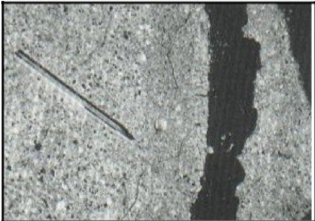
Figura 16: Grieta de durabilidad de severidad baja
