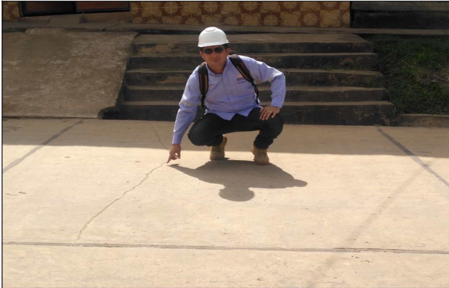
Figura 63: Vista panorámica de la patología Grieta Lineal severidad baja
