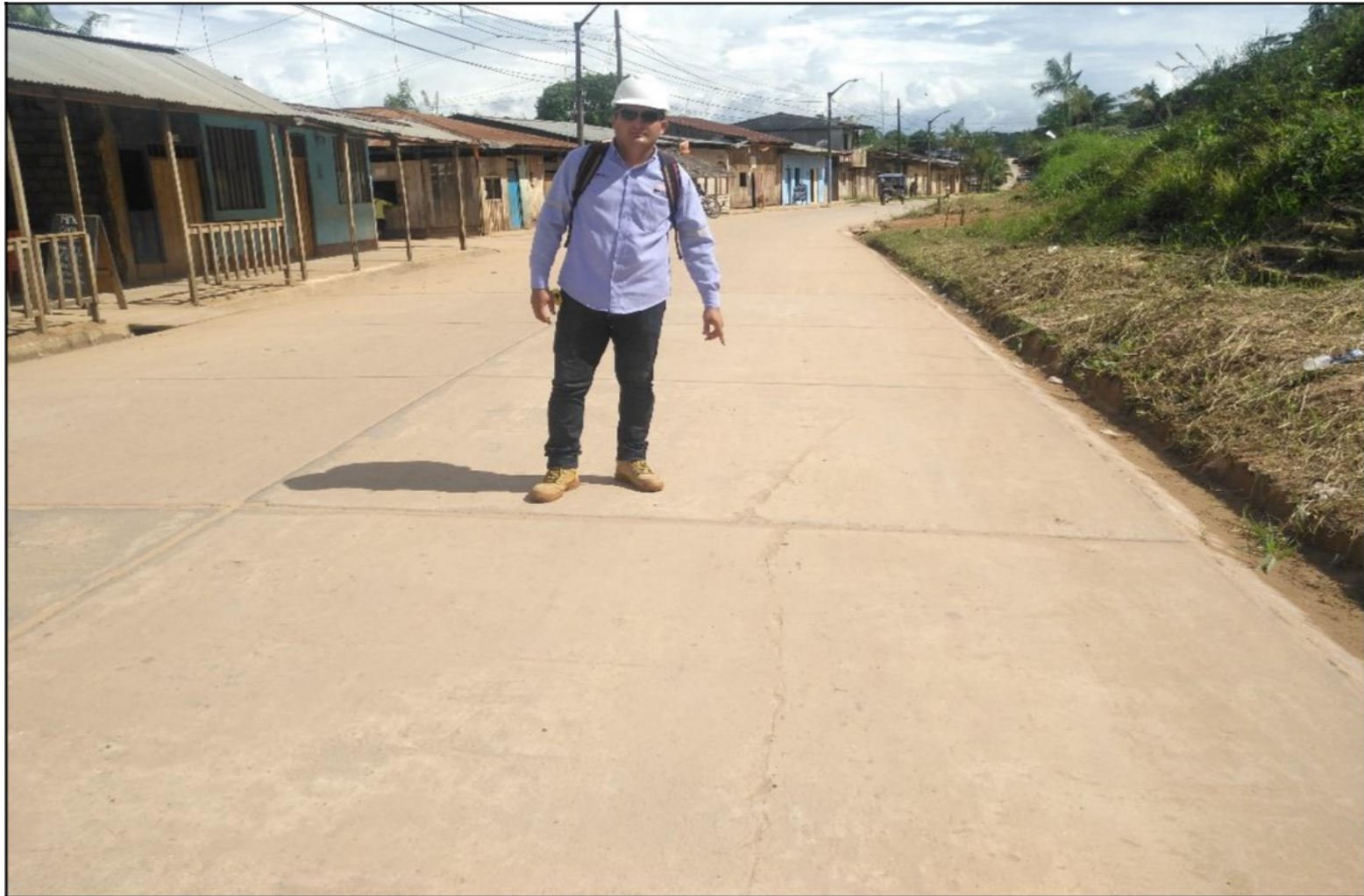
Figura 65: Vista panorámica de la patología Grieta Lineal severidad media
