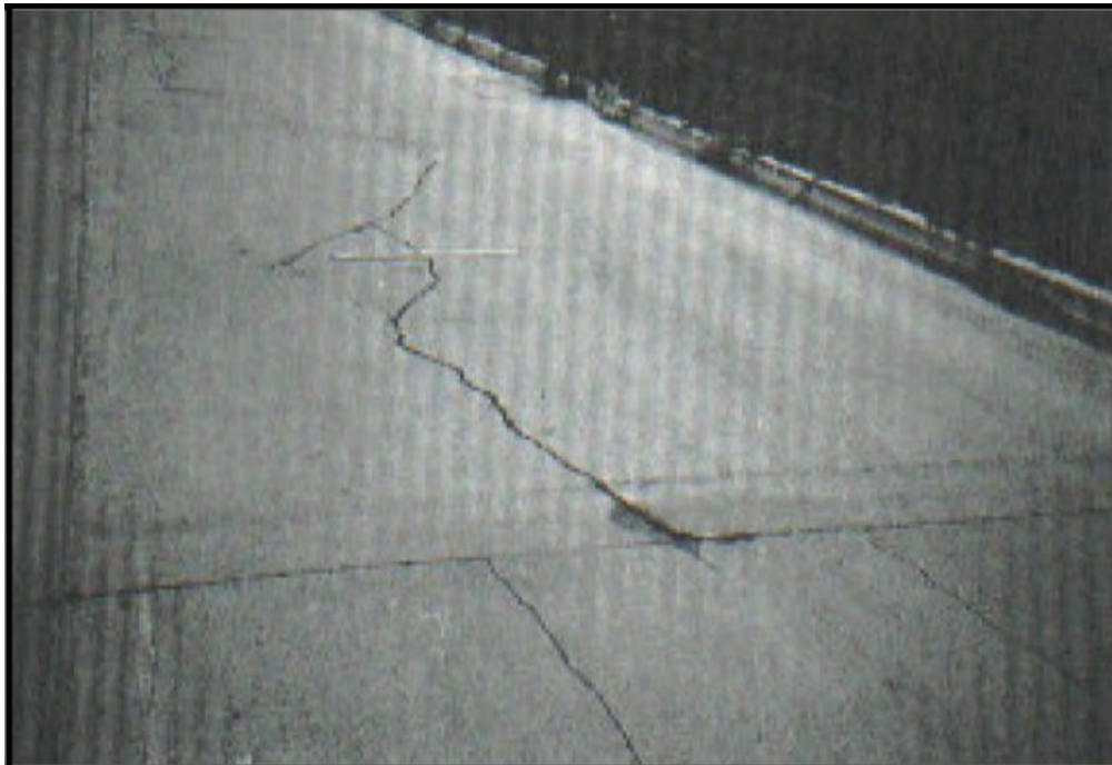
Figura 14: Losa dividida de severidad media.
