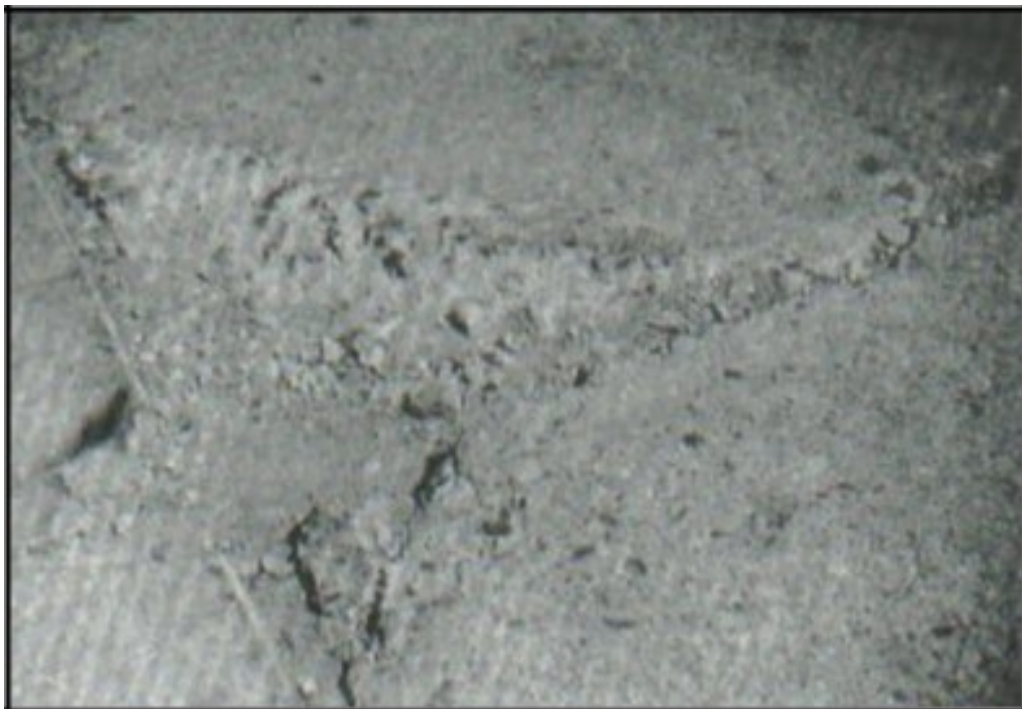
Figura 52: Descascaramiento de esquina de severidad alta
