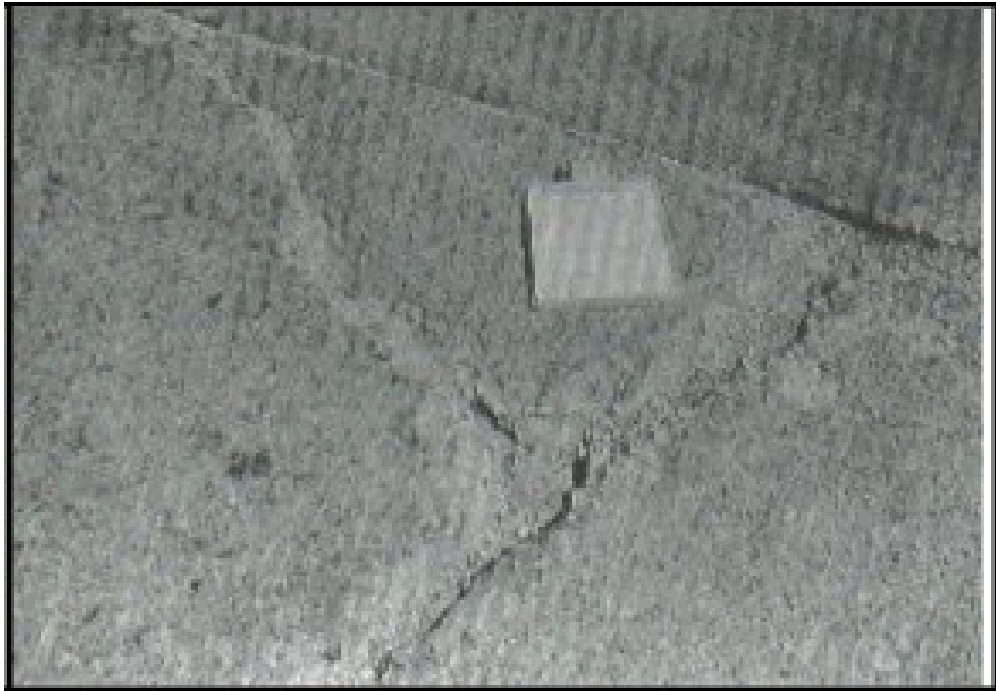
Figura 12: Grieta de esquina de severidad alta
