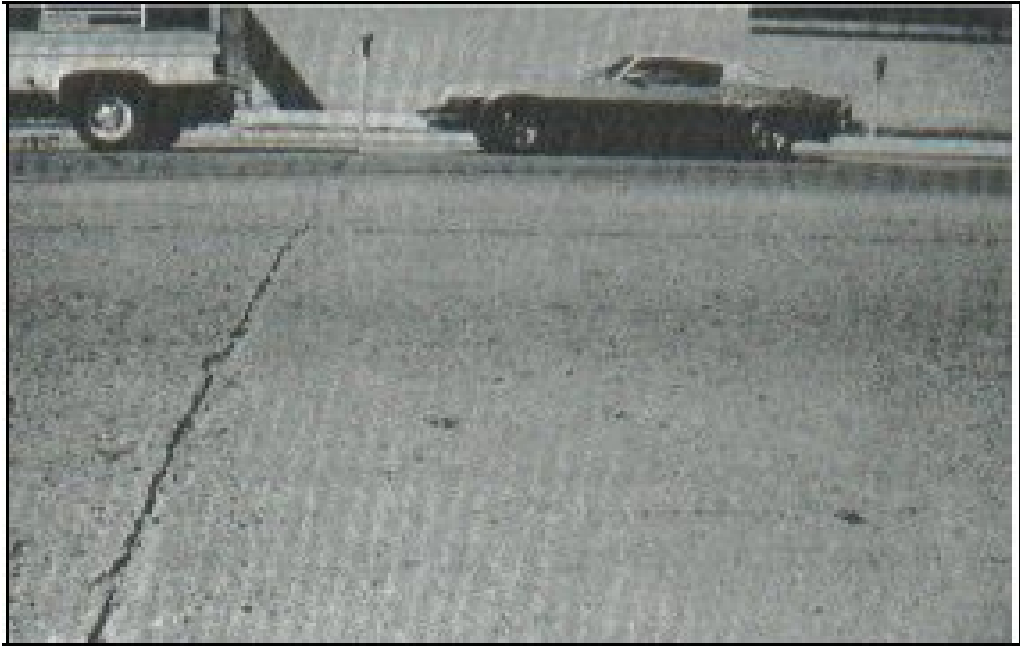
Figura 53: Descascaramiento de junta de baja severidad.
