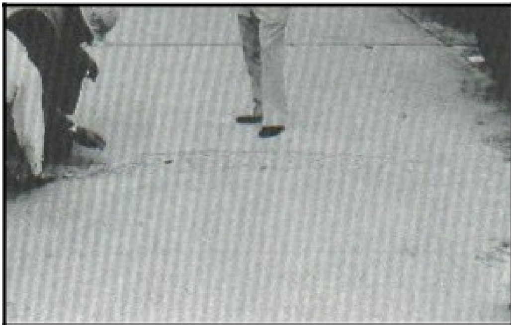
Figura 18: Grieta de durabilidad de severidad alta
