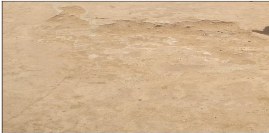
Figura 71: Desconchamiento severidad alta
