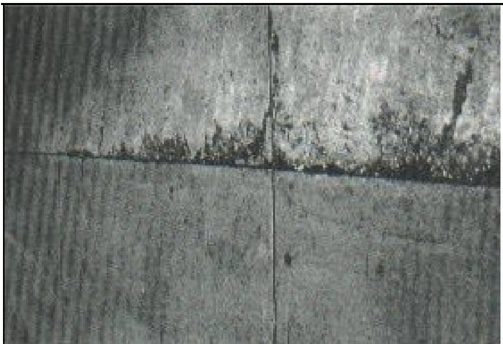
Figura 54: Descascaramiento de junta de severidad media.
