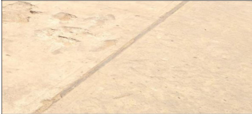
Figura 70: Desconchamiento severidad media
