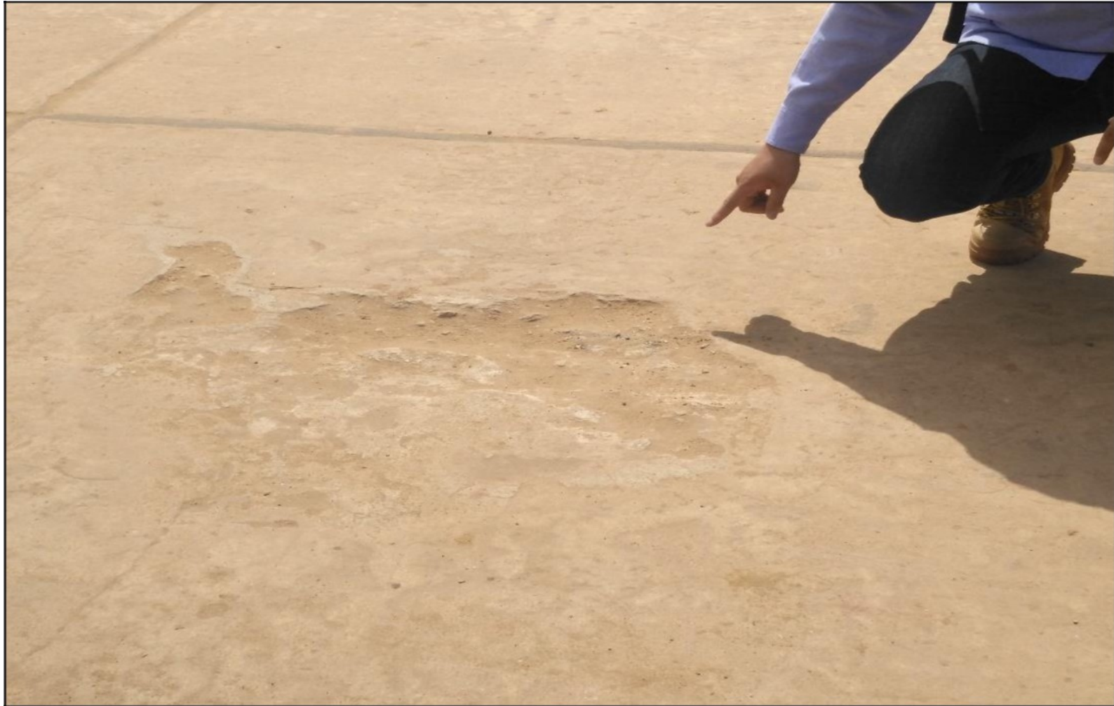
Figura 59: Vista panorámica de la patología Desconchamiento severidad alta
