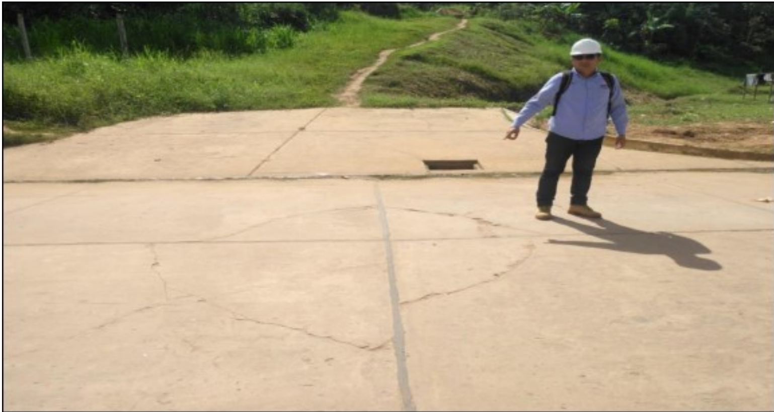
Figura 56: Vista panorámica de la patología grietas de esquina severidad media
