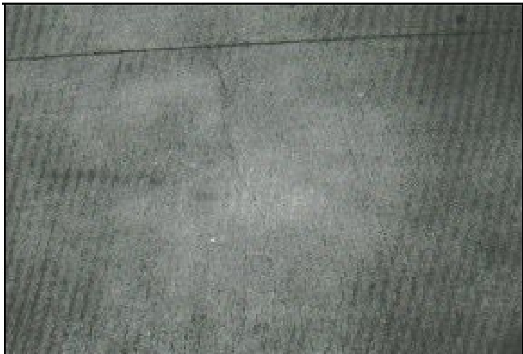
Figura 49: Grietas de contracción.
