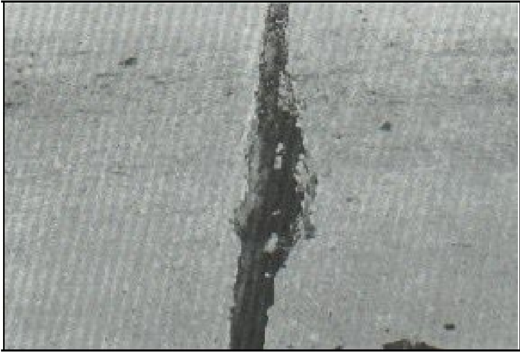
Figura 23: Daño del sello de junta de severidad media.
