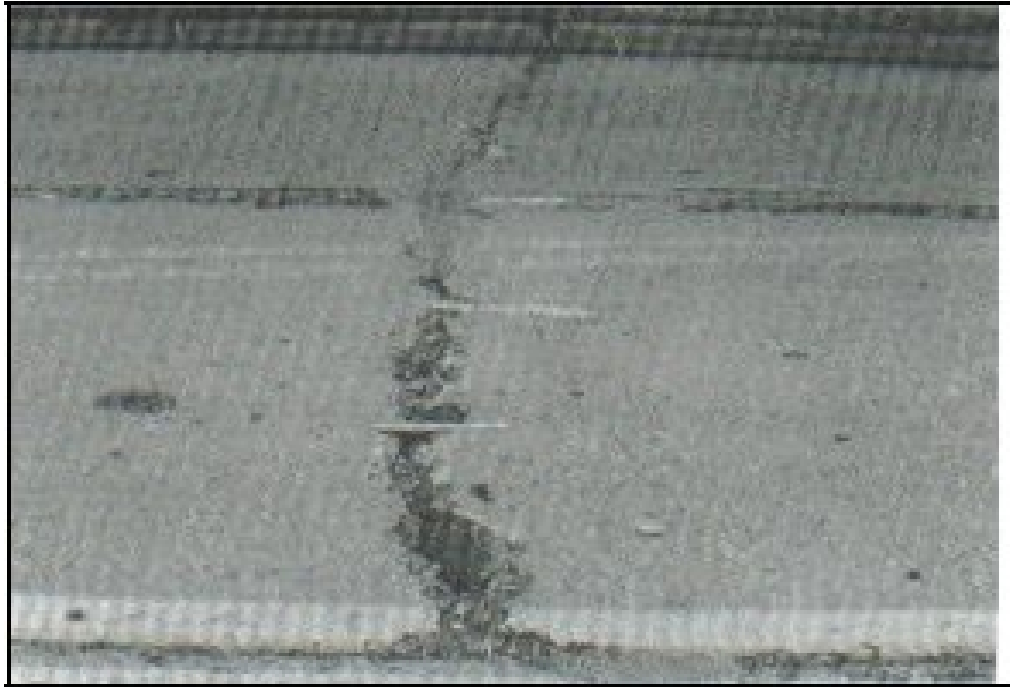
Figura 30: Grietas lineales de alta severidad en losa de concreto simple.
