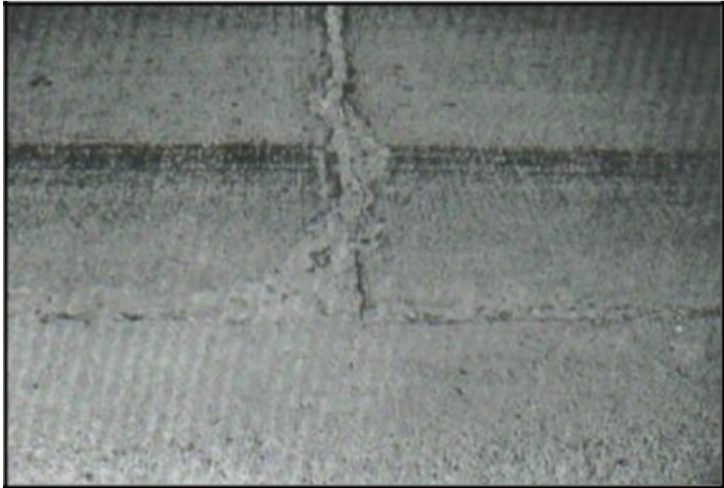
Figura 51: Descascaramiento de esquina de severidad media.
