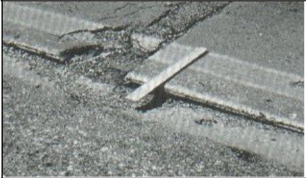
Figura 25: Desnivel carril / berma de baja severidad.
