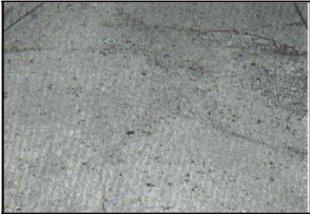
Figura 17: Grieta de durabilidad de severidad media.
