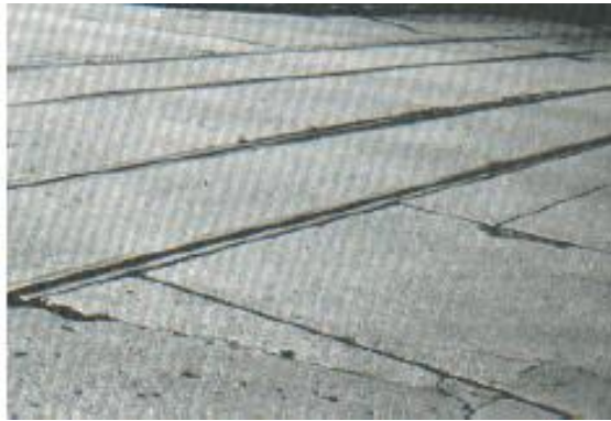
Figura: Cruce de Vía Férrea de Baja Severidad.
