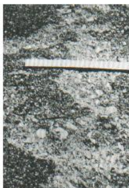
Figura: Desconchamiento / Mapas de grietas de Severidad Media.
