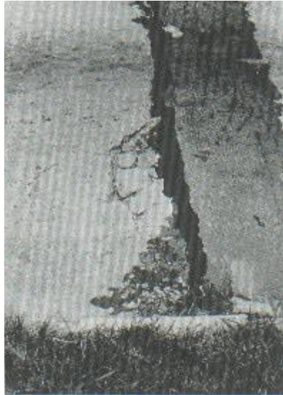
Figura: Blowup / Buckling de Baja Severidad.
