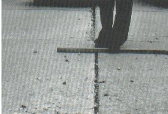
Figura: Escala de Baja Severidad.
