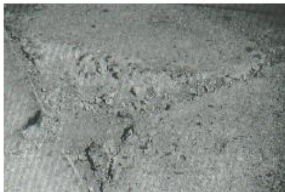
Figura: Descascaramiento de esquina de Alta Severidad.
