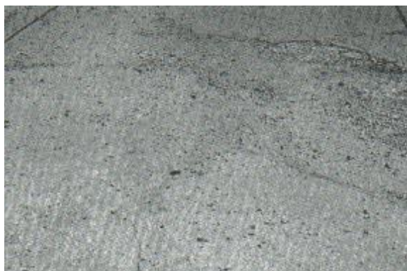
Figura: Grieta de Durabilidad de Alta Severidad.
