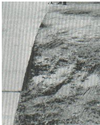
Figura: Desnivel carril / Berma de Severidad Media.
