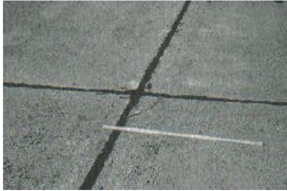
Figura: Descascaramiento de esquina de baja Severidad.
