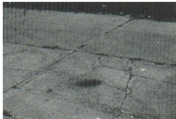
Figura: Losa Dividida de Alta Severidad.
