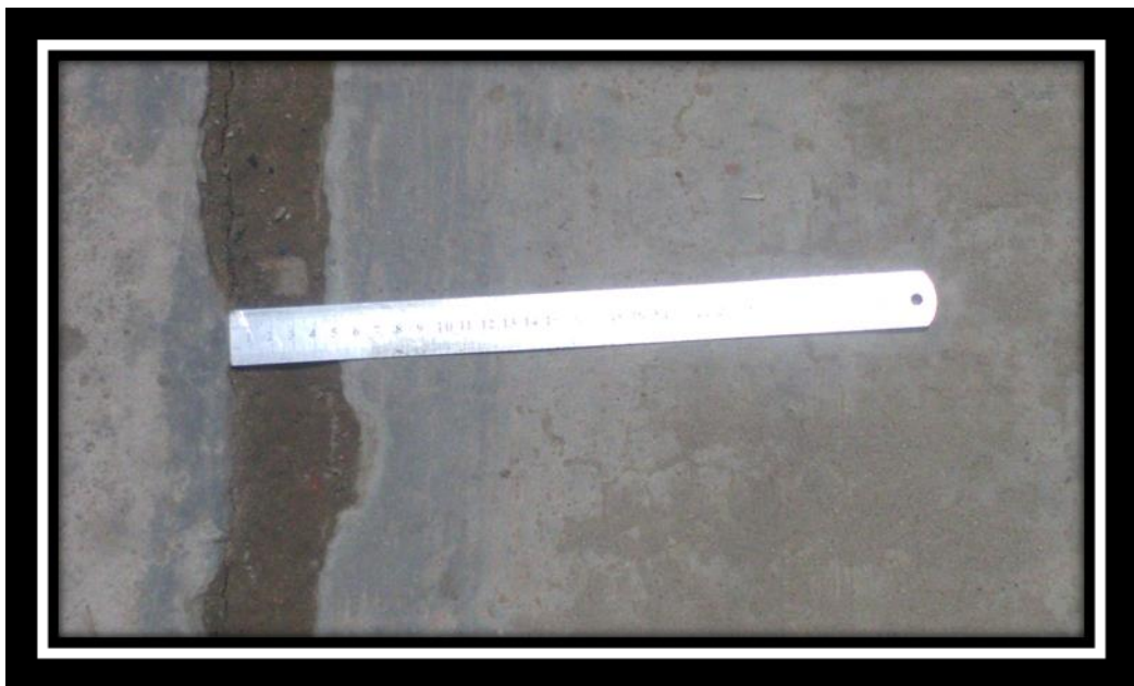
FOTO N°8: Se observa el Daño del Sello de la Junta
