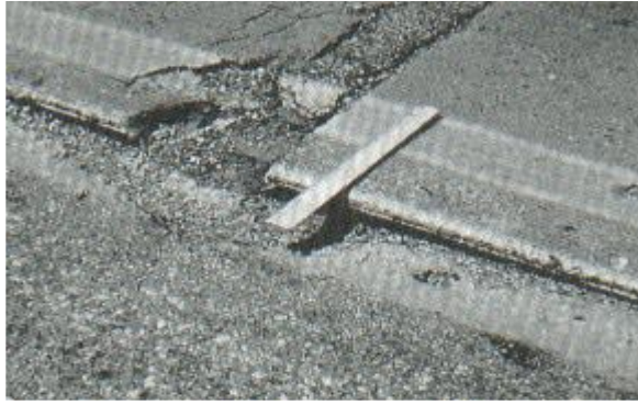
Figura: Desnivel carril / Berma de Baja Severidad.
