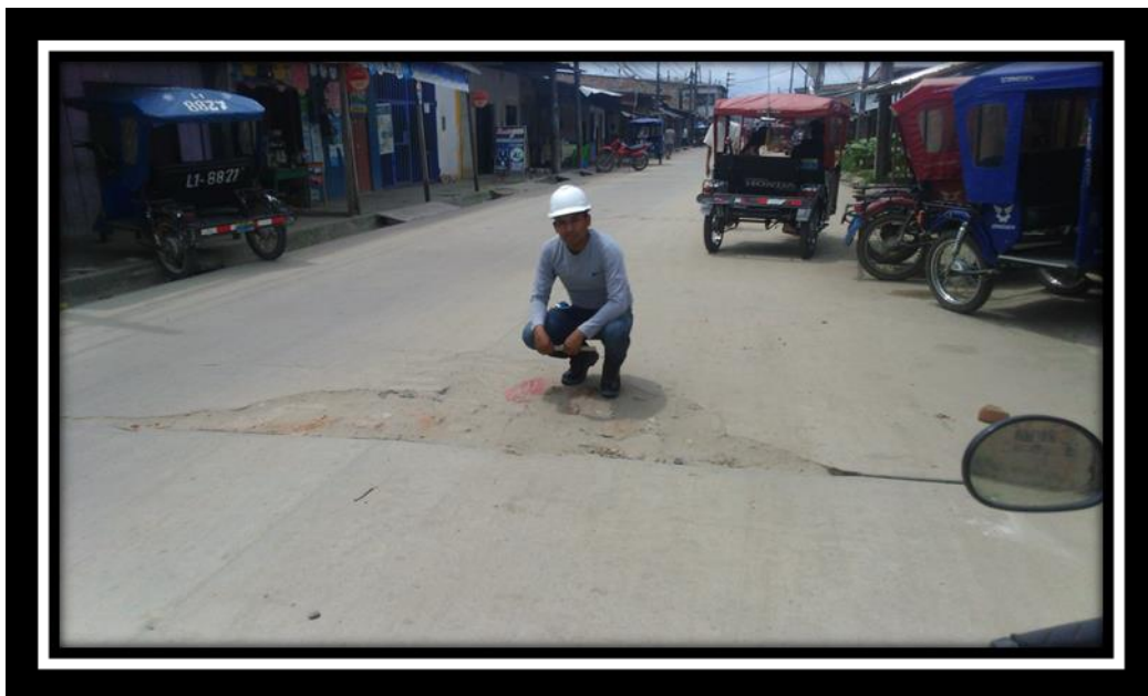
FOTO N°3: Se observa el Punzonamiento en las esquinas de los paños
