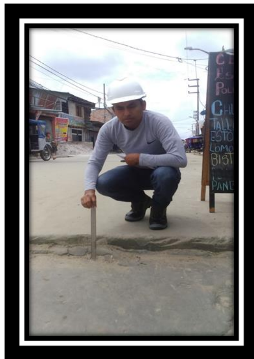
FOTO N°2: Se observa el desnivel que existe entre dos paños de la Ca. Cap. Belgrano
