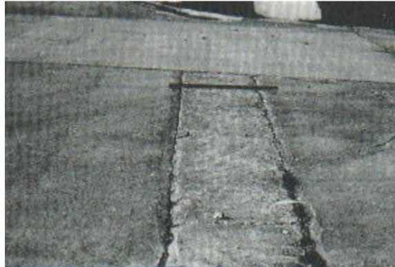
Figura: Parcheo Grande de Severidad Media. Fuente Manual del PCI (16)
