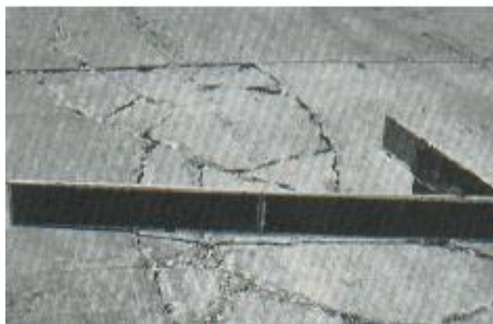
Figura: Punzonamiento de Alta Severidad.
