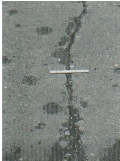
Figura: Grieta Lineal de Severidad Media. Fuente Manual del PCI (16)
