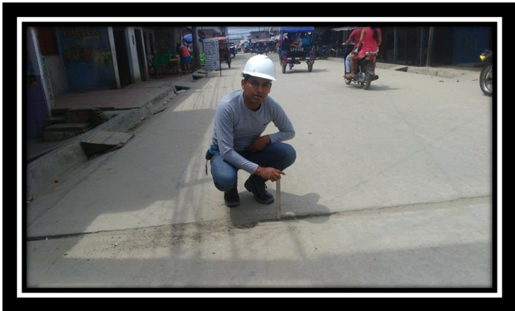
FOTO N°7: Se observa el desnivel que existe entre dos paños de la Ca. Cap. Belgrano
