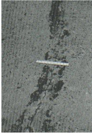
Figura: Grieta Lineal de Baja Severidad. Fuente Manual del PCI (16)
