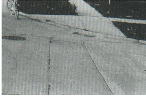
Figura: Parcheo Grande de Baja Severidad. Fuente Manual del PCI (16)
