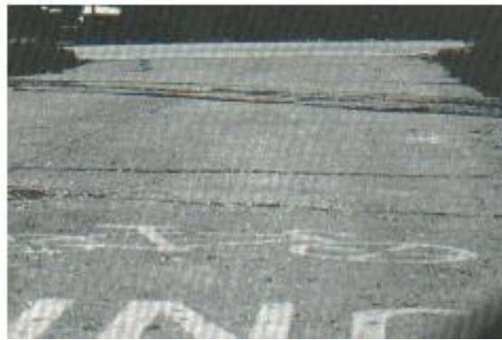
Figura: Cruce de Vía Férrea de Severidad Media.
