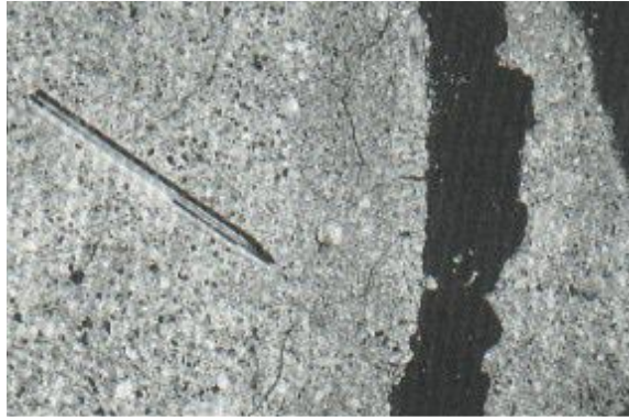
Figura: Grieta de Durabilidad de Baja Severidad.
