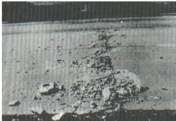
Figura: Blowup / Buckling de Severidad Media.
