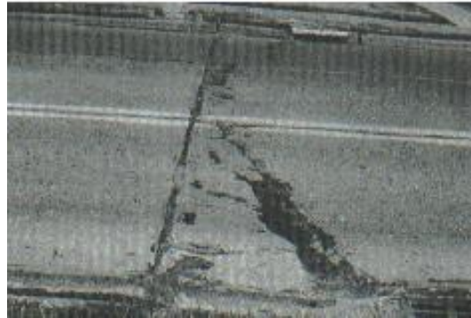
Figura: Punzonamiento de Severidad Media.
