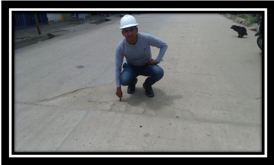
FOTO N°5: Se observa el Punzonamiento en las esquinas de los paños
