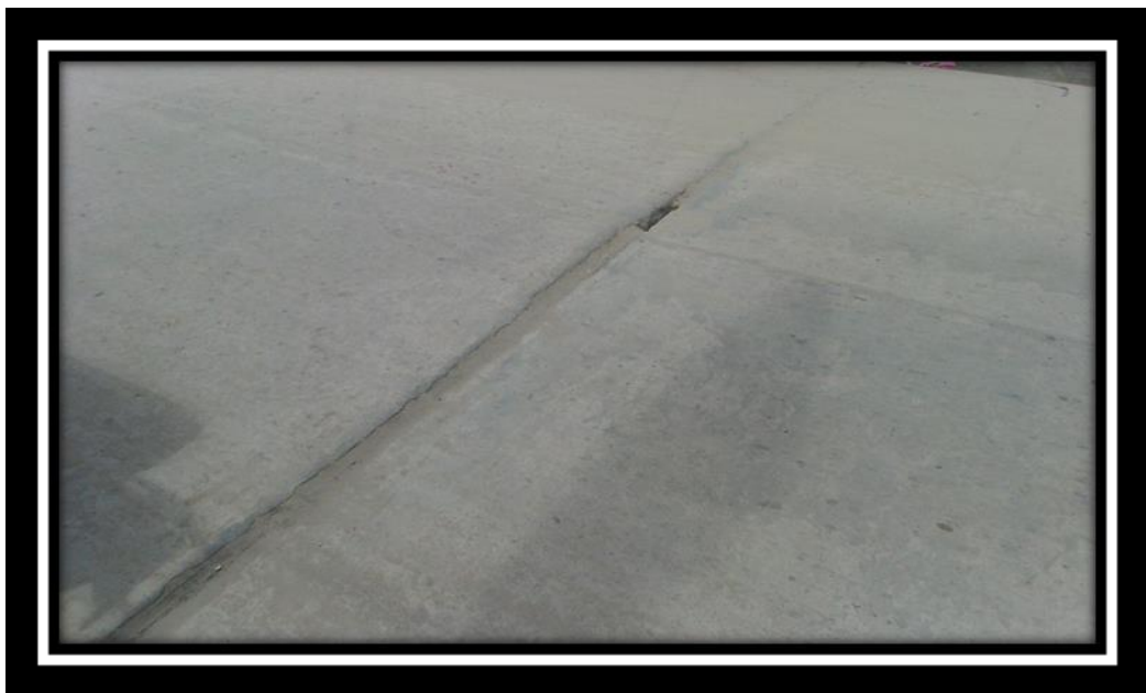
FOTO N°6: Se observa el Daño del Sello de la Junta
