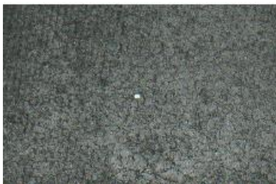
Figura: Desconchamiento / Mapas de grietas de Baja Severidad.
