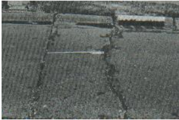
Figura: Punzonamiento de Baja Severidad.
