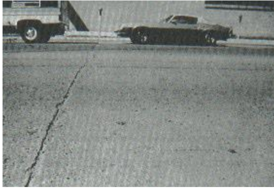
Figura: Descascaramiento de Junta de baja Severidad. Fuente Manual del PCI (16)
