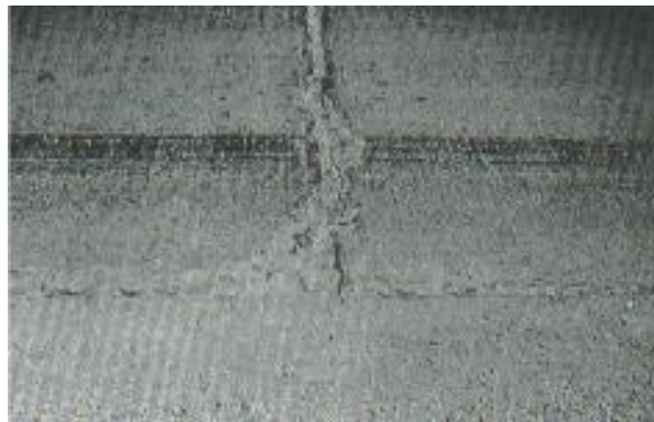
Figura: Descascaramiento de esquina de Severidad Media.
