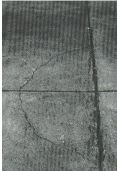
Figura: Grieta de Esquina de Baja Severidad.
