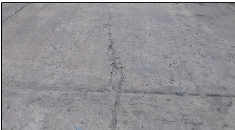
Fotografía 20: grieta lineal de baja severidad en UM - 06.
