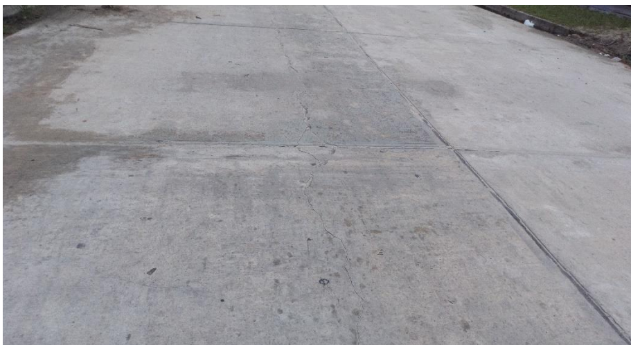
Fotografía 28: Grieta lineal de severidad leve UM – 11, se nota el desconchamiento inicial
