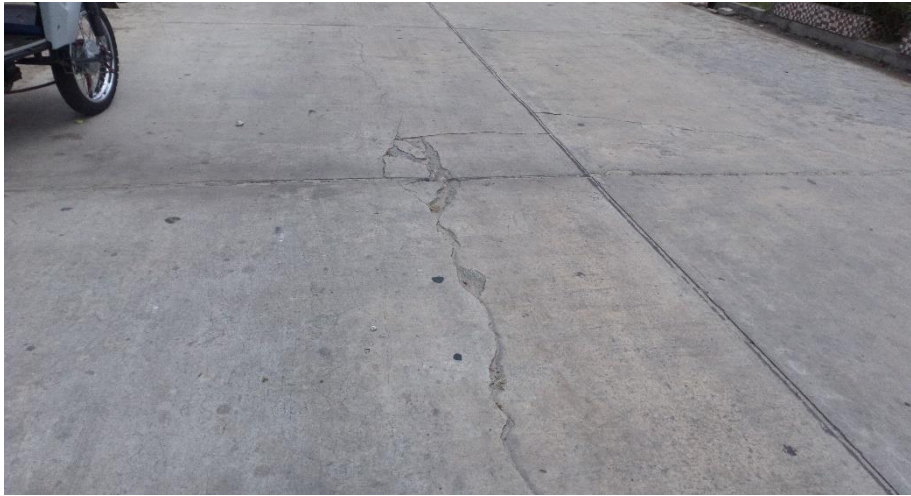
Fotografía 24: Grieta lineal de severidad media UM - 08
