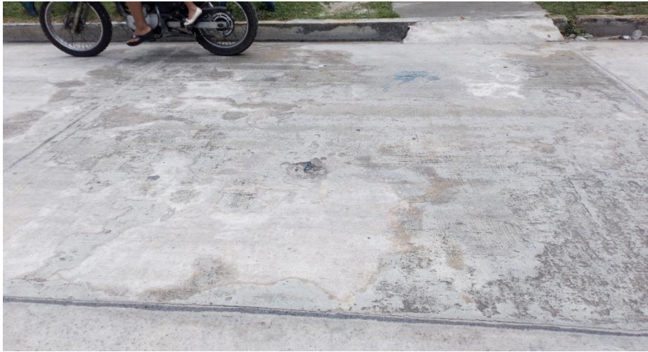
Fotografía 31: Desconchamiento de severidad media UM – 12.
