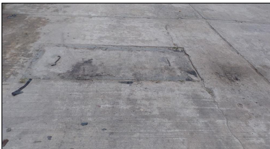
Fotografía 26: parche grande de severidad alta y grietas lineal de severidad media en UM - 10.
