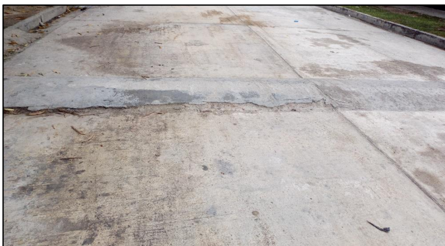
Fotografía 30: Giba insertada en el pavimento (parcheo grande) UM - 12.
