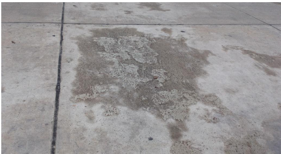
Fotografía 32: desconchamiento de severidad media UM – 13.
