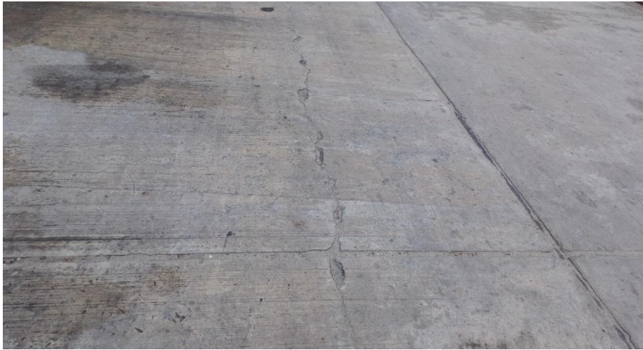
Fotografía 27: Grieta lineal de severidad leve UM – 10, se nota el desconchamiento inicial.
