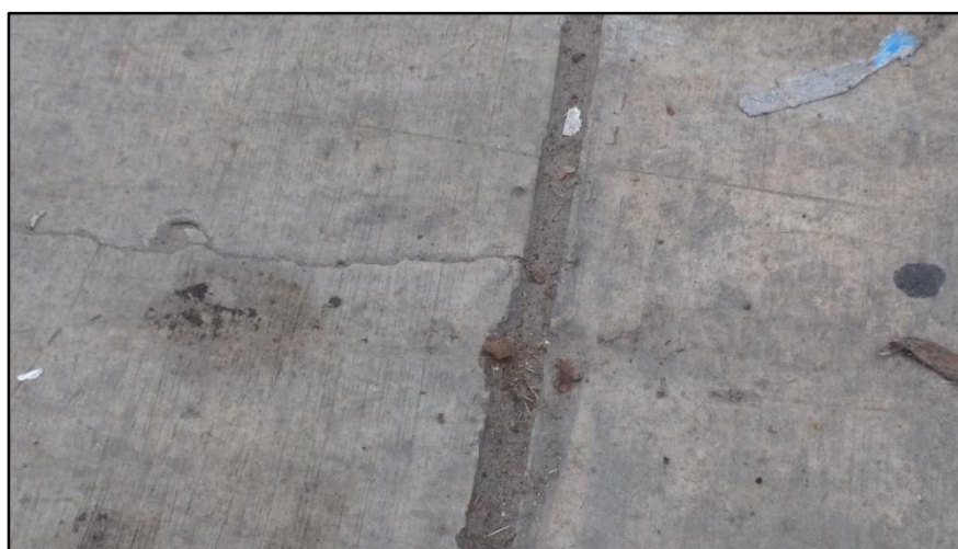
Fotografía 18: Escala de severidad leve UM - 03. Se ve también la grieta lineal de severidad baja.
