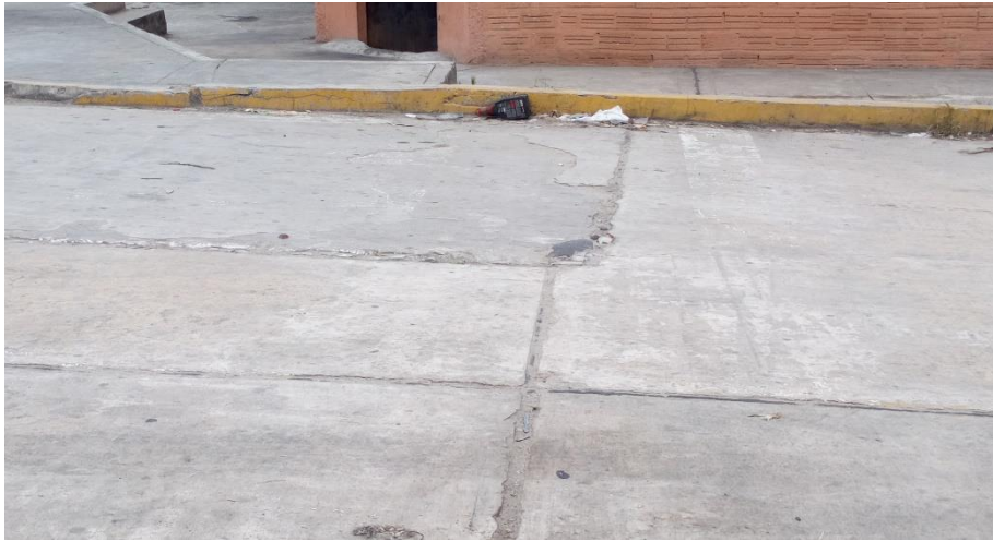
Fotografía 15: Parcheo grande de severidad media UM 02
