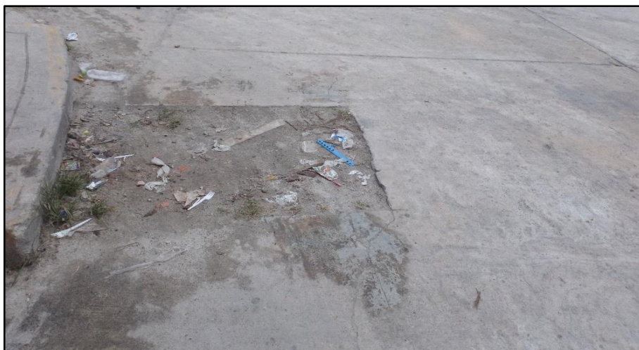
Fotografía 25: parche grande de alta severidad y desconchamiento de severidad baja UM - 09.
