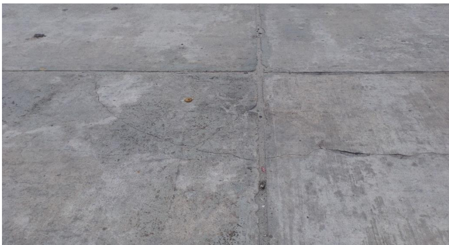
Fotografía 23: Desconchamiento de baja severidad, losa dividida de severidad leve y grieta lineal de severidad leve UM - 09
