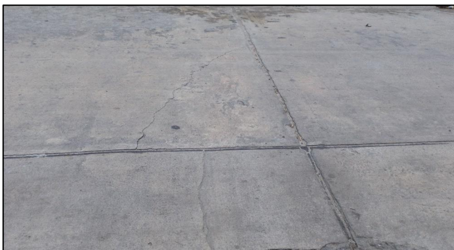
Fotografía 22: grieta de esquina de baja severidad y grieta lineal de severidad baja en UM - 08.
