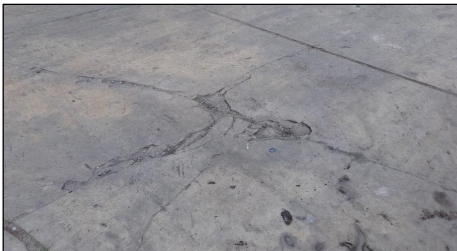
Fotografía 19: losa dividida de severidad alta en UM - 05.
