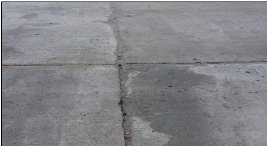
Fotografía 13: Escala de severidad baja, desconchamiento de severidad baja UM - 01
