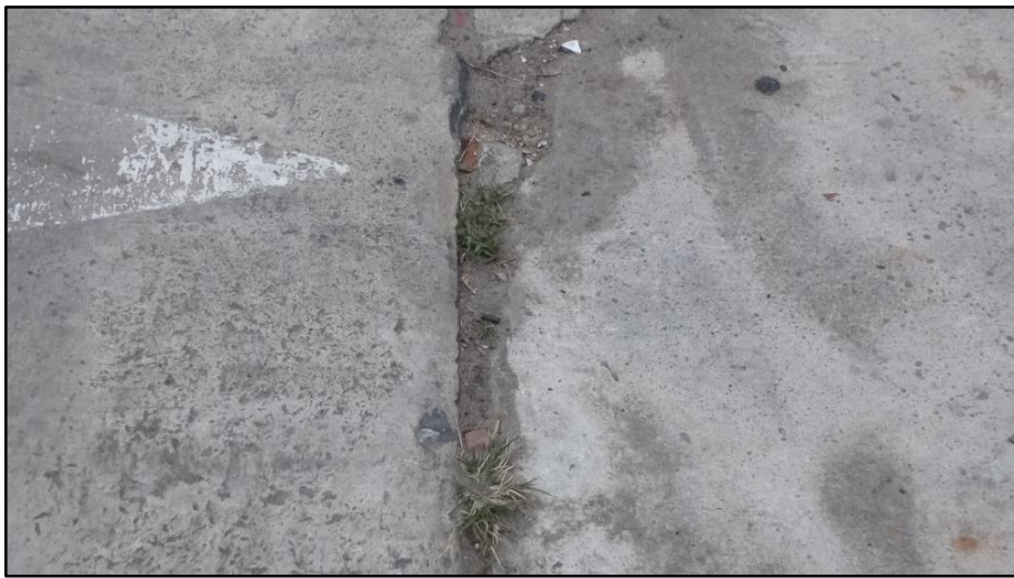
Fotografía 16: daño de sello y descascaramiento de junta de severidad leve, escala de severidad baja y desconchamiento de baja severidad en UM - 02.
