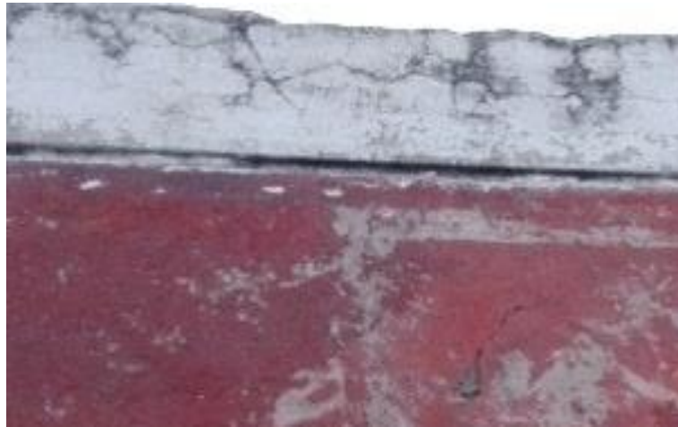
Figura 09: Fisura en viga
