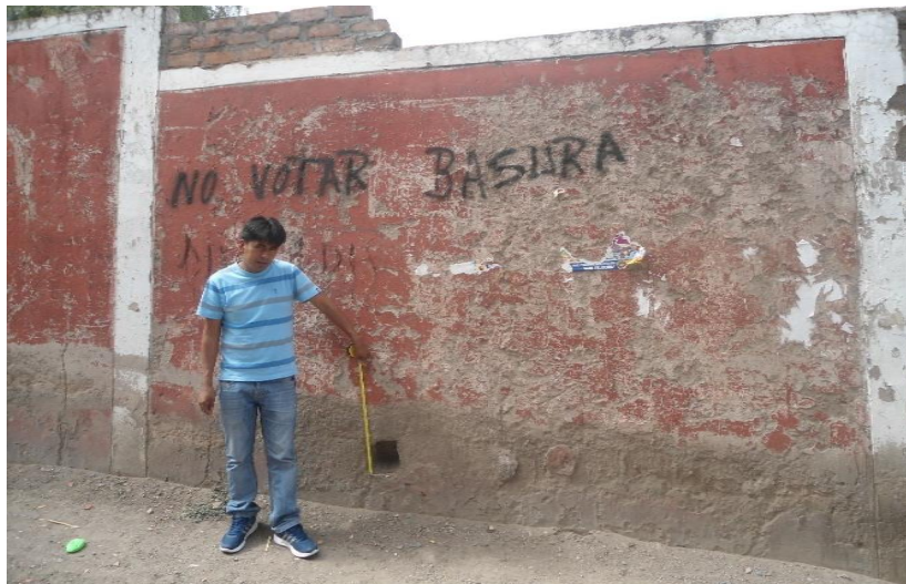
Fotografía 03: Picadura del cerco perimétrico, en la unidad de muestra 05
