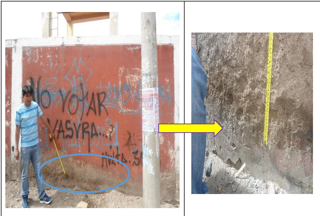
Fotografía 03: Erosión en muros del cerco perimétrico en la unidad de muestra 01.
