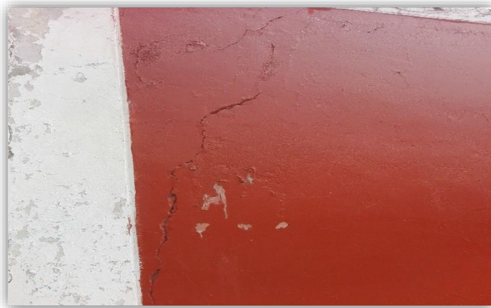
Fotografía 04: Grieta en muro del cerco perimétrico, en la unidad de muestra 03.
