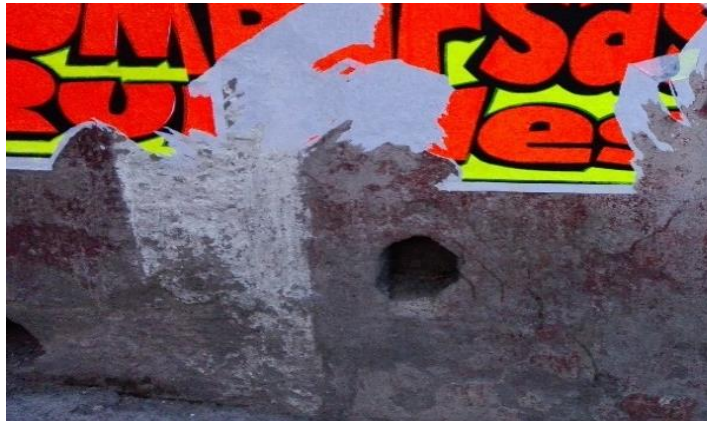
Figura 13: Picadura en muro
