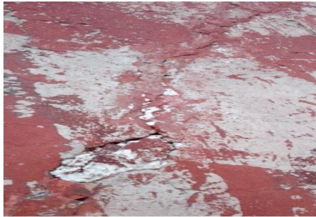
Figura 11. Grieta en muros
