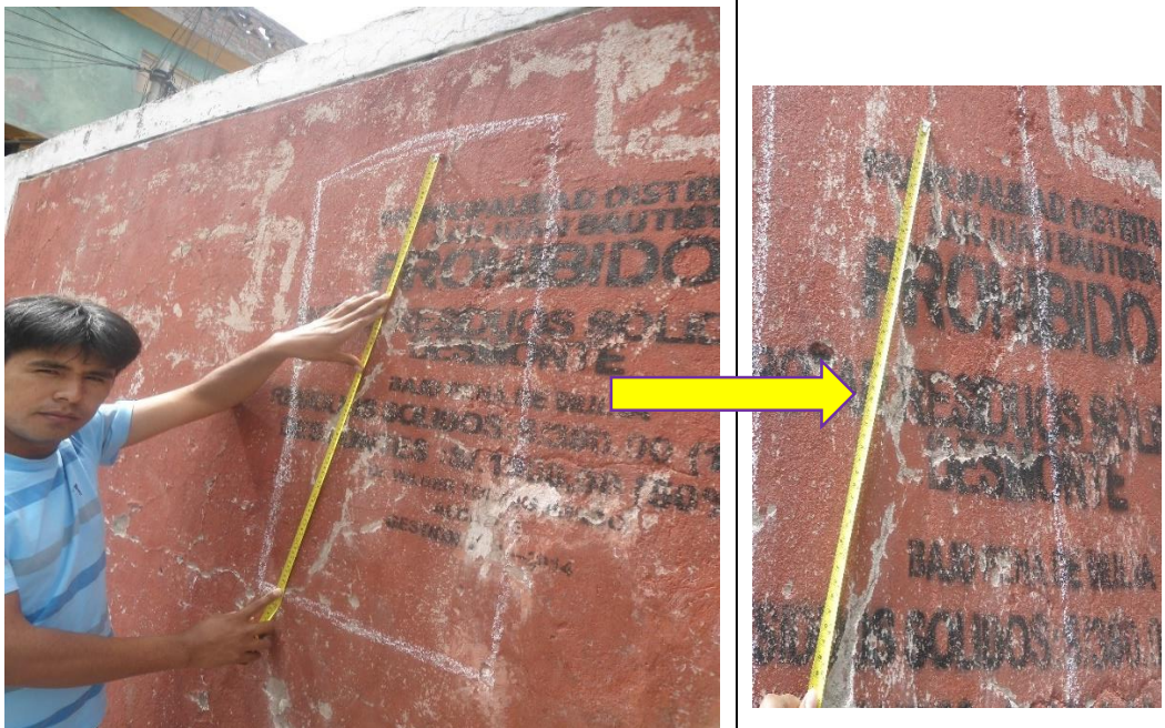
Fotografía 02: Fisura en muros del cerco perimétrico en la unidad de muestra 01.
