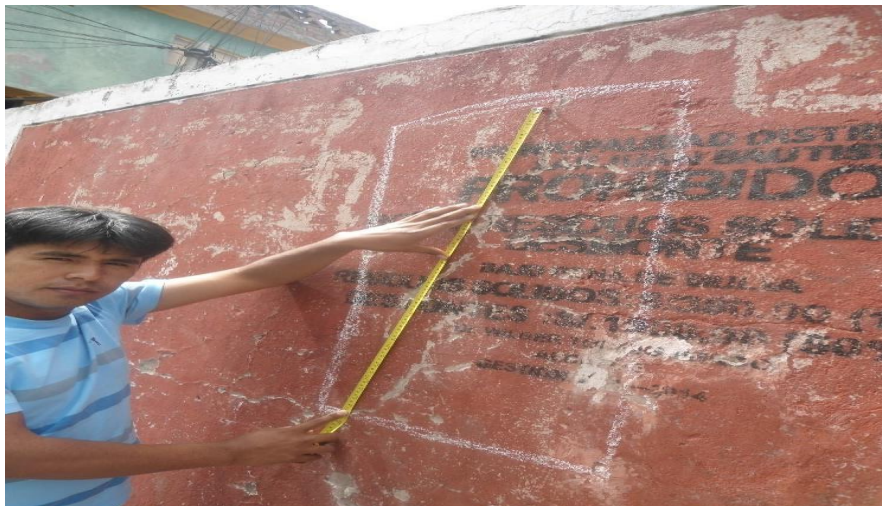
Fotografía 02: Fisura en muro del cerco perimétrico, en la unidad de muestra 01
