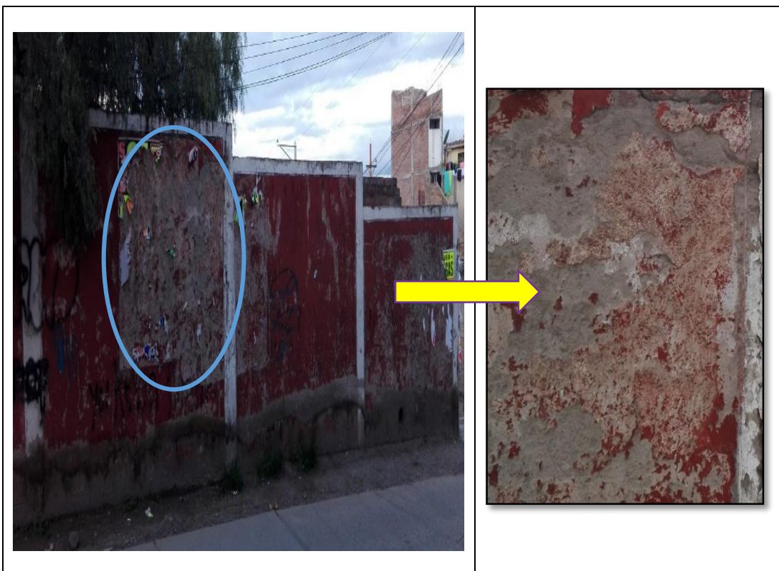
Fotografía 04: Erosión en muro del cerco perimétrico, en la unidad de muestra 04.
