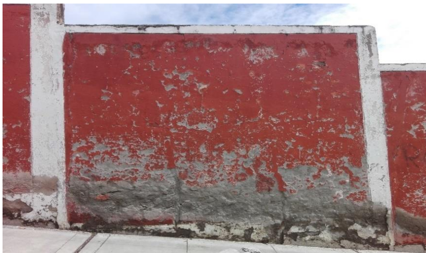
Fotografía 01: Erosión en muro y columna del cerco perimétrico, en la unidad de muestra 07.
