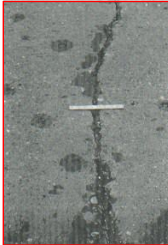
Figura 17. Grietas lineales de severidad media en losa de concreto reforzado.
