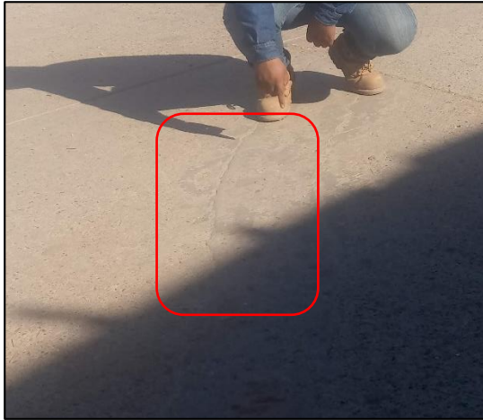
Fig. 42. Patología de Grieta de Esquina con nivel de severidad baja, en la cuadra 1 de la Av. Santa Clara, Distrito de Manantay.
