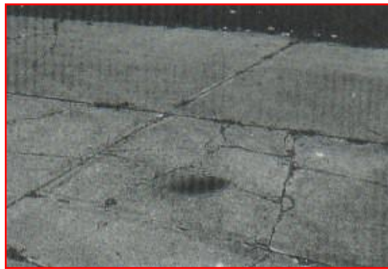
Figura 12. Losa Dividida de Alta severidad.
