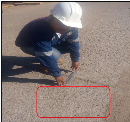
Fig. 43. Patología de Escala con nivel de severidad media, en la cuadra 1 de la Av. Santa Clara, Distrito de Manantay.
