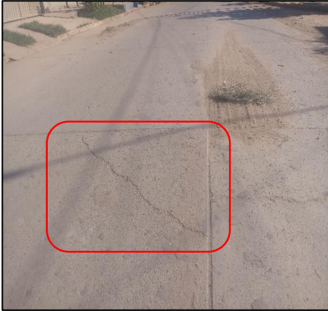
Fig. 45. Patología de Grieta de Esquina con nivel de severidad media, en la cuadra 2 de la Av. Santa Clara, Distrito de Manantay.
