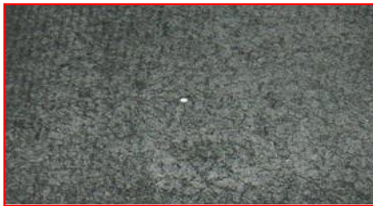
Figura 24. Desconchamiento de baja severidad.
