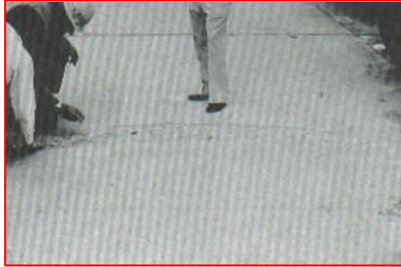
Figura 13. Grieta de durabilidad de severidad media.
