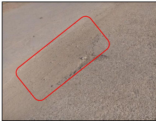
Fig. 50. Patología de Parcheo pequeño con nivel de severidad baja, en la cuadra 3 de la Av. Santa Clara, Distrito de Manantay.
