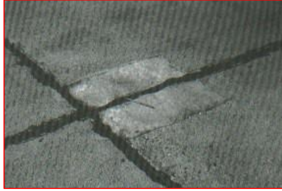
Figura 19. Parche pequeño de baja severidad.
