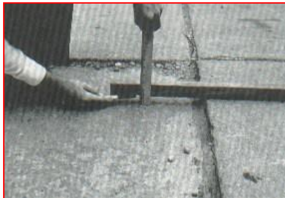
Figura 14. Escala de Alta Severidad.
