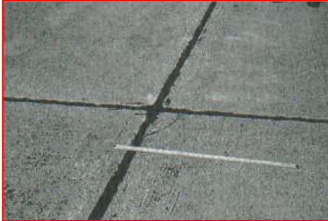
Figura 26. Descascaramiento de esquina de baja severidad.
