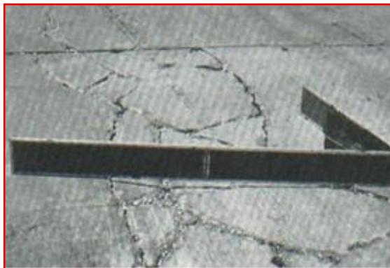
Figura 23. Punzonamiento de alta severidad.
