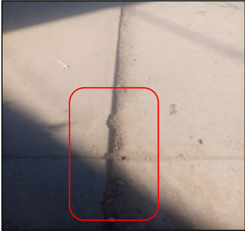
Fig. 48. Patología de Escala con nivel de severidad alta, en la cuadra 3 de la Av. Santa Clara, Distrito de Manantay.
