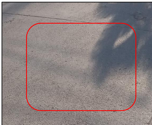
Fig. 51. Patología de Pulimiento de Agregados sin severidad, en la cuadra 3 de la Av. Santa Clara, Distrito de Manantay.
