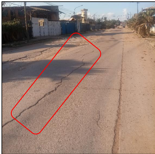
Fig. 52. Patología de Grieta Lineal con nivel de severidad alta, en la cuadra 4 de la Av. Santa Clara, Distrito de Manantay.
