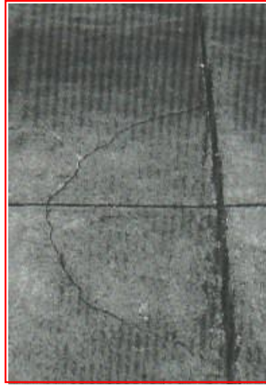
Figura 11. Grieta de esquina de baja severidad.
