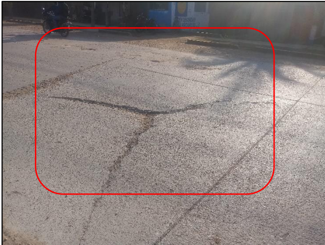
Fig. 54. Patología de Grieta Lineal con nivel de severidad alta, en la cuadra 5 de la Av. Santa Clara, Distrito de Manantay.
