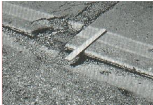
Figura 16. Desnivel carril/ Berma de baja severidad.
