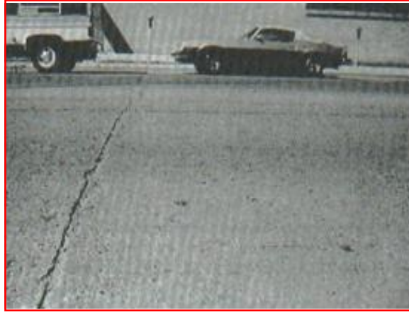
Figura 27. Descascamiento de junta de baja severidad.
