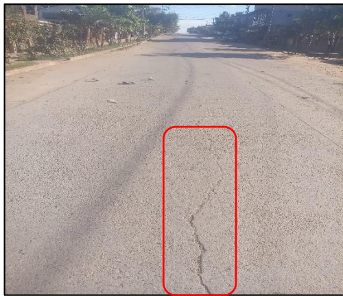
Fig. 49. Patología de Grieta Lineal con nivel de severidad media, en la cuadra 3 de la Av. Santa Clara, Distrito de Manantay.
