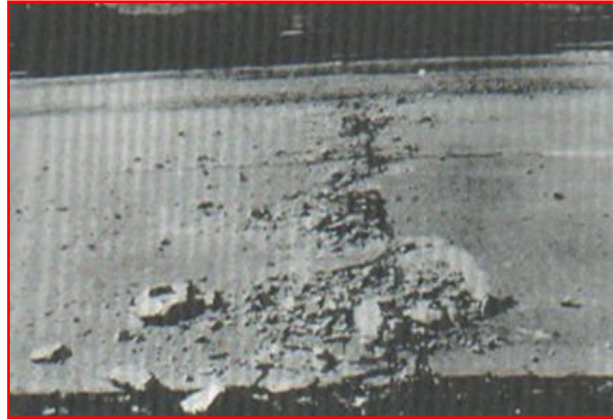
Figura 10. Blowup / Buckling de baja severidad.
