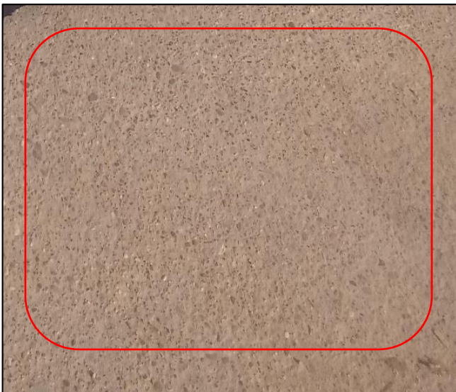
Fig. 55. Patología de Pulimiento de Agregados sin severidad, en la cuadra 5 de la Av. Santa Clara, Distrito de Manantay.
